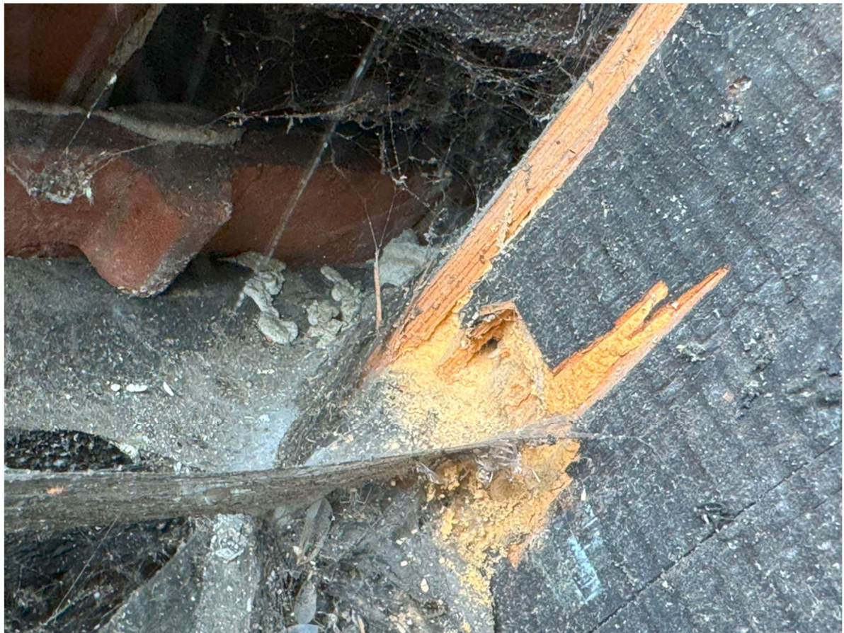
Fragmenty konstrukcji dachu częściowo nadwęglone, wymagające naprawy, uzupełnienia i napraw.
