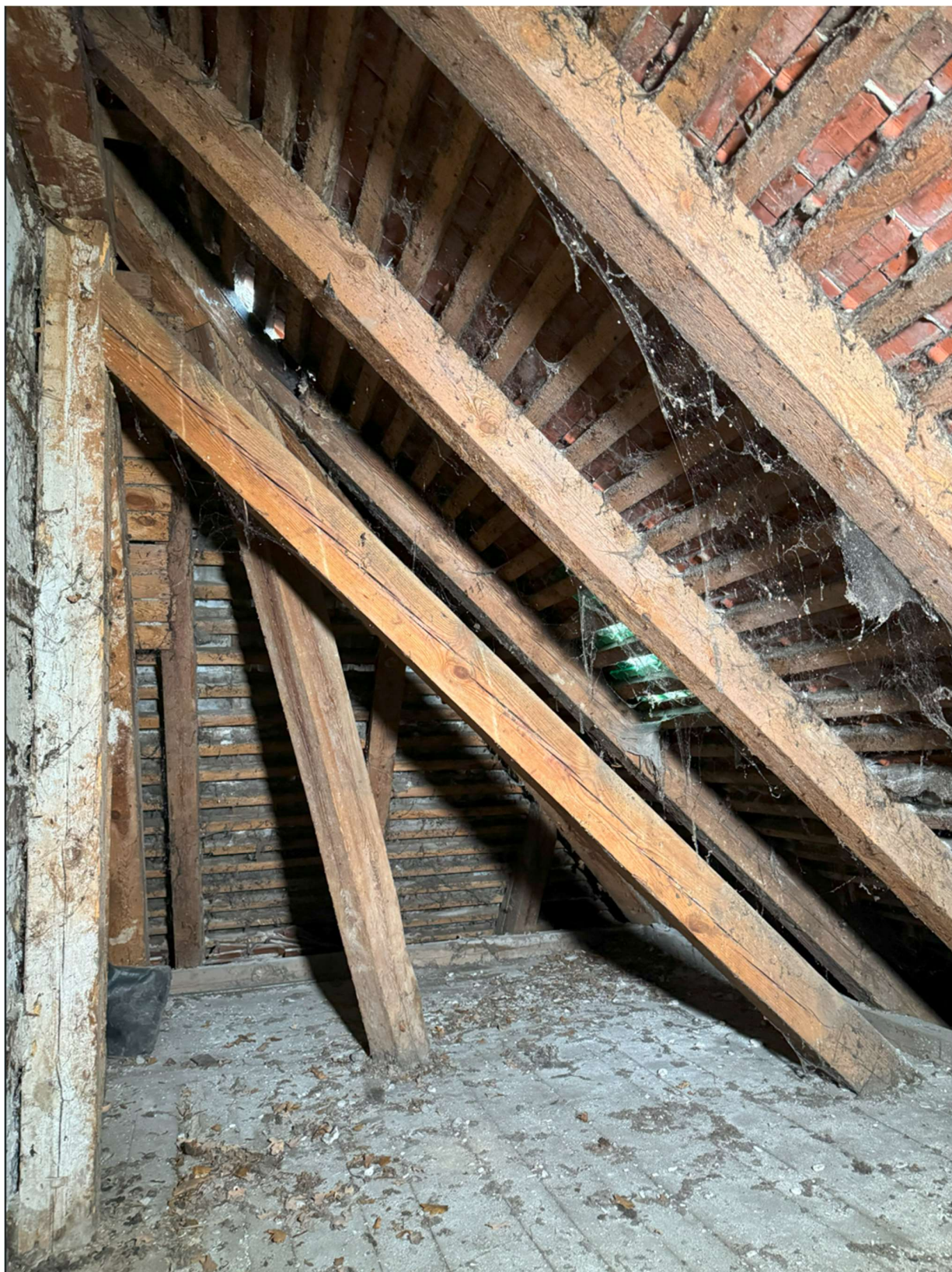
Fragment konstrukcji dachu niewymagający wymiany, konieczne naprawy miejscowe, w szczególności w obrębie okapów i w miejscach nieszczelności pokrycia dachowego.
