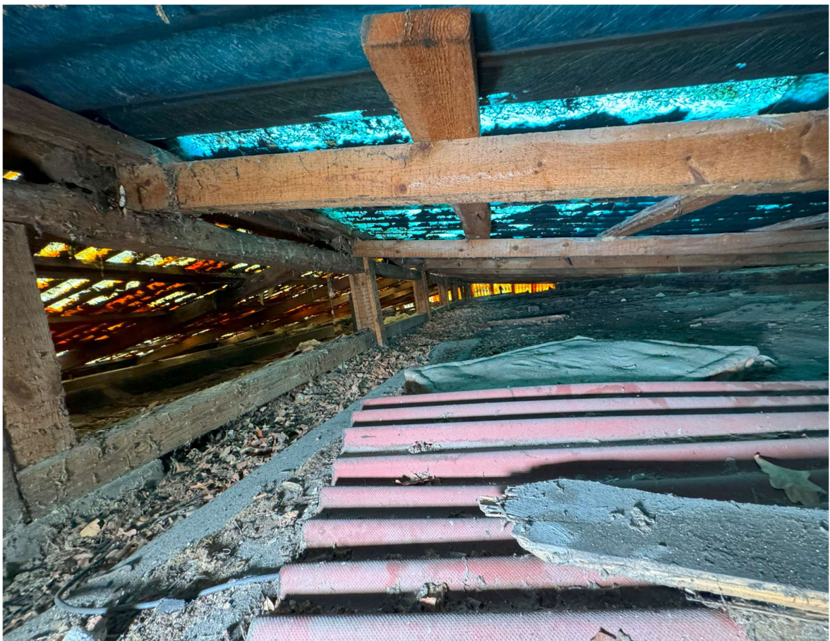
Fragment tymczasowej konstrukcji dachu wymagający wymiany na nową.
