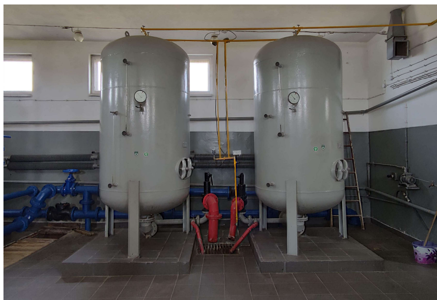
Fot. 10. Zbiorniki hydroforowe
