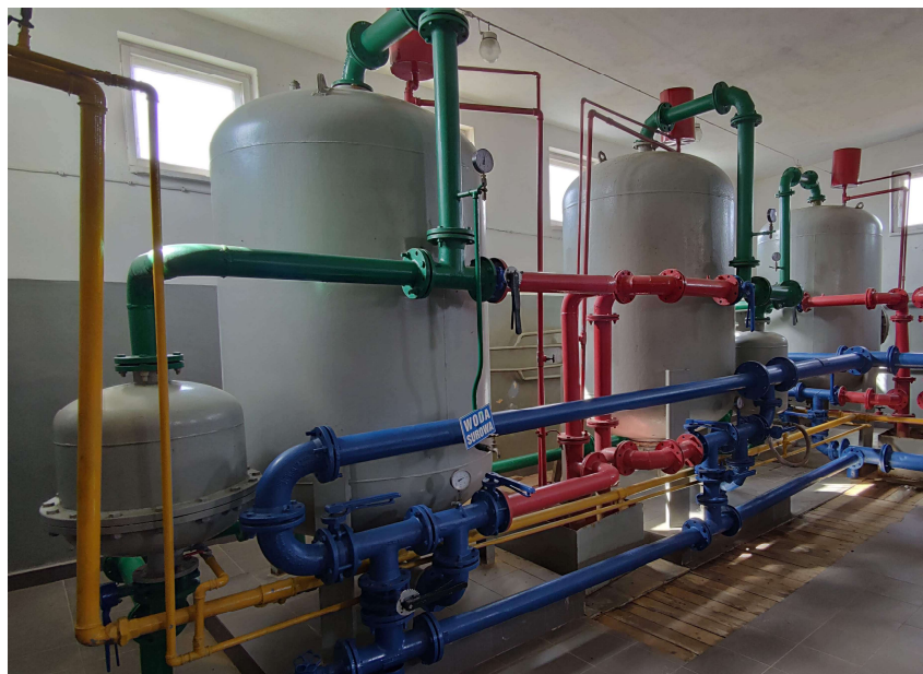
Fot. 9. Mieszacze wodno-powietrzne oraz 3 filtry odżelaziające
