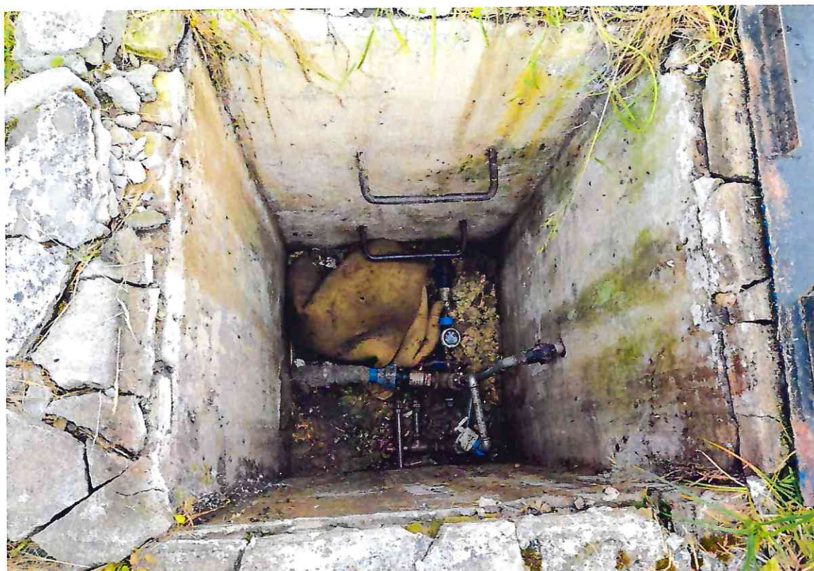
Fot. Studzienka z zestawem wodomierzowym
