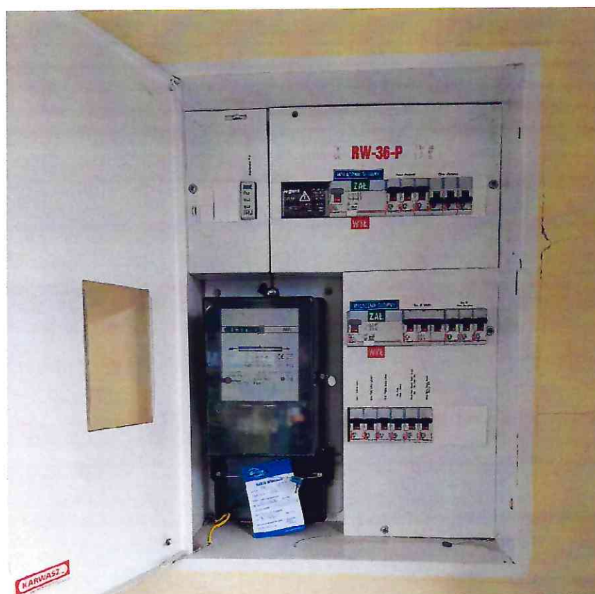
Fot. Rozdzielnica elektryczna
