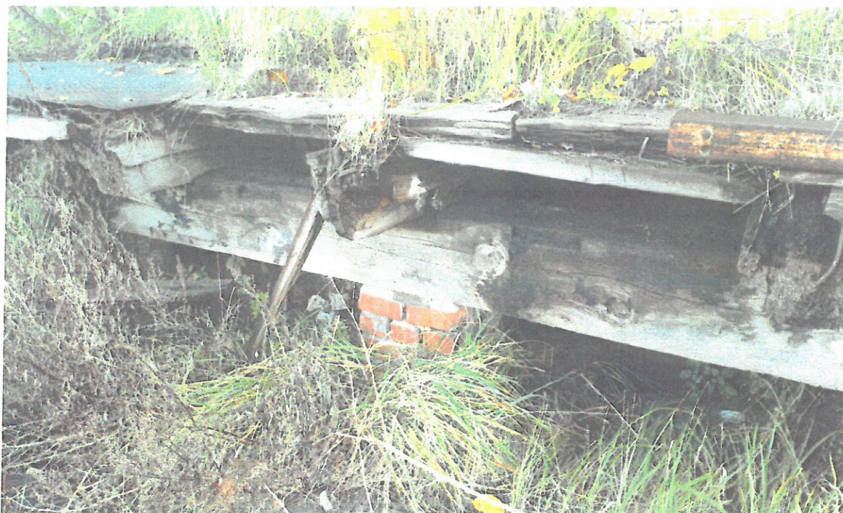
Zdjęcie nr 17 – zniszczona konstrukcja drewniana rampy
