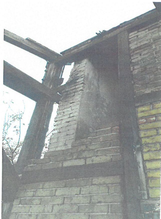
Zdjęcie nr 20 – brak połączenie ściany szczytowej ze ścianą podłużną
