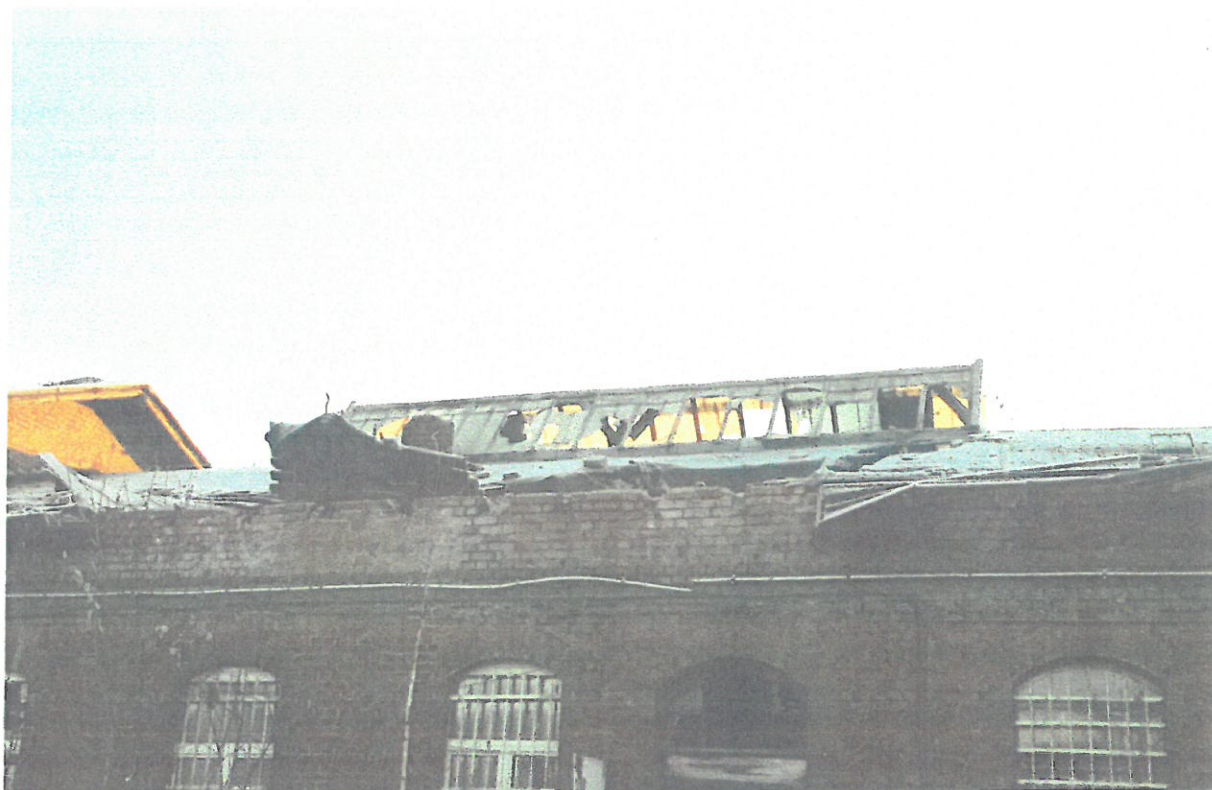
Zdjęcie nr 5 - zawalona centralna część dachu ze świetlikiem stalowym.
