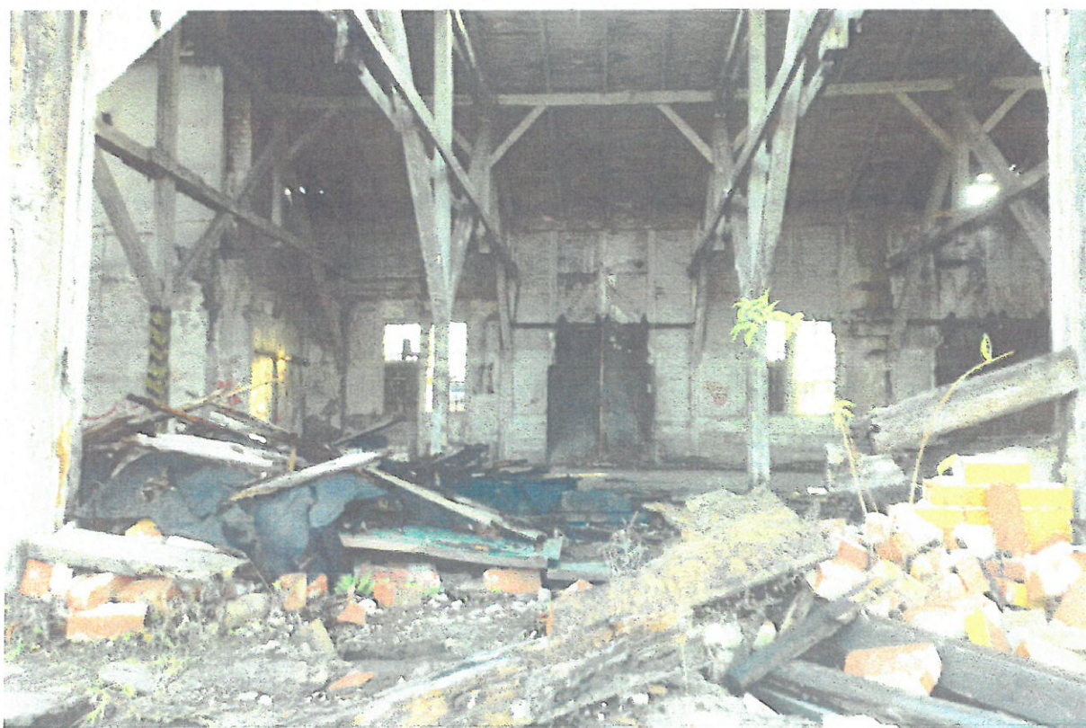
Zdjęcie nr 27 – zniszczona konstrukcja i poszycie dachu
