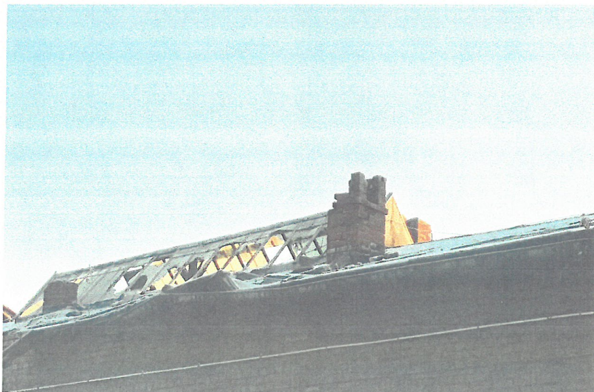
Zdjęcie nr 12 – zniszczony komin i świetlik konstrukcji stalowej
