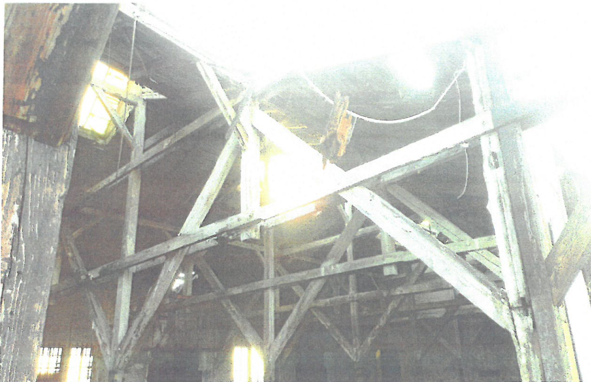
Zdjęcie nr 26 – zniszczone poszycie dachu
