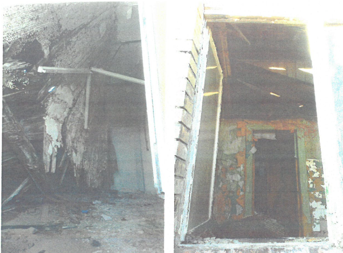
Zdjęcie nr 8, 9 – zawalona konstrukcja stropu drewnianego
