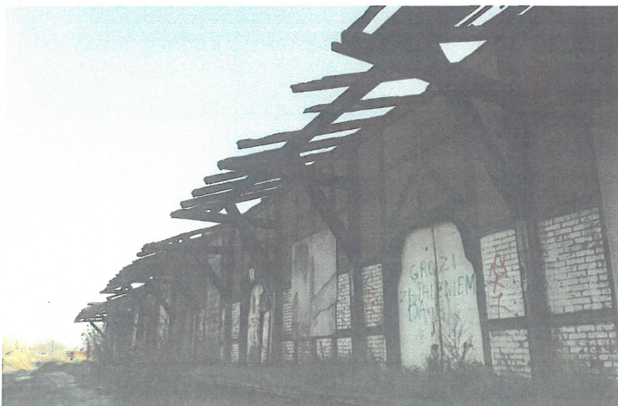
Zdjęcie nr 22 – zniszczone krokwie i poszycie nad rampą od strony parkingu
