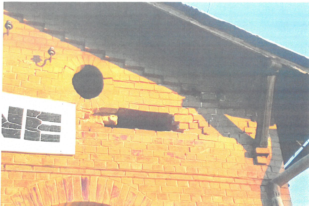
Zdjęcie nr 11 – zniszczona i odkształcony fragment ściany szczytowej
