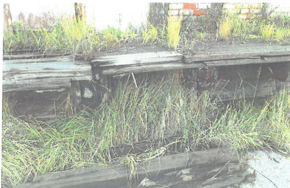
Zdjęcie nr 18 – zniszczona konstrukcja drewniana rampy
