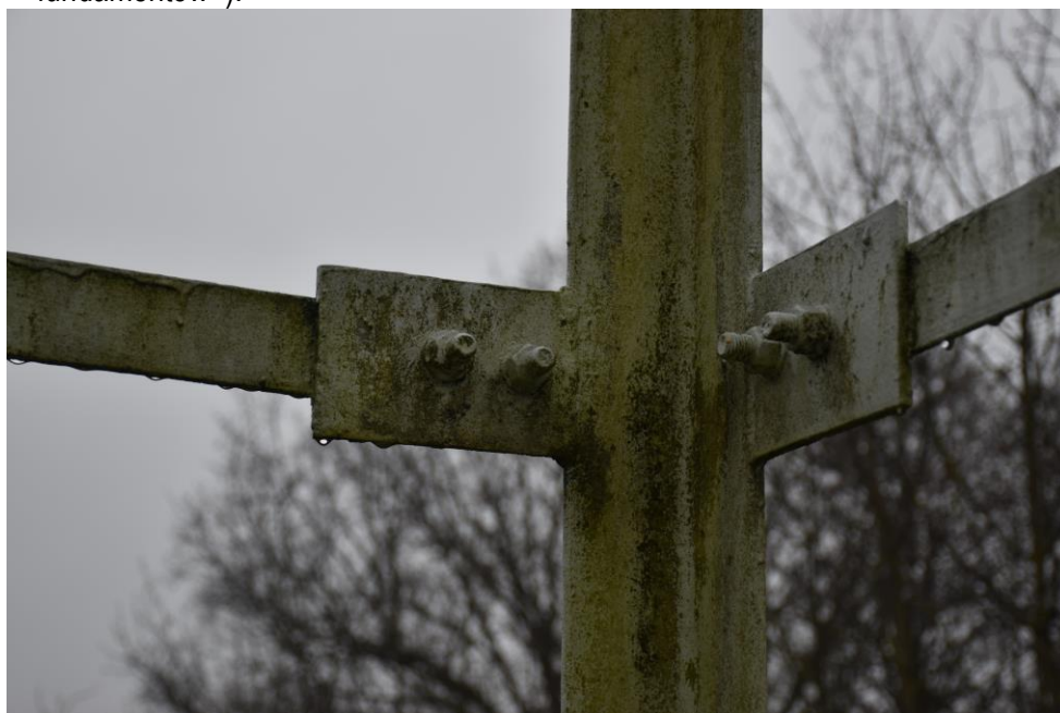
Rys.4b. Widok aktualnego stanu zabezpieczenia antykorozyjnego łączników śrubowych na wieży. Istotnych objawów korozji nie stwierdzono.
