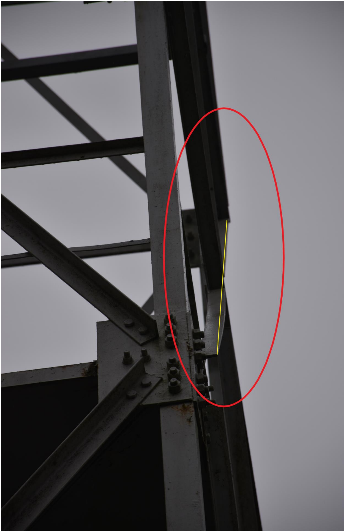
Rys.4d. Widok odkształconych prętów stężenia krawężników wieży.
