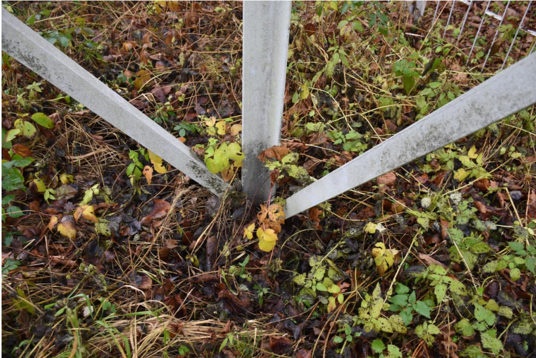
Rys.4e.Brak oczyszczenia i izolacji naziemnych części fundamentów.
