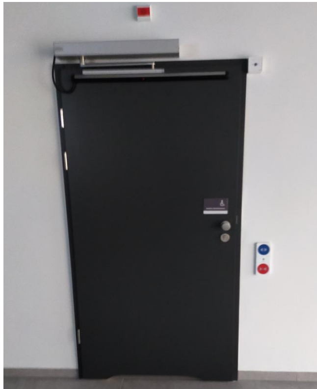
Zdj. 4. Drzwi automatyczne w budynku Wydziału Ekonomiczno-Socjologicznego Uniwersytetu Łódzkiego
