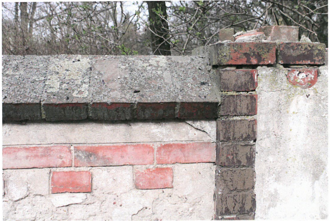
7. Rakoniewice. Ogrodzenie pałacowo – parkowe . Zniszczona czapka słupka
