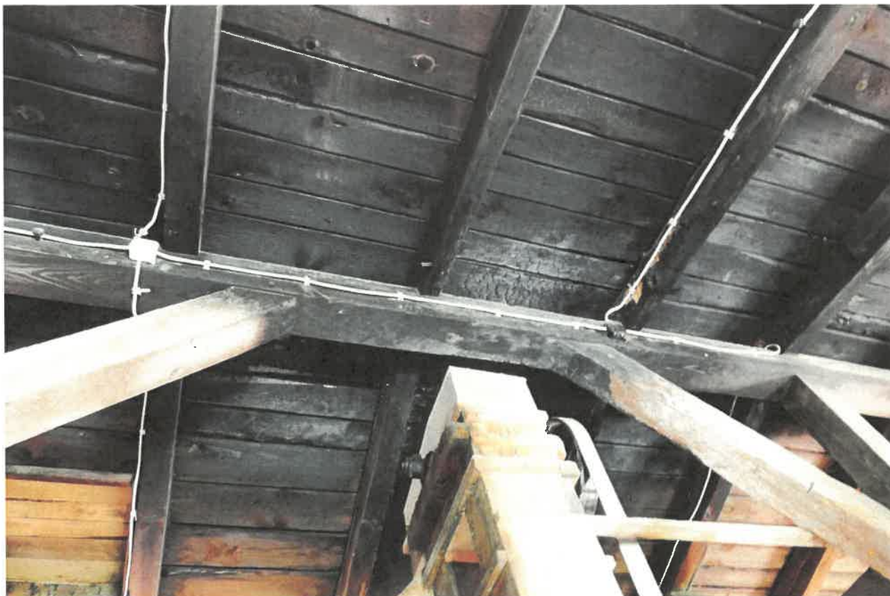
18. Nadpalone w wyniku pożaru belkowanie i deskowanie stropu ostatniej kondygnacji.
