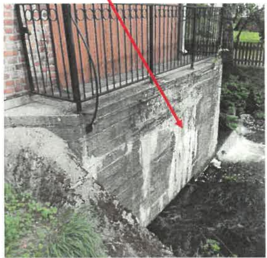
15. Betonowy cokół zanurzony w wodzie z widocznymi solami Candlota.
