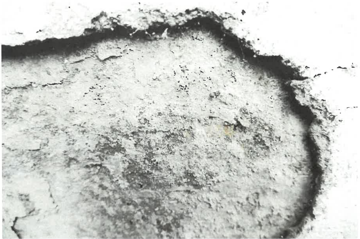
26. Odpadający tynk współczesny – północna ściana piwnicy. Widoczne krystalizujące sole na powierzchni ściennej.
