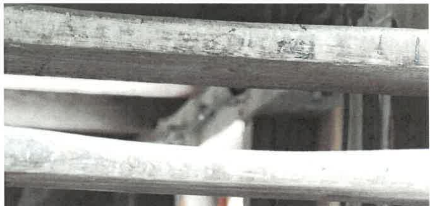
23. Przetarcia stopni oryginalnych schodów – parter budynku.
