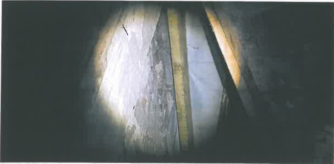
Fot. 12. Zdjęcie wykonane podczas kontroli pomieszczeń poddasza budynku starej szkoły.
