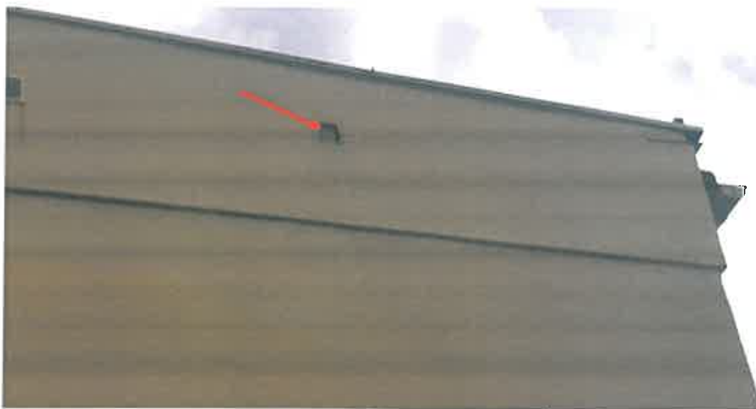
Fot. 3. Szczegółowa lokalizacja przestrzeni zajętej przez wróble. Ptaki nie wykorzystywały zabezpieczonego stropodachu a jedynie przestrzeń pomiędzy ścianą a tynkiem.
