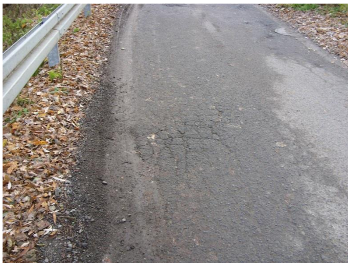
Fot. 5. Widoczne zanieczyszczenia i wegetacja roślinności na jezdni i poboczu. Widoczne spękania nawierzchni przy krawędzi jezdni po stronie dolnej wody.
