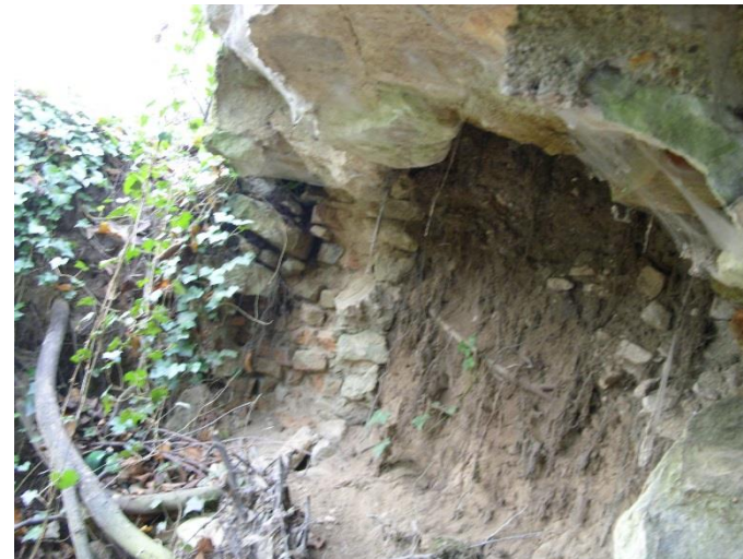
Fot. 14. Widoczny bardzo duży ubytek materiału w korpusie i skrzydle przyczółka po stronie górnej wody.
