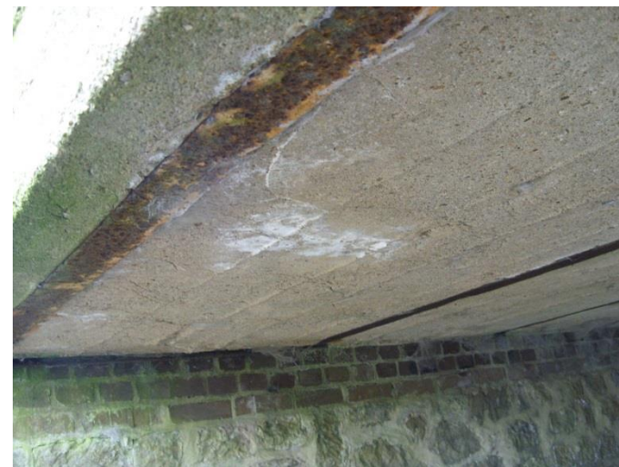
Fot. 10. Widoczne ubytki na zewnętrznej krawędzi płyty pomostu oraz korozja dźwigara stalowego. Widoczne zacieki, wykwyty i zanieczyszczenie spodniej części płyty pomostowej.
