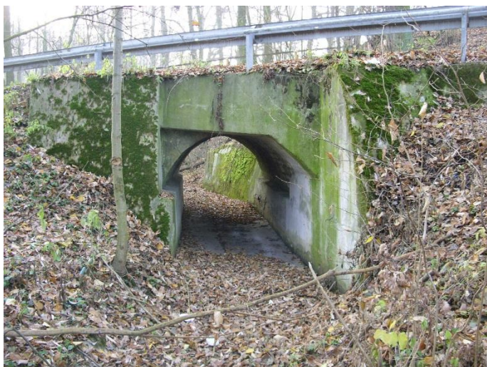
Fot. 11. Widoczne zanieczyszczenia i wegetacja roślinności na ścianie skrzydła podpory nr 2 po stronie dolnej wody.
