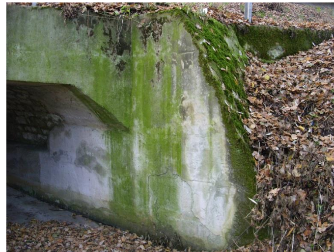
Fot. 10. Widoczne zanieczyszczenia, zacieki oraz wegetacja roślinności na ścianie bocznej pomostu i skrzydle podpory nr 1 po stronie dolnej wody. Widoczny ubytek ziemi na skarpie
