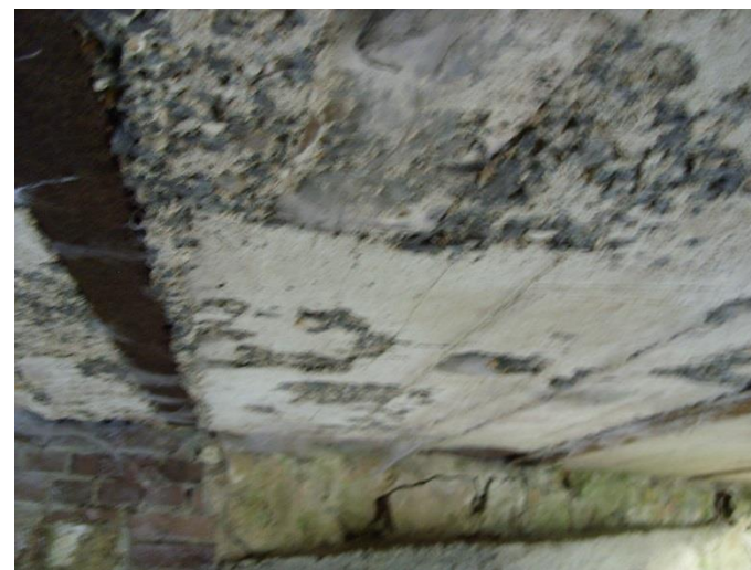
Fot. 12. Widoczne ubytki betonu na spodniej części płyty pomostowej oraz korozja dźwigarów stalowych. Widoczne zanieczyszczenia oraz ubytki materiału w ścianie przyczółka.
