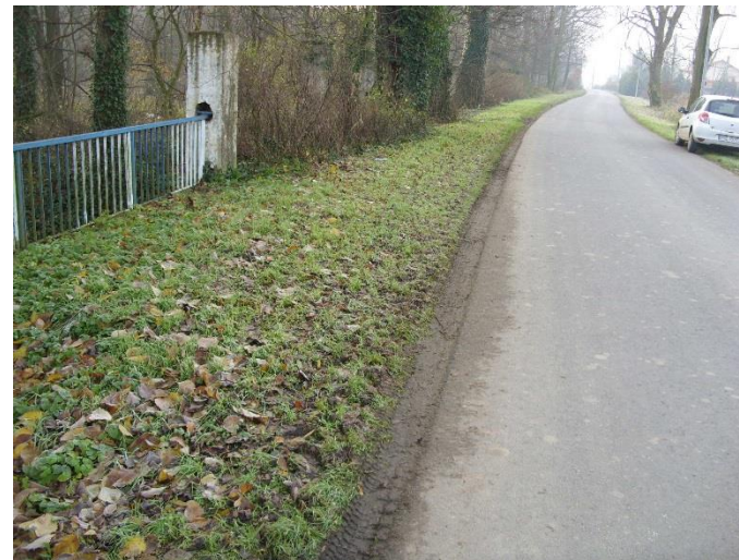
Fot. 6. Widoczne duże zanieczyszczenia i wegetacja roślin na poboczu.
