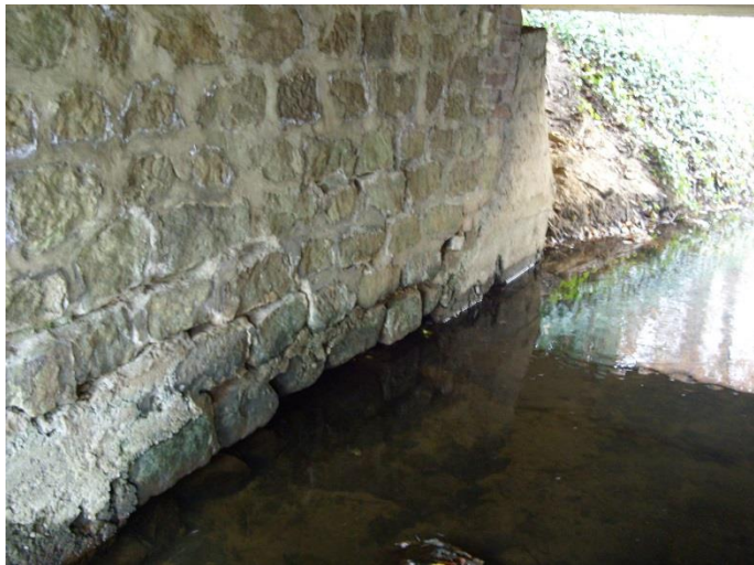
Fot. 13. Widoczne zanieczyszczenia oraz ubytki materiału w ścianie przedniej przyczółka oraz częściowe jego podmycie.
