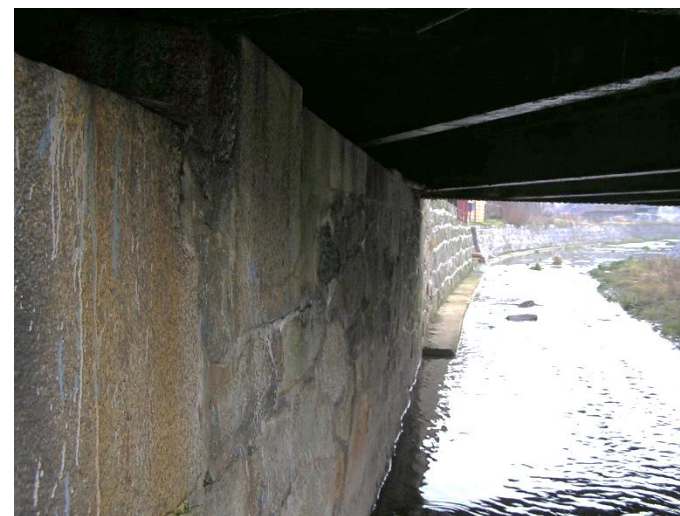
Fot. 20. Widoczne zanieczyszczenia i zacieki na ścianie korpusu podpory oraz ubytki materiału spoin w murze podpory nr 1. W tle widoczne niewielkie zanieczyszczenie koryta cieku.
