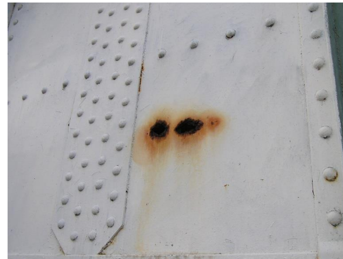
Fot. 14. Widoczna perforacja blachy środnika na wysokości elementów pomostu w dźwigarze głównym po stronie górnej wody.
