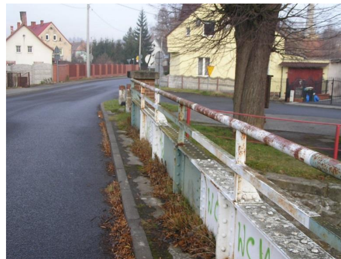
Fot. 6. Widoczne niewielkie zanieczyszczenia i wegetacja roślin na jezdni i chodniku.
