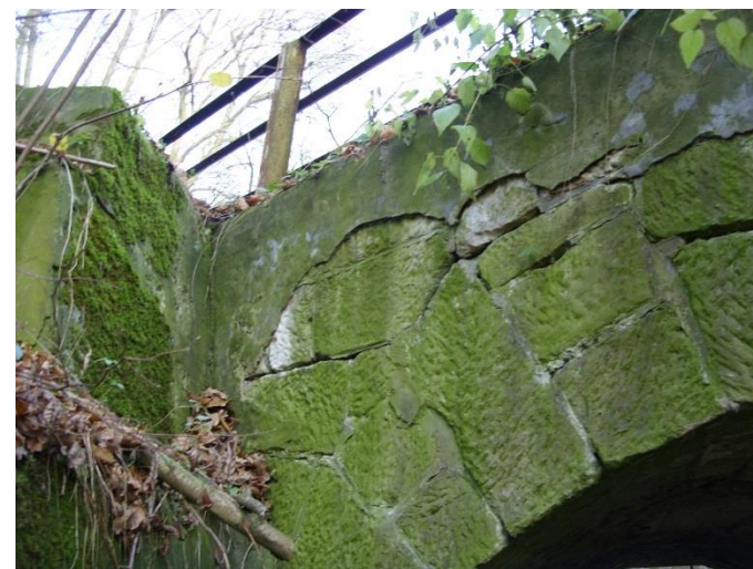
Fot. 8. Widoczne zanieczyszczenia i występowanie porostów na ścianie bocznej. Widoczne ubytki materiału spoin w sklepieniu po stronie górnej wody.
