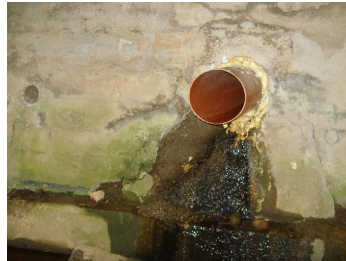
Fot. 18. Widoczne spękania korpusu przyczółka po stronie m. Lubań. Widoczny znaczny ubytek materiału konstrukcyjnego korpusu podpory. Widoczne zanieczyszczenia koryta ciekłu pod obiektem.
