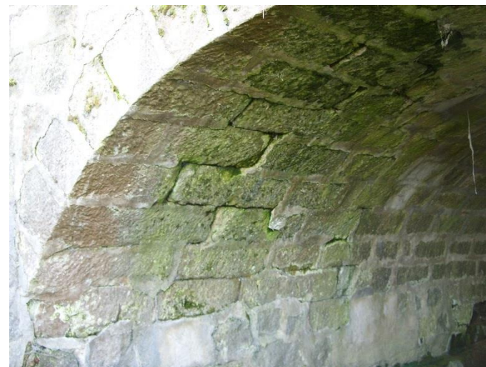
Fot. 10. Widoczne ubytki spoin w konstrukcji sklepienia łukowego. Przebieg ubytków spoin w sklepieniu świadczy o przemieszczaniu się skrajnej części sklepienia i ściany czołowej na zewnątrz obiektu.
