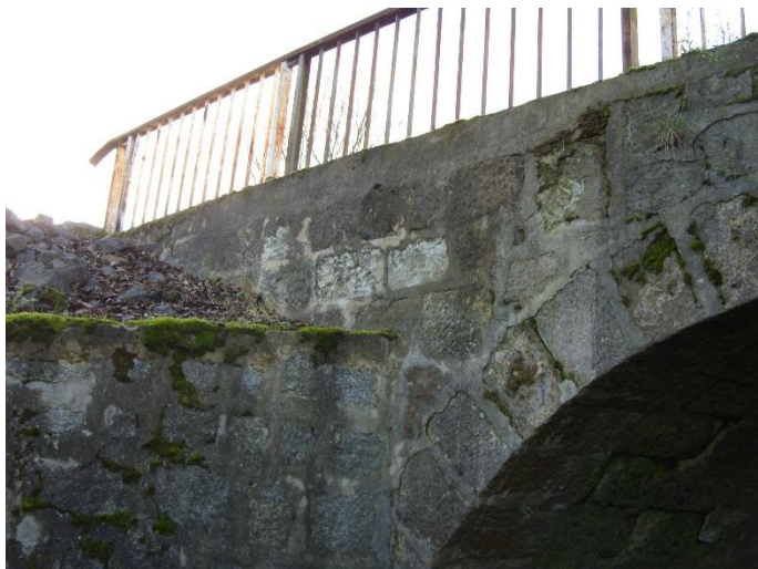
Fot. 9. Widoczna wegetacja roślinności na gzymsie, skrzydłach, ścianie czołowej podpory oraz na elementach kamiennego sklepienia po stronie dolnej wody.
