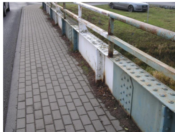
Fot. 8. Widoczne zanieczyszczenia i wegetacja roślinności na chodniku przy środku dźwigara głównego. Widoczne ubytki powłok antykorozyjnych oraz korozja powierzchniowa na elementach konstrukcji stalowej przęsła.
