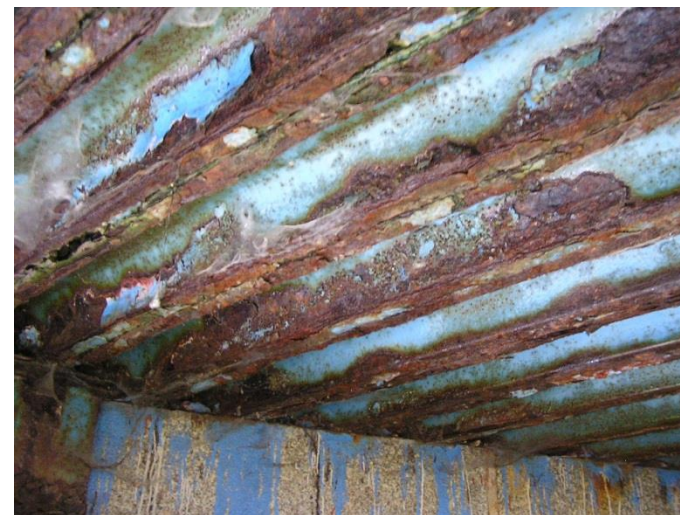
Fot. 12. Widoczne zacieki i wykwyty na elementach ustroju nośnego świadczące o nieszczelności izolacji pomostu. Widoczne znaczne ubytki powłok antykorozyjnych oraz zaawansowana korozja i ubytki elementów konstrukcji stalowej przęsła.
