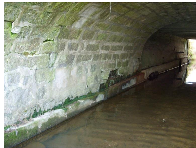
Fot. 12. Widoczne ubytki spoin w konstrukcji sklepienia łukowego. Przebieg ubytków spoin w sklepieniu świadczy o przemieszczaniu się skrajnej części sklepienia i ściany czołowej na zewnątrz obiektu.
