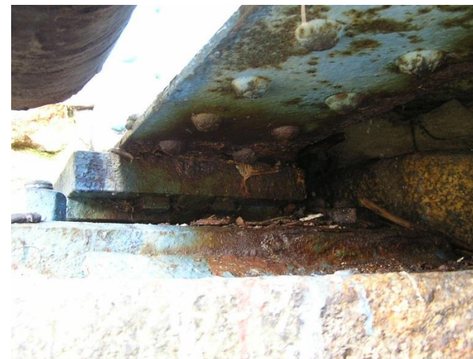
Fot. 16. Widoczne ubytki powłok antykorozyjnych oraz zaawansowana korozja elementów konstrukcji stalowej przęsła i łożyska stalowego.
