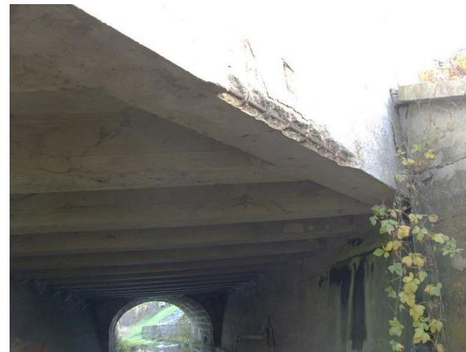
Fot. 14. Widoczny ubytek otuliny w dźwigarze skrajnym po stronie górnej wody. Widoczna korozja odsłoniętych prętów zbrojeniowych.
