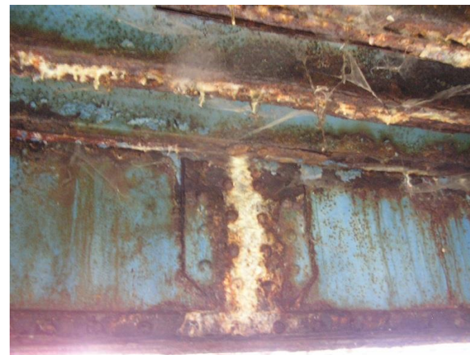
Fot. 10. Widoczne zacieki i wykwyty na elementach ustroju nośnego świadczące o nieszczelności izolacji pomostu. Widoczne znaczne ubytki powłok antykorozyjnych oraz zaawansowana korozja i ubytki elementów konstrukcji stalowej przęsła.
