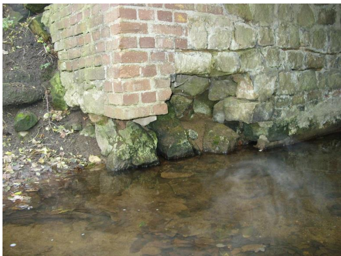
Fot. 15. Widoczne ubytki materiału kamiennego i ceglanego w ścianie przedniej przyczółka oraz w skrzydle po stronie dolnej wody.
