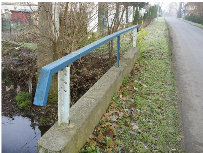
Fot. 7. Widoczna wegetacja roślin na poboczu oraz korozja stalowej części balustrady.
