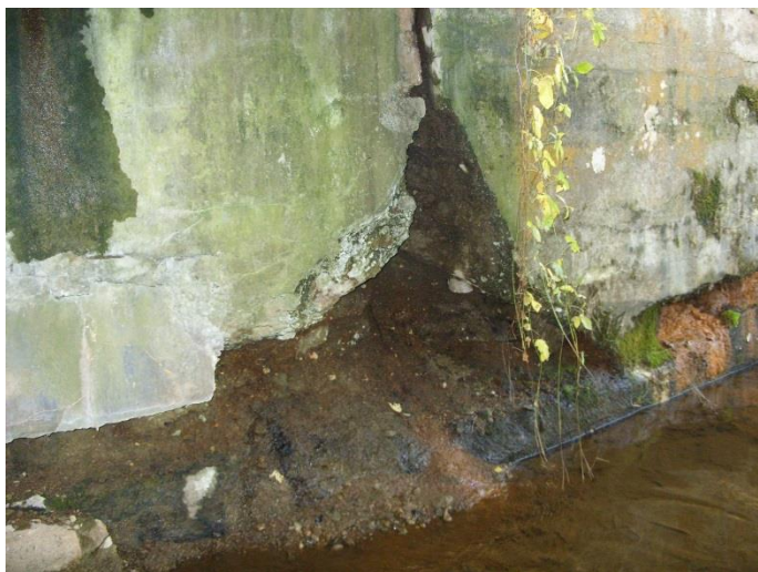
Fot. 19. Widoczne liczne spękania ściany czołowej przyczółka w trefie ławy fundamentowej oraz ubytek w ścianie czołowej korpusu podpory.
