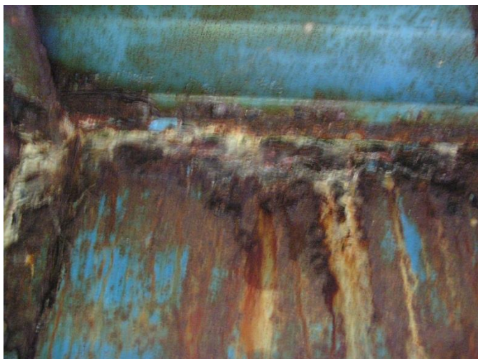
Fot. 11. Widoczne zacieki i wykwyty na elementach ustroju nośnego świadczące o nieszczelności izolacji pomostu. Widoczne znaczne ubytki powłok antykorozyjnych oraz zaawansowana korozja nitów i elementów konstrukcji stalowej przęsła.
