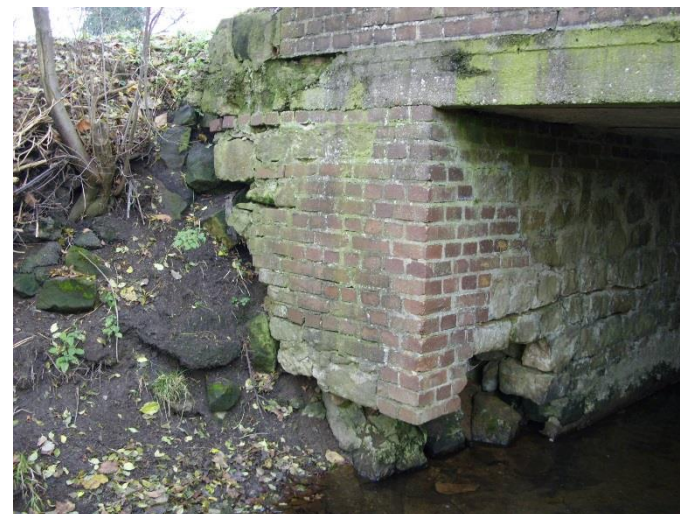
Fot. 16. Widoczna roślinność oraz duże ubytki ziemi na skarpach przy obiekcie. Widoczne ubytki materiału kamiennego i ceglanego w ścianie przedniej przyczółka oraz w skrzydle po stronie dolnej wody.
