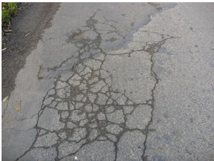
Fot. 7. Widoczne spękania siatkowe, obniżenia i ubytki nawierzchni mineralno-asfaltowej jezdni na długości skrzydła po stronie górnej wody.
