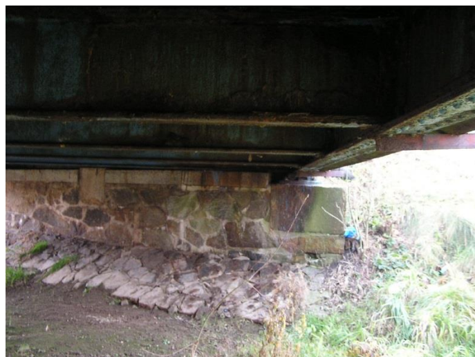
Fot. 19. Widoczne zanieczyszczenia i zacieki na ścianie korpusu podpory oraz ubytki materiału spoin w murze podpory nr 2.
