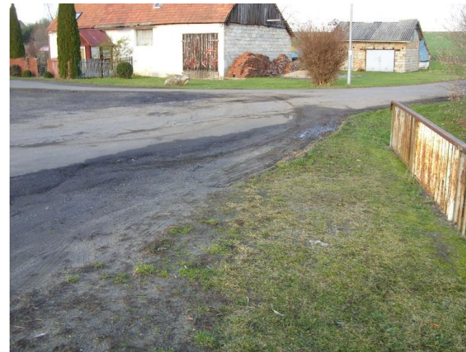
Fot. 6. Widoczne zanieczyszczenia i wegetacja roślin na jezdni, poboczu oraz gzymsie. Widoczne znaczne ubytki powłok antykorozyjnych i korozja balustrady stalowej po stronie dolnej wody.
