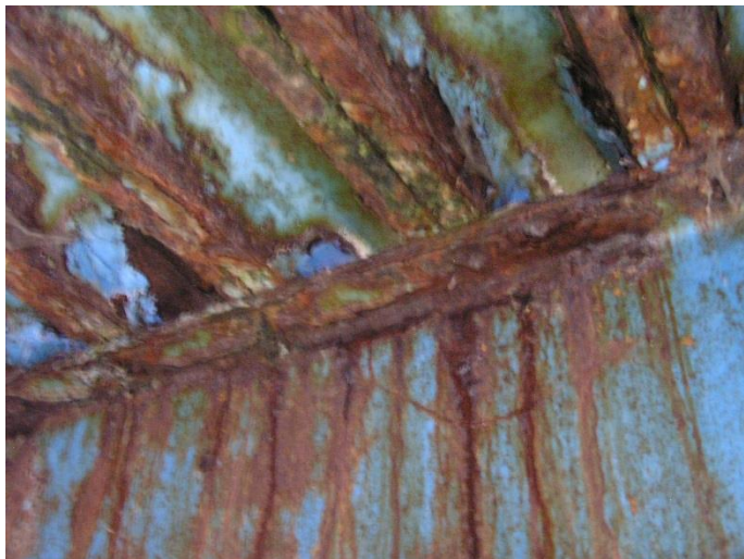
Fot. 13. Widoczne znaczne ubytki powłok antykorozyjnych oraz zaawansowana korozja elementów konstrukcji stalowej przęsła. Widoczny ubytek materiału kształtownika Zoresa.
