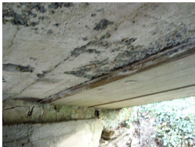
Fot. 11. Widoczne ubytki betonu na spodniej części płyty pomostowej. Widoczna korozja prętów zbrojeniowych oraz półek dolnych dźwigarów stalowych.
