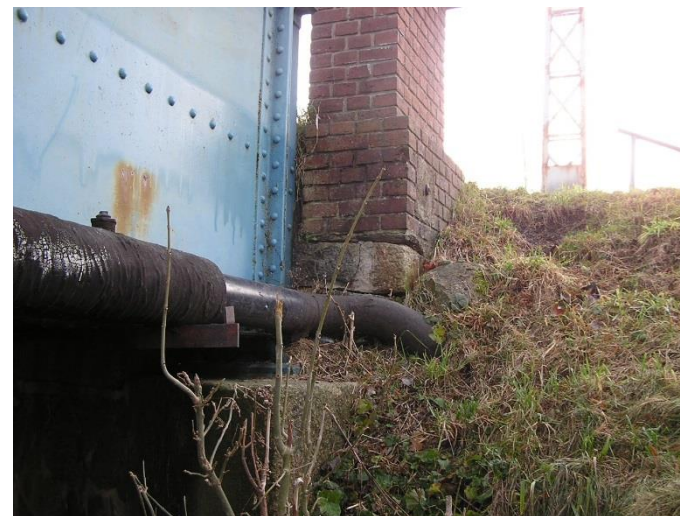
Fot. 18. Widoczna zanieczyszczenia ławy podłożyskowej podpory nr 2. Widoczne ubytki powłok antykorozyjnych oraz korozja powierzchniowa na elementach konstrukcji stalowej przęsła.
