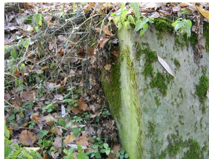
Fot. 12. Widoczne zanieczyszczenia i wegetacja roślinności na ścianie skrzydła podpory nr 1 po stronie górnej wody.
