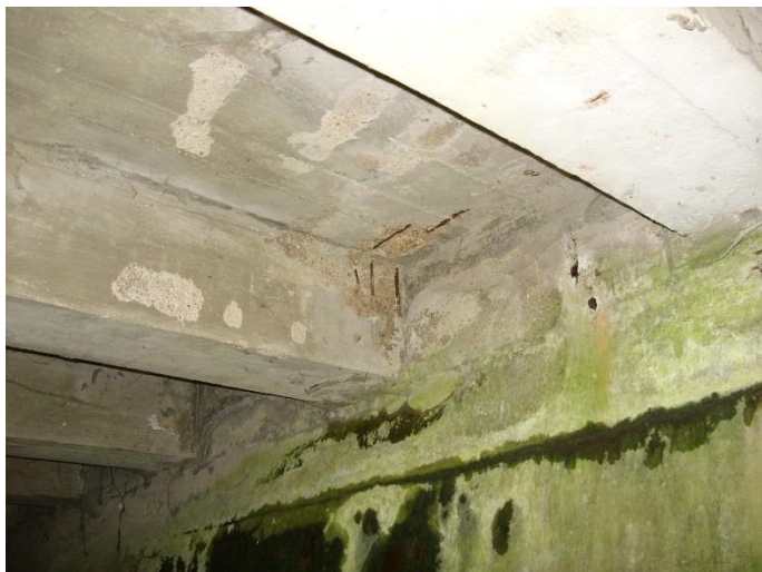
Fot. 13. Widoczne ubytki otulin w żelbetowej płycie pomostowej, poprzecznicy i dźwigarze. Widoczna zaawansowana korozja odsłoniętych prętów zbrojeniowych. Widoczne zacieki i wykwyty oraz porosty na ścianie czołowej korpusu podpory świadczące o nieszczelności izolacji obiektu w rejonie przerwy technologicznej.
