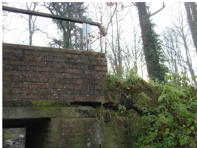
Fot. 9. Widoczna vegetacja roślin na skarpach przy obiekcie. Widoczne zanieczyszczenia w postaci porostów oraz ubytki materiału w ceglanej ścianie bocznej obiektu.
