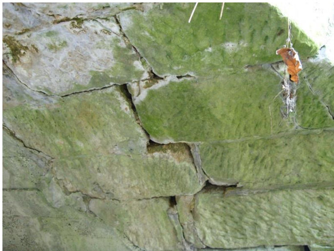
Fot. 9. Widoczne ubytki materiału spoin w kamiennym sklepieniu.
