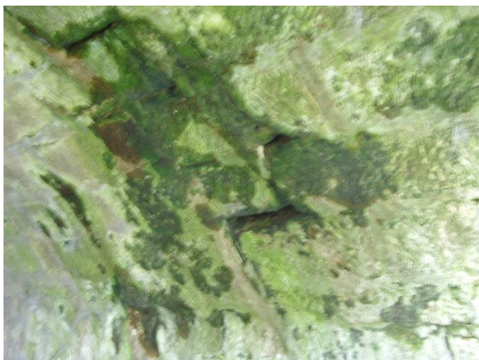
Fot. 11. Widoczne ubytki spoin oraz pęknięcia materiału konstrukcyjnego sklepienia łukowego.
