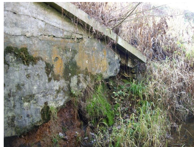
Fot. 20. Widoczne bardzo duże ubytki materiału konstrukcyjnego skrzydła i przyczółka. Widoczne przemieszczenie się skrzydła w stronę koryta ciekłu. Widoczne liczne spękania skrzydła. Widoczna duża wegetacja roślinności na skrzydle oraz liczne zacieki na ścianach skrzydła.
