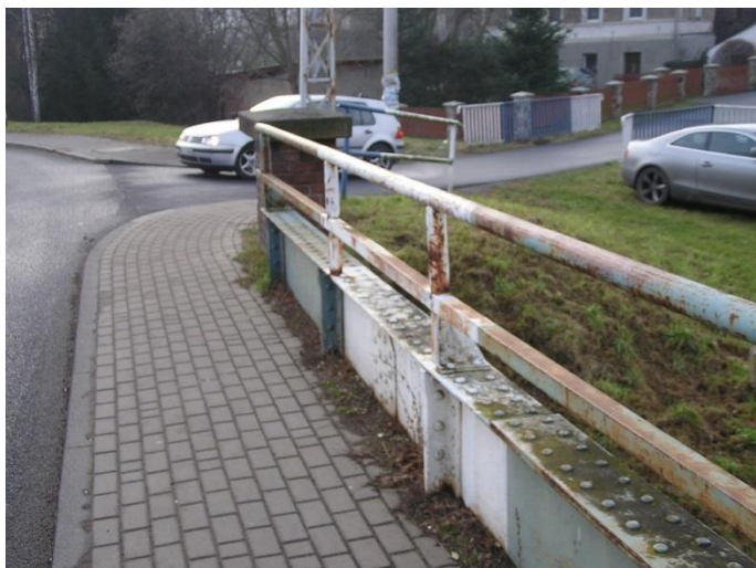
Fot. 9. Widoczne zanieczyszczenia i wegetacja roślinności na chodniku przy środniku dźwigara głównego. Widoczne ubytki powłok antykorozyjnych oraz korozja powierzchniowa na elementach dźwigara głównego i balustrady stalowej.
