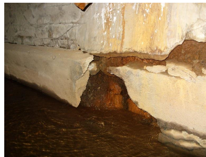
Fot. 16. Widoczne liczne spękania korpusu przyczółka po stronie m. Gościszów. Widoczny znaczny ubytek materiału konstrukcyjnego korpusu podpory oraz podmycia fundamentu podpory.
