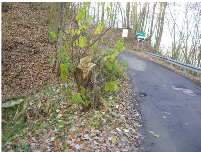
Fot. 7. Widoczne drzewo wrosnięte w balustradę stalową od strony m. Nowogrodzic. Widoczne całkowite ubytki powłok antykorozyjnych i korozja powierzchniowa na stalowych elementach balustrady. Widoczne ubytki i deformacje nawierzchni jezdni na obiekcie i dojazdach.
