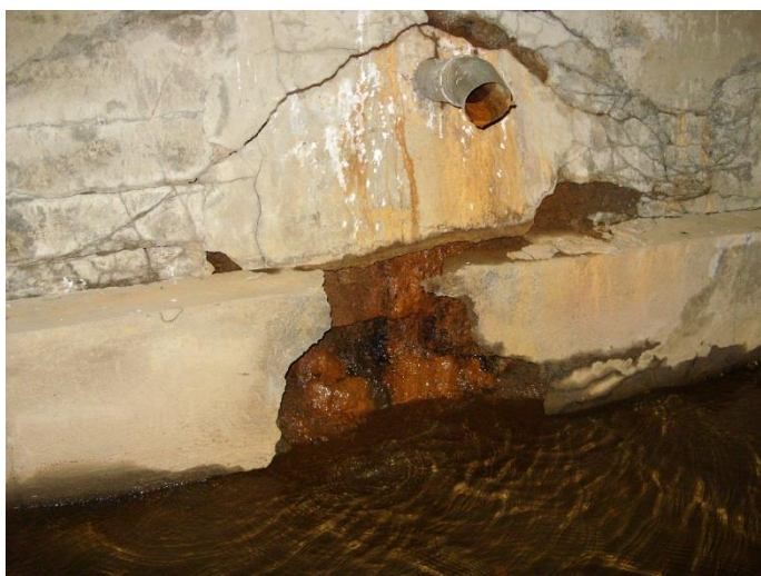
Fot. 15. Widoczne liczne spękania korpusu przyczółka po stronie m. Gościszów. Widoczny znaczny ubytek materiału konstrukcyjnego korpusu podpory oraz podmycie fundamentu podpory.
