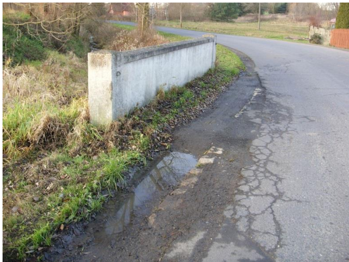
Fot. 5. Widoczne zanieczyszczenia i wegetacja roślin na jezdni, poboczu oraz barierze betonowej od strony górnej wody. Widoczne rysy, deformacje i spękania w nawierzchni jezdni
