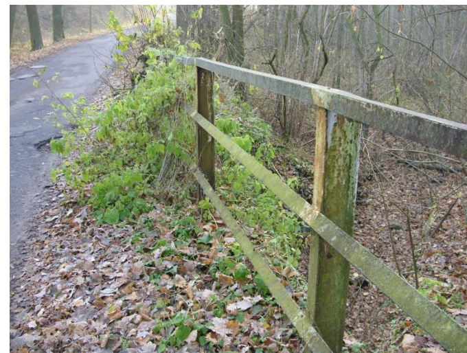
Fot. 6. Widoczne duże zanieczyszczenia i wegetacja roślinności na jezdni i poboczu. Widoczne całkowite ubytki powłok antykorozyjnych i korozja powierzchniowa na stalowych elementach balustrady.
