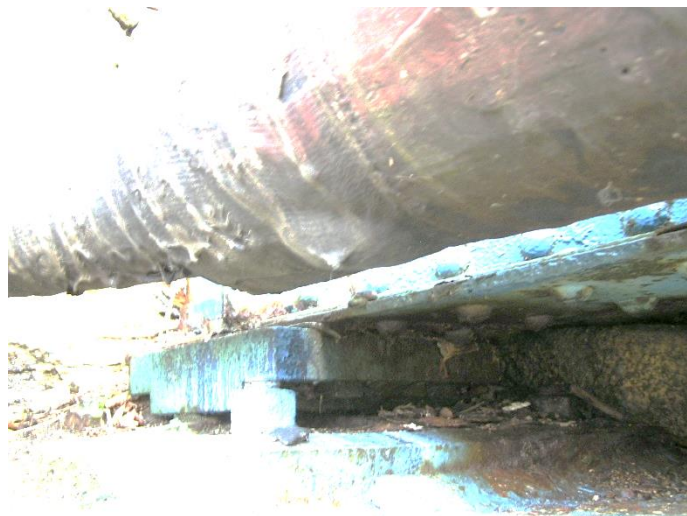
Fot. 17. Widoczna zanieczyszczenia ławy podłożyskowej podpory nr 1.
