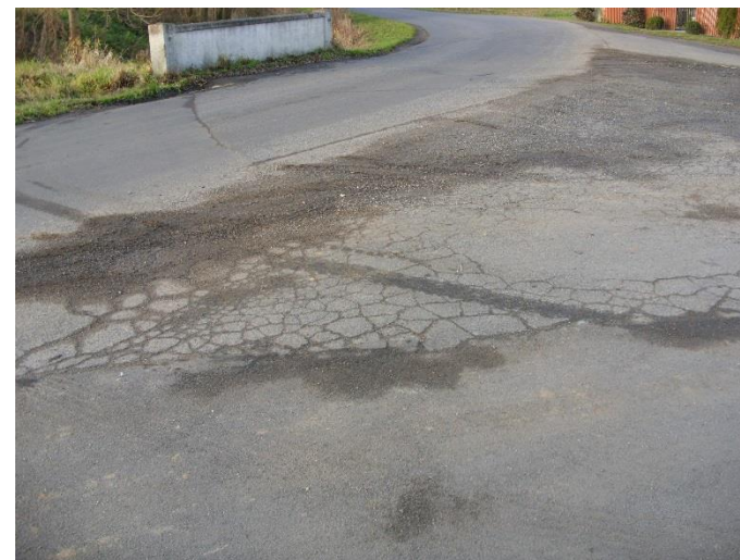
Fot. 8. Widoczne bardzo duże deformacje nawierzchni jezdni na obiekcie w rejonie "wyspy".
