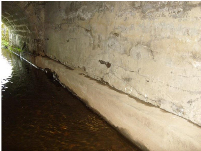
Fot. 17. Widoczne liczne spękania korpusu przyczółka po stronie m. Gościszów. Widoczny znaczny ubytek materiału konstrukcyjnego korpusu podpory oraz podmycia fundamentu podpory.
