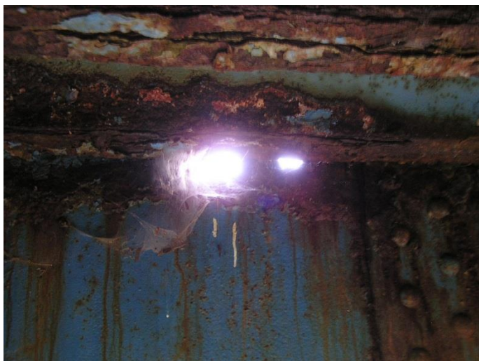
Fot. 15. Widoczna perforacja blachy środnika na wysokości elementów pomostu w dźwigarze głównym po stronie górnej wody. Widoczne ubytki powłok antykorozyjnych oraz zaawansowana korozja elementów konstrukcji stalowej przęsła.
