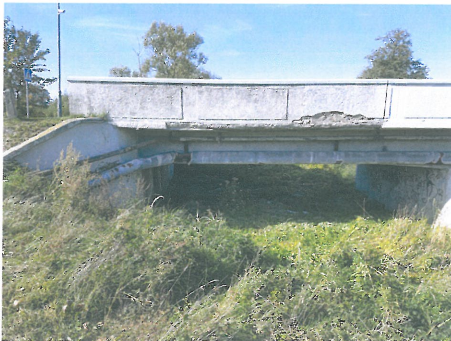
Uszkodzenie wspornika pod balustradą po stronie połuniowej od górnej wody
