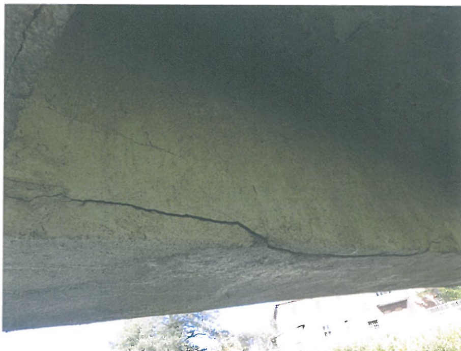
Pęknięcie otuliny w dolnej części belki
