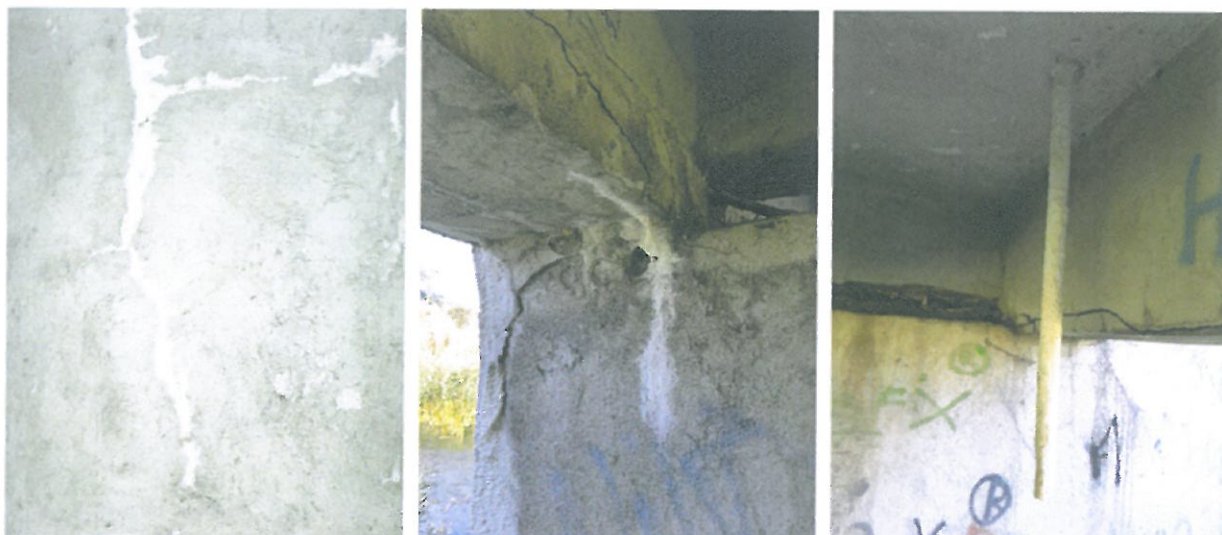
Uszkodzenia izolacji (przecieki) oraz nieszczelność płyty w rejonie sączków
