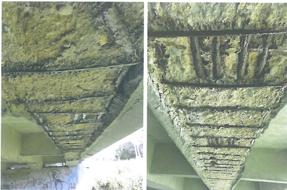
Brak otuliny w dolnej części belki, odsłonięcie zbrojenia głównego i rozdzielczego
