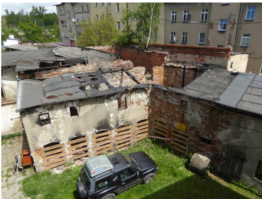
6. Dach zniszczony przez pożar.
