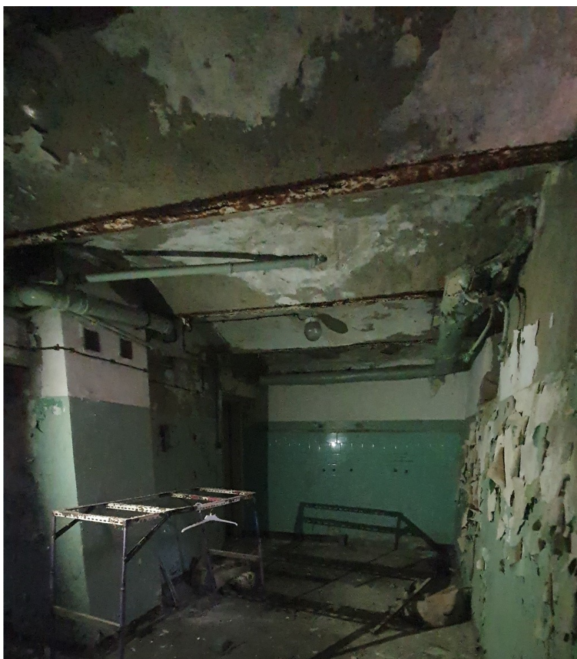
Widok ścian piwnicznych oraz stropu nad piwnicą i ich zawilgocenie. [fotografia stan na 10.03.2022 r.]
