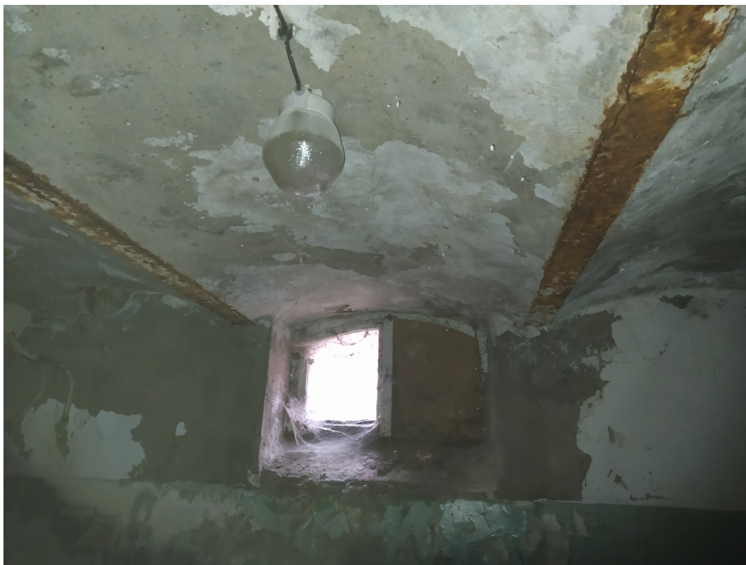
Stropy nad piwnicą – strop odcinkowy. Belki stalowe znacznie skorodowane
