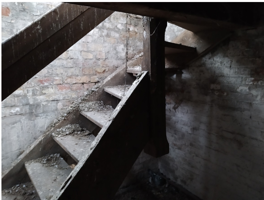
Schody na wieże i widoczne zanieczyszczenie drewna odchodami ptaków
