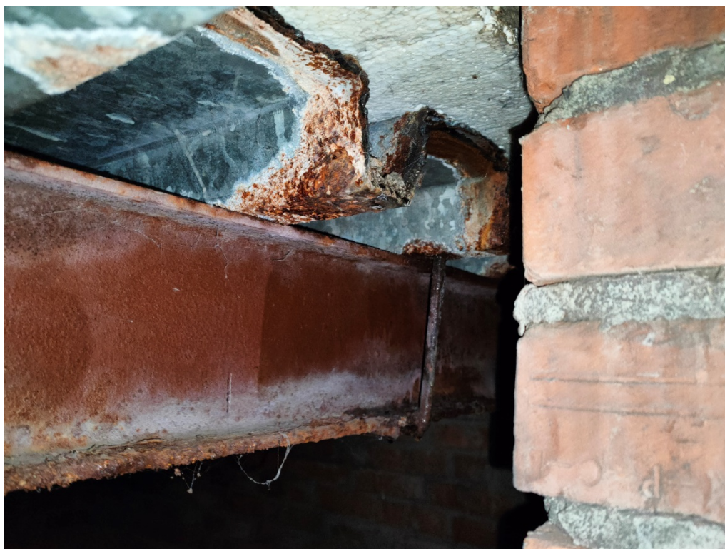
Widok korozji blachy pod dachem. [fotografia stan na 10.03.2022 r.]
