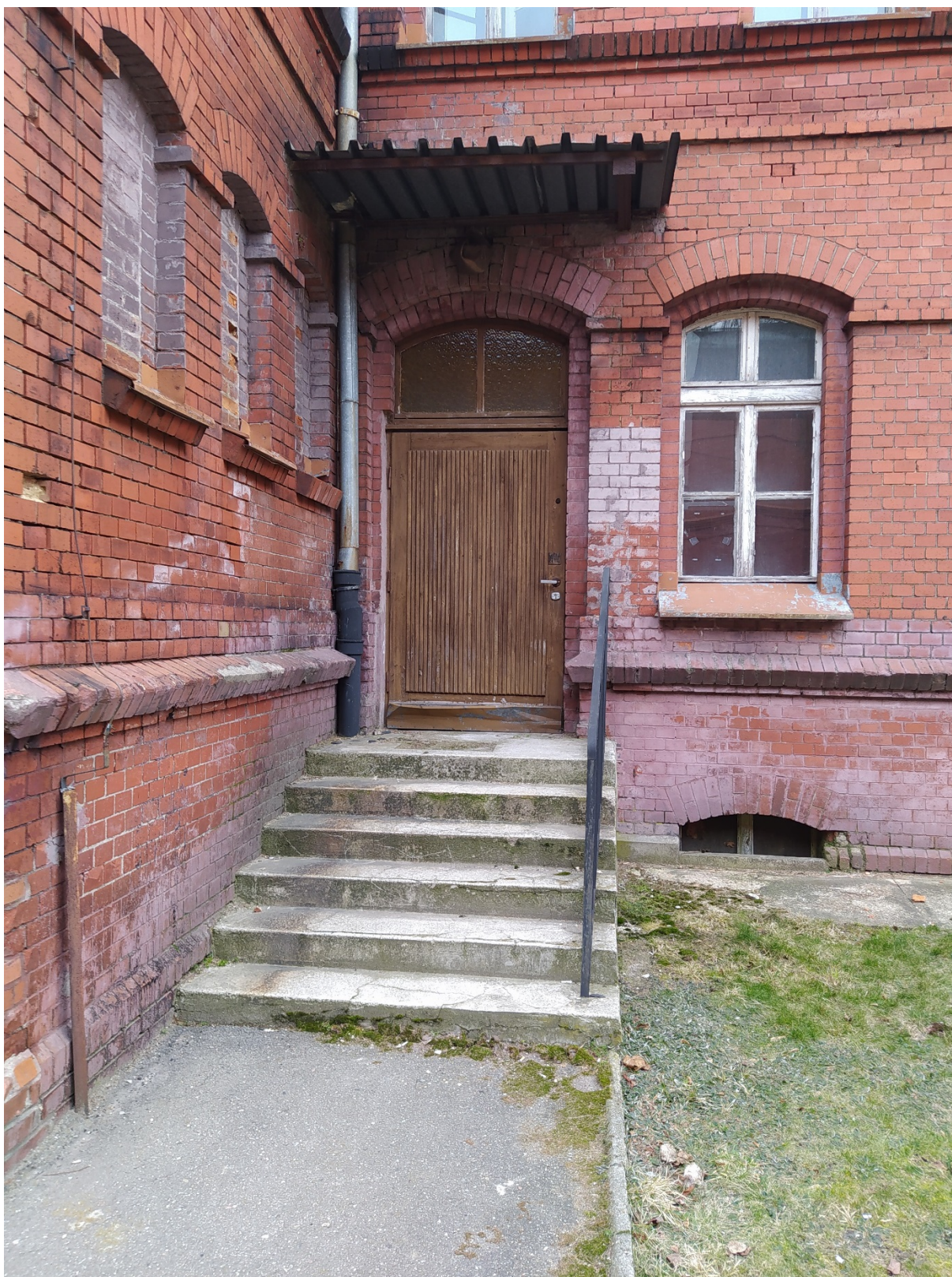
Widok ścian zewnętrznych budynku – wykwitły wapienne na ceglach, uszkodzenia cegieł, uszkodzenia schodów, uszkodzenia gzymsów.
