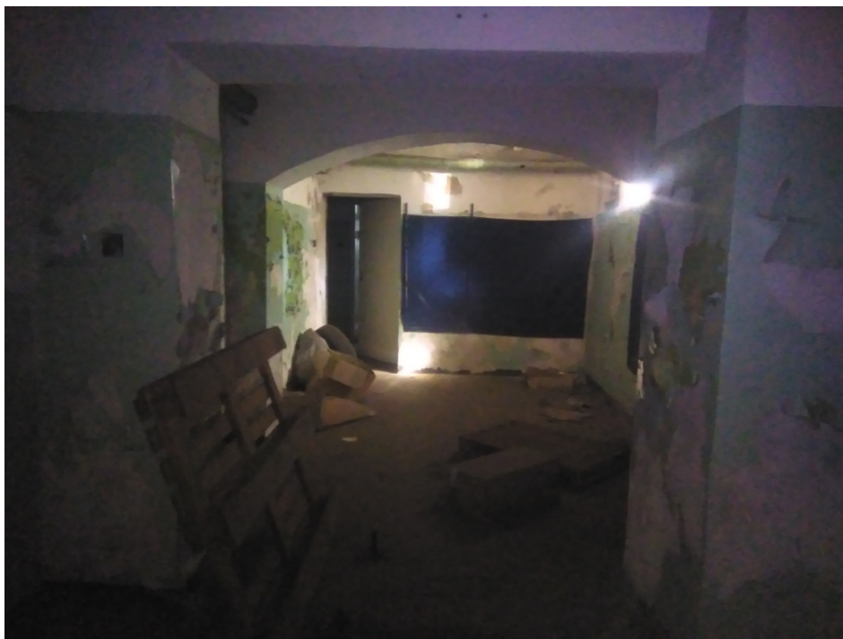
Widok ścian piwnicznych i ich zawilgocenie. [fotografia stan na 10.03.2022 r.]
