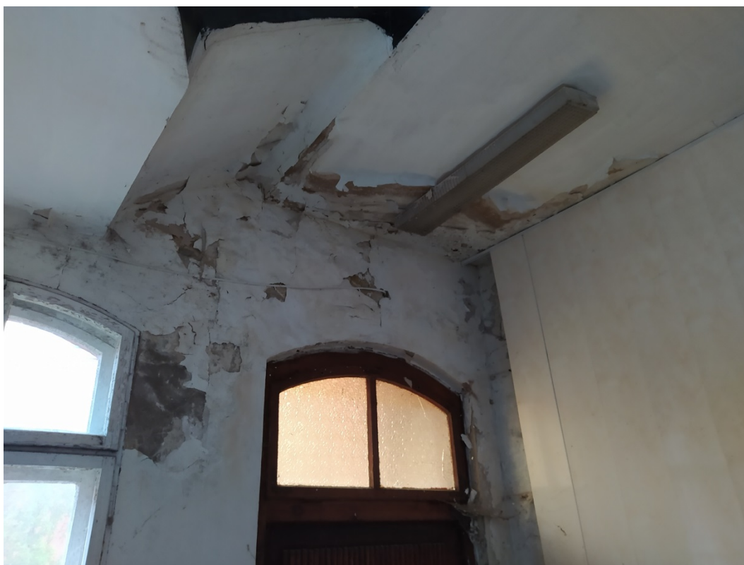
Widok zawilgoconych ścian parteru
