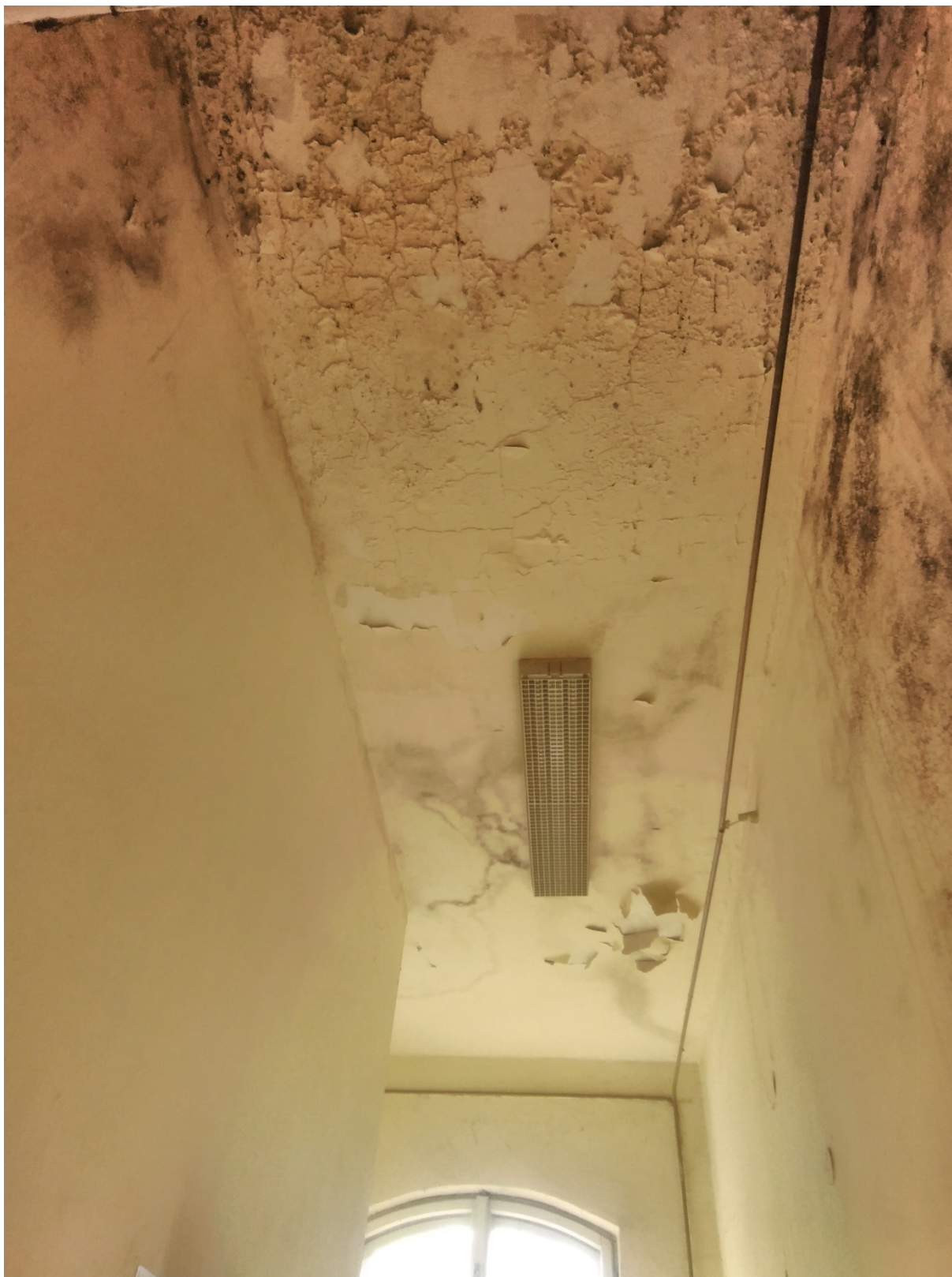
Widok zawilgoconego stropodachu. [fotografia stan na 10.03.2022 r.]
