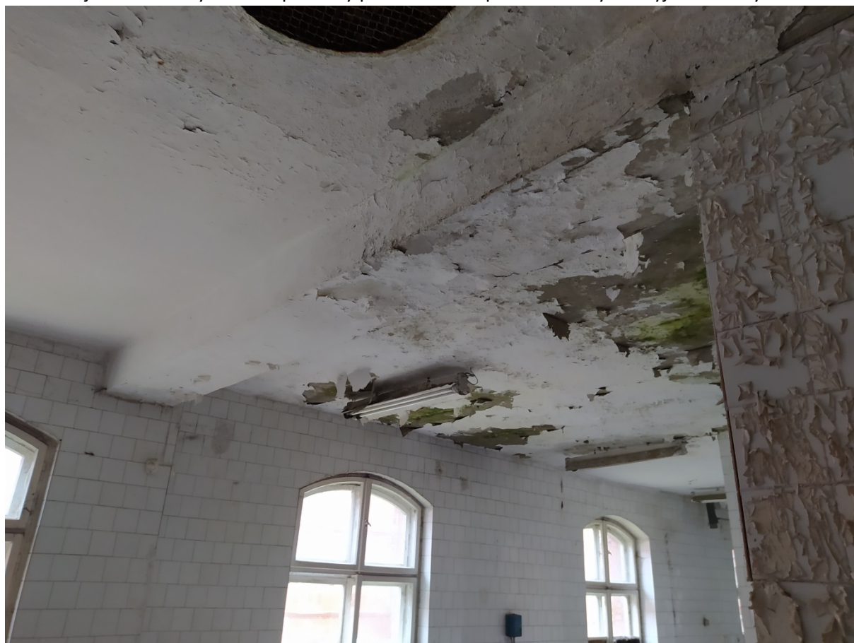
Widok zawilgoconego stropodachu. [fotografia stan na 10.03.2022 r.]
