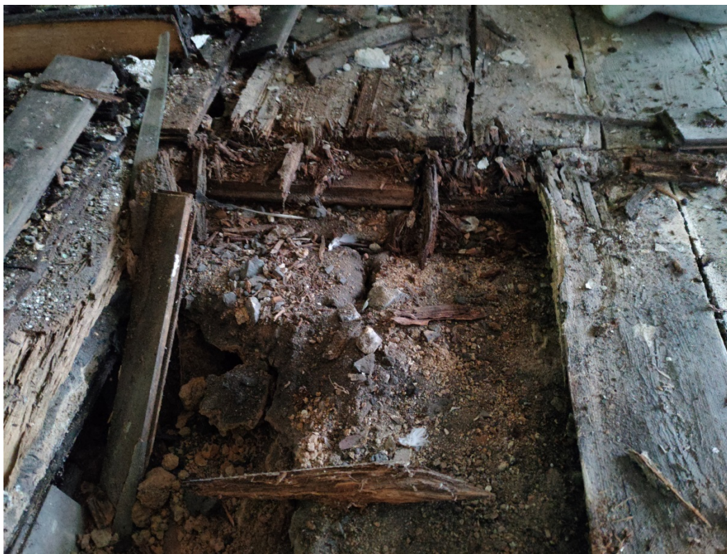
Widok belek stropowych drewnianych – całkowita korozja
