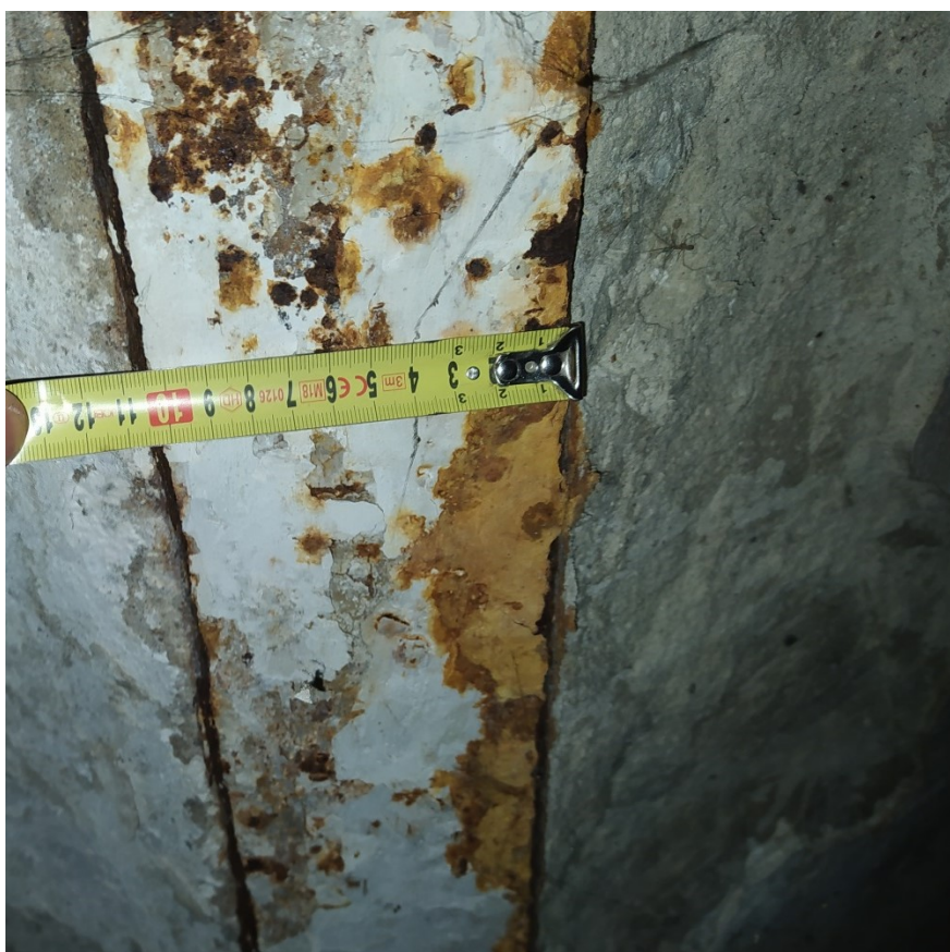
Stropy nad piwnicą – strop odcinkowy. Belki stalowe znacznie skorodowane
