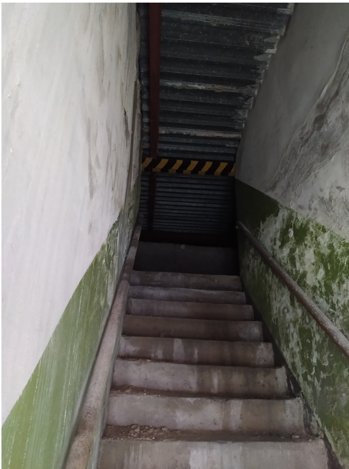
Widok konstrukcji dachu w części środkowej – znaczne zawilgocenia. [fotografia stan na 10.03.2022 r.]
