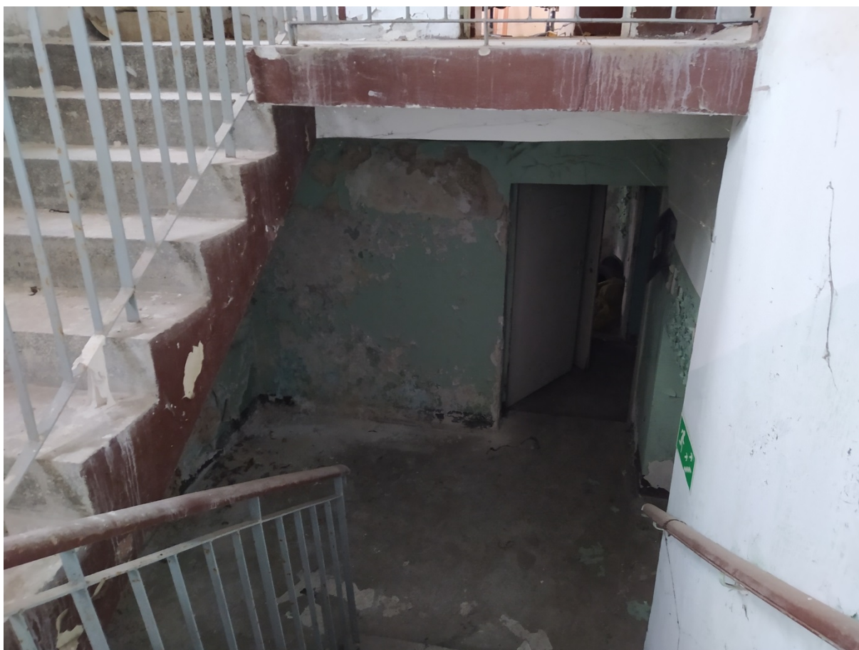
Widok zawilgoconych ścian w piwnicy
