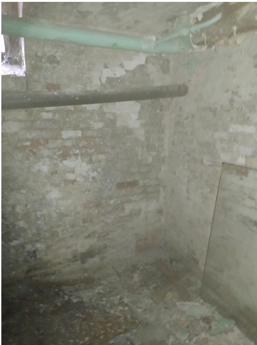
Widok ścian fundamentowych oraz piwnicznych i ich zawilgocenie.
