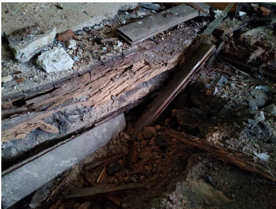
Widok belek stropowych drewnianych – całkowita koroza
