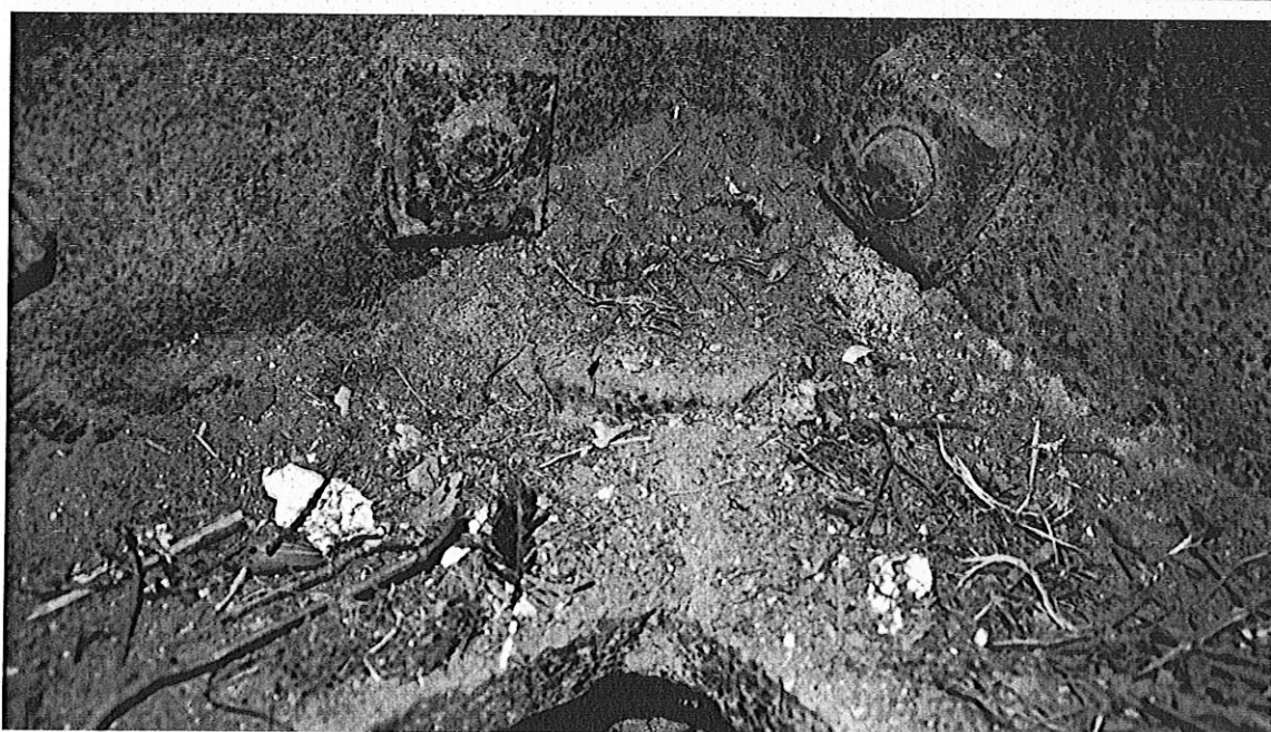
Fot. 13. Fot. 14. Pomnik Traktu Brzeskiego. Stosunkowo dobrze zachowane, mimo zanieczyszczeń organicznych, wewnątrz obelisku. Widoczne śrubowe połączenia elementów.
