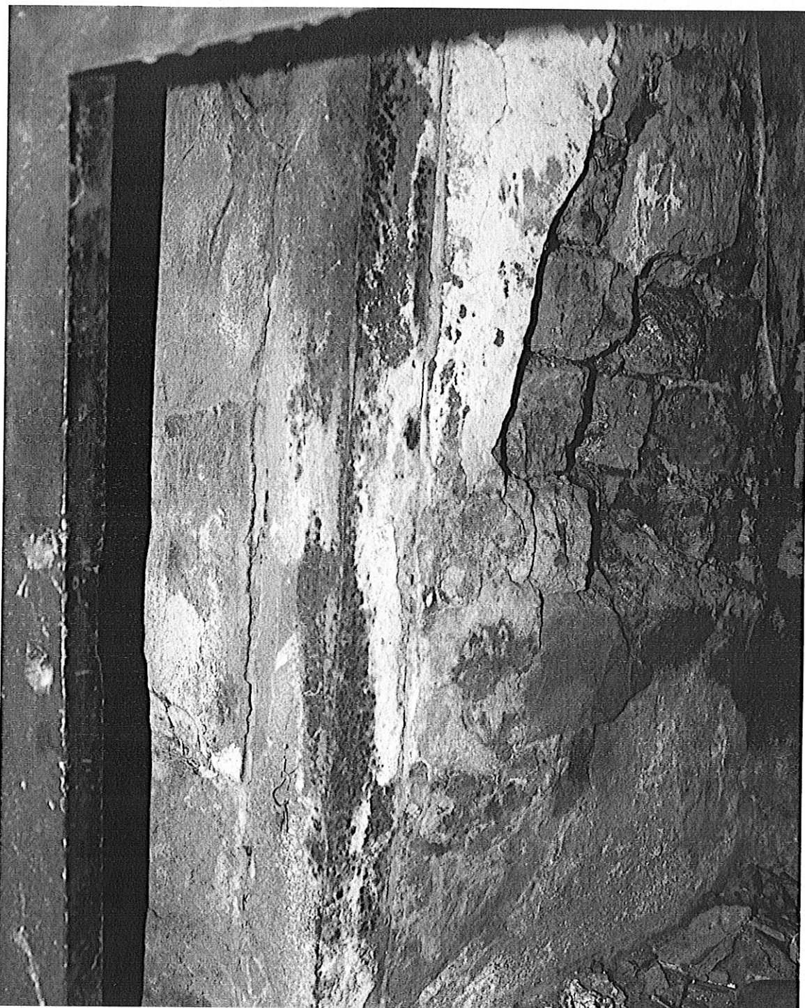
Fot. 15. Pomnik Traktu Brzeskiego. Uszkodzone przemurowania pomiędzy słupami konstrukcyjnymi i odpadające z nich tynki wewnątrz obelisku.
