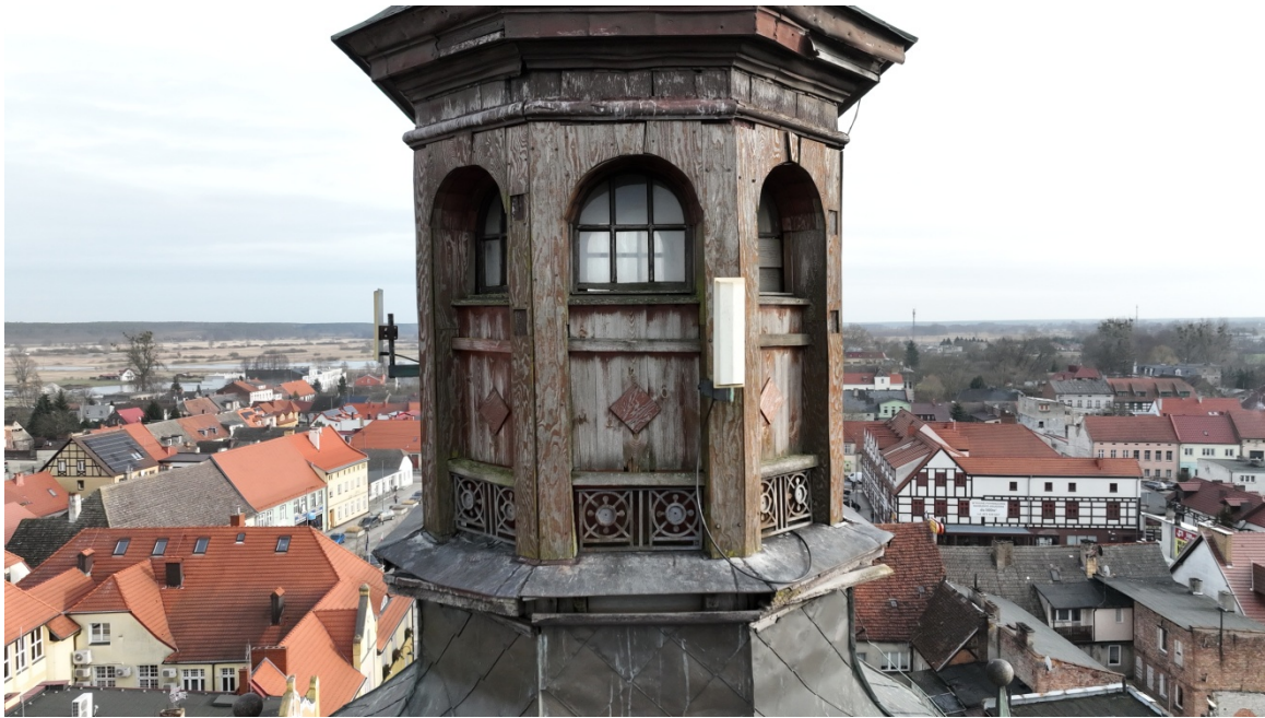
Fot. 11 Przekształcona latarnia, wtórnie przesłonięte otwory i filary. Widoczne odkształcenia drewnianych gzymsów, wymyte powłoki farby i porostanie mikroorganizmów.
