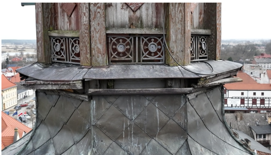
Fot. 12 Ażurowe metalowe dekoracje. Widoczny również ubytek profilowanego odcinka gzymsu oraz odkształcenia pozostałych.
