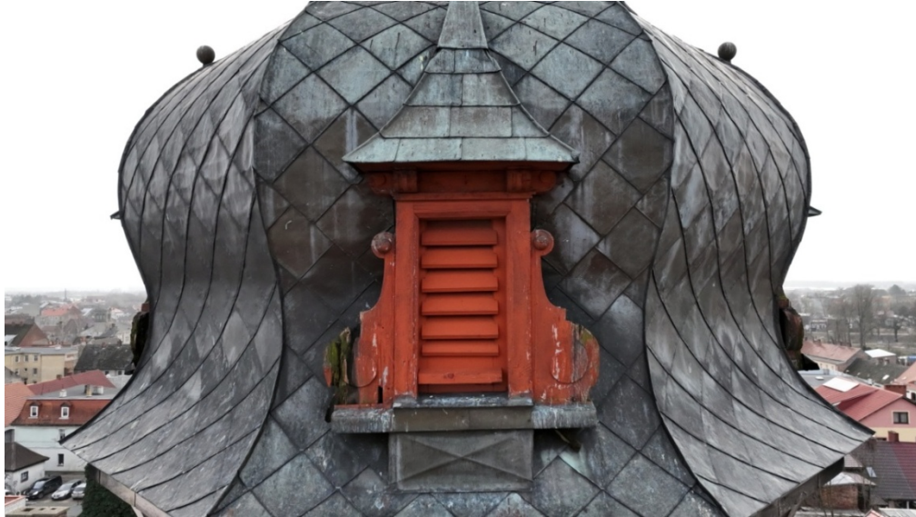
Fot. 10 Jedno z okienek helmu. Zachowane powłoki farby w części chronionej daszkiem. Widoczne uszkodzenia lewego uszaka, zerodowane drewno skażone mikrobiologicznie w partii woluty na którą zacieka woda opadowa.
