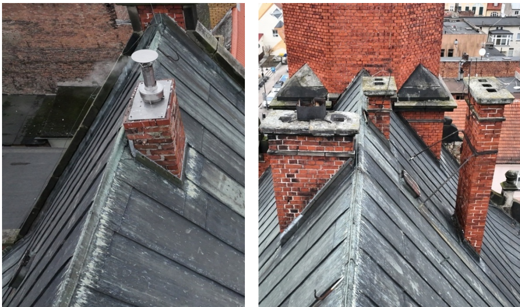
Fot. 6 Niewłaściwie wykonana obróbka blacharska na zwieńczeniu komina, woda opadowa spływa bezpośrednio w otwory wtórnych cegieł pustaków zawilgacając w ten sposób niższe partie cegieł komina. Fot. 7 Czapy pozostałych kominów zabezpieczają górne partie cegieł.
