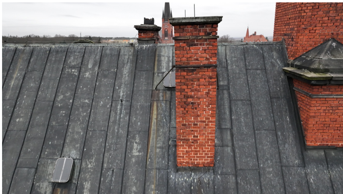
Fot. 5 Wysoki komin, widoczne ubytki spoinowania i delikatne wychylenie komina. Ponadto widoczne rdzawe zacieki na powierzchni pokrycia dachowego z blachy miedzianej — powstały na skutek zaciekania wraz z wodą opadową produktów korozji stalowej konstrukcji podtrzymującej komin.
