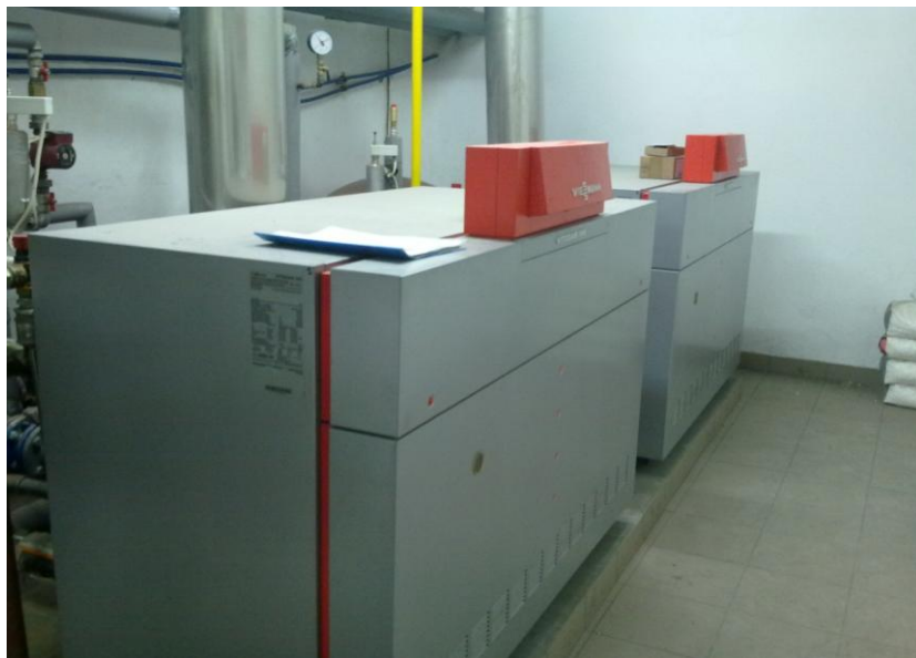
fot. nr 7: obecnie stosowane dwa kotły olejowe niskotemperaturowe Vitogas 100 GS 1 o mocy 144 kW każdy
