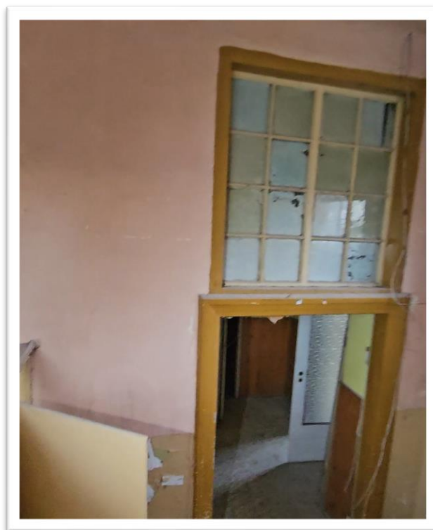
Fotografia 38 Stan istniejący (inwentaryzacja pom. 01 parter) – Korytarz – widok zniszczonych drzwi z naświetlem.
