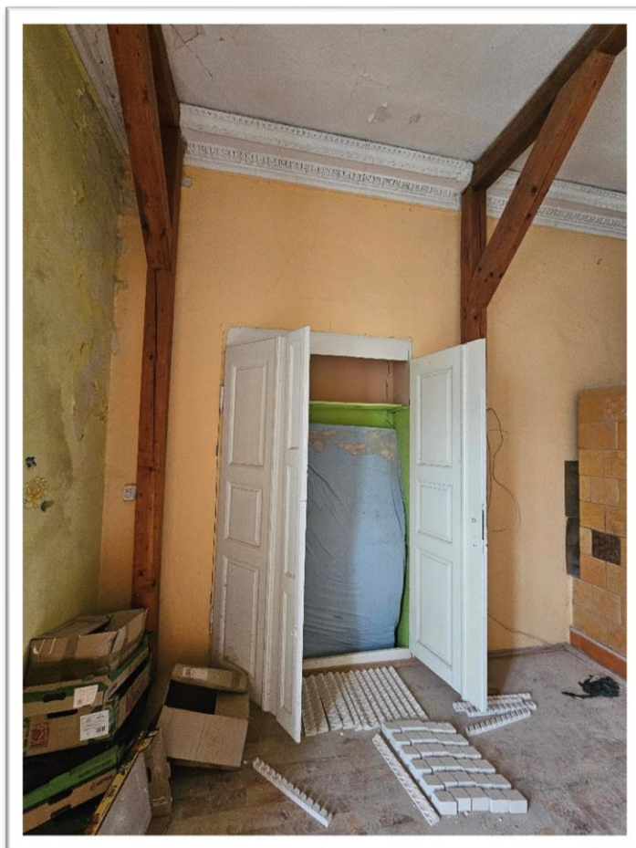
Fotografia 19 Stan istniejący (inventaryzacja pom. 06 parter) zachód – Biblioteka – podparcie stropu, detale, zamurowane drzwi.
