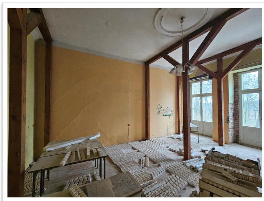
Fotografia 20 Stan istniejący (inventaryzacja pom. 06 parter) wschód – Biblioteka – podparcie stropu, detale.
