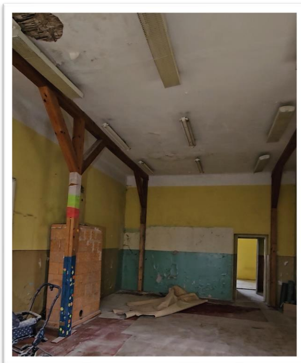
Fotografia 32 Stan istniejący (inwentaryzacja pom. 02 parter) południe – Sala spotkań – podparcie stropu
