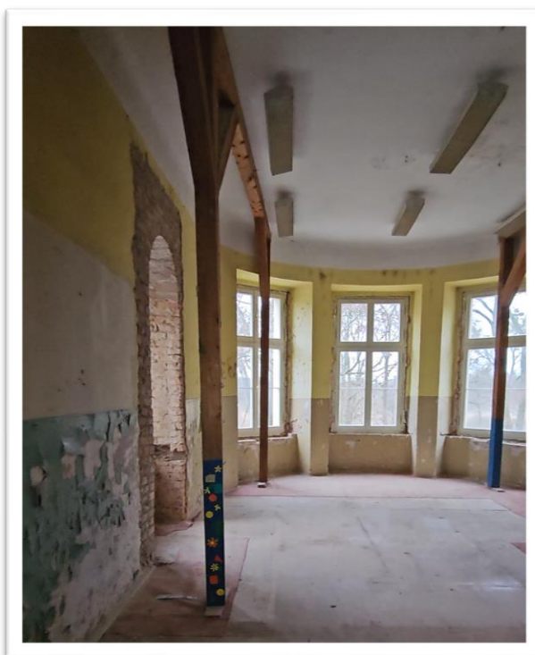
Fotografia 28 Stan istniejący (inventaryzacja pom. 02 parter) północ – Sala spotkań – podparcie stropu
