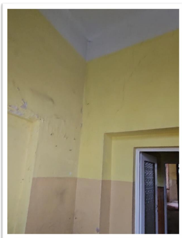
Fotografia 47 Stan istniejący (inventaryzacja pom. 21 parter) – Zaplecze socjalne – widok stanu po adaptacji pomieszczeń na przedszkole.
