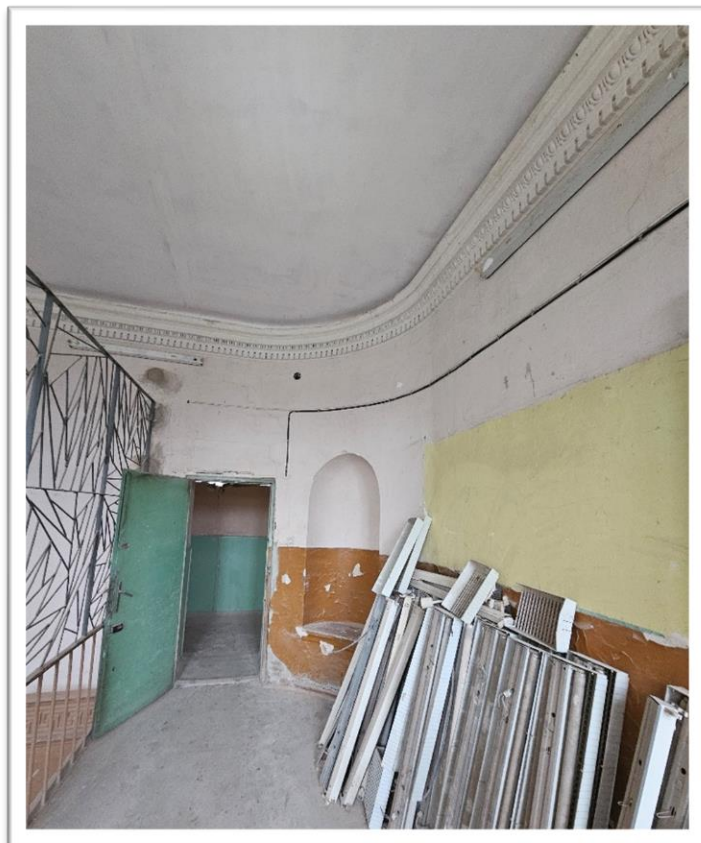
Fotografia 14 Stan istniejący – Hol ściana północno-zachodnia I piętro – trakt do likwidacji, detale, nisze.
