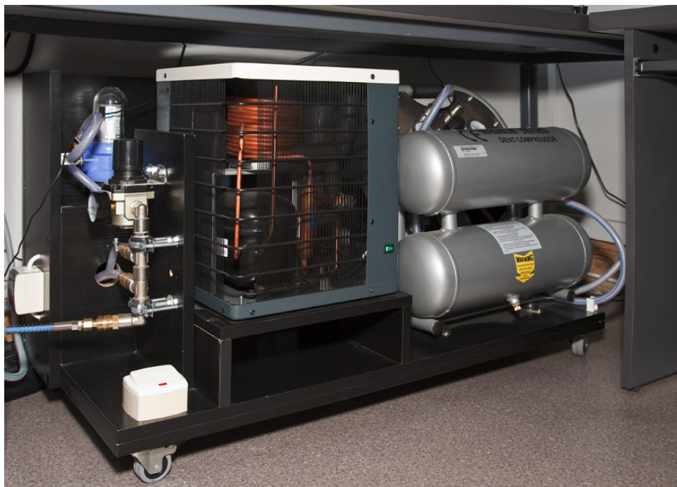
Ilustracja 2.6. Moduł kompresji i oczyszczania sprężonego powietrza. Na ruchomej platformie znajdują się: kompresor; osuszacz chłodniczy oraz manometr wyjściowy. Za osuszaczem umieszczony jest zespół filtrów. Pracownia digitalizacji Muzeum Historycznego Miasta Krakowa. Fot. W. Pyzik
