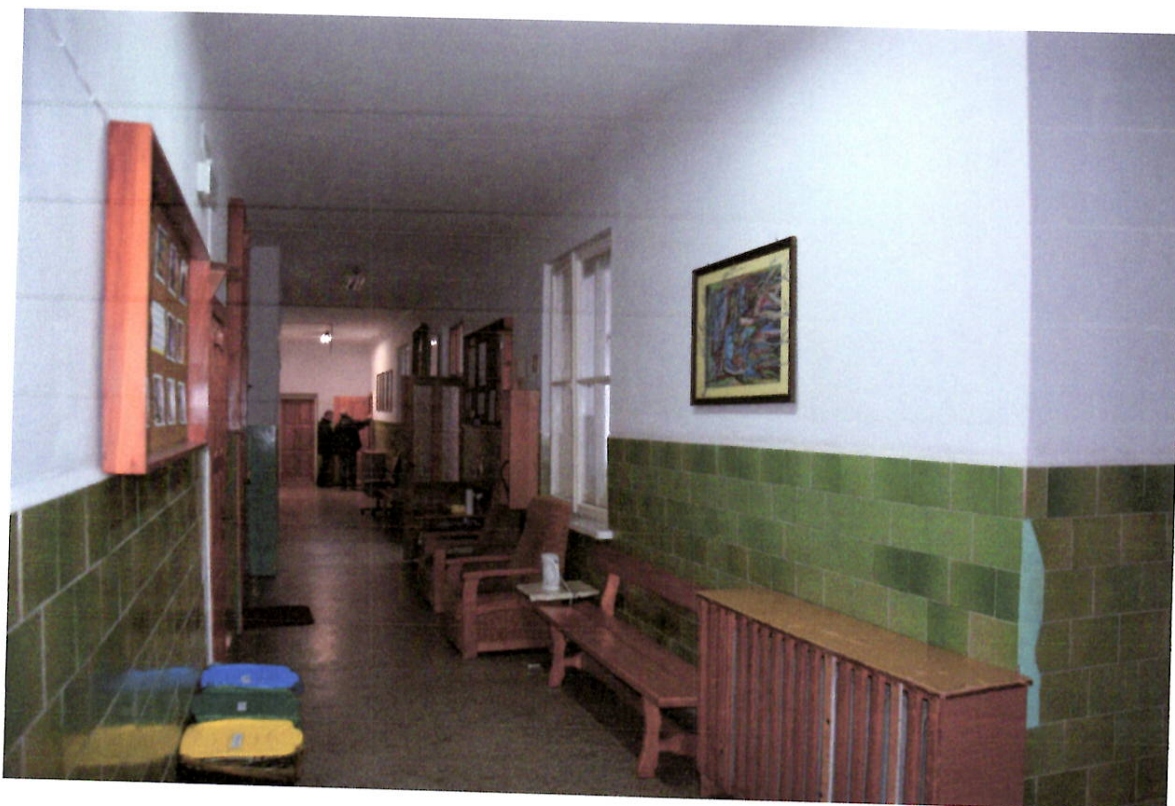
Fot.9. Budynek j.w. – korytarz na poziomie I piętra – po prawej widoczne okno wewnętrzne do przebudowy na wejście do windy.
