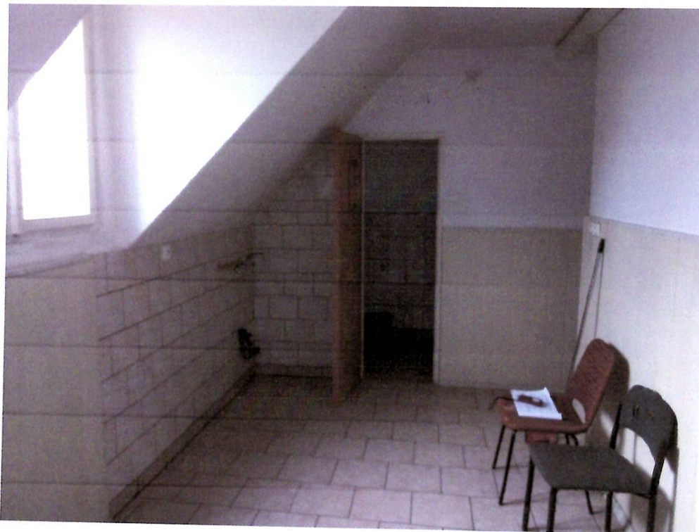
Fot. 13. Pomieszczenia użytkowe na II piętrze przeznaczone do przebudowy na węzeł sanitarny - stan istniejący.
