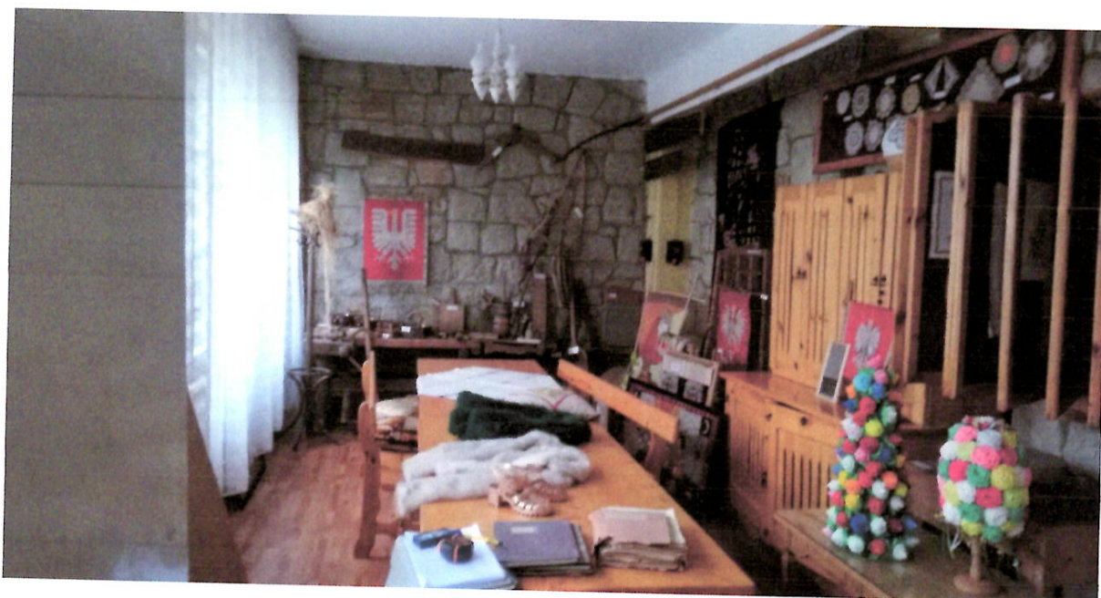
Fot.7. Pomieszczenie Izby Regionalnej na parterze, gdzie zostanie zlokalizowany wewnętrzny szyb windowy.
