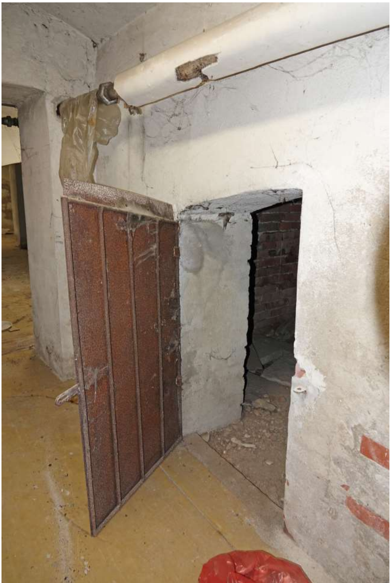
Fot. 66. Budynek nr 6a Szpitala Specjalistycznego im. dra J. Babińskiego SPZOZ w Krakowie. Wnętrze budynku. Stan przed konserwacją. Widoczny bardzo zły stan ścian w piwnicy. Fot. M. Domańska.
