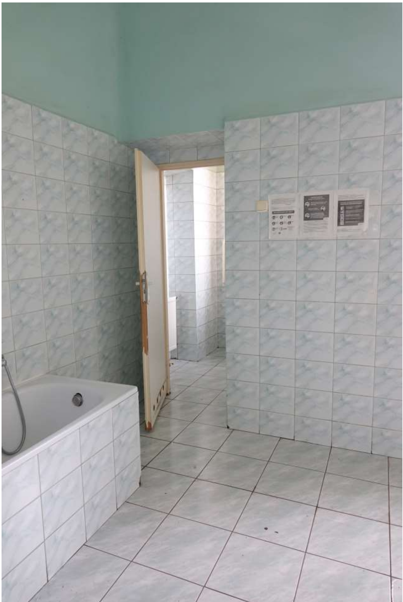
Fot. 148. Budynek nr 6a Szpitala Specjalistycznego im. dra J. Babińskiego SPZOZ w Krakowie. Wnętrze budynku Stan przed konserwacją. Widoczny obecny stan techniczno-estetyczny stolarki drzwiowej oraz tynków wewnętrznych.
