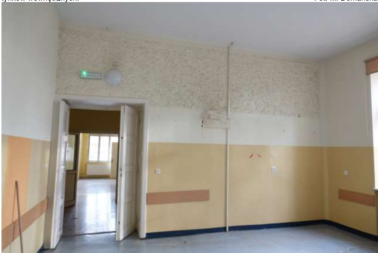
Fot. 53. Budynek nr 6a Szpitala Specjalistycznego im. dra J. Babińskiego SPZOZ w Krakowie. Wnętrze budynku Stan przed konserwacją. Widoczny obecny stan techniczno-estetyczny stolarki drzwiowej oraz tynków wewnętrznych. Fot. M. Domańska.
