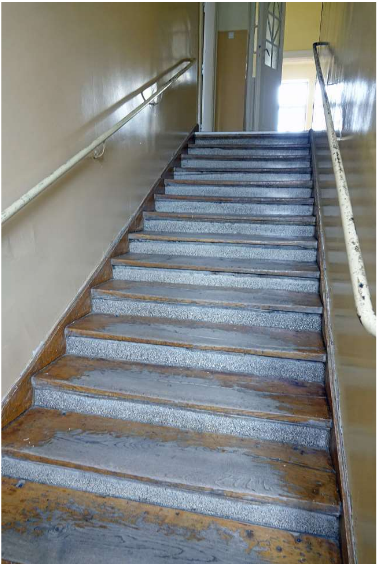
Fot. 37. Budynek nr 6a Szpitala Specjalistycznego im. dra J. Babińskiego SPZOZ w Krakowie. Wnętrze budynku. Stan przed konserwacją. Widoczne zniszczenia i przekształcenia schodów z lastryko. Fot. M. Domańska.
