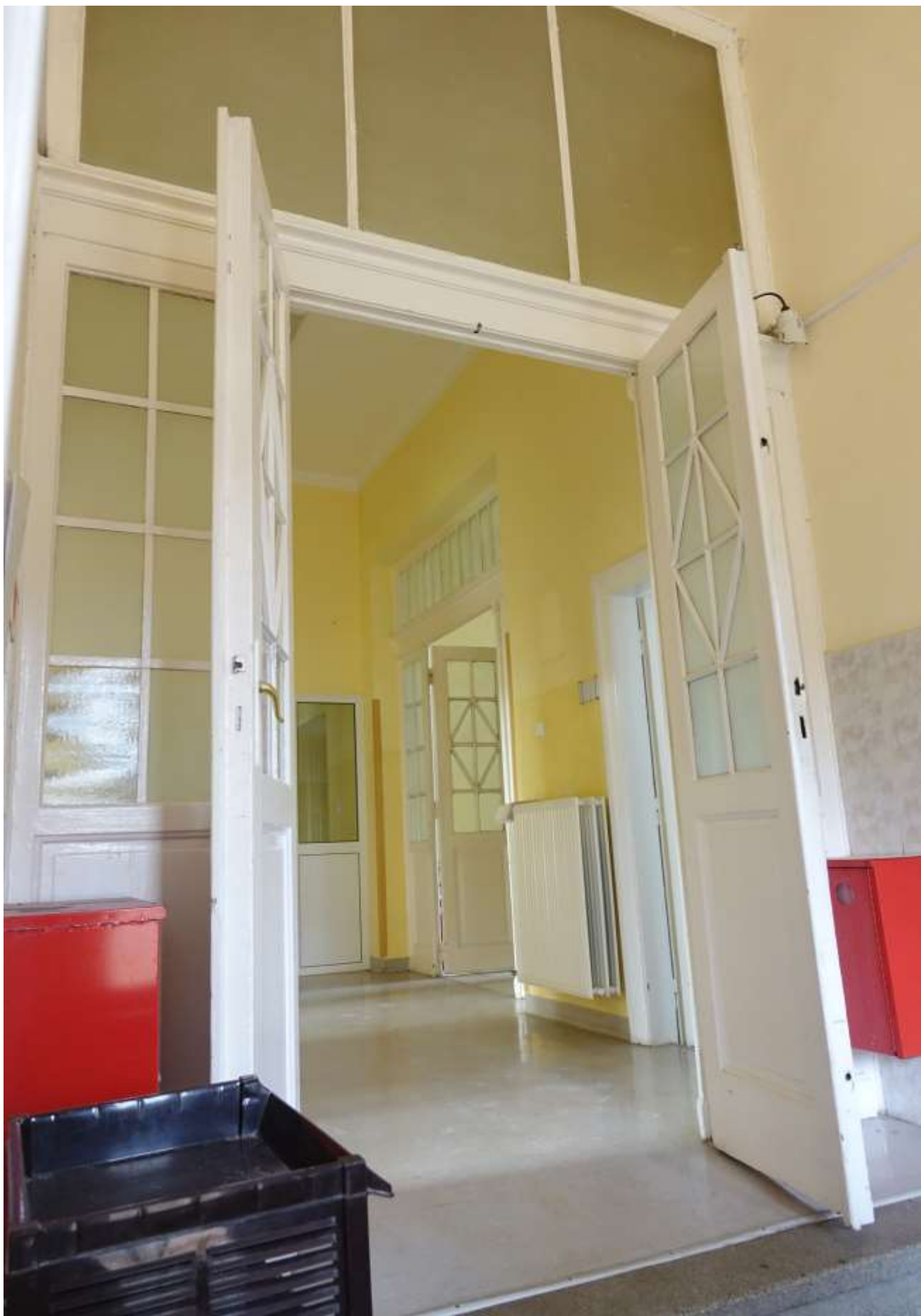
Fot. 42. Budynek nr 6a Szpitala Specjalistycznego im. dra J. Babińskiego SPZOZ w Krakowie. Wnętrze budynku Stan przed konserwacją. Widoczny obecny stan techniczno-estetyczny stolarki drzwiowej oraz tynków wewnętrznych. Fot. M. Domańska.
