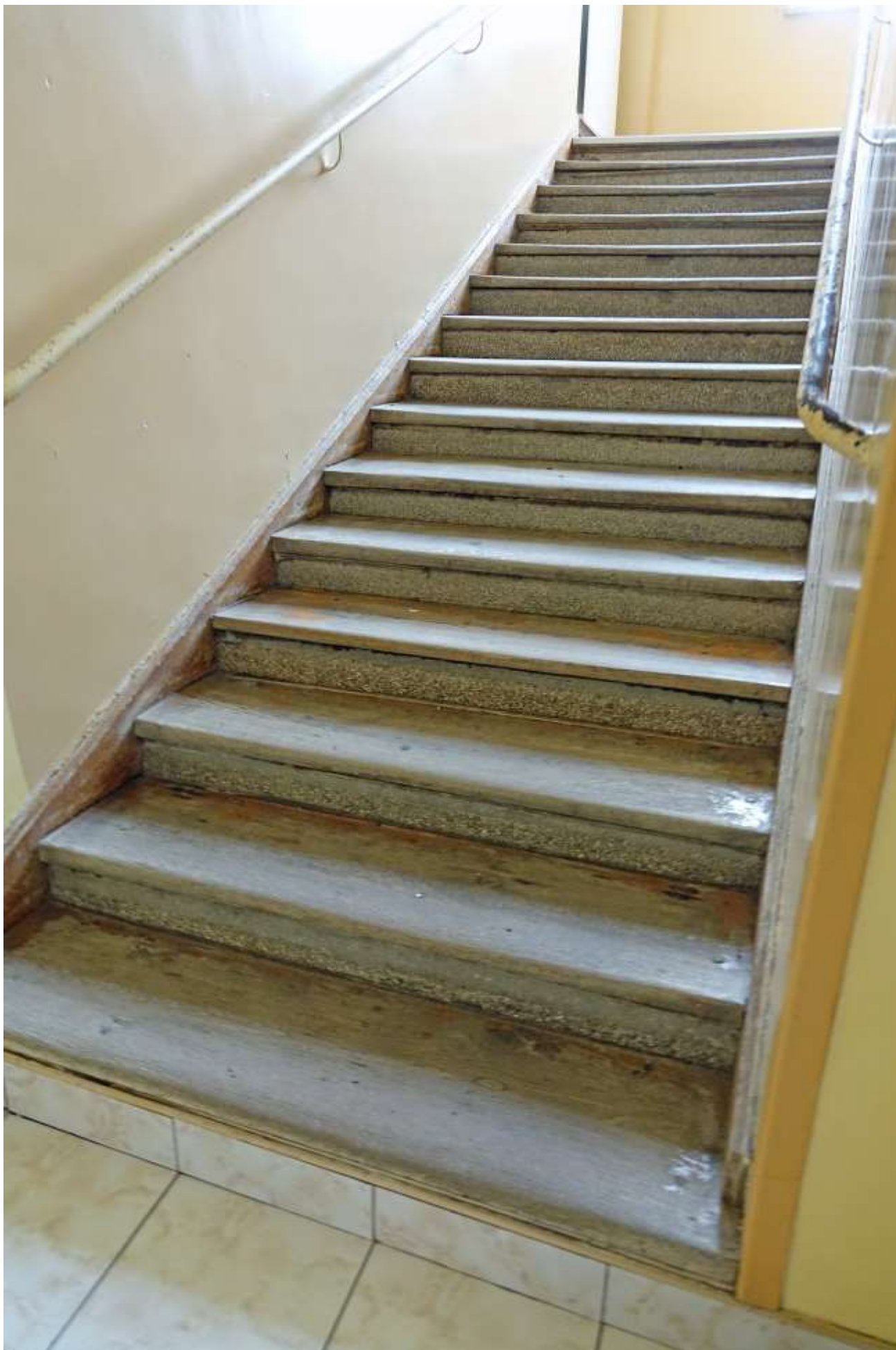
Fot. 38. Budynek nr 6a Szpitala Specjalistycznego im. dra J. Babińskiego SPZOZ w Krakowie. Wnętrze budynku. Stan przed konserwacją. Widoczne zniszczenia i przekształcenia schodów z lastryko. Fot. M. Domańska.
