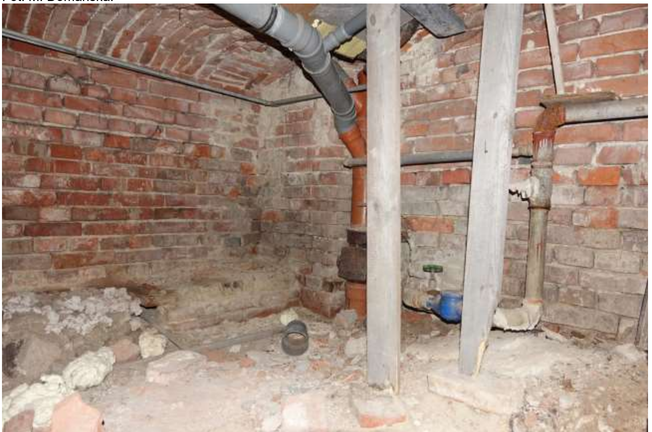
Fot. 65. Budynek nr 6a Szpitala Specjalistycznego im. dra J. Babińskiego SPZOZ w Krakowie. Wnętrze budynku. Stan przed konserwacją. Widoczny bardzo zły stan ścian w piwnicy. Fot. M. Domańska.
