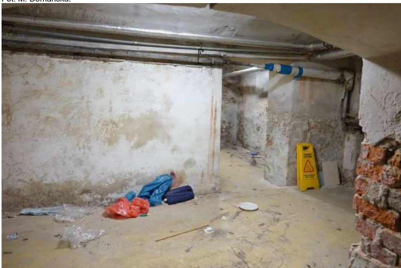
Fot. 63. Budynek nr 6a Szpitala Specjalistycznego im. dra J. Babińskiego SPZOZ w Krakowie. Wnętrze budynku. Stan przed konserwacją. Widoczny bardzo zły stan tynków w piwnicy. Fot. M. Domańska.
