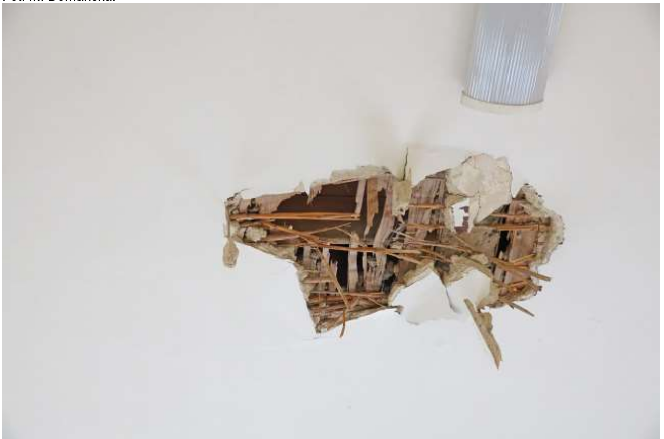
Fot. 29. Budynek nr 6a Szpitala Specjalistycznego im. dra J. Babińskiego SPZOZ w Krakowie. Strop pod częścią piętra. Stan przed konserwacją. Widoczny stan techniczny konstrukcji stropu. Fot. M. Domańska.
