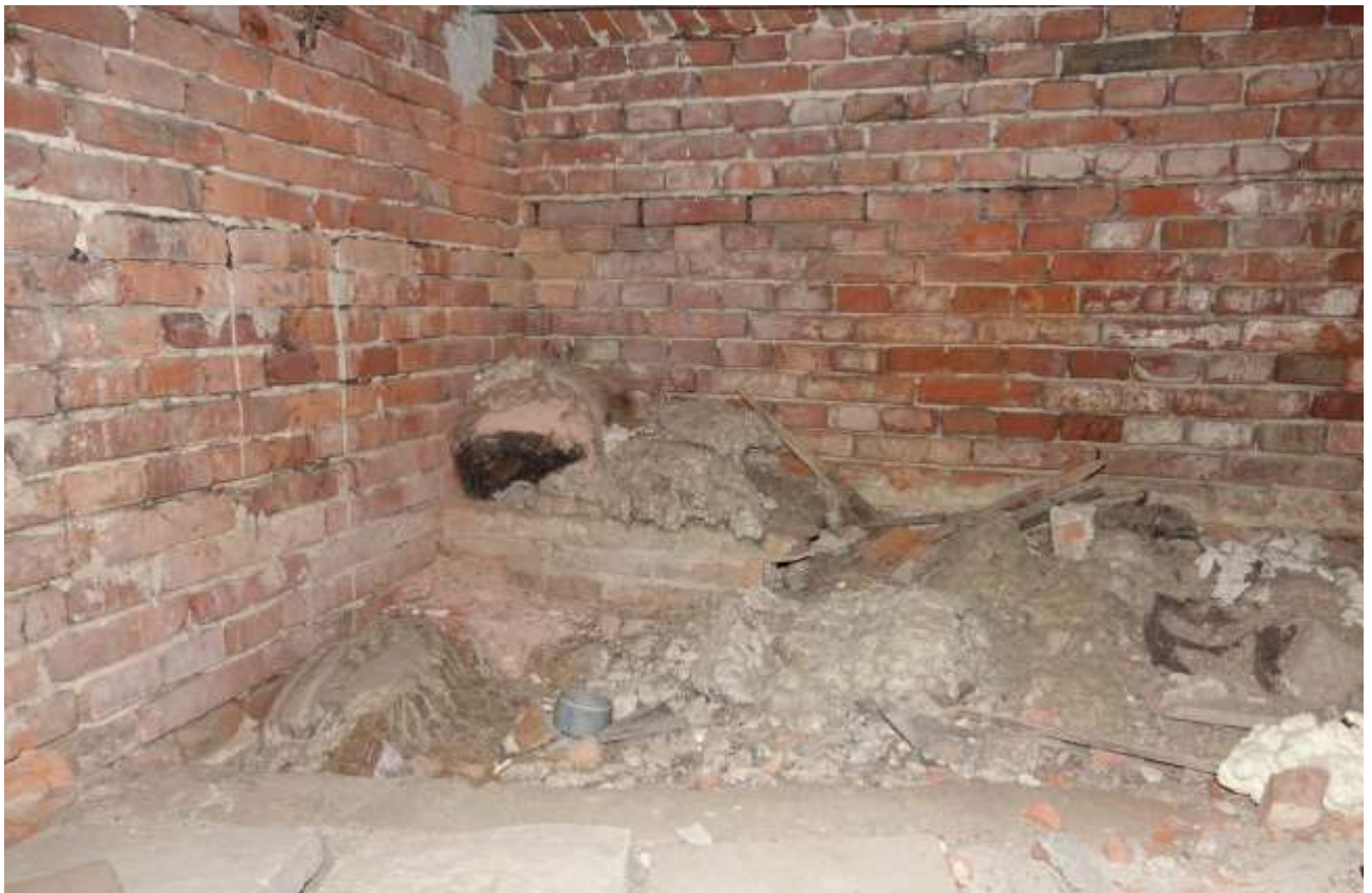
Fot. 64. Budynek nr 6a Szpitala Specjalistycznego im. dra J. Babińskiego SPZOZ w Krakowie. Wnętrze budynku. Stan przed konserwacją. Widoczny bardzo zły stan ścian w piwnicy. Fot. M. Domańska.
