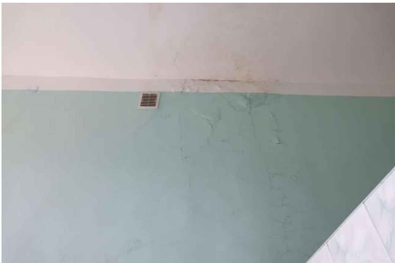
Fot. 49. Budynek nr 6a Szpitala Specjalistycznego im. dra J. Babińskiego SPZOZ w Krakowie. Wnętrze budynku Stan przed konserwacją. Widoczny obecny stan techniczno-estetyczny stolarki drzwiowej oraz tynków wewnętrznych. Fot. M. Domańska.
