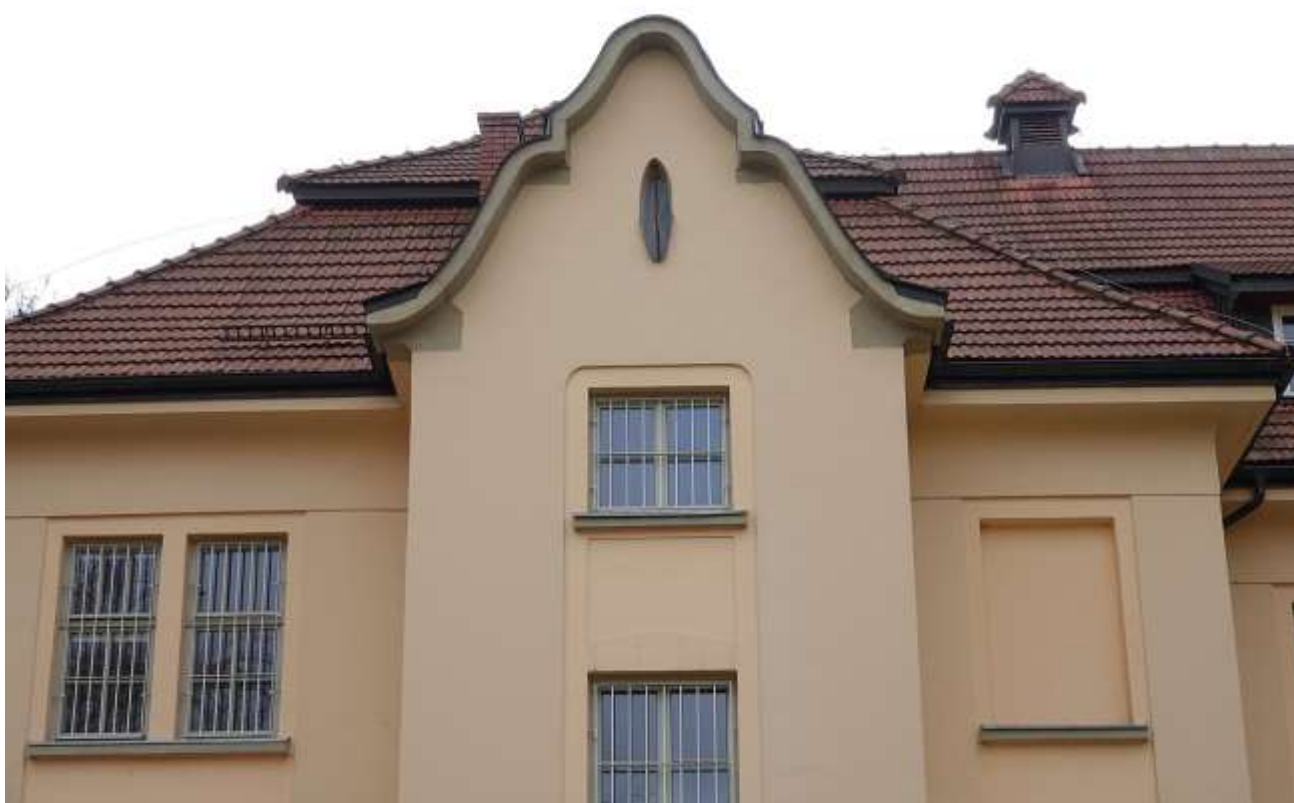
Fot. 11. Budynek nr 6a Szpitala Specjalistycznego im. dra J. Babińskiego SPZOZ w Krakowie. Elewacja płn. Stan przed konserwacją. Widoczny obecny stan techniczno-estetyczny budynku. Fot. M. Domańska.
