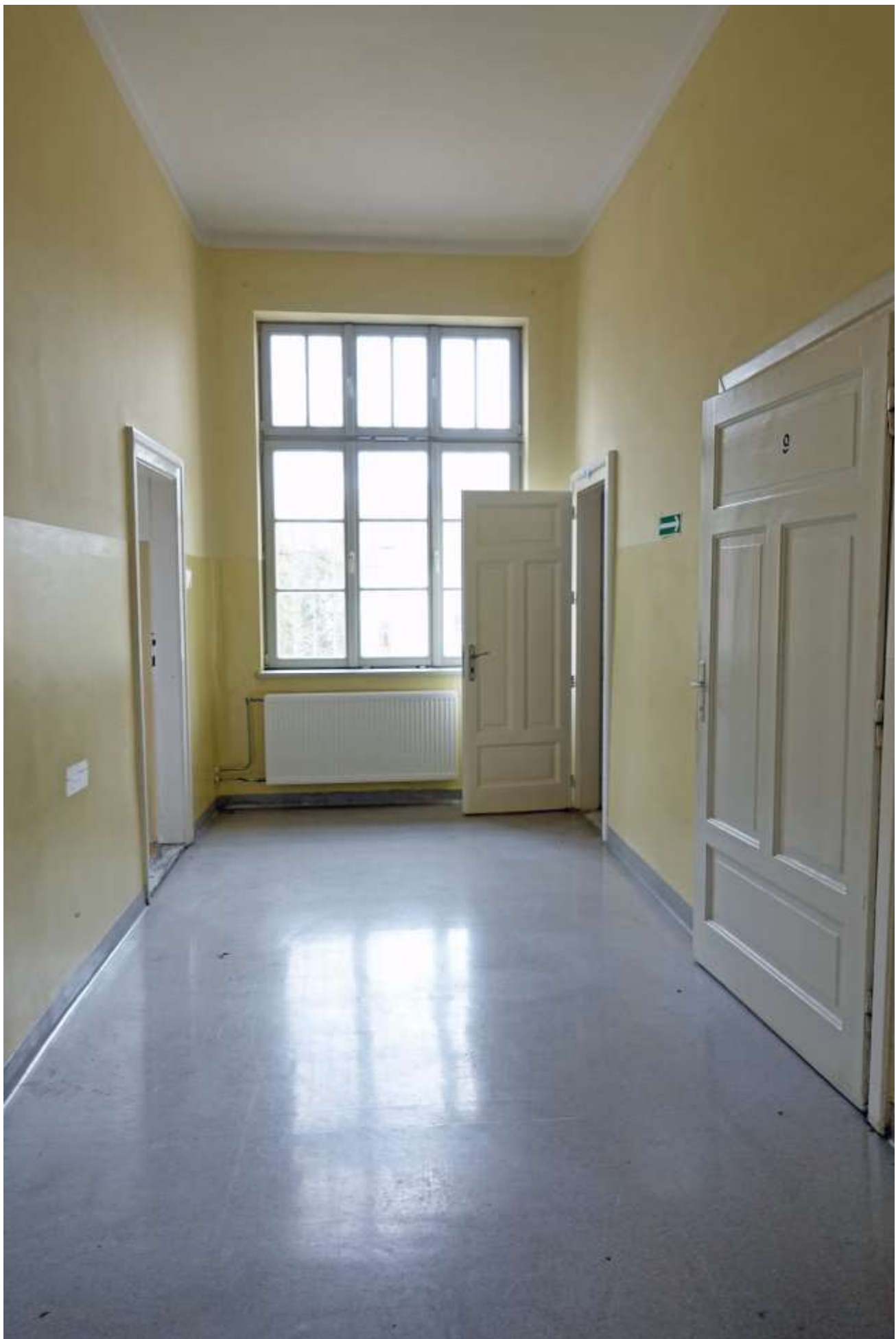
Fot. 51. Budynek nr 6a Szpitala Specjalistycznego im. dra J. Babińskiego SPZOZ w Krakowie. Wnętrze budynku Stan przed konserwacją. Widoczny obecny stan techniczno-estetyczny stolarki drzwiowej oraz tynków wewnętrznych.
