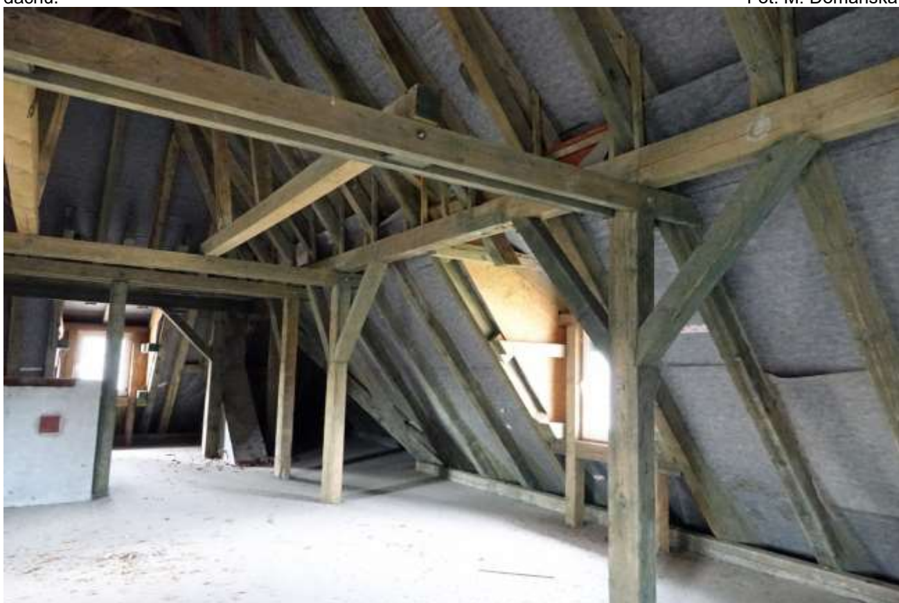
Fot. 25. Budynek nr 6a Szpitala Specjalistycznego im. dra J. Babińskiego SPZOZ w Krakowie. Poddasze. Stan przed konserwacją. Widoczny stan techniczny konstrukcji dachowej oraz brak izolacji termicznej połaci dachu. Fot. M. Domańska.
