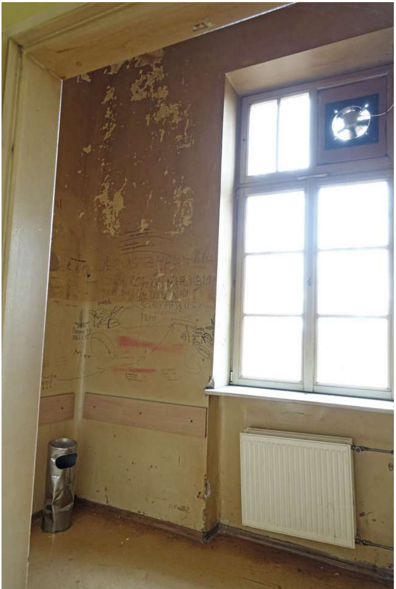
Fot. 46. Budynek nr 6a Szpitala Specjalistycznego im. dra J. Babińskiego SPZOZ w Krakowie. Wnętrze budynku Stan przed konserwacją. Widoczny obecny stan techniczno-estetyczny stolarki drzwiowej oraz tynków wewnętrznych.
