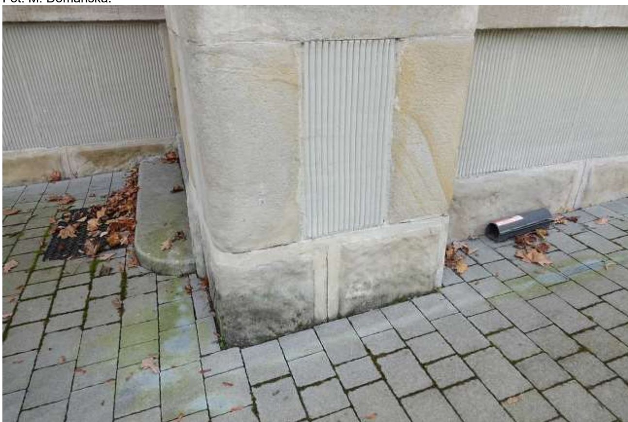
Fot. 23. Budynek nr 6a Szpitala Specjalistycznego im. dra J. Babińskiego SPZOZ w Krakowie. Elewacja wsch. Stan przed konserwacją. Widoczny obecny stan techniczno-estetyczny budynku. Fot. M. Domańska.
