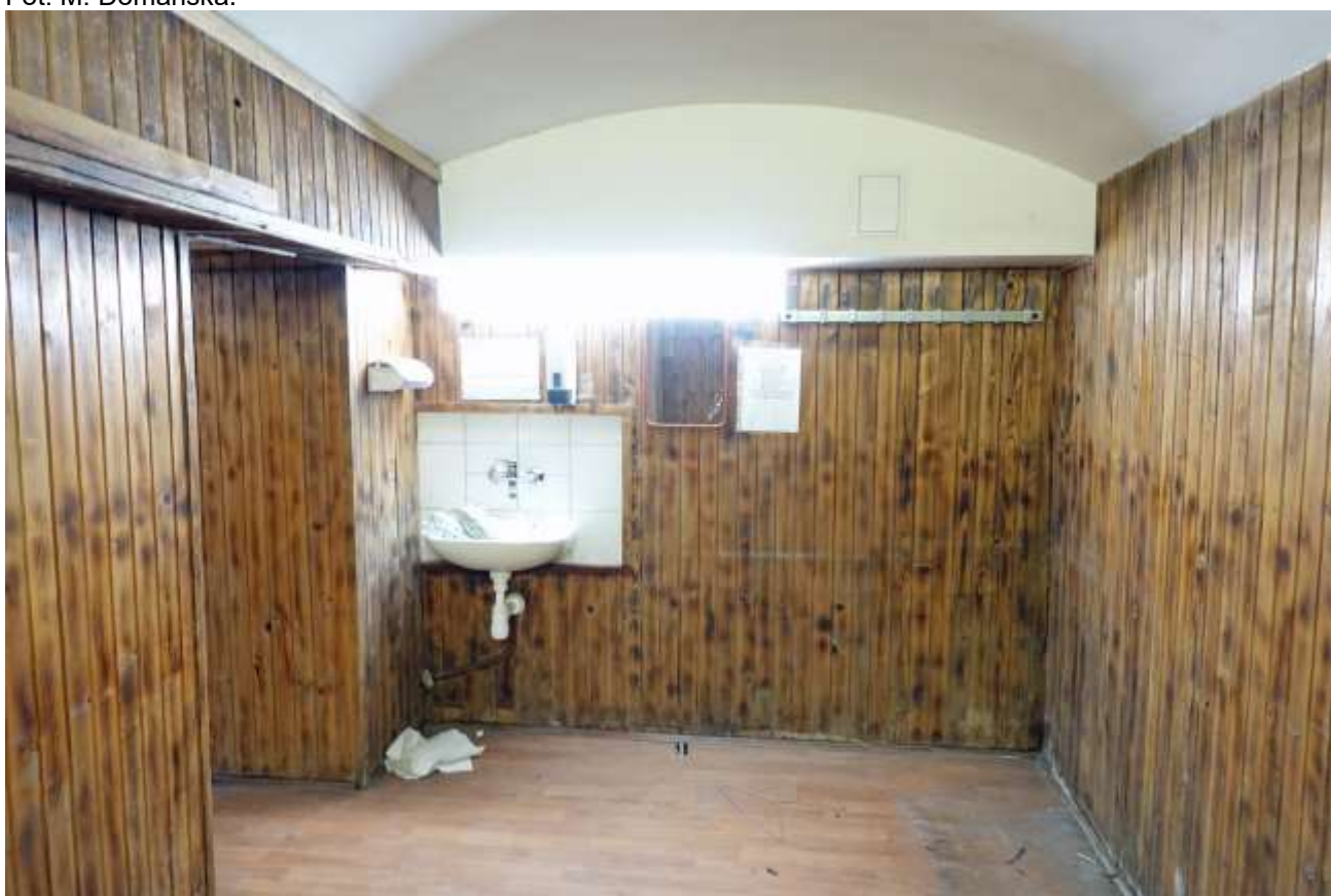
Fot. 68. Budynek nr 6a Szpitala Specjalistycznego im. dra J. Babińskiego SPZOZ w Krakowie. Wnętrze budynku. Stan przed konserwacją. Widoczny bardzo zły stan ścian w piwnicy. Fot. M. Domańska.
