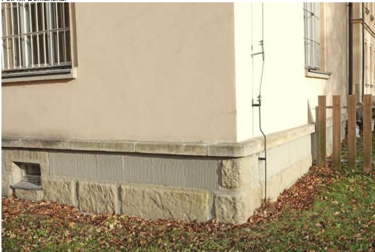
Fot. 17. Budynek nr 6a Szpitala Specjalistycznego im. dra J. Babińskiego SPZOZ w Krakowie. Elewacje płd. i wsch. Stan przed konserwacją. Widoczny obecny stan techniczno-estetyczny budynku. Fot. M. Domańska.
