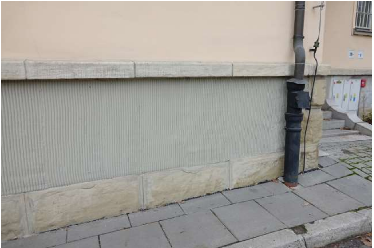
Fot. 6. Budynek nr 6a Szpitala Specjalistycznego im. dra J. Babińskiego SPZOZ w Krakowie. Elewacja wsch. Stan przed konserwacją. Widoczny obecny stan techniczno-estetyczny budynku. Fot. M. Domańska.
