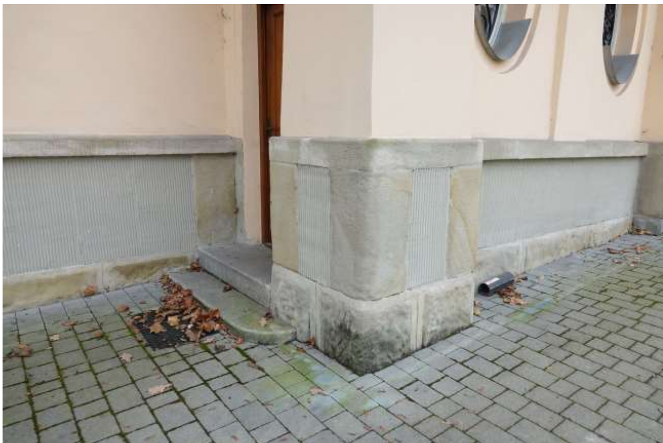
Fot. 8. Budynek nr 6a Szpitala Specjalistycznego im. dra J. Babińskiego SPZOZ w Krakowie. Elewacja płn. Stan przed konserwacją. Widoczny obecny stan techniczno-estetyczny budynku. Fot. M. Domańska.
