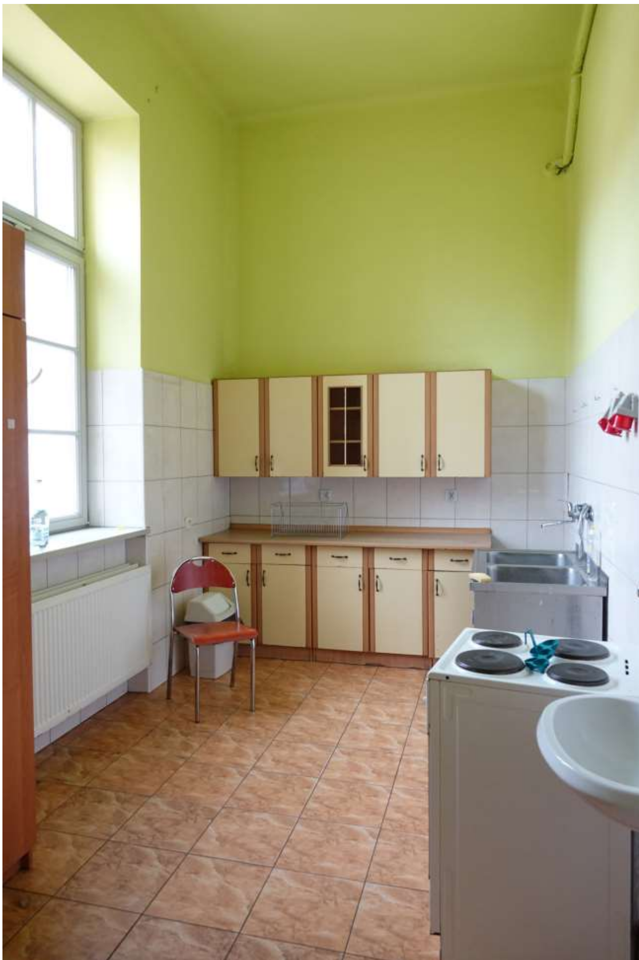
Fot. 45. Budynek nr 6a Szpitala Specjalistycznego im. dra J. Babińskiego SPZOZ w Krakowie. Wnętrze budynku Stan przed konserwacją. Widoczny obecny stan techniczno-estetyczny stolarki drzwiowej oraz tynków wewnętrznych.
