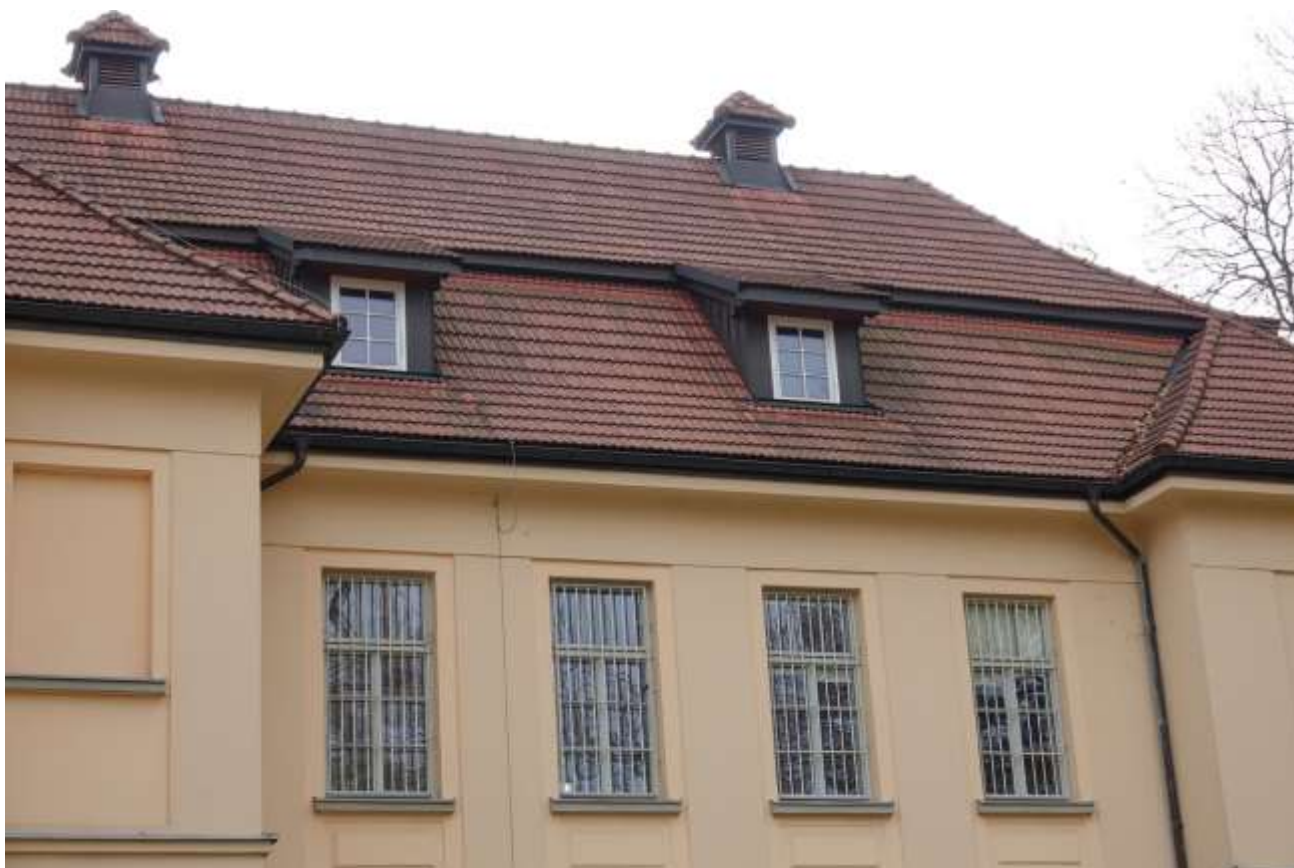
Fot. 10. Budynek nr 6a Szpitala Specjalistycznego im. dra J. Babińskiego SPZOZ w Krakowie. Elewacja płn. Stan przed konserwacją. Widoczny obecny stan techniczno-estetyczny budynku. Fot. M. Domańska.
