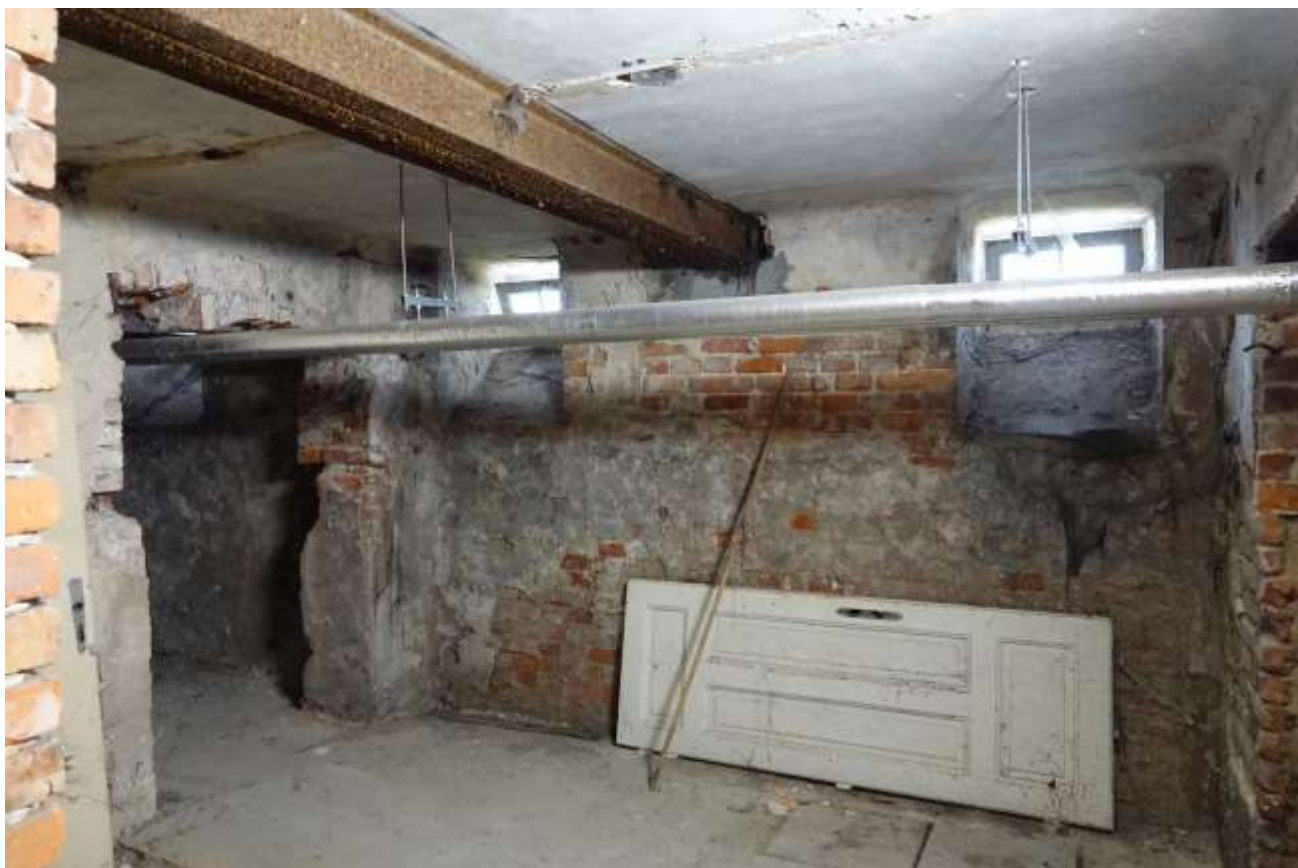
Fot. 57. Budynek nr 6a Szpitala Specjalistycznego im. dra J. Babińskiego SPZOZ w Krakowie. Wnętrze budynku. Stan przed konserwacją. Widoczny bardzo zły stan tynków w piwnicy. Fot. M. Domańska.
