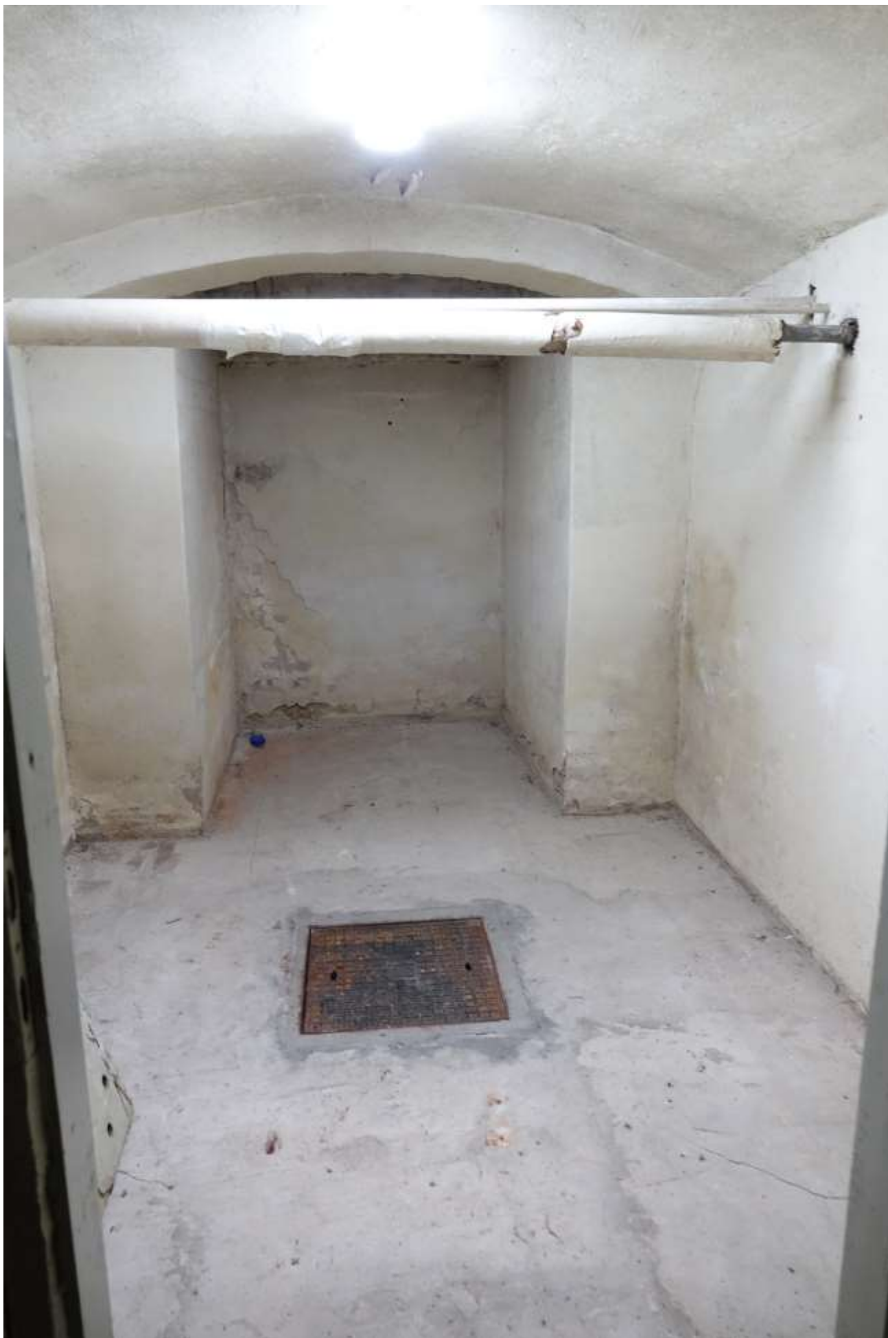
Fot. 54. Budynek nr 6a Szpitala Specjalistycznego im. dra J. Babińskiego SPZOZ w Krakowie. Wnętrze budynku. Stan przed konserwacją. Widoczny bardzo zły stan tynków w piwnicy. Fot. M. Domańska.
