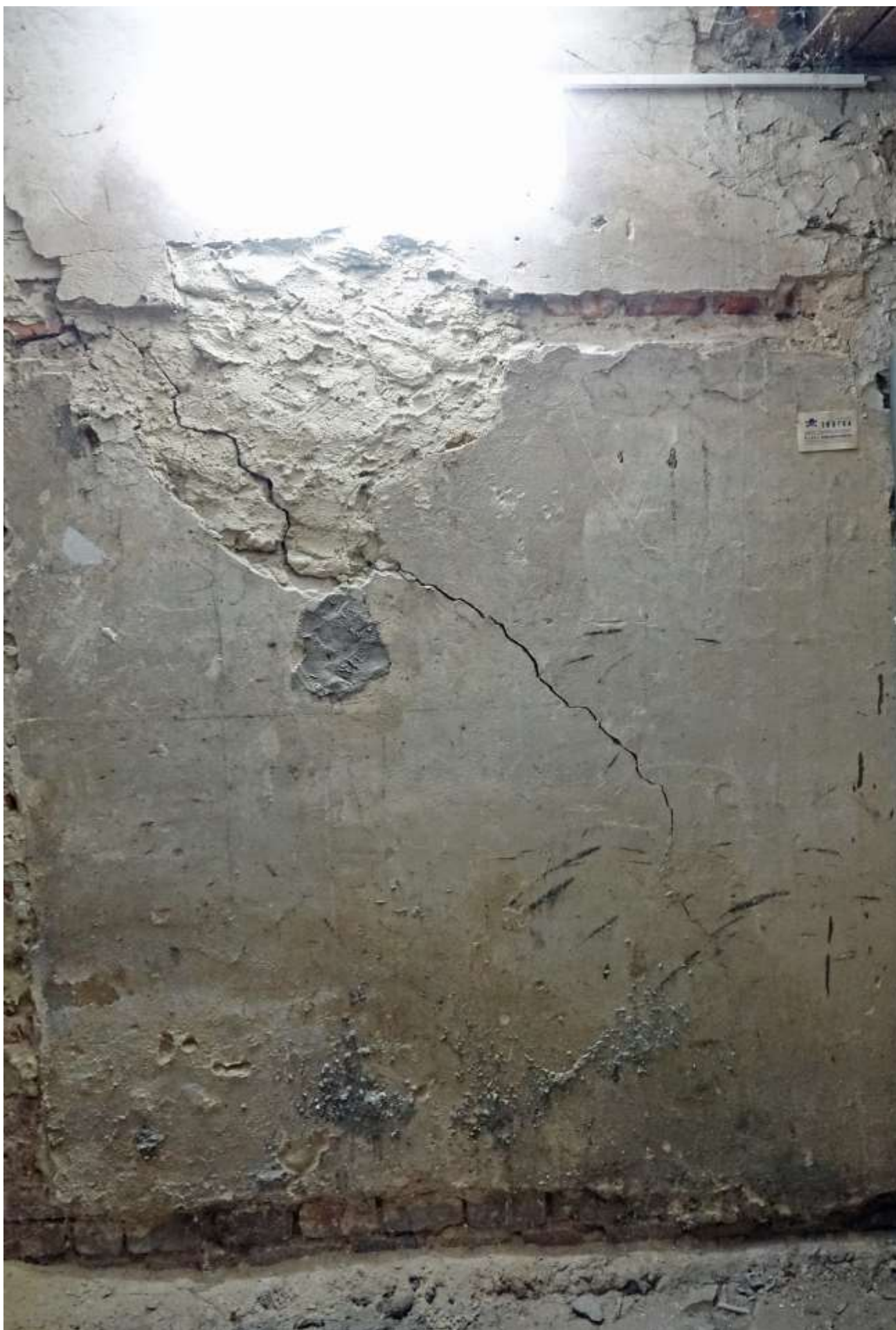
Fot. 61. Budynek nr 6a Szpitala Specjalistycznego im. dra J. Babińskiego SPZOZ w Krakowie. Wnętrze budynku. Stan przed konserwacją. Widoczny bardzo zły stan tynków w piwnicy. Fot. M. Domańska.
