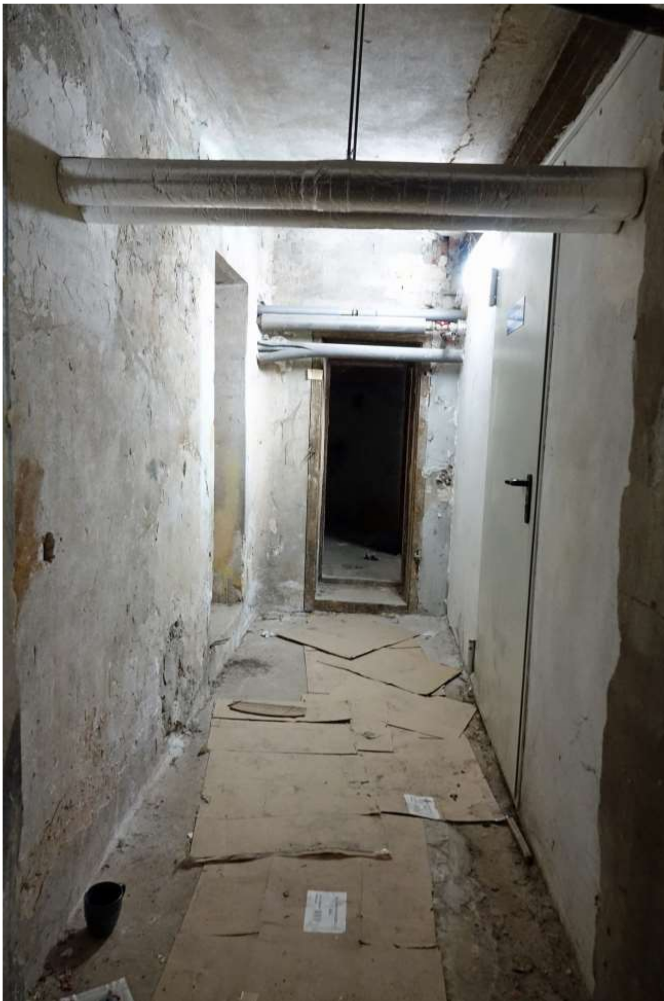
Fot. 55. Budynek nr 6a Szpitala Specjalistycznego im. dra J. Babińskiego SPZOZ w Krakowie. Wnętrze budynku. Stan przed konserwacją. Widoczny bardzo zły stan tynków w piwnicy. Fot. M. Domańska.
