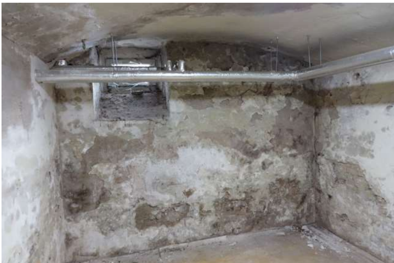
Fot. 62. Budynek nr 6a Szpitala Specjalistycznego im. dra J. Babińskiego SPZOZ w Krakowie. Wnętrze budynku. Stan przed konserwacją. Widoczny bardzo zły stan tynków w piwnicy. Fot. M. Domańska.
