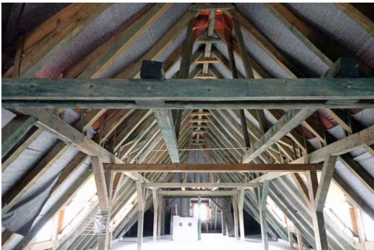
Fot. 24. Budynek nr 6a Szpitala Specjalistycznego im. dra J. Babińskiego SPZOZ w Krakowie. Poddasze. Stan przed konserwacją. Widoczny stan techniczny konstrukcji dachowej oraz brak izolacji termicznej połaci dachu. Fot. M. Domańska.
