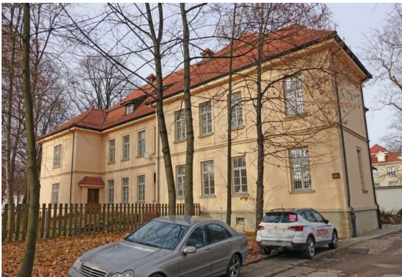
Fot. 1. Budynek nr 6a Szpitala Specjalistycznego im. dra J. Babińskiego SPZOZ w Krakowie. Elewacje płd. i wsch. Stan przed konserwacją. Widoczny obecny stan techniczno-estetyczny budynku. Fot. M. Domańska.
