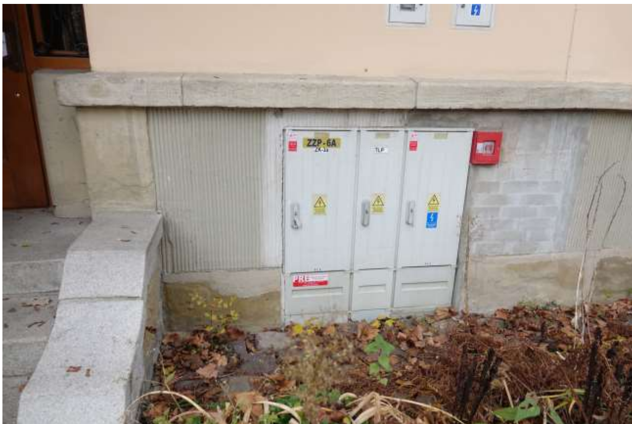
Fot. 1. Budynek nr 6a Szpitala Specjalistycznego im. dra J. Babińskiego SPZOZ w Krakowie. Elewacja wsch. Stan przed konserwacją. Widoczny obecny stan techniczno-estetyczny budynku. Fot. M. Domańska.
