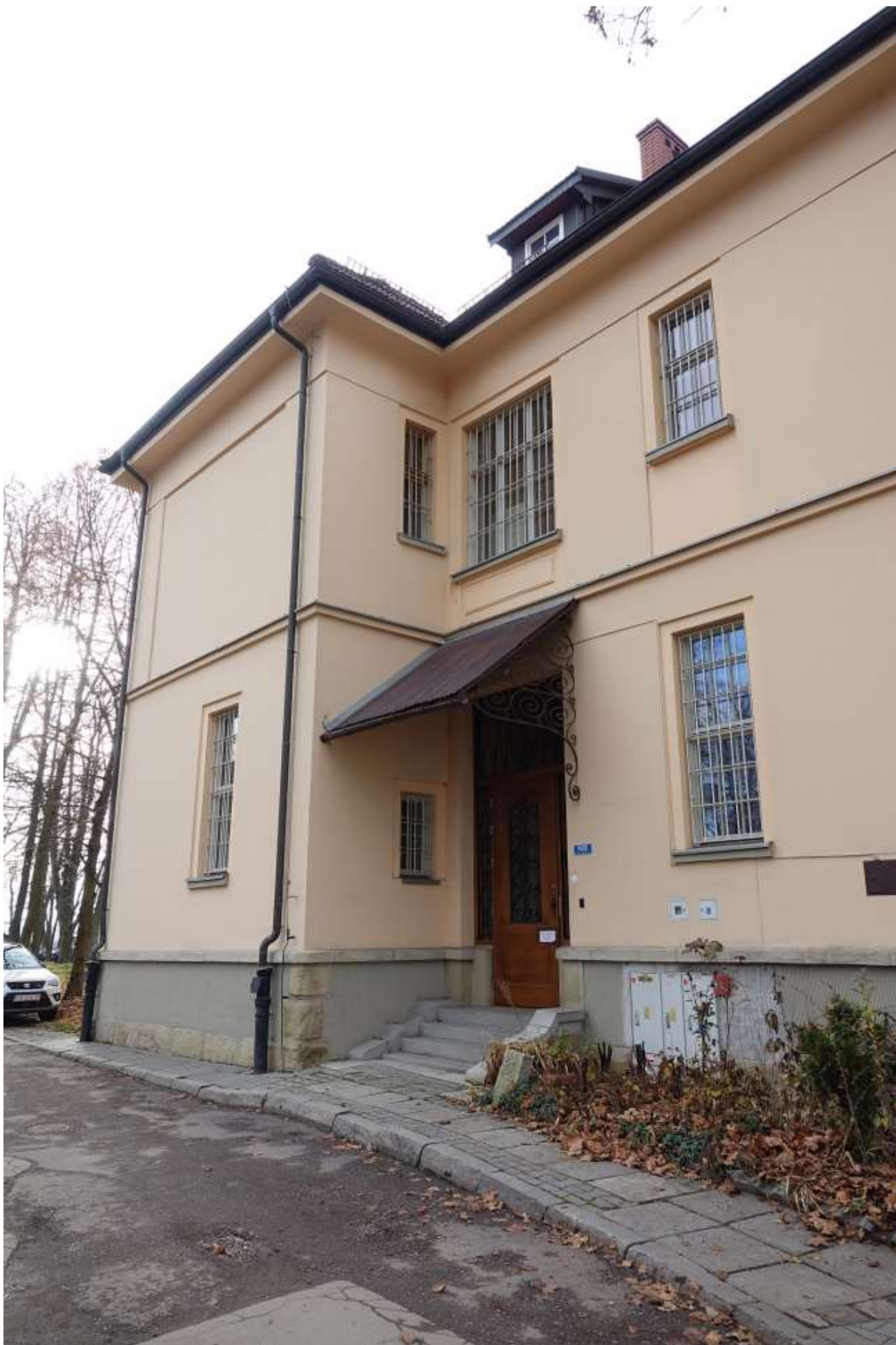
Fot. 2. Budynek nr 6a Szpitala Specjalistycznego im. dra J. Babińskiego SPZOZ w Krakowie. Elewacja wsch. Stan przed konserwacją. Widoczny obecny stan techniczno-estetyczny budynku. Fot. M. Domańska.
