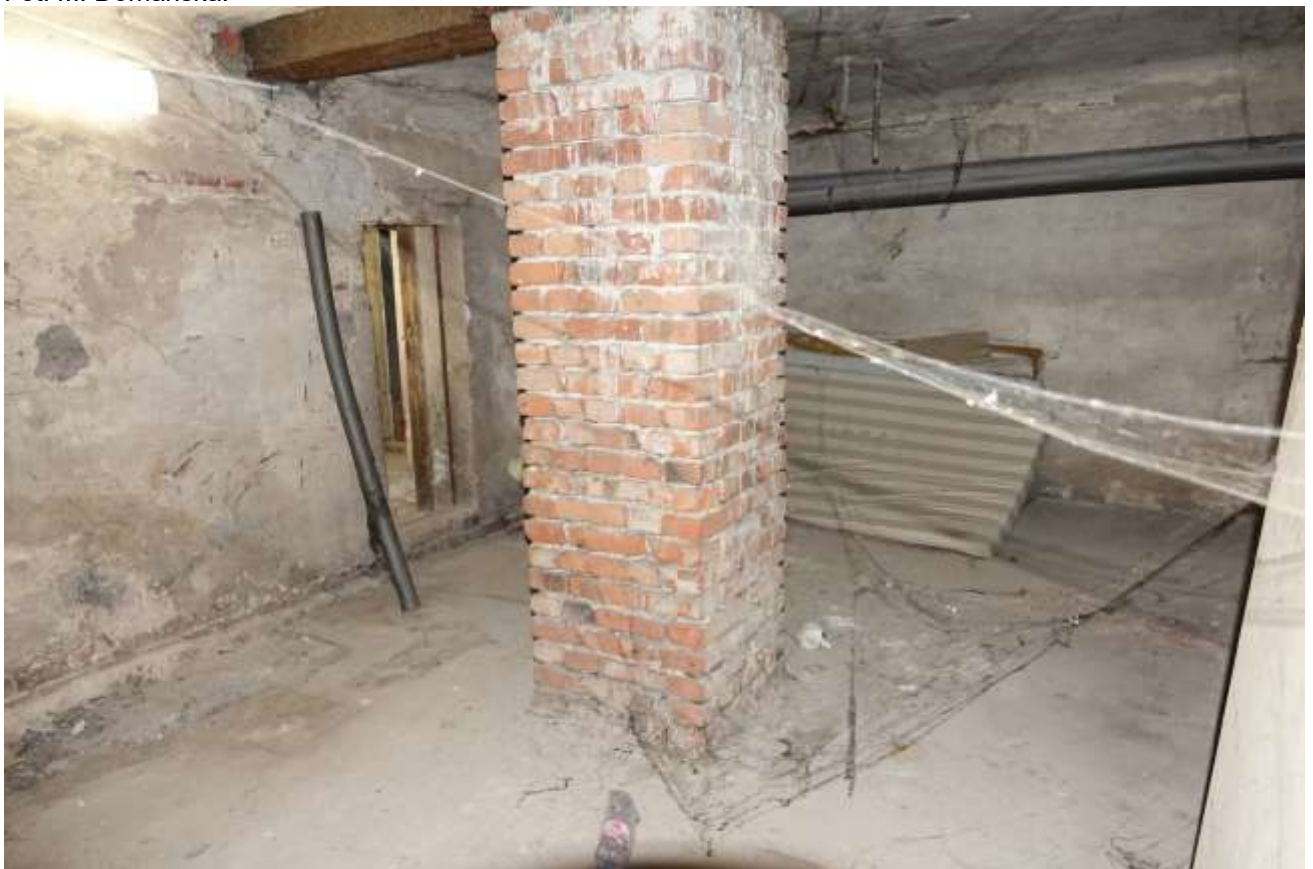
Fot. 60. Budynek nr 6a Szpitala Specjalistycznego im. dra J. Babińskiego SPZOZ w Krakowie. Wnętrze budynku. Stan przed konserwacją. Widoczny bardzo zły stan tynków w piwnicy. Fot. M. Domańska.
