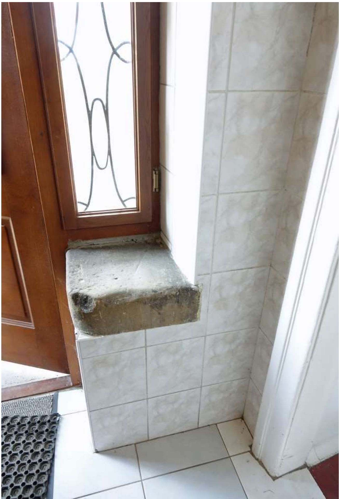
Fot. 33. Budynek nr 6a Szpitala Specjalistycznego im. dra J. Babińskiego SPZOZ w Krakowie. Wnętrze budynku. Stan przed konserwacją. Widoczny stan stolarki drzwiowej oraz ścian i posadzek oraz kamiennych parapetów przy drzwiach wejściowych. Fot. M. Domańska.
