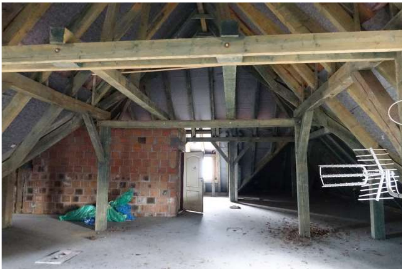
Fot. 26. Budynek nr 6a Szpitala Specjalistycznego im. dra J. Babińskiego SPZOZ w Krakowie. Poddasze. Stan przed konserwacją. Widoczny stan techniczny konstrukcji dachowej oraz brak izolacji termicznej połaci dachu. Fot. M. Domańska.
