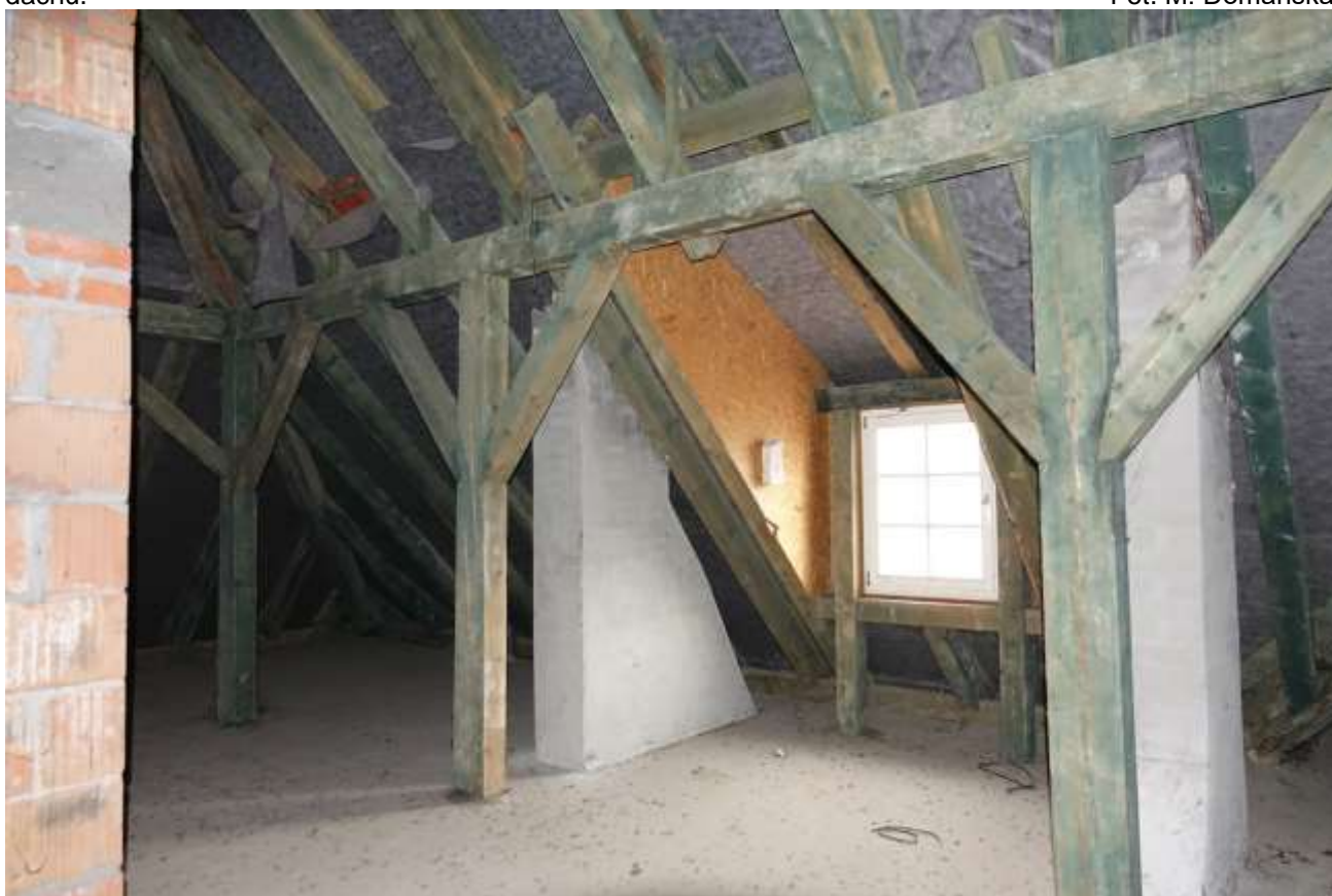
Fot. 27. Budynek nr 6a Szpitala Specjalistycznego im. dra J. Babińskiego SPZOZ w Krakowie. Poddasze. Stan przed konserwacją. Widoczny stan techniczny konstrukcji dachowej oraz brak izolacji termicznej połaci dachu. Fot. M. Domańska.
