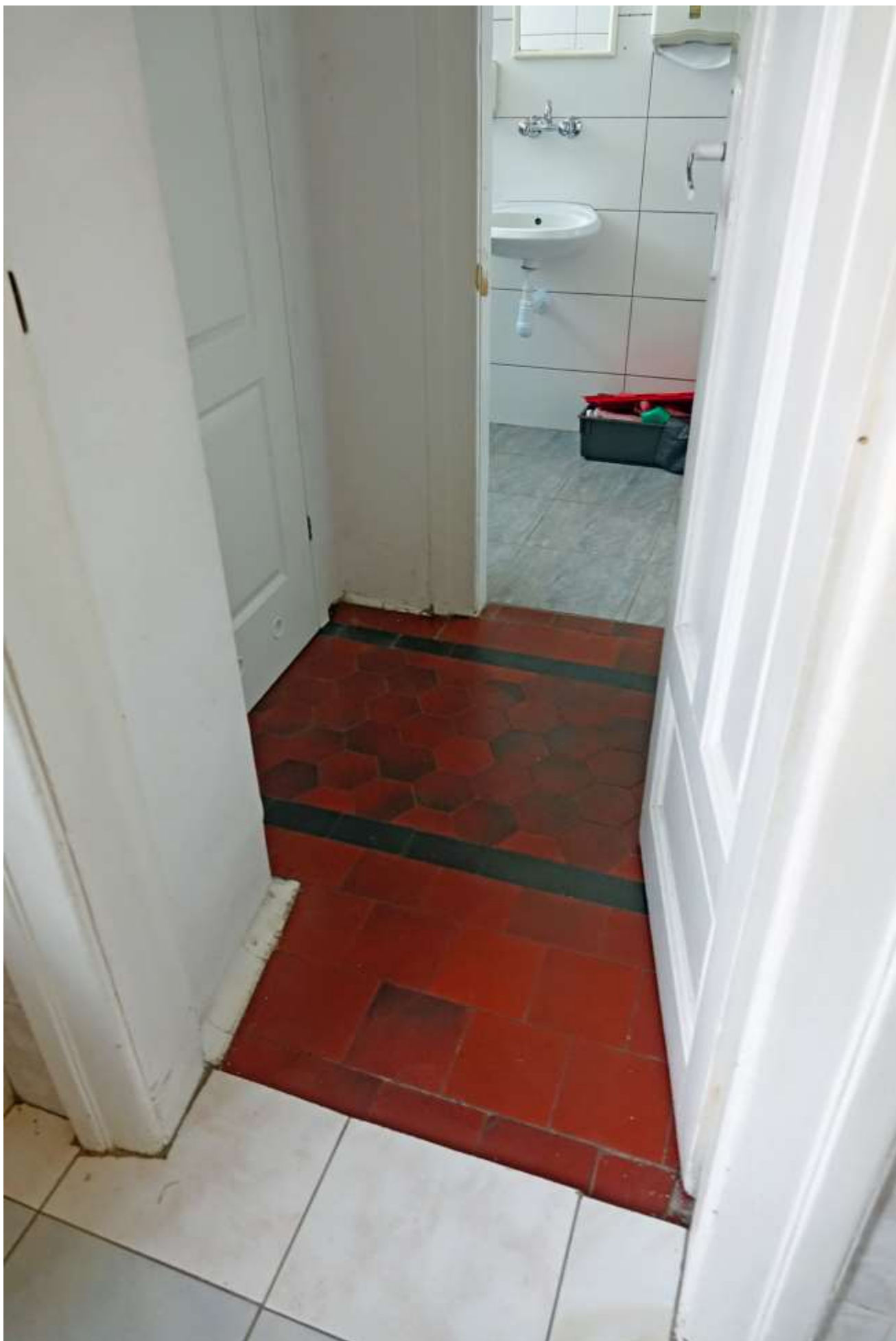
Fot. 41. Budynek nr 6a Szpitala Specjalistycznego im. dra J. Babińskiego SPZOZ w Krakowie. Wnętrze budynku. Stan przed konserwacją. Widoczny nieestetyczne tynki na ścianach. Zachowane oryginalne posadzki kamionkowe. Fot. M. Domańska.
