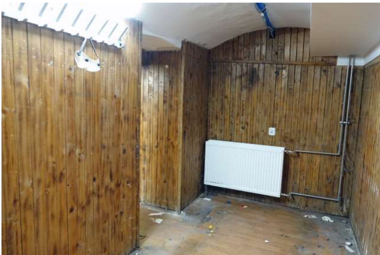
Fot. 67. Budynek nr 6a Szpitala Specjalistycznego im. dra J. Babińskiego SPZOZ w Krakowie. Wnętrze budynku. Stan przed konserwacją. Widoczny bardzo zły stan ścian w piwnicy. Fot. M. Domańska.
