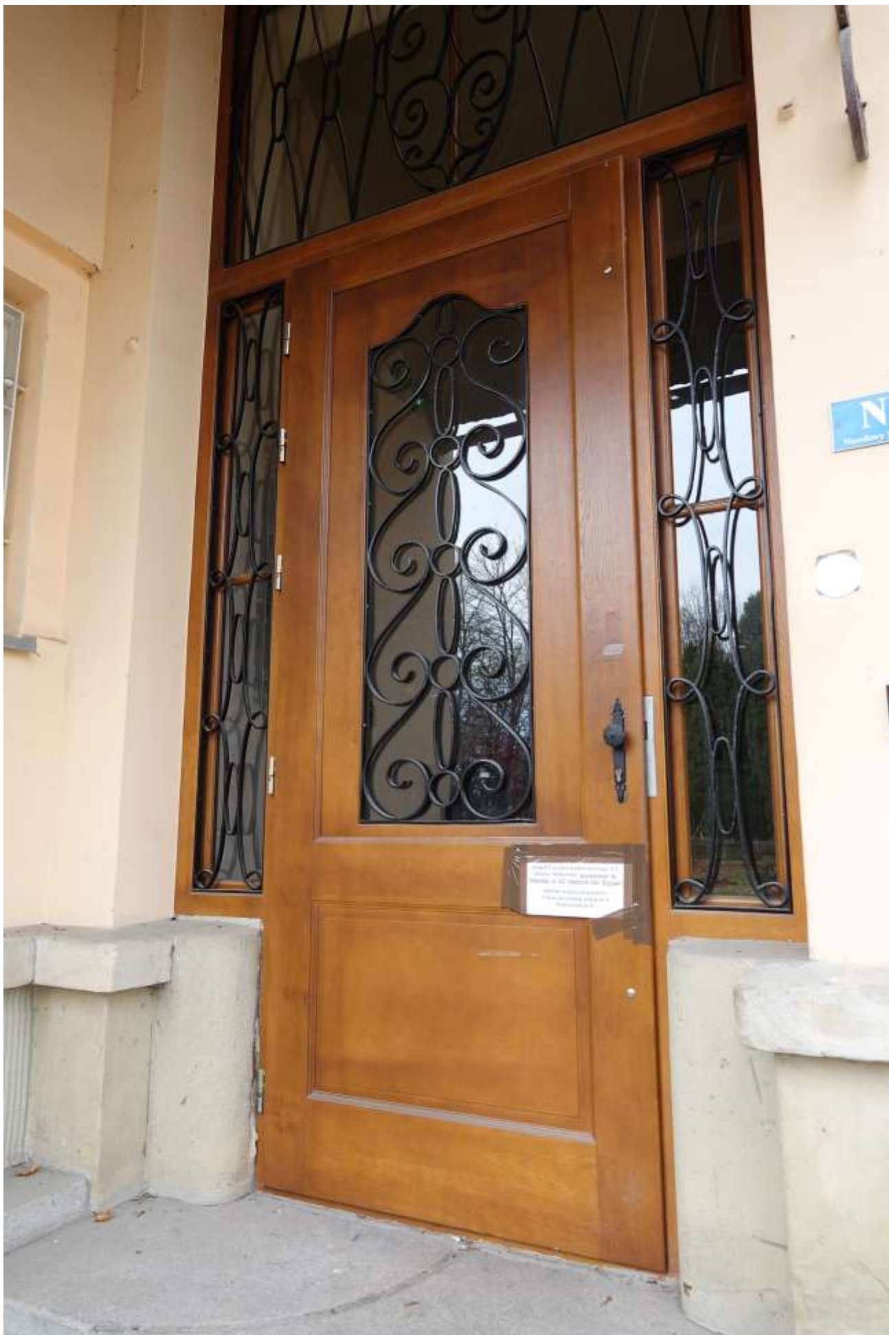
Fot. 4. Budynek nr 6a Szpitala Specjalistycznego im. dra J. Babińskiego SPZOZ w Krakowie. Elewacja wsch. Stan przed konserwacją. Widoczny obecny stan techniczno-estetyczny budynku. Fot. M. Domańska.
