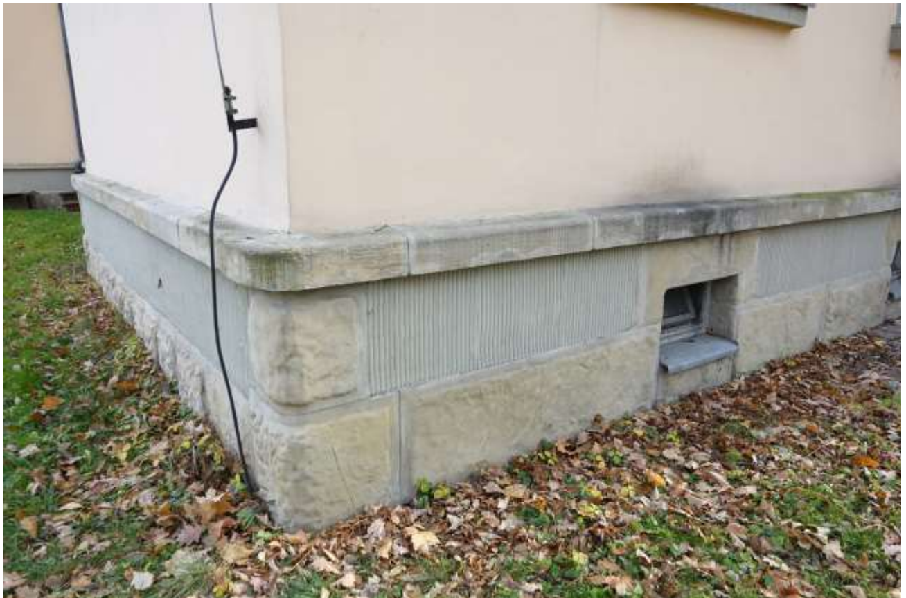
Fot. 21. Budynek nr 6a Szpitala Specjalistycznego im. dra J. Babińskiego SPZOZ w Krakowie. Elewacje płd. i wsch. Stan przed konserwacją. Widoczny obecny stan techniczno-estetyczny budynku. Fot. M. Domańska.
