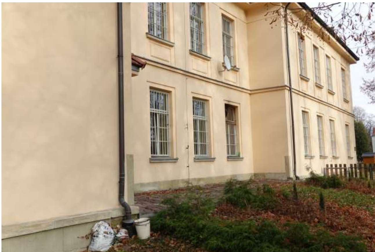
Fot. 18. Budynek nr 6a Szpitala Specjalistycznego im. dra J. Babińskiego SPZOZ w Krakowie. Elewacja pld. Stan przed konserwacją. Widoczny obecny stan techniczno-estetyczny budynku. Fot. M. Domańska.
