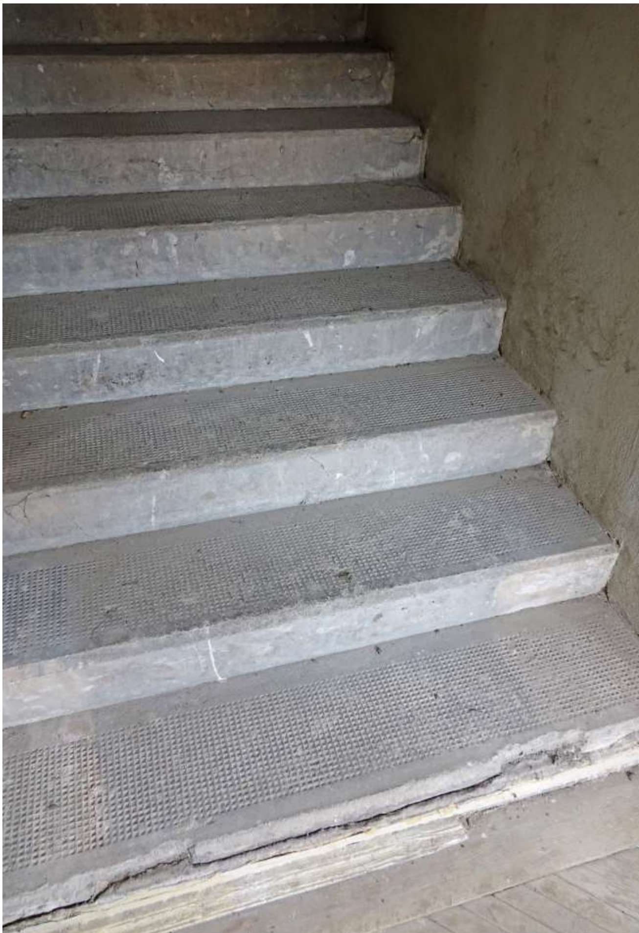
Fot. 35. Budynek nr 6a Szpitala Specjalistycznego im. dra J. Babińskiego SPZOZ w Krakowie. Wnętrze budynku. Stan przed konserwacją. Widoczne zniszczenia i zabrudzenia schodów betonowych na poziom poddasza. Fot. M. Domańska.
