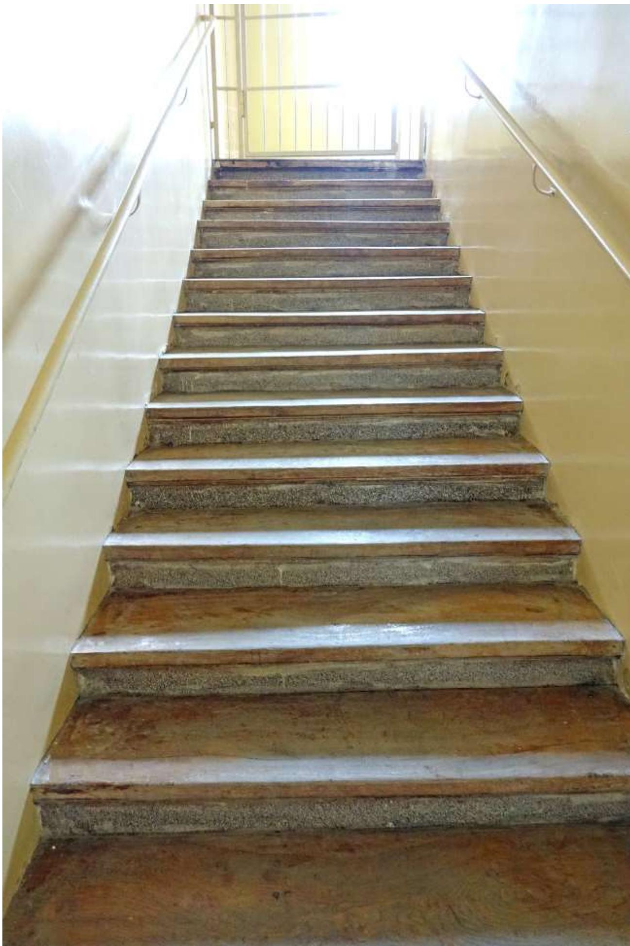
Fot. 36. Budynek nr 6a Szpitala Specjalistycznego im. dra J. Babińskiego SPZOZ w Krakowie. Wnętrze budynku. Stan przed konserwacją. Widoczne zniszczenia i przekształcenia schodów z lastryko. Fot. M. Domańska.
