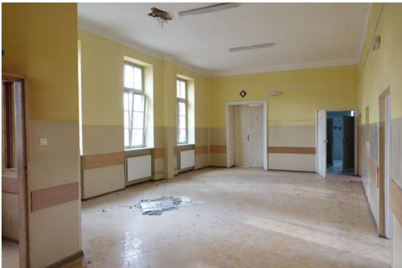
Fot. 47. Budynek nr 6a Szpitala Specjalistycznego im. dra J. Babińskiego SPZOZ w Krakowie. Wnętrze budynku Stan przed konserwacją. Widoczny obecny stan techniczno-estetyczny stolarki drzwiowej oraz tynków wewnętrznych. Fot. M. Domańska.
