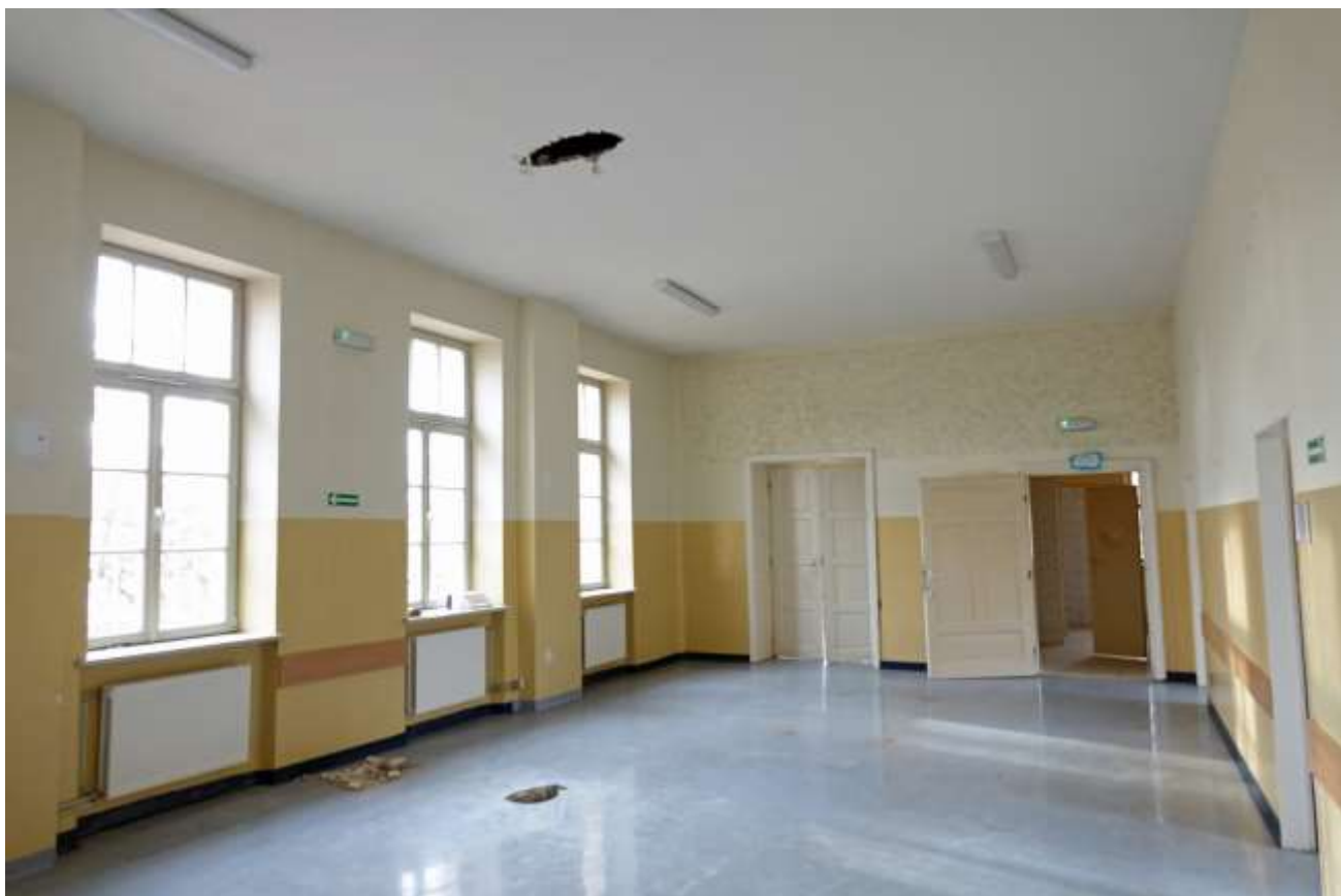
Fot. 52. Budynek nr 6a Szpitala Specjalistycznego im. dra J. Babińskiego SPZOZ w Krakowie. Wnętrze budynku Stan przed konserwacją. Widoczny obecny stan techniczno-estetyczny stolarki drzwiowej oraz tynków wewnętrznych. Fot. M. Domańska.
