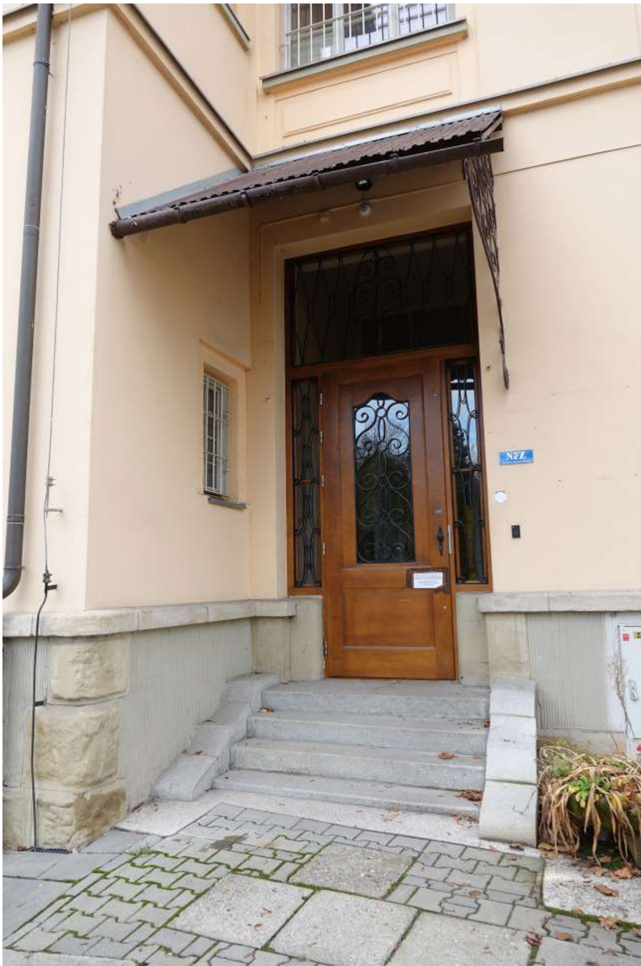
Fot. 3. Budynek nr 6a Szpitala Specjalistycznego im. dra J. Babińskiego SPZOZ w Krakowie. Elewacja wsch. Stan przed konserwacją. Widoczny obecny stan techniczno-estetyczny budynku. Fot. M. Domańska.
