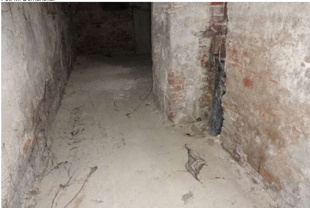
Fot. 58. Budynek nr 6a Szpitala Specjalistycznego im. dra J. Babińskiego SPZOZ w Krakowie. Wnętrze budynku. Stan przed konserwacją. Widoczny bardzo zły stan tynków w piwnicy. Fot. M. Domańska.
