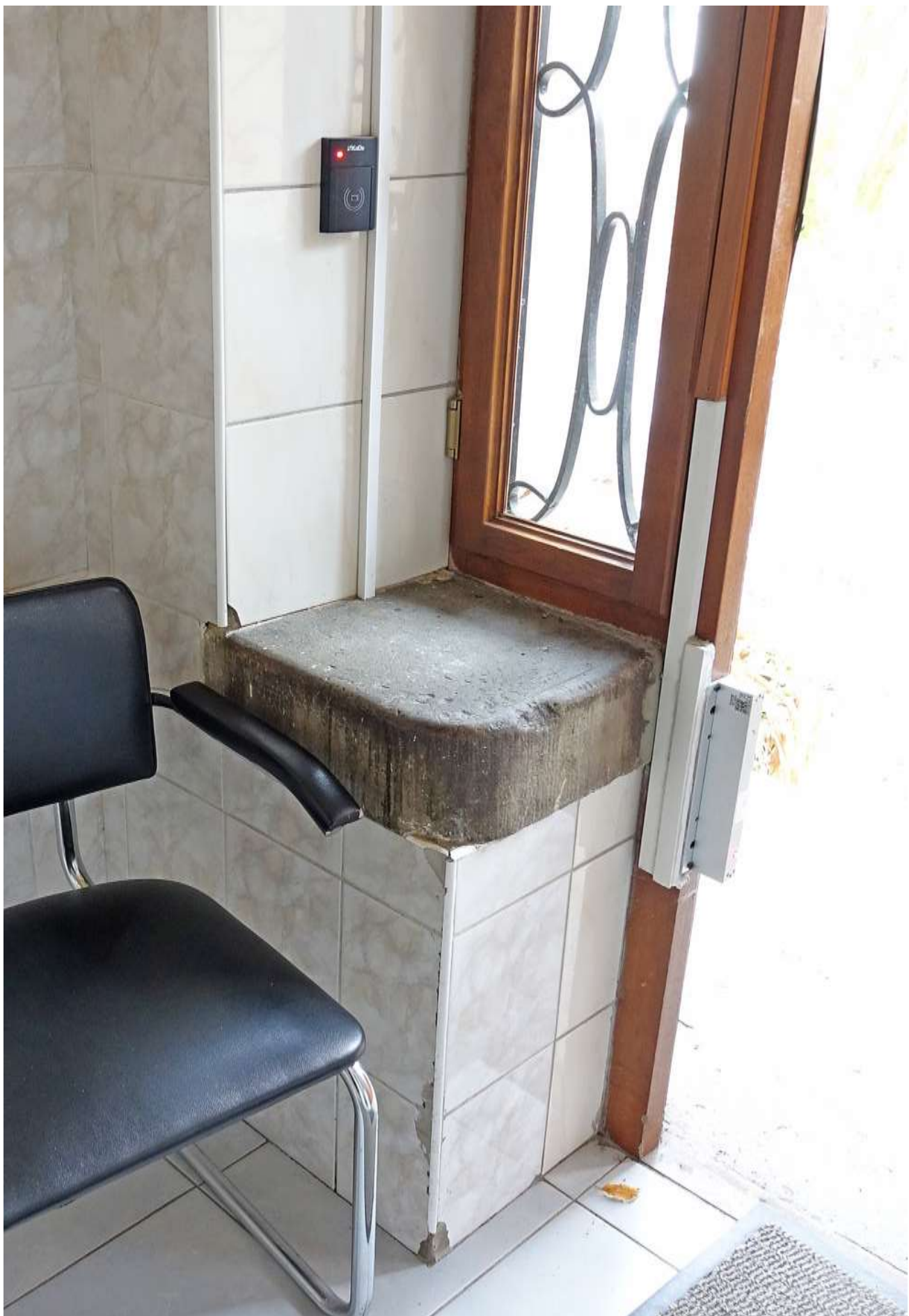
Fot. 32. Budynek nr 6a Szpitala Specjalistycznego im. dra J. Babińskiego SPZOZ w Krakowie. Wnętrze budynku. Stan przed konserwacją. Widoczny stan stolarki drzwiowej oraz ścian i posadzek oraz kamiennych parapetów przy drzwiach wejściowych. Fot. M. Domańska.
