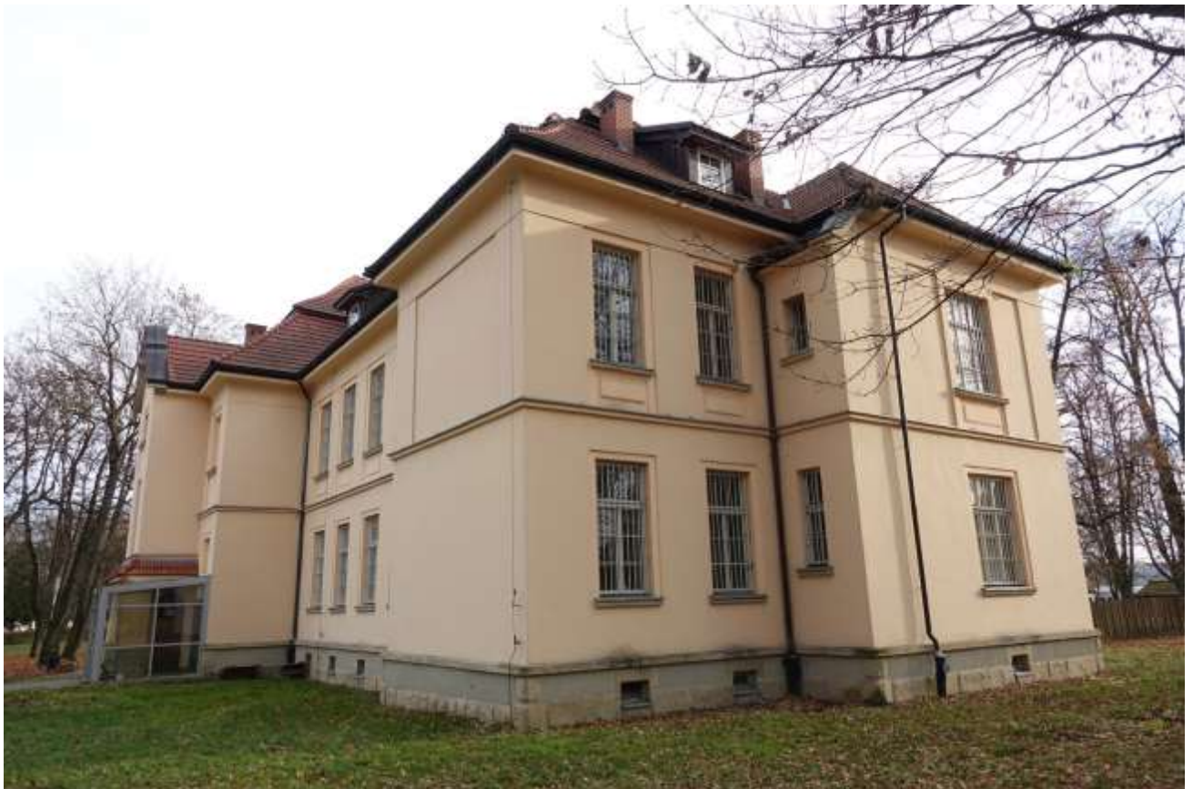
Fot. 14. Budynek nr 6a Szpitala Specjalistycznego im. dra J. Babińskiego SPZOZ w Krakowie. Elewacje płn. i zach. Stan przed konserwacją. Widoczny obecny stan techniczno-estetyczny budynku. Fot. M. Domańska.
