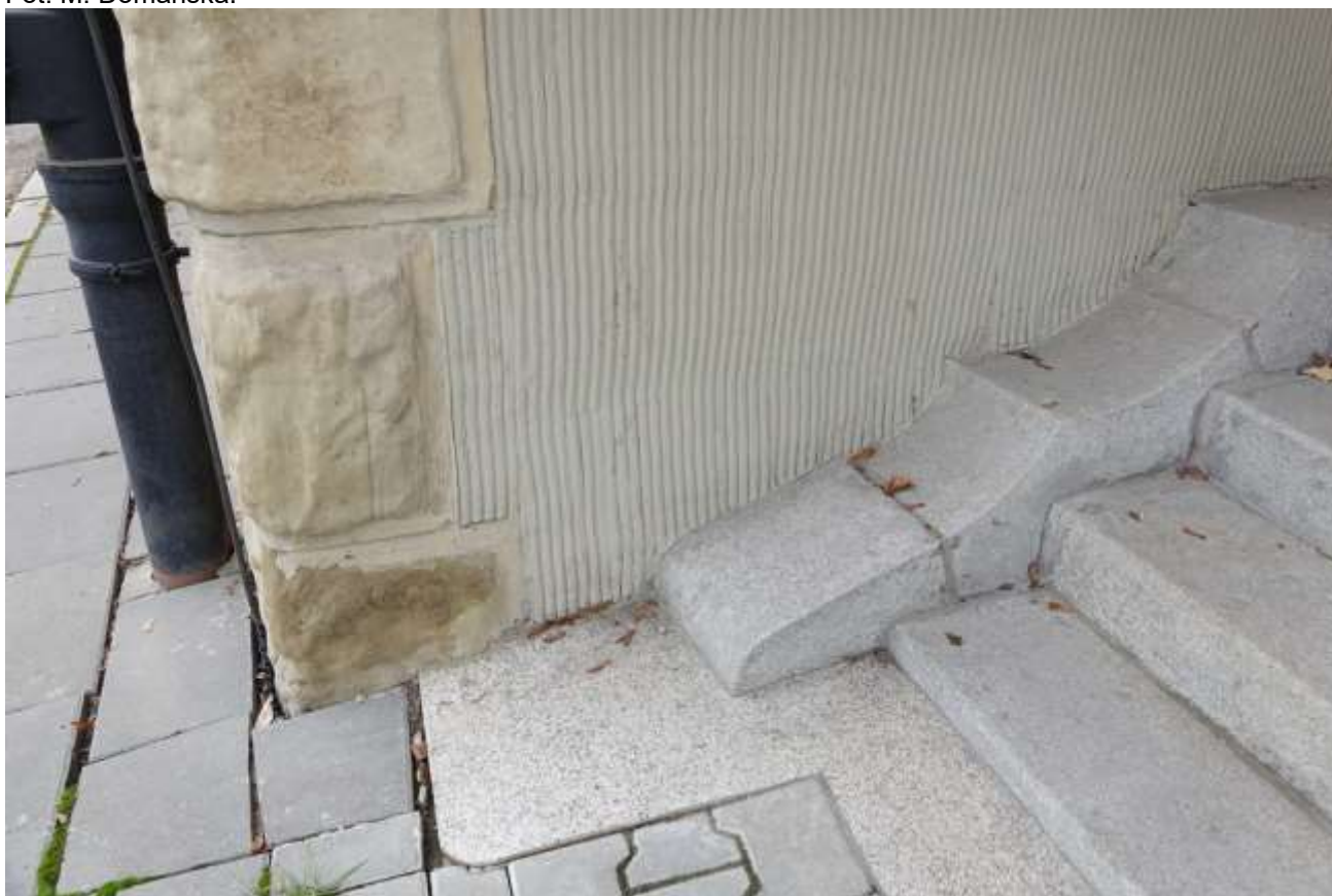
Fot. 5. Budynek nr 6a Szpitala Specjalistycznego im. dra J. Babińskiego SPZOZ w Krakowie. Elewacje płd. i wsch. Stan przed konserwacją. Widoczny obecny stan techniczno-estetyczny budynku. Fot. M. Domańska.
