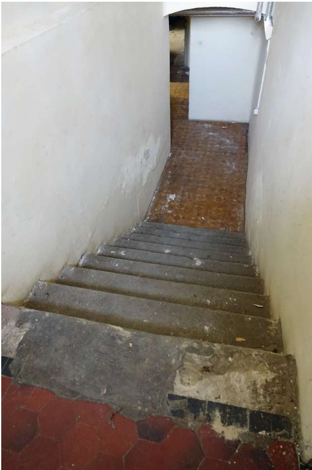
Fot. 39. Budynek nr 6a Szpitala Specjalistycznego im. dra J. Babińskiego SPZOZ w Krakowie. Wnętrze budynku. Stan przed konserwacją. Widoczne rozległe zniszczenia schodów kamiennych do piwnicy. Fot. M. Domańska.
