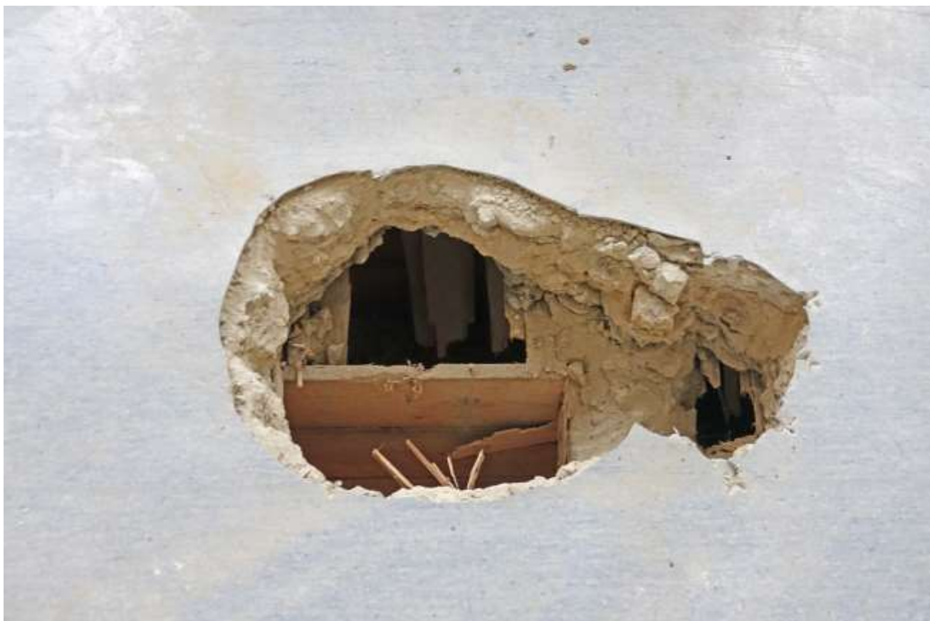
Fot. 30. Budynek nr 6a Szpitala Specjalistycznego im. dra J. Babińskiego SPZOZ w Krakowie. Strop pod częścią piętra. Stan przed konserwacją. Widoczny stan techniczny konstrukcji stropu. Fot. M. Domańska.
