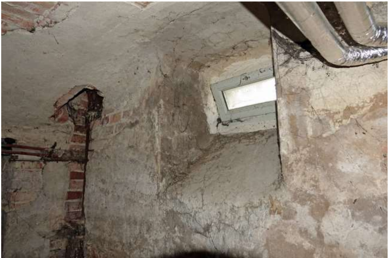
Fot. 59. Budynek nr 6a Szpitala Specjalistycznego im. dra J. Babińskiego SPZOZ w Krakowie. Wnętrze budynku. Stan przed konserwacją. Widoczny bardzo zły stan tynków w piwnicy. Fot. M. Domańska.
