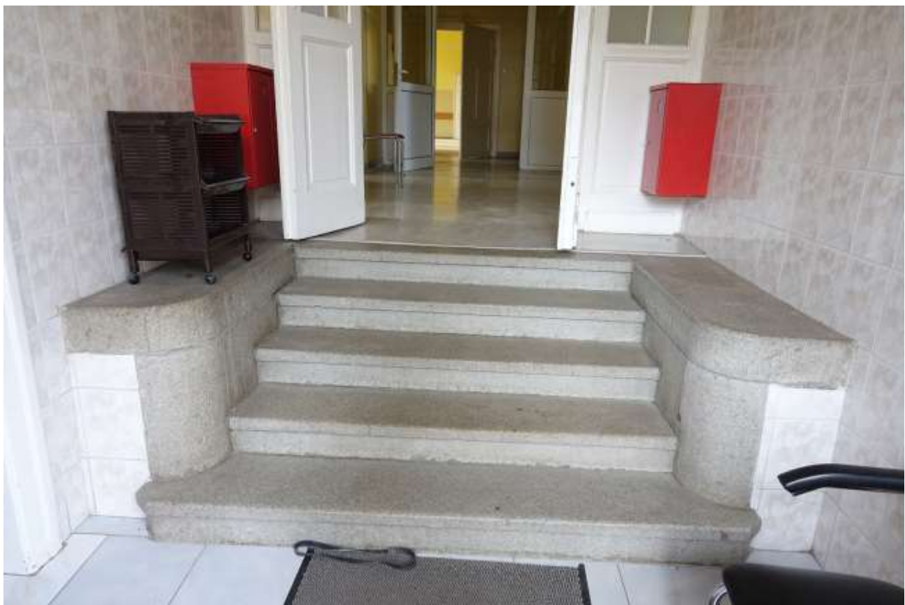
Fot. 34. Budynek nr 6a Szpitala Specjalistycznego im. dra J. Babińskiego SPZOZ w Krakowie. Wnętrze budynku. Stan przed konserwacją. Widoczne zniszczenia i zabrudzenia schodów z tzw. policzkami. Fot. M. Domańska.
