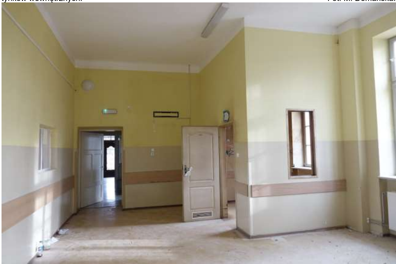
Fot. 50. Budynek nr 6a Szpitala Specjalistycznego im. dra J. Babińskiego SPZOZ w Krakowie. Wnętrze budynku Stan przed konserwacją. Widoczny obecny stan techniczno-estetyczny stolarki drzwiowej oraz tynków wewnętrznych. Fot. M. Domańska.
