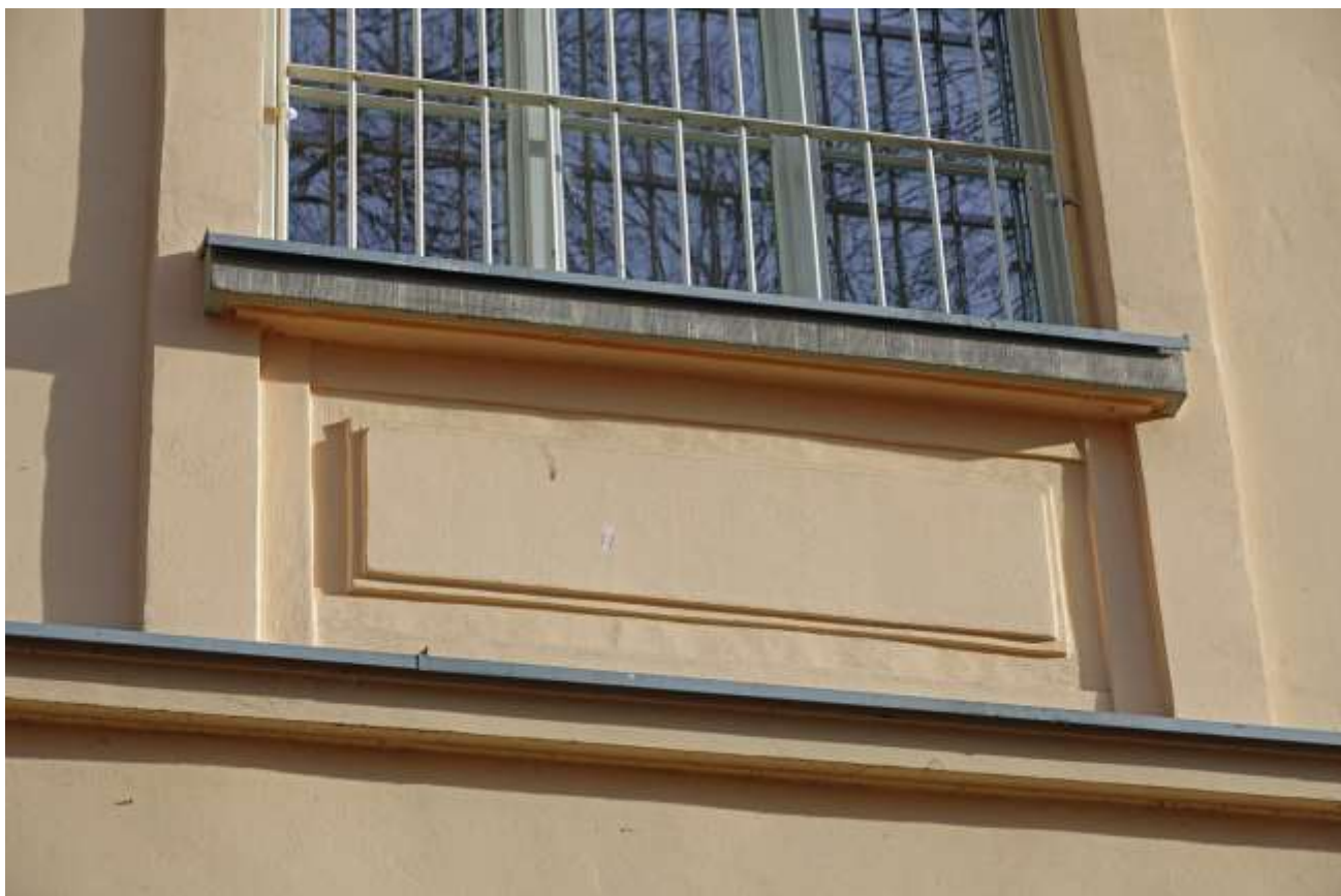
Fot. 16. Budynek nr 6a Szpitala Specjalistycznego im. dra J. Babińskiego SPZOZ w Krakowie. Elewacja zach. Stan przed konserwacją. Widoczny obecny stan techniczno-estetyczny budynku. Fot. M. Domańska.
