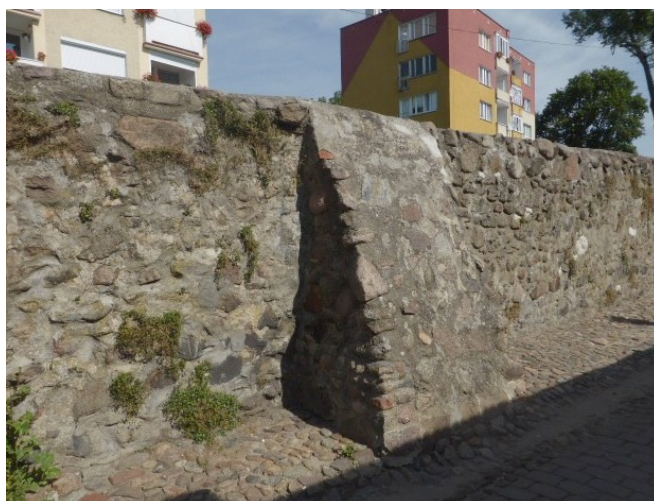
Fot.5 Widoczna duża ilość zapraw cementowych pomiędzy kamieniami
