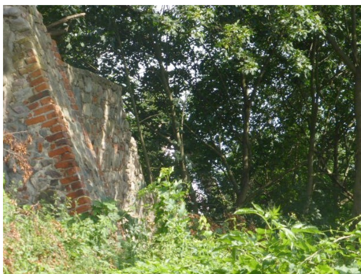
Fot.23 Przepora czwartego odcinka muru
