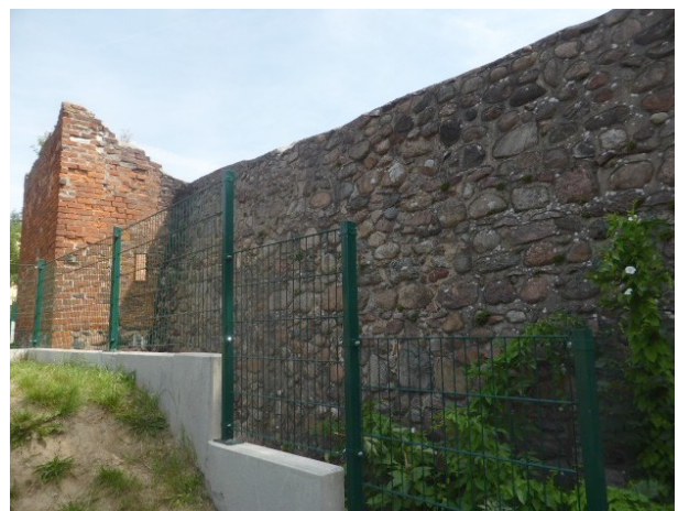
Fot.31 Widok na mur od strony boiska, rozwarstwienia korony murów czatowni
