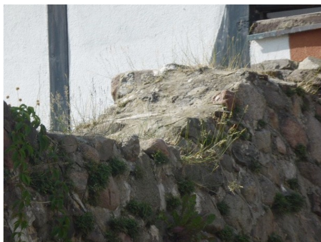
Fot.3 Górna partia muru zamknięta cementem.
