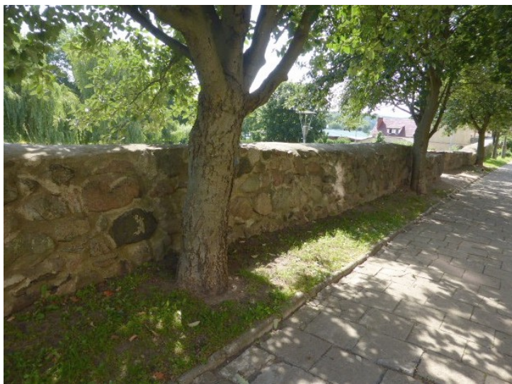
Fot.17 Drzewa rosnące zbyt blisko muru wymagające przekierowania korzeni
