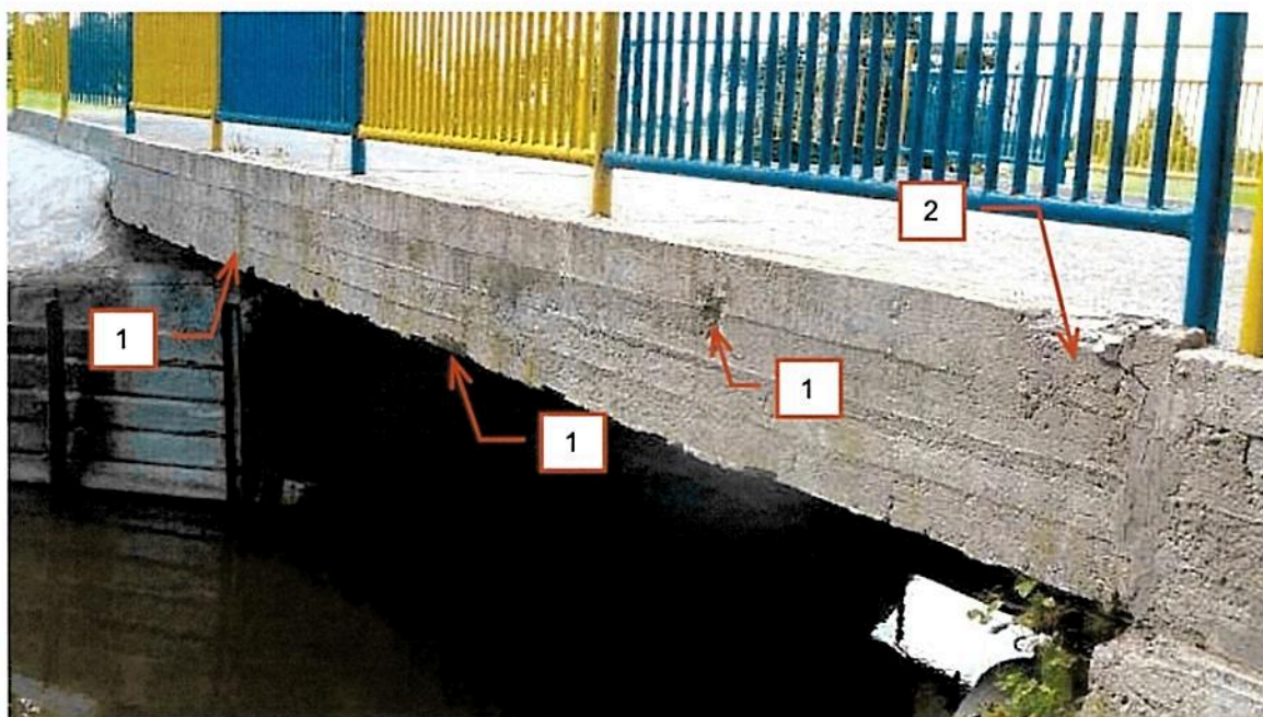
Fot. 2.31 Gzyms po stronie wschodniej. Zanieczyszczenia, ubytki betonu, zarysowania powierzchni gzymsu (1). Zniszczenie struktury betonu (2).
