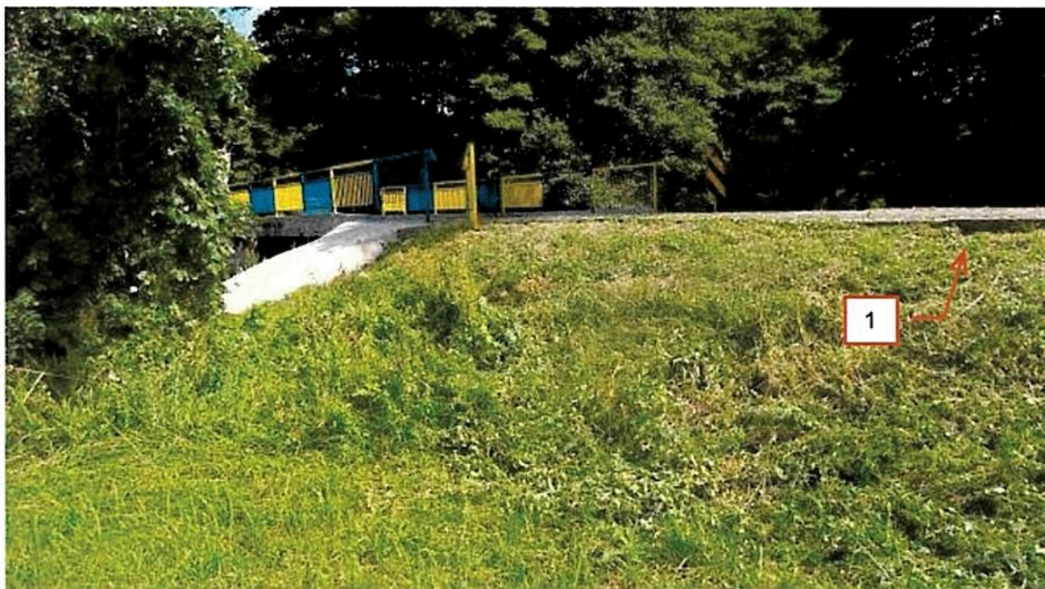
Fot. 2.1 Skarpa nasypu od strony południowo-zachodniej. Lokalny ubytek nasypu drogowego (1).
