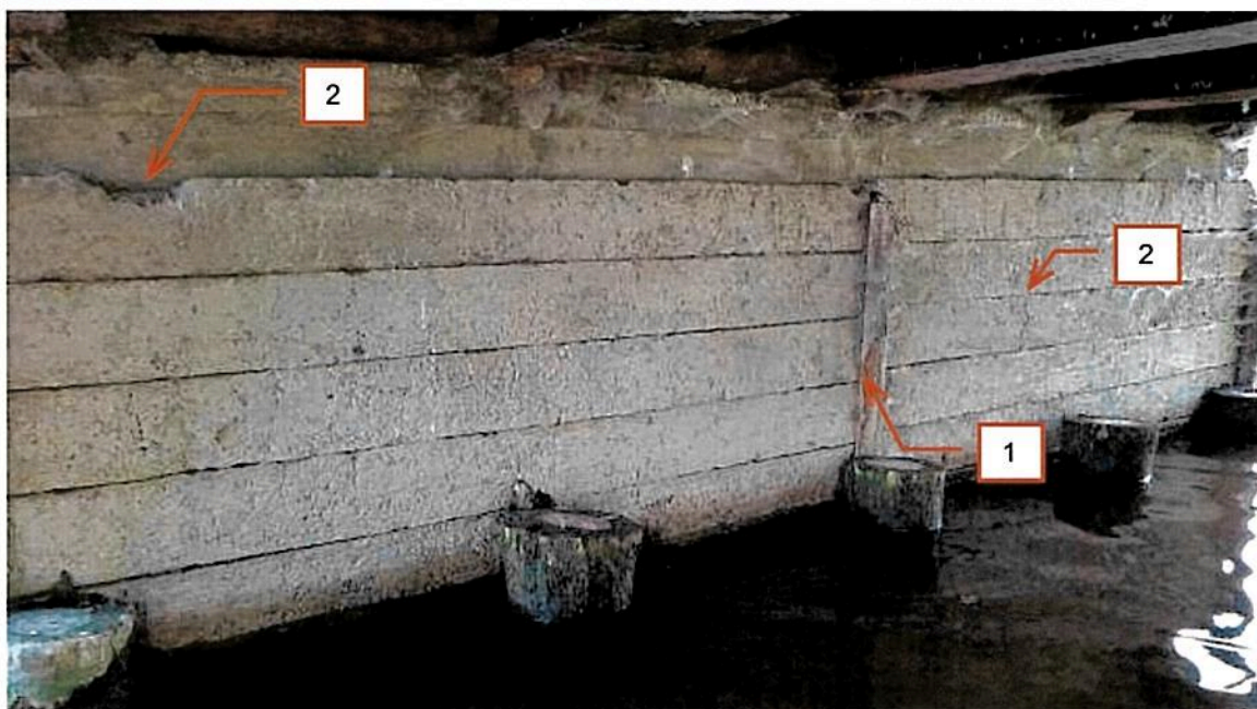
Fot. 2.55 Korpus przyczółka południowego. Deformacje i korozja kształtowników stalowych (1). Zanieczyszczenia, pęknięcia i ubytki betonowych elementów wypełniających (2).
