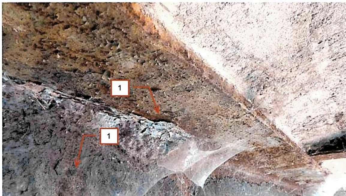
Fot. 2.44 Dźwigary główne. Zniszczenie powłoki malarskiej i ogniska korozji powierzchniowej (1).
