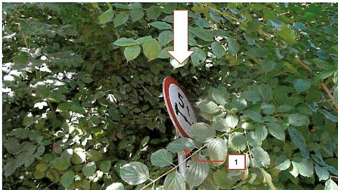
Fot. 2.66 Oznakowanie na dojeździe od strony północnej. Przewrócony znak drogowy (1).
