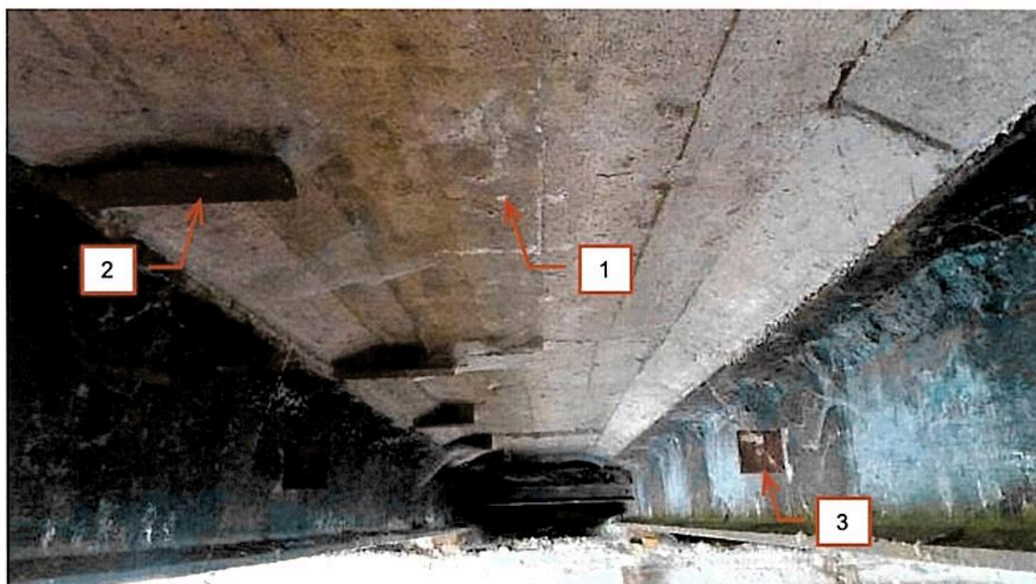
Fot. 2.35 Spód płyty ustroju nośnego. Ślady zawilgoceń, wykwity substancji mineralnych (1). Korozja stalowych elementów podtrzymujących gzymsy (2). Brak stężeń poprzecznych (3).
