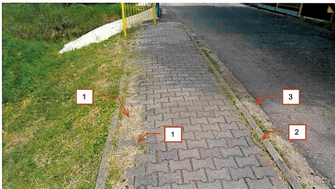
Fot. 2.13 Dojście do obiektu od strony południowo-zachodniej. Deformacje, zanieczyszczenia nawierzchni chodnika (1). Wegetacja roślinności w szczelinach między nawierzchnią a obrzeżem (2). Ubytki nawierzchni jezdni i zanieczyszczenie gruntem w strefach przykrawężnikowych (3)
