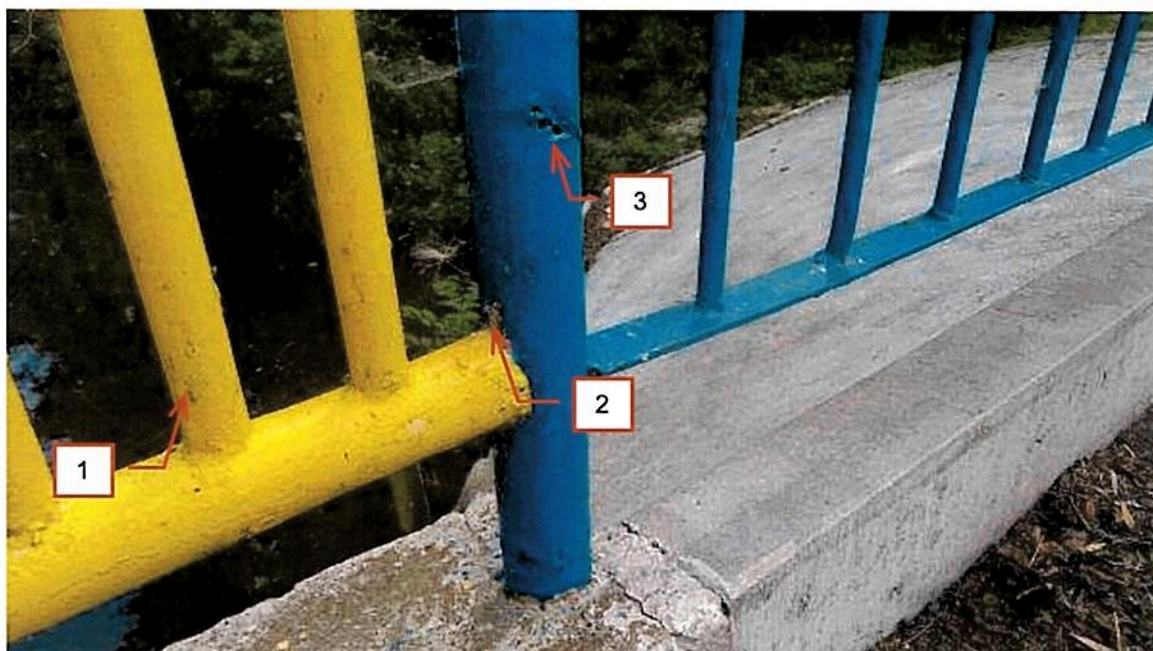
Fot. 2.21 Balustrada po stronie wschodniej. Zanieczyszczenie powierzchni stalowej balustrady (1). Lokalne uszkodzenia powłoki malarskiej i ogniska korozji (2). Perforacja słupka balustrady (3)
