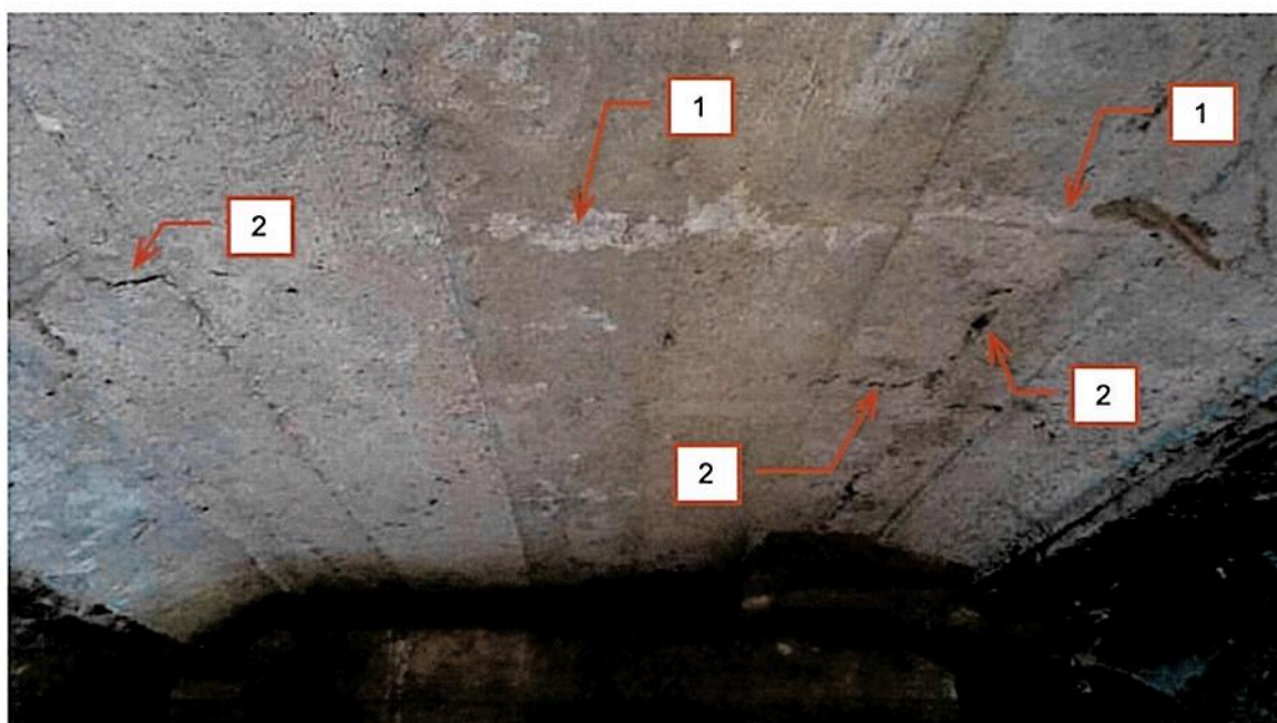
Fot. 2.40 Spód płyty ustroju nośnego. Wykwity substancji mineralnych (1). Lokalne zarysowania i ubytki otuliny betonowej (2).
