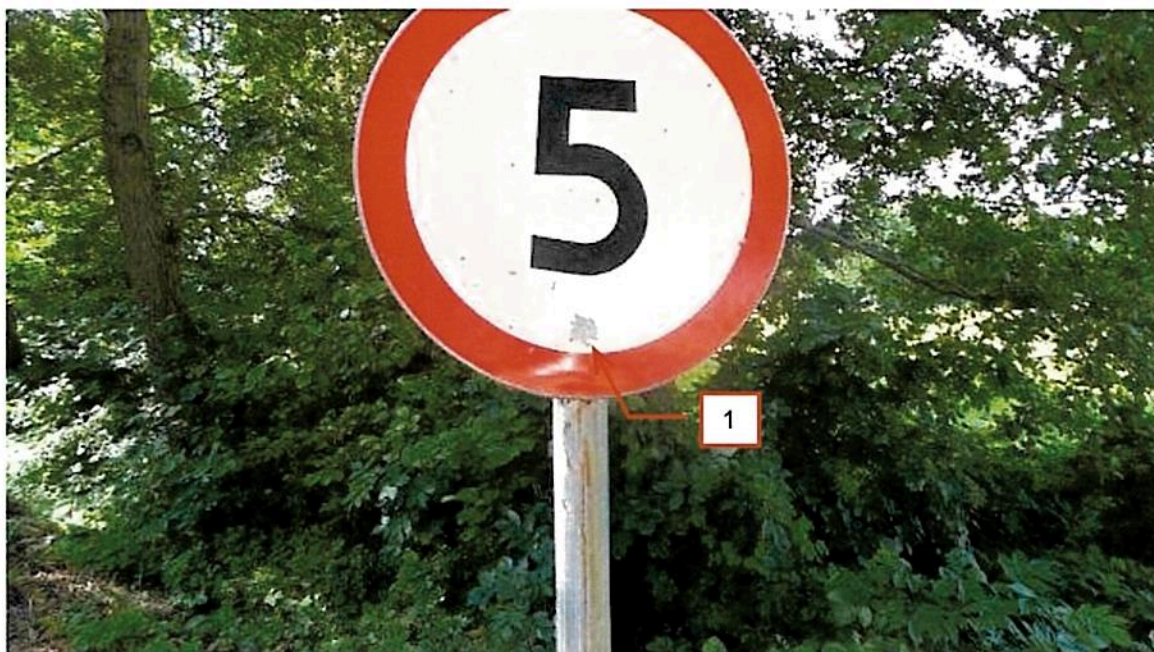
Fot. 2.68 Oznakowanie na dojeździe od strony północnej. Drobne uszkodzenie i zanieczyszczenie tablic znaków (1).
