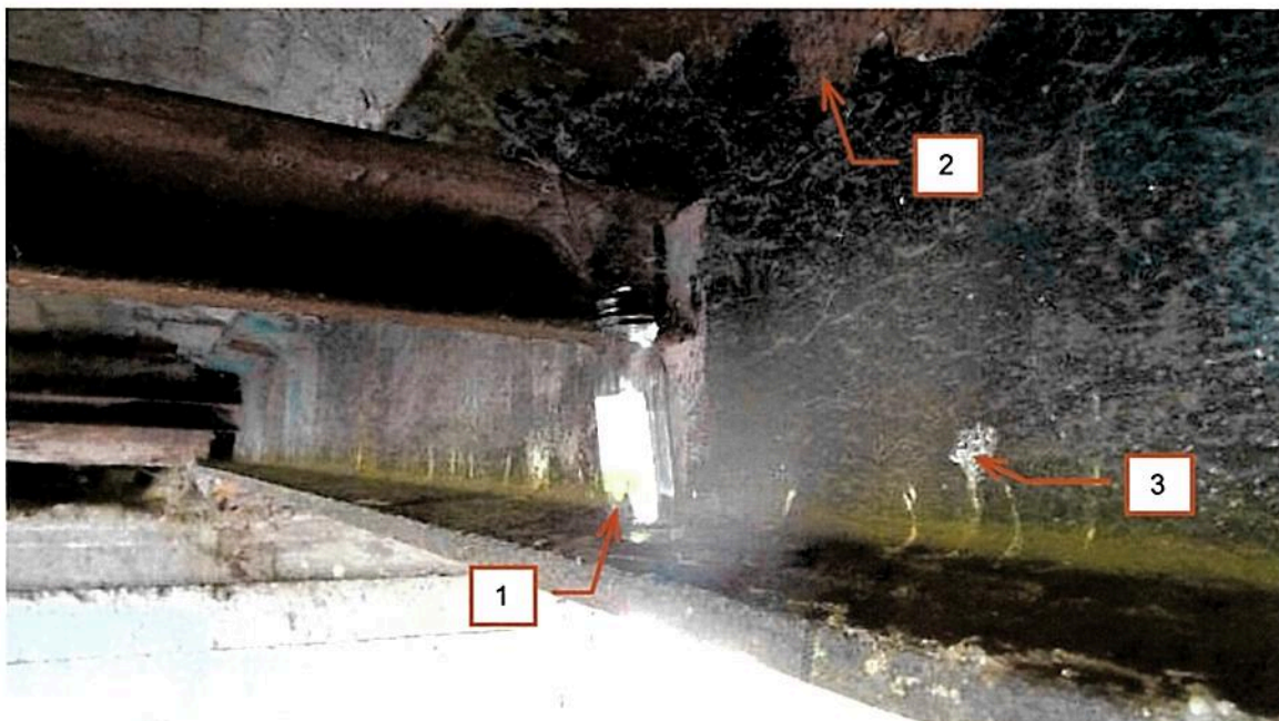
Fot. 2.45 Dźwigary główne. Zaśmieccenie (1). Zniszczenie powłoki malarskiej i ogniska korozji powierzchniowej (2). Zanieczyszczenie powierzchni ptasimi odchodami (3).
