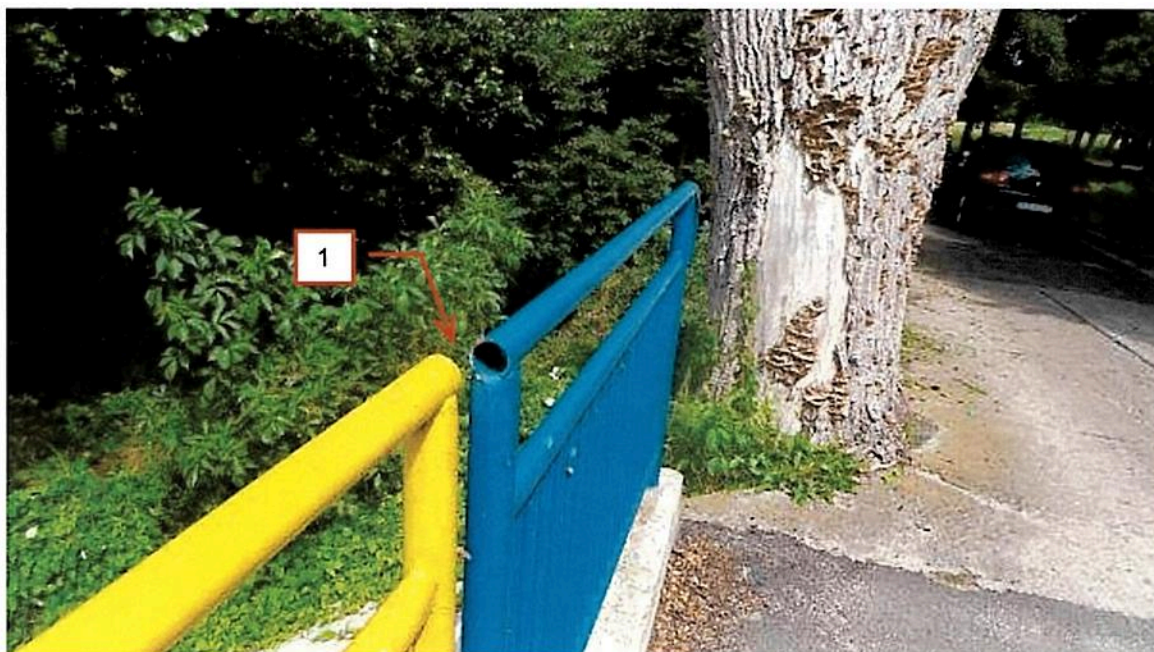
Fot. 2.26 Balustrada po stronie wschodniej. Brak ciągłości pochwyty balustrady (1).
