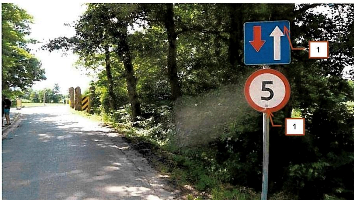
Fot. 2.67 Oznakowanie na dojeździe od strony północnej. Drobne uszkodzenie i zanieczyszczenie tablic znaków (1).
