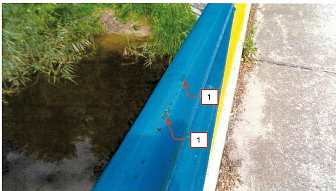
Fot. 2.25 Balustrada po stronie zachodniej. Lokalne uszkodzenia powłoki malarskiej (1).
