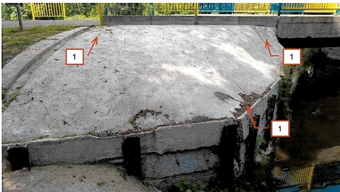
Fot. 2.7 Stożek od strony południowo-wschodniej. Zanieczyszczenia, osady na powierzchni umocnienia (1).
