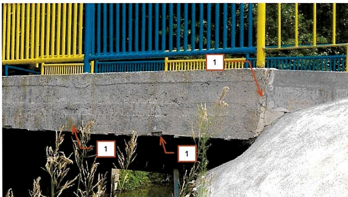
Fot. 2.27 Gzys po stronie zachodniej. Zanieczyszczenia, ubytki betonu, zarysowania powierzchni gzymsu (1).
