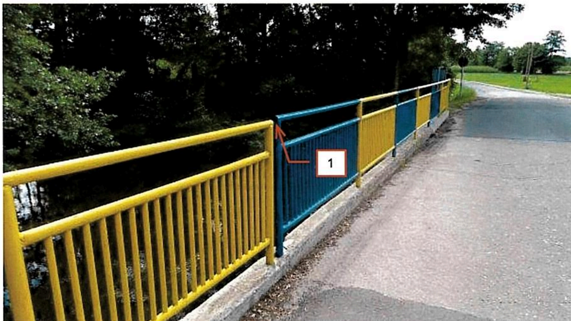
Fot. 2.19 Balustrada po stronie wschodniej. Brak ciągłości pochwytu balustrady (1).
