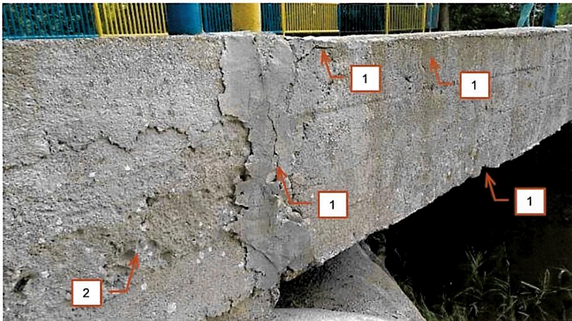
Fot. 2.29 Gzys po stronie zachodniej. Zanieczyszczenia, ubytki betonu, zarysowania powierzchni gzymsu (1). Zniszczenie struktury betonu (2)
