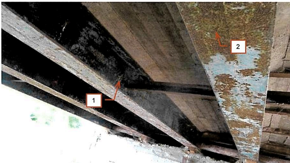
Fot. 2.41 Dźwigary główne. Zanieczyszczenia, zabrudzenia (1). Zniszczenie powłoki malarskiej i ogniska korozji powierzchniowej (2).
