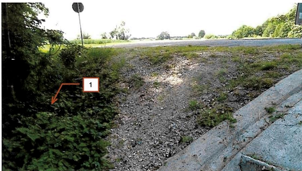
Fot. 2.3 Skarpa nasypu od strony południowo-wschodniej. Wegetacja roślin (drzew, krzewów) na powierzchni nasypu (1).
