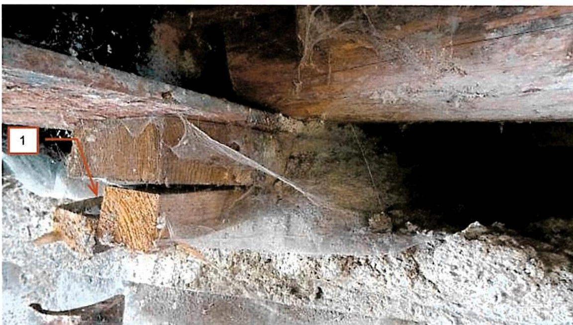
Fot. 2.49 Brak Łożysk (podklinowanie z drewna). Przemieszczenie klina mogące skutkować utratą punktu podparcia dźwigara (1).
