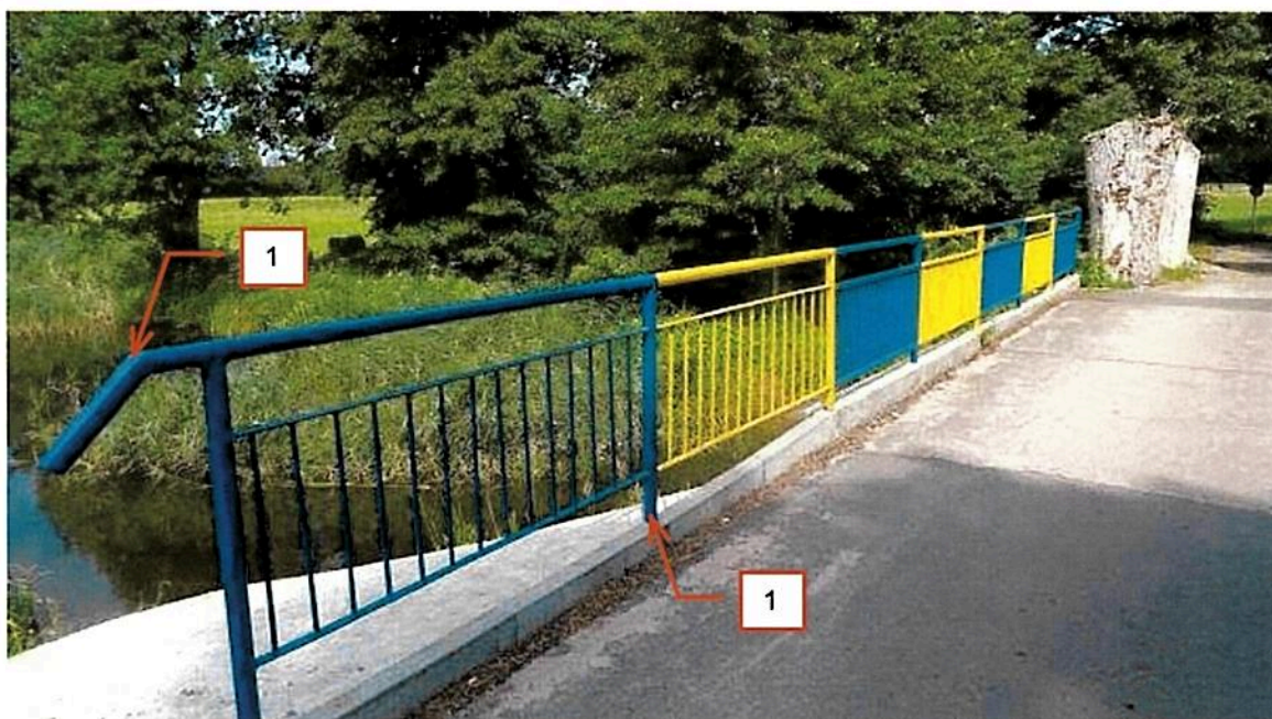
Fot. 2.23 Balustrada po stronie zachodniej. Lokalne uszkodzenia powłoki malarskiej (1).
