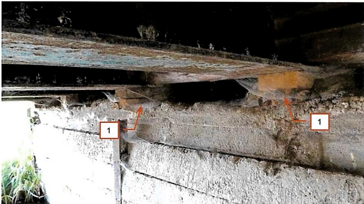
Fot. 2.47 Brak łożysk (podklinowanie z drewna). Zanieczyszczenie elementów (1).
