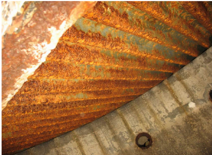
Fot.6 Widok na skorodowaną blachę stropu komory ujęcia i rozdziału wody.
