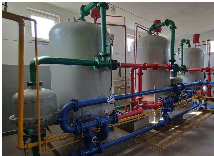
Fot. 9. Mieszacze wodno-powietrzne oraz 3 filtry odzielające
