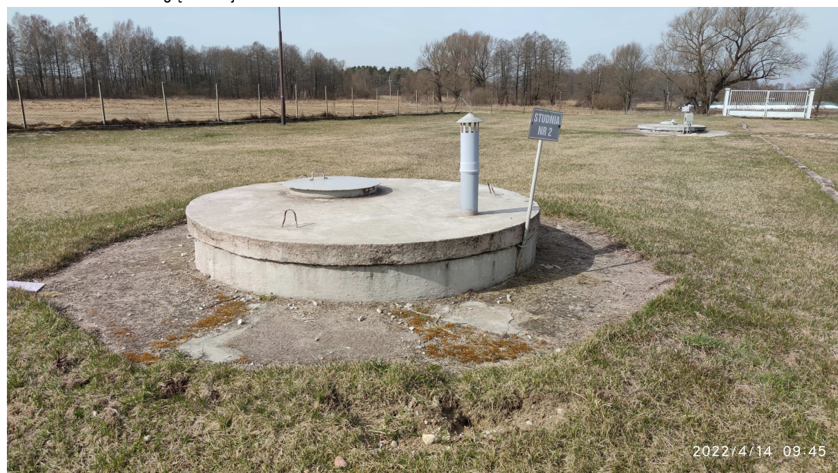
Fot. 8 Obudowa studni głębinowej nr 2
