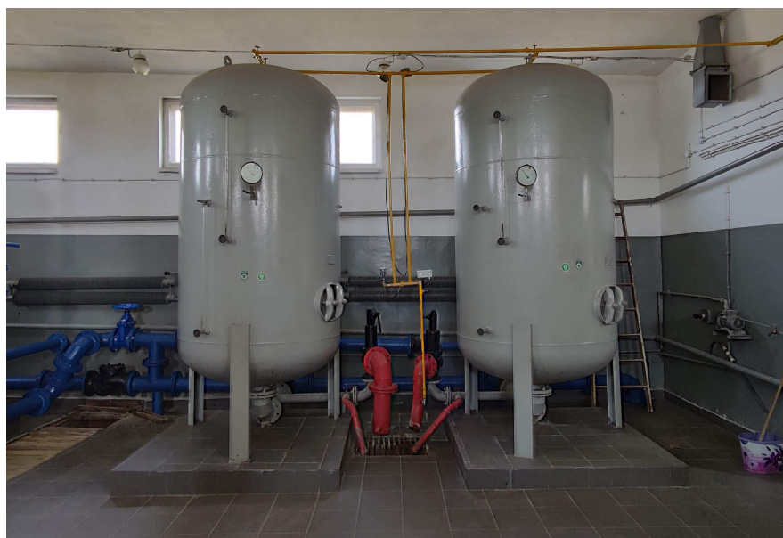
Fot. 10. Zbiorniki hydroforowe
