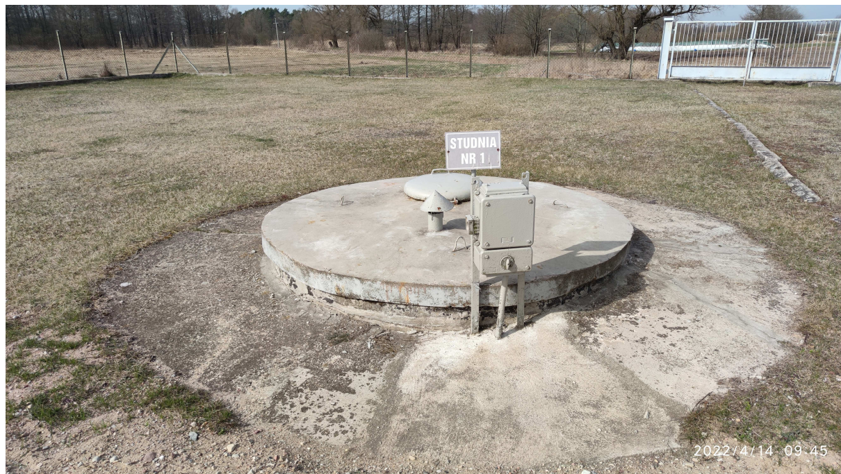
Fot. 7. Obudowa studni głębinowej nr 1
