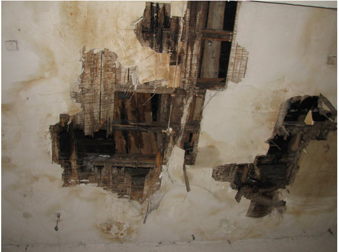
Fot. 7. Widoczne zawilgocenia i uszkodzenia na suficie. Zniszczone belki stropowe.
