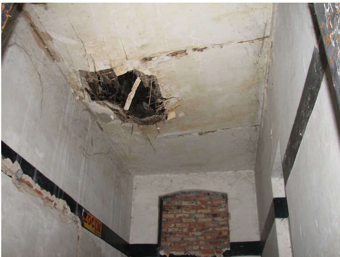
Fot. 14. Widoczne zawilgocenia i uszkodzenia na suficie w pomieszczeniu przy scenie.
