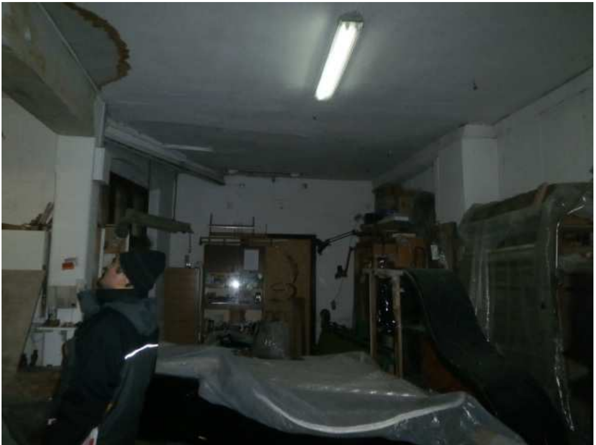
Fot. 27. Widok łącznika od wewnątrz. Widoczne mocne zawilgocenie sufitu.
