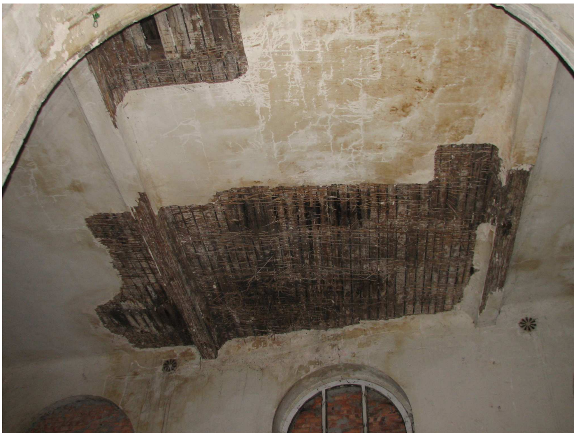
Fot. 9. Widoczne zawilgocenia i uszkodzenia na suficie przy wejściu.
