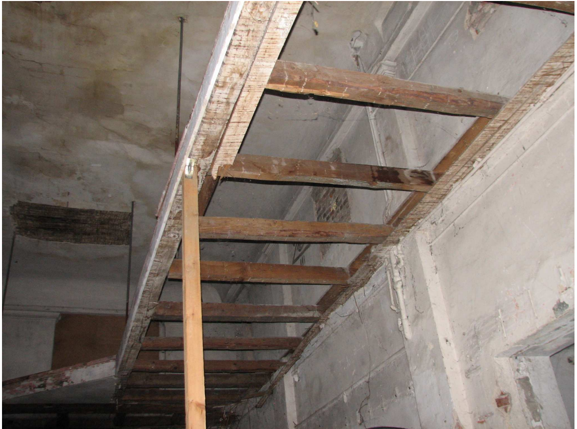
Fot.3. Konstrukcja balkonów bez podłóg i barier. Widoczne zawilgocenia na suficie.
