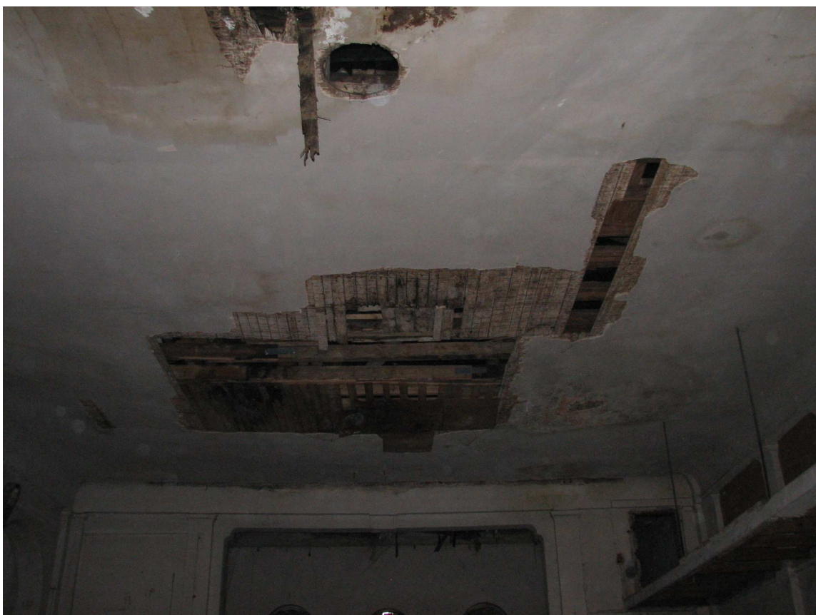
Fot. 10. Widoczne zawilgocenia i uszkodzenia na suficie. Zniszczone belki stropowe.
