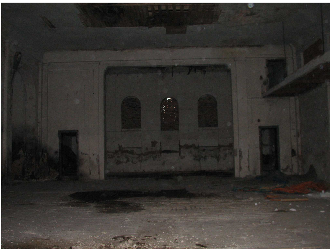
Fot. 12. Widoczne zawilgocenia i uszkodzenia na suficie przy wejściu.
