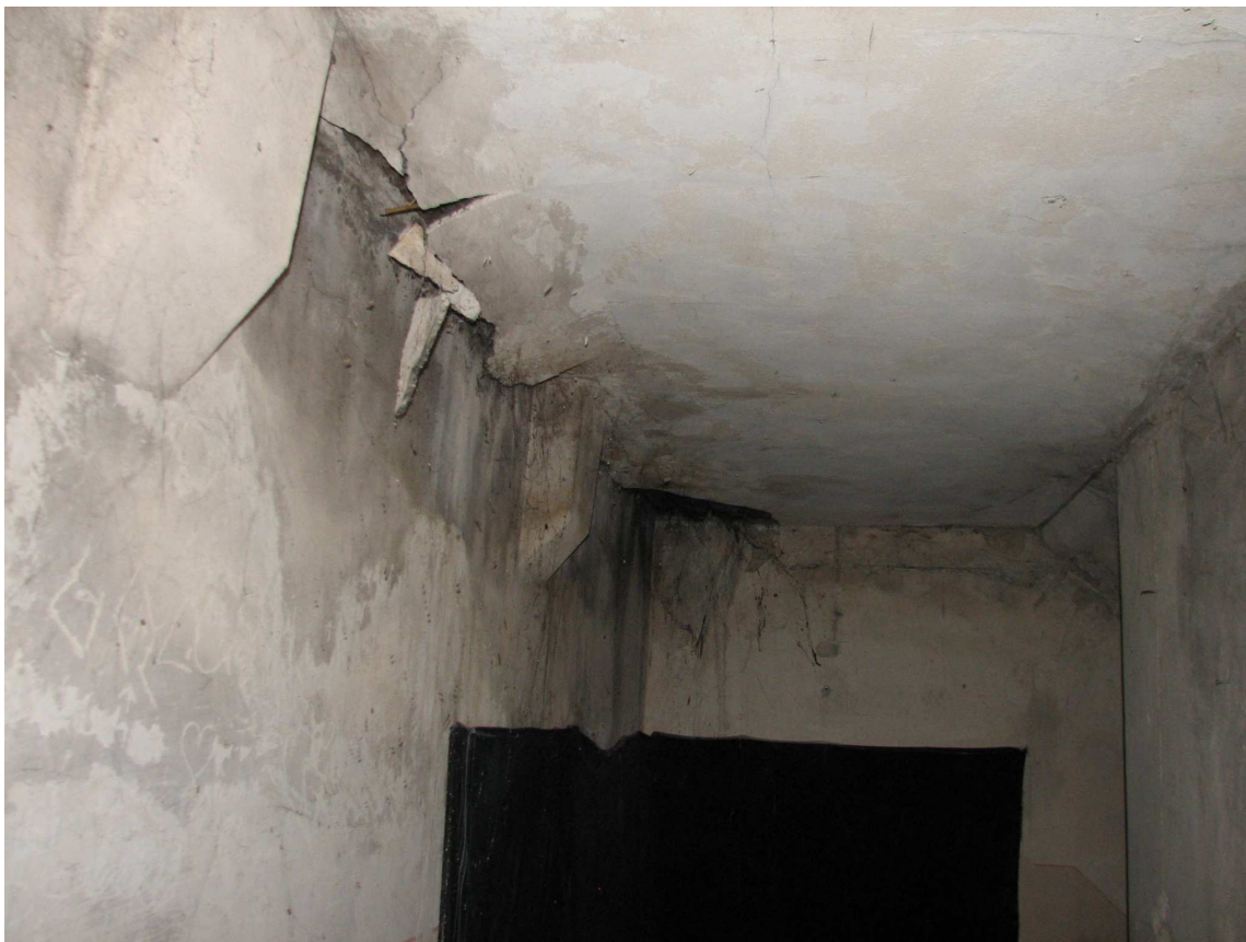
Fot. 11. Widoczne zawilgocenia i uszkodzenia na suficie w korytarzu na piętrze.
