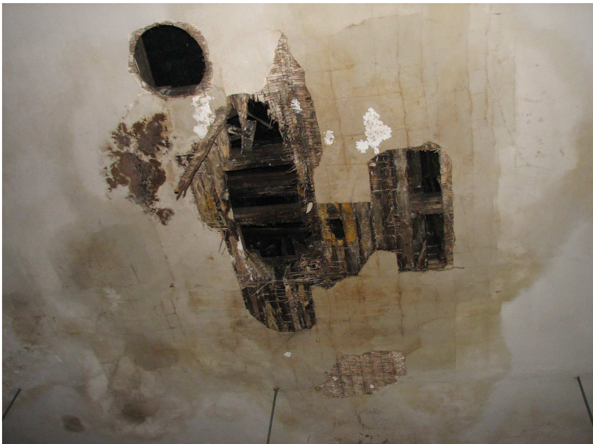
Fot. 8. Widoczne zawilgocenia i uszkodzenia na suficie. Zniszczone belki stropowe.
