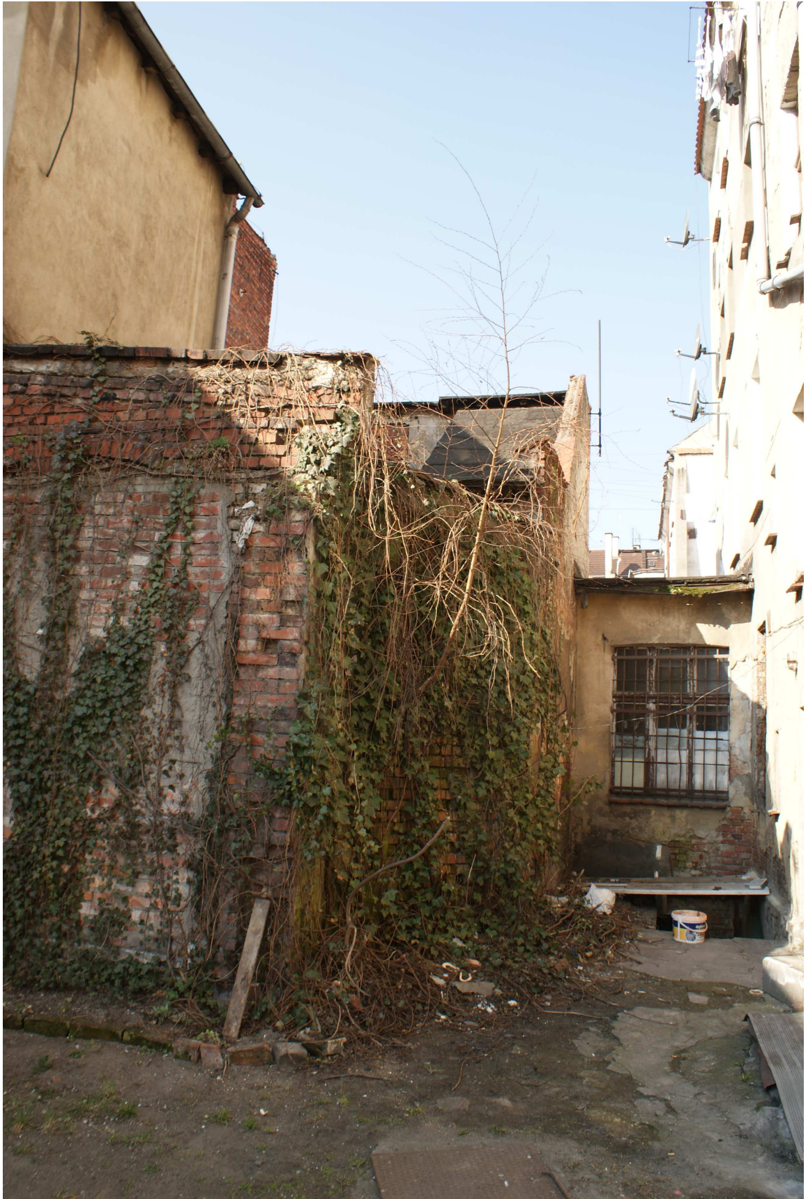
Fot. 25. Widok całego łącznika. Cegły w ścianach mocno uszkodzone. Dachy zniszczone i ciągle w cieniu nie wysychają i niszczeją.
