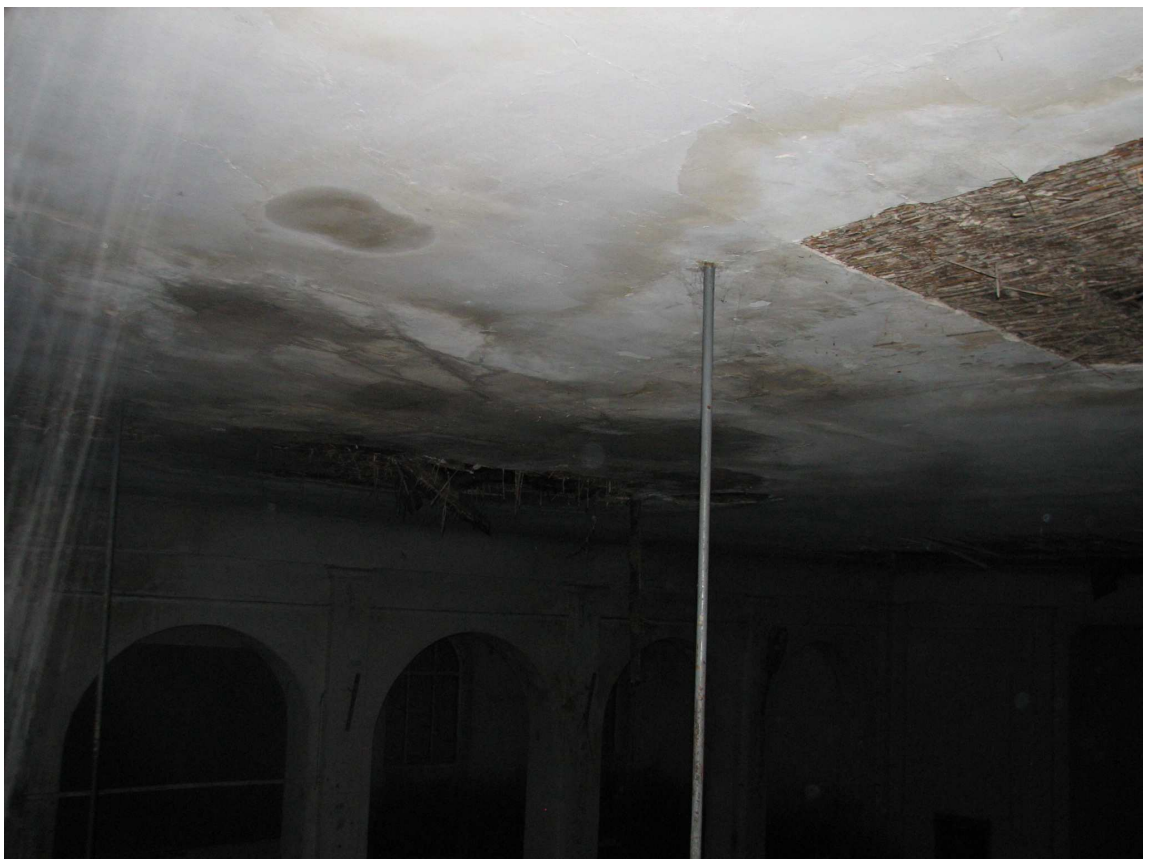
Fot.4. Widoczne zawilgocenia i uszkodzenia na suficie.
