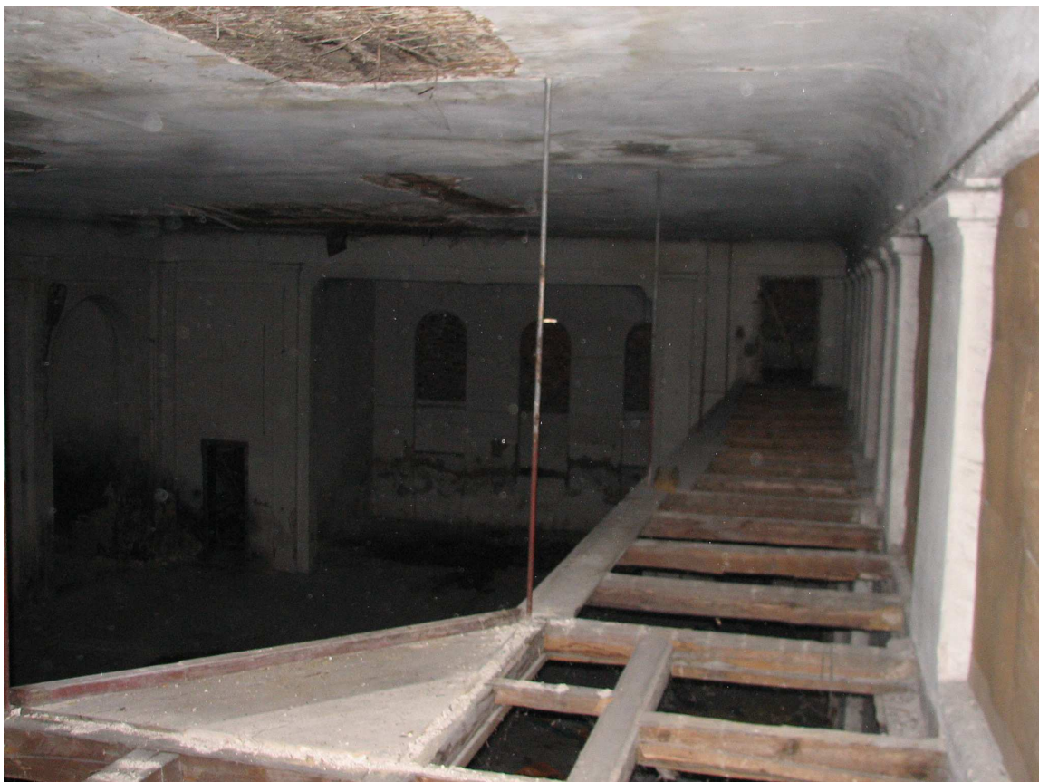
Fot.1. Konstrukcja balkonów bez podłóg i barier. Widoczne zawilgocenia na suficie.
