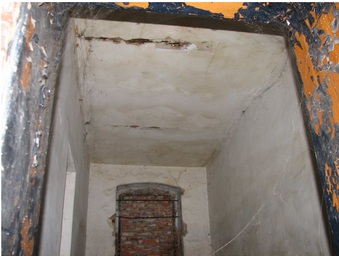
Fot. 13. Widoczne zawilgocenia i uszkodzenia na suficie w pomieszczeniu przy scenie.
