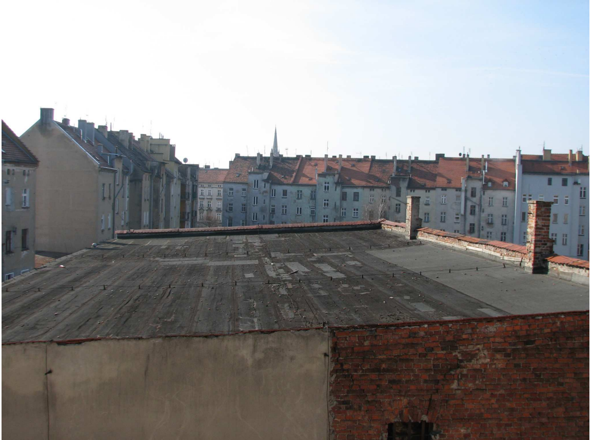
Fot. 22. Dach nad salą główną – widoczne ugięcia i nierówności.
