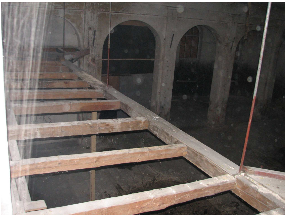
Fot.2. Konstrukcja balkonów bez podłóg i barier.
