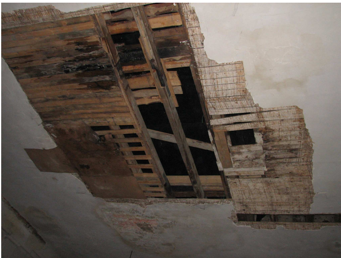
Fot. 6. Widoczne zawilgocenia i uszkodzenia na suficie.
