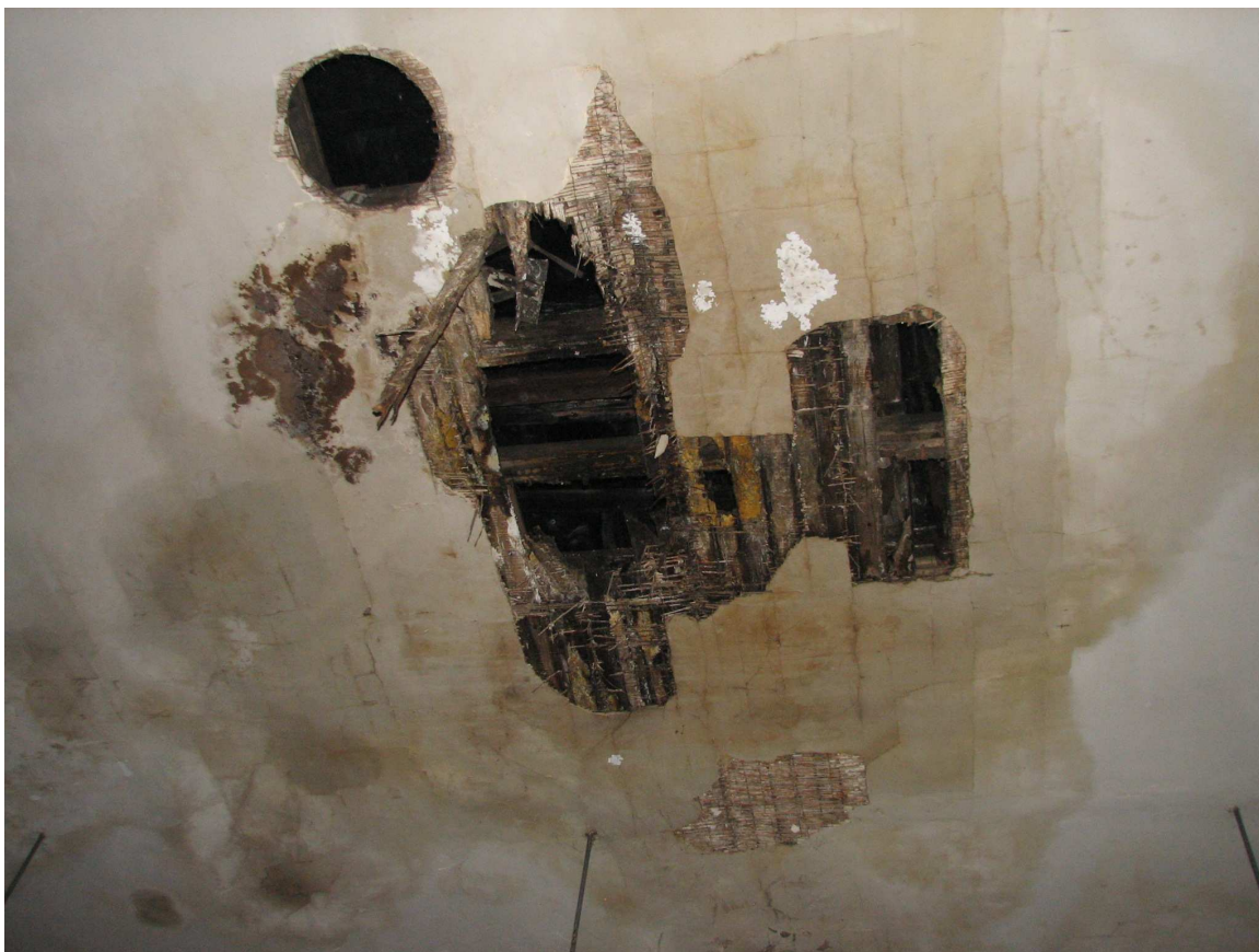
Fot. 5. Widoczne zawilgocenia i uszkodzenia na suficie.
