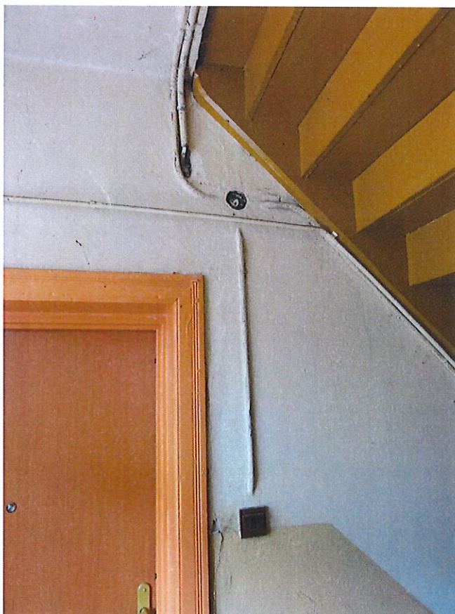
Instalacja elektryczna na klatce schodowej
