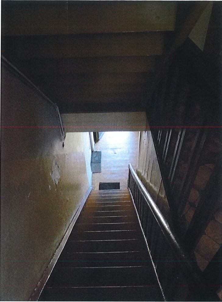
Drewniane elementy klatki schodowej, wysokość między elementami klatki schodowej <200 cm.
