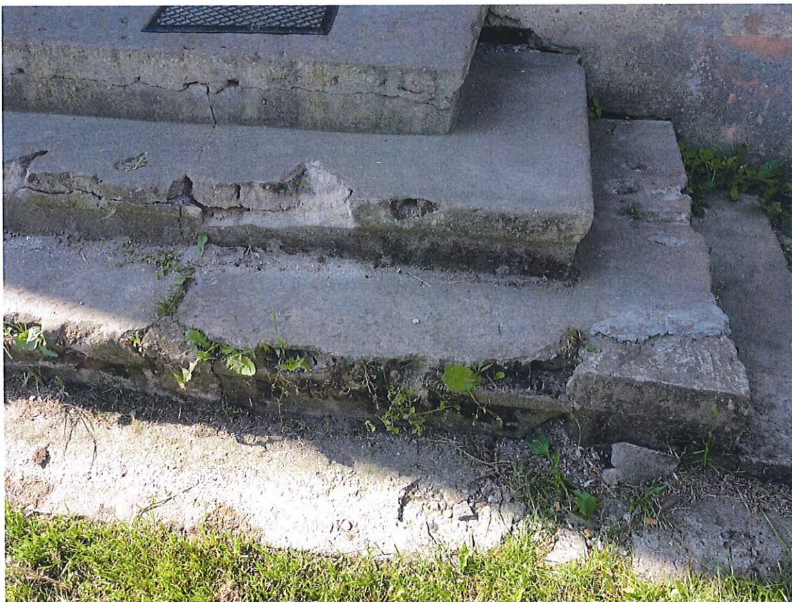
Uszkodzenia schodów wejściowych.
