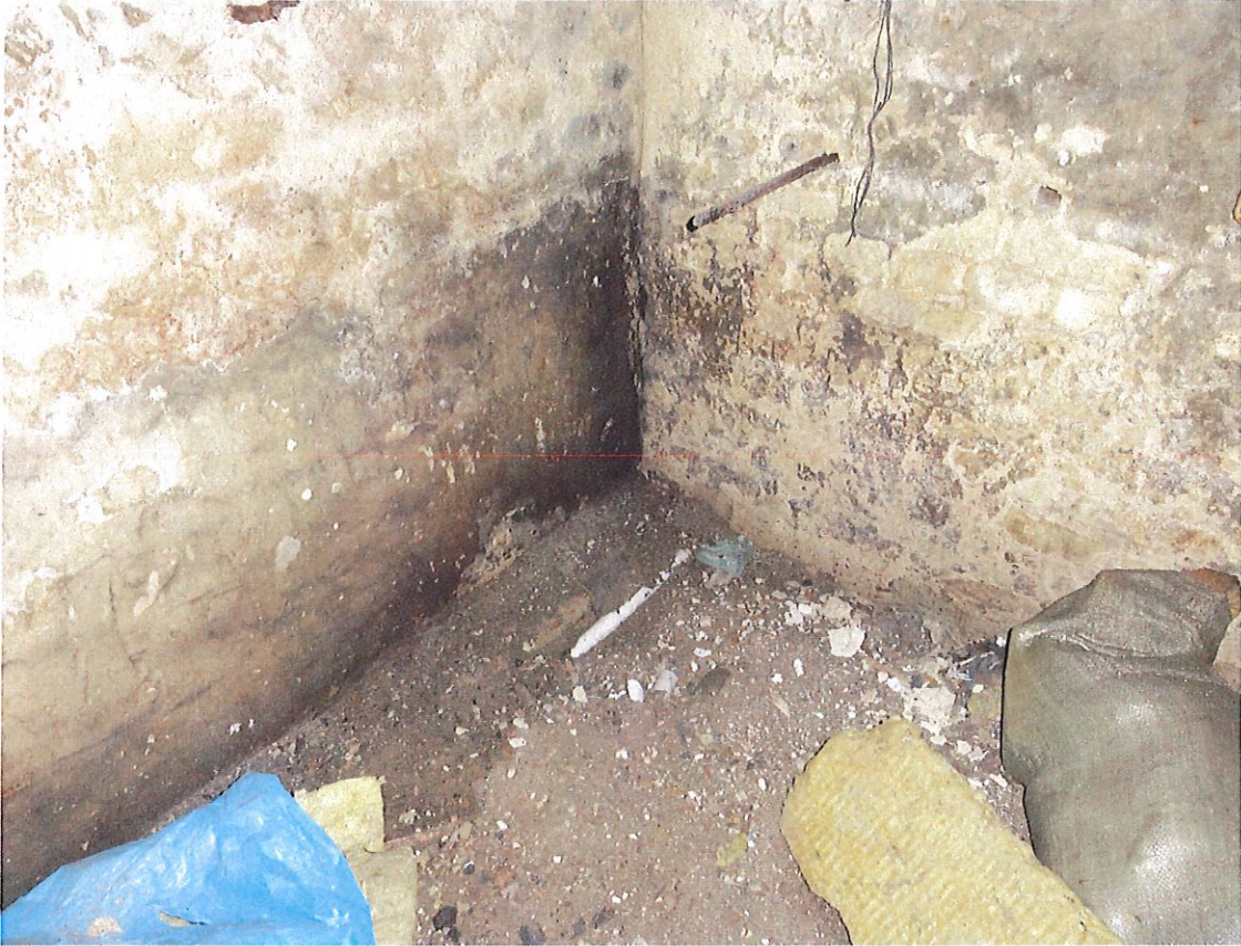
Zawilgocone i zagrzybione mury piwnic.
