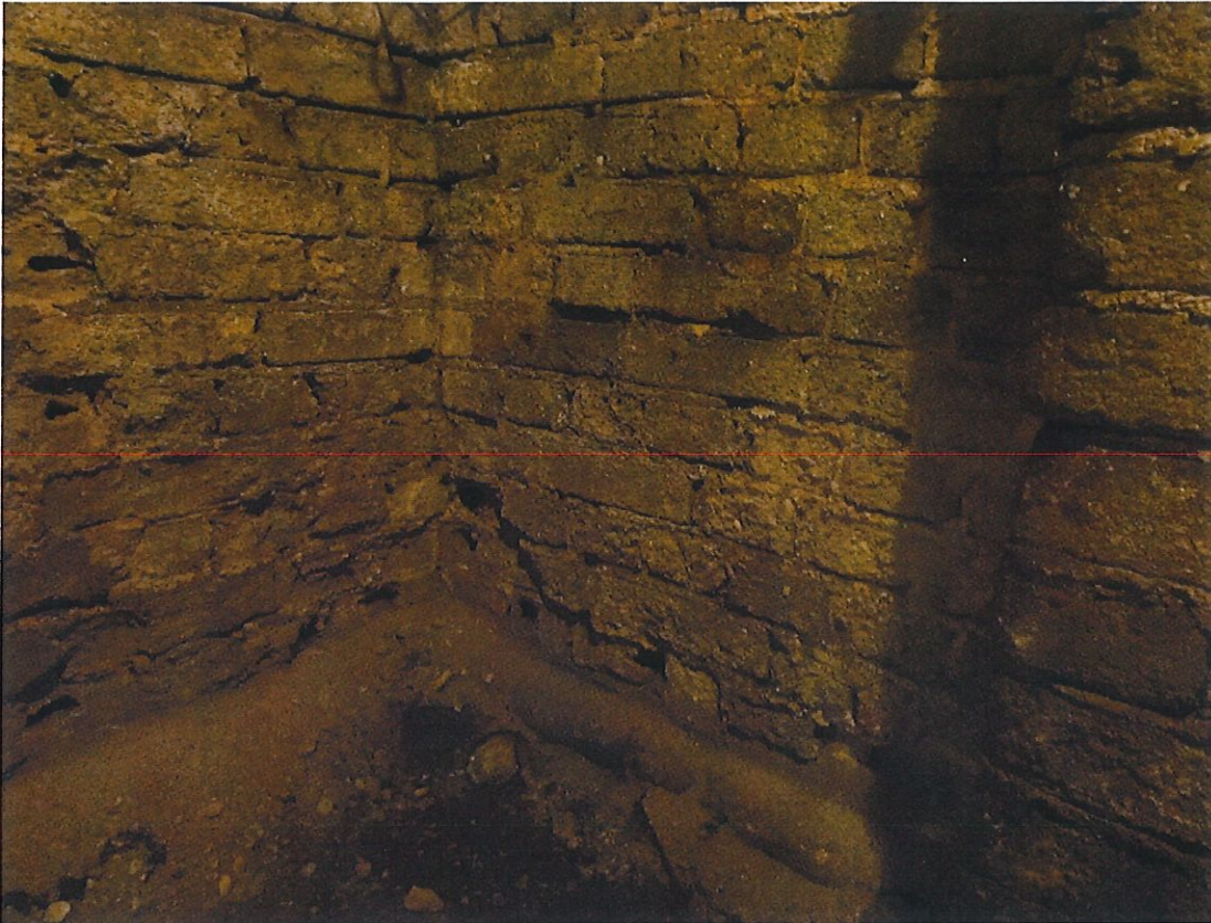
Zawilgocone mury piwnic, naruszona struktura materiału ściennego, wypłukane zaprawy.
