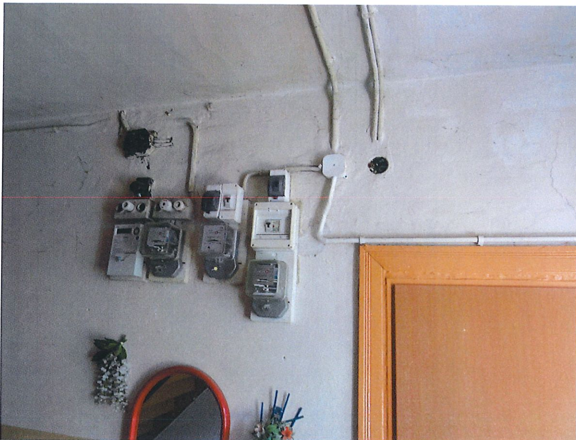
Fragment instalacji elektrycznej w budynku.
