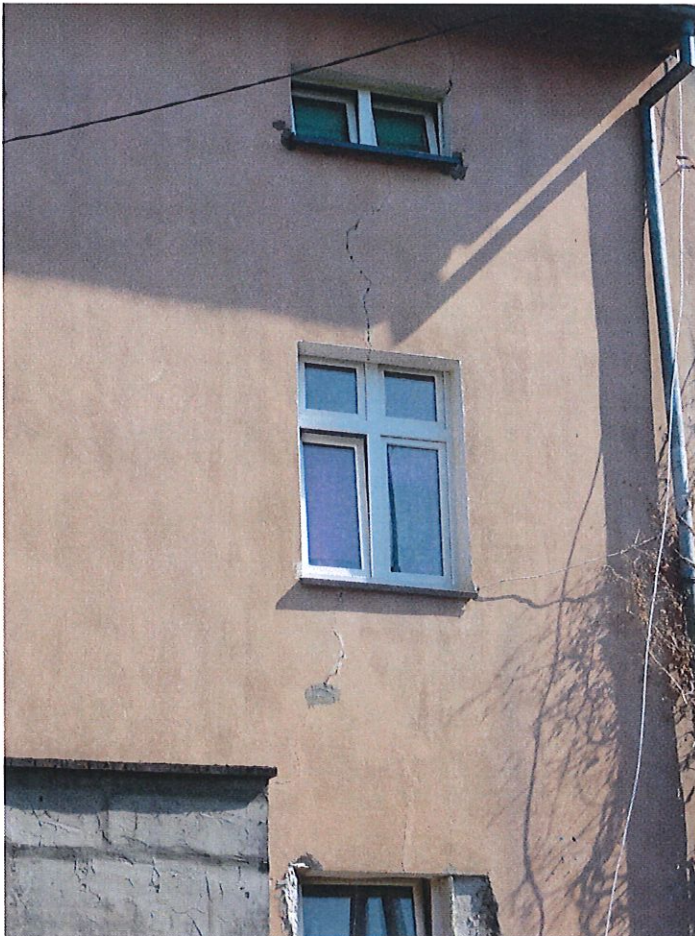
Pęknięcie pionowe ściany przez nadproża otworów okiennych.
