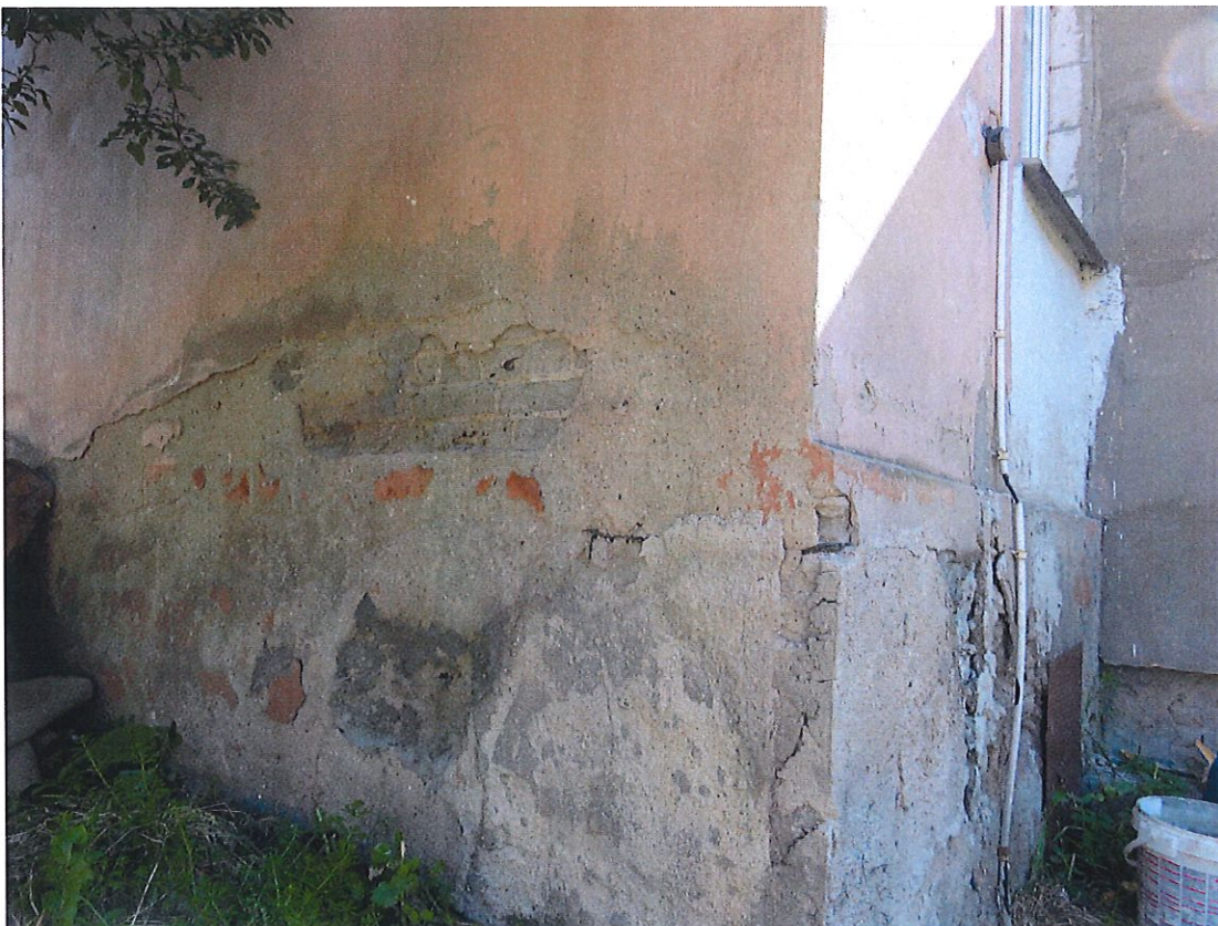
Uszkodzenia i próby naprawy murów w poziomie cokołu.
