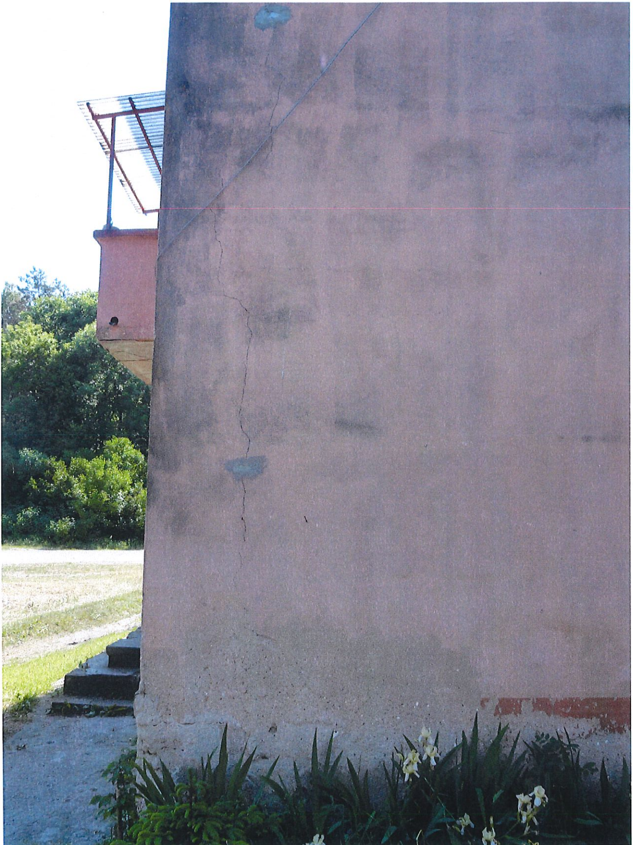
Pęknięcie muru w narożu budynku.
