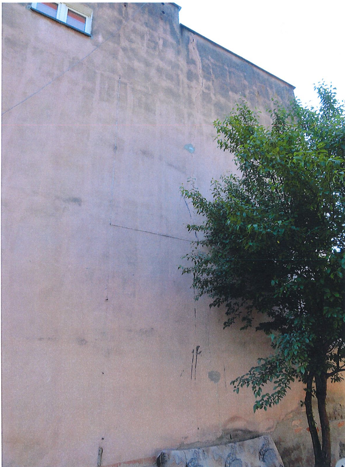
Elewacja boczna, widoczne pęknięcie ściany na całej wysokości budynku.
