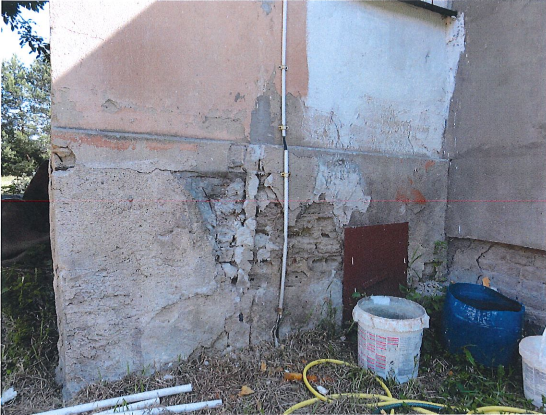
Uszkodzenia, ubytki tynku i cegieł w poziomie cokołu budynku.
