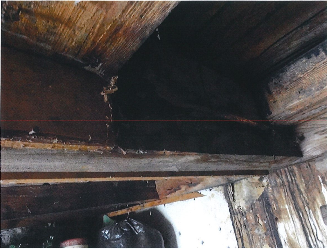
Fragment uszkodzonej konstrukcji dachu.
