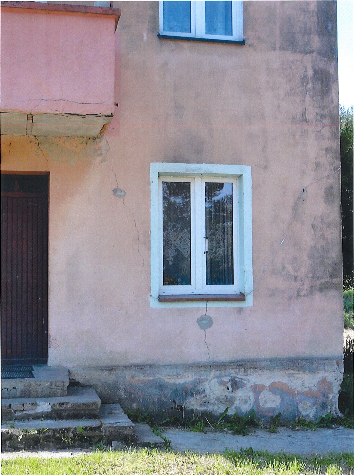
Pęknięcia muru, uszkodzenia płyty balkonowej, ubytki nawierzchni schodów zewnętrznych.
