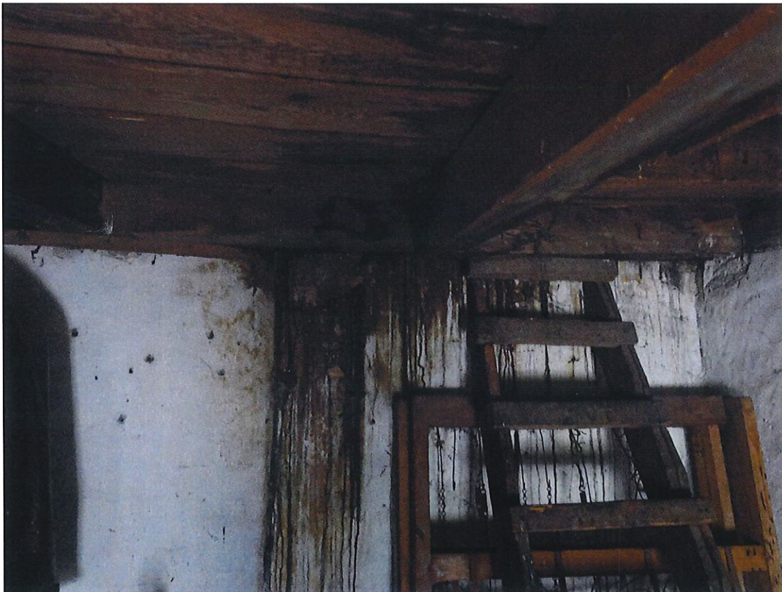
Wejście z poddasza na dach, uszkodzona i naprawiana konstrukcja dachu, zbutwiałe drewno poszycia dachu, zacieki przez nieszczelności obróbek blacharskich przy kominie.
