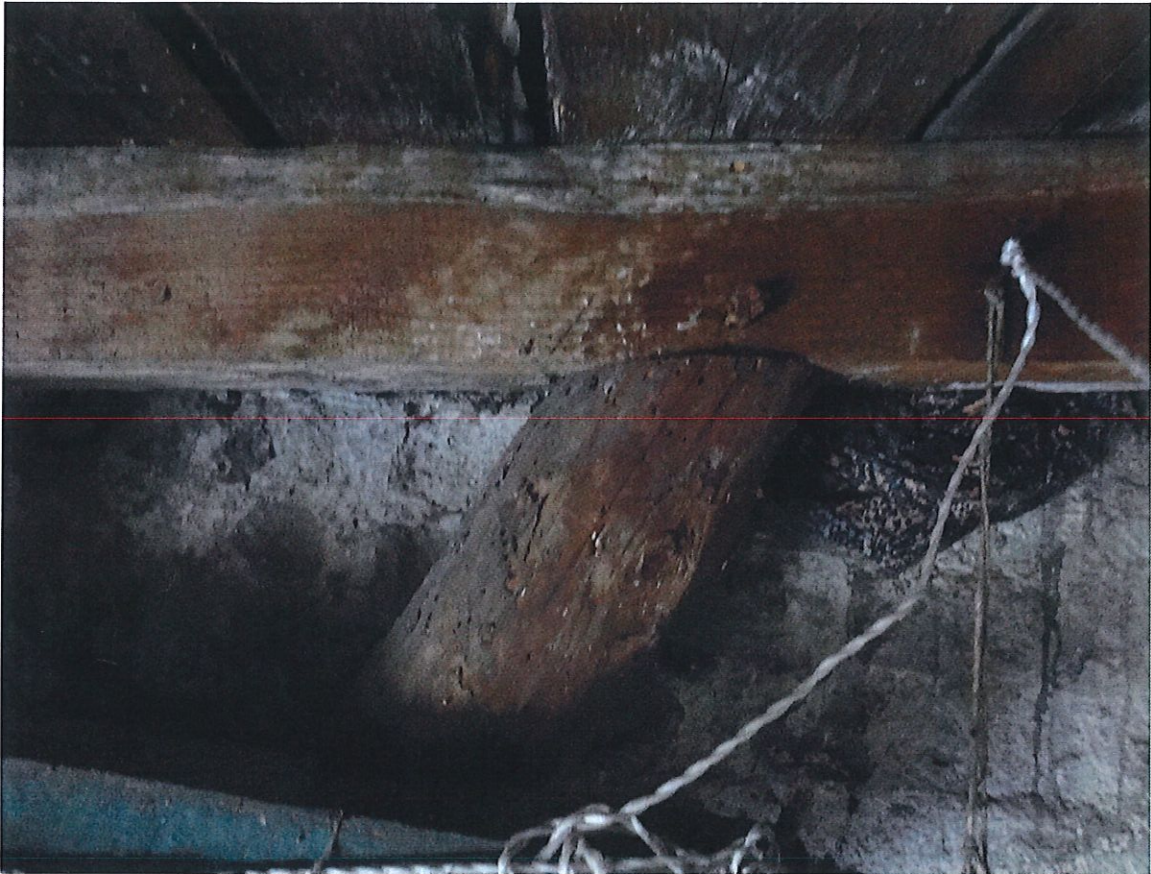
Detal konstrukcji dachu, widoczne uszkodzenia przez owady.
