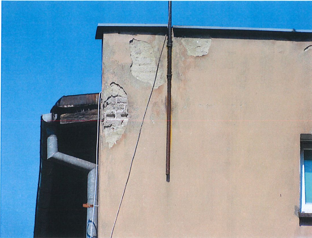
Ubytki tynku i cegieł silikatowych, zmurszałe drewno belek dachowych, skorodowane obróbki blacharskie.
