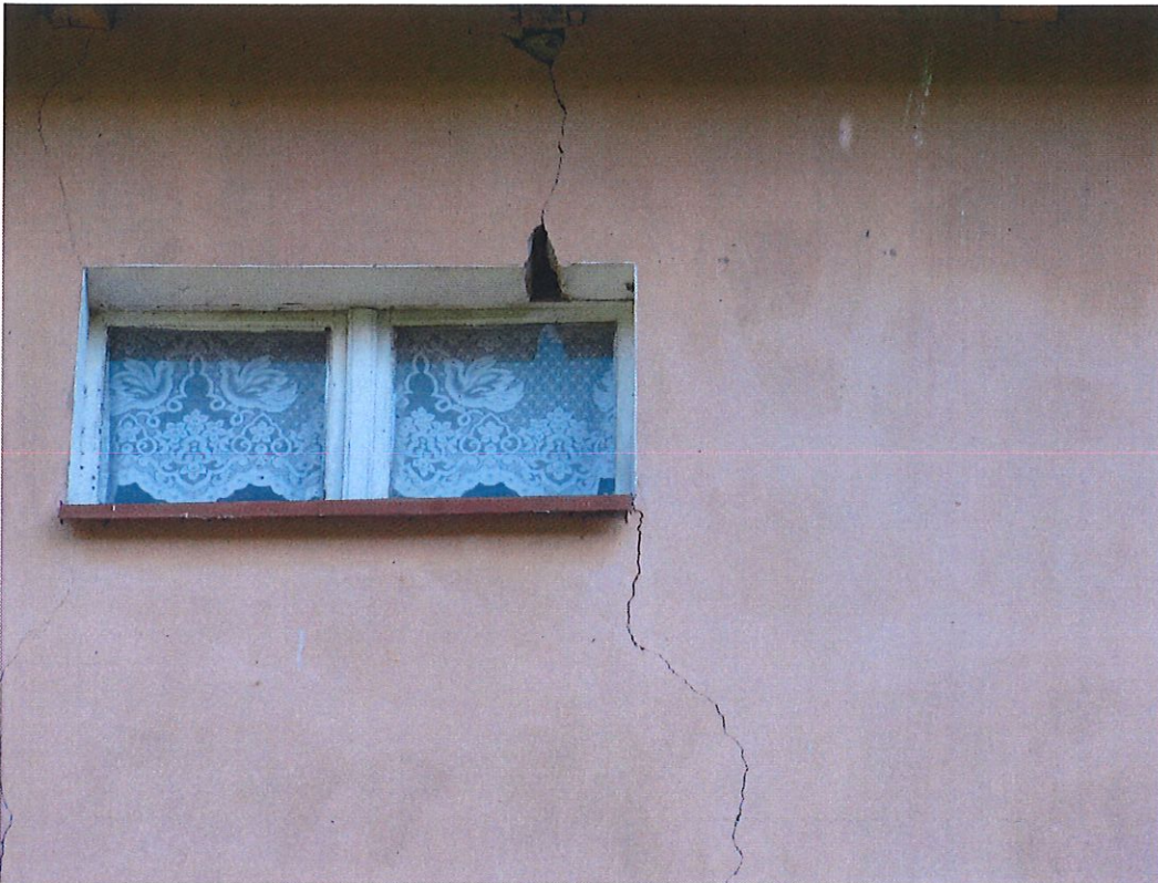
Uszkodzenia muru na poziomie poddasza budynku.
