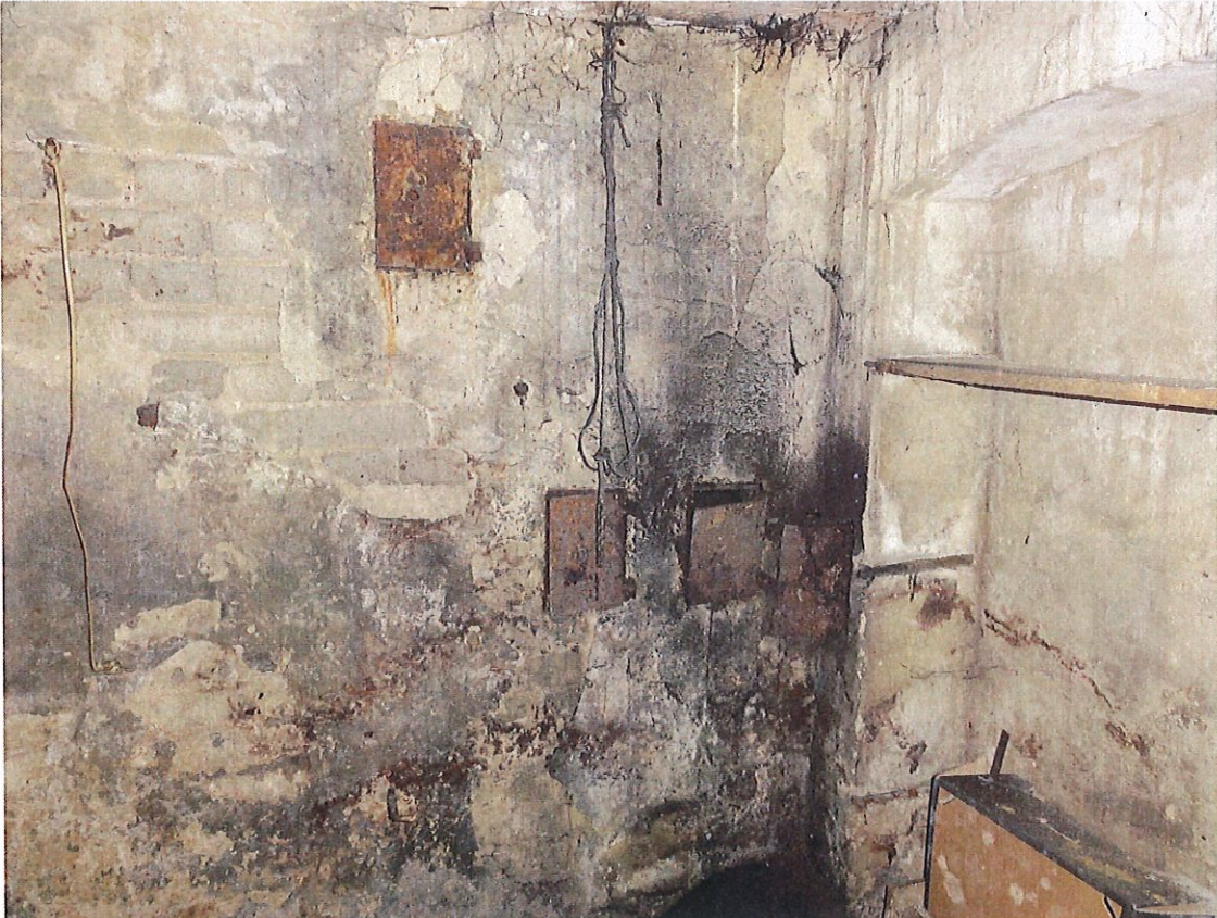
Zawilgocone mury i kominy w poziomie piwnic.
