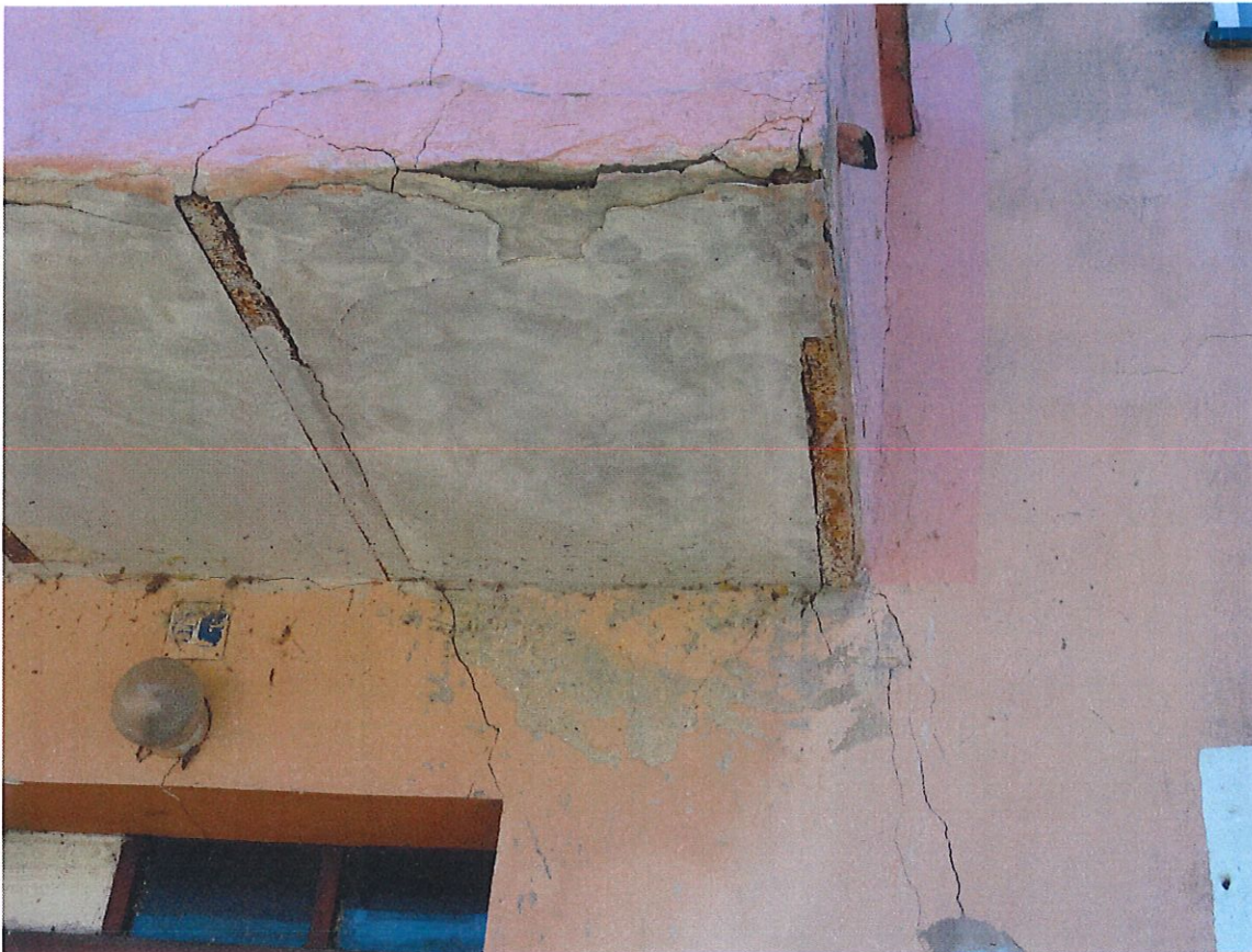
Uszkodzenia balkonu i muru przy drzwiach wejściowych.
