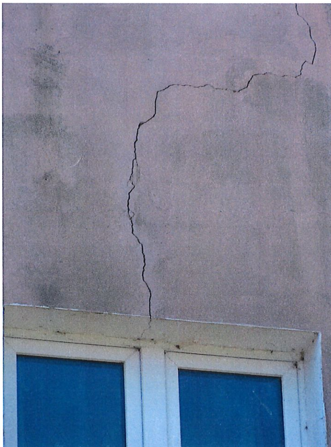
Pęknięcie muru przez nadproże okienne.
