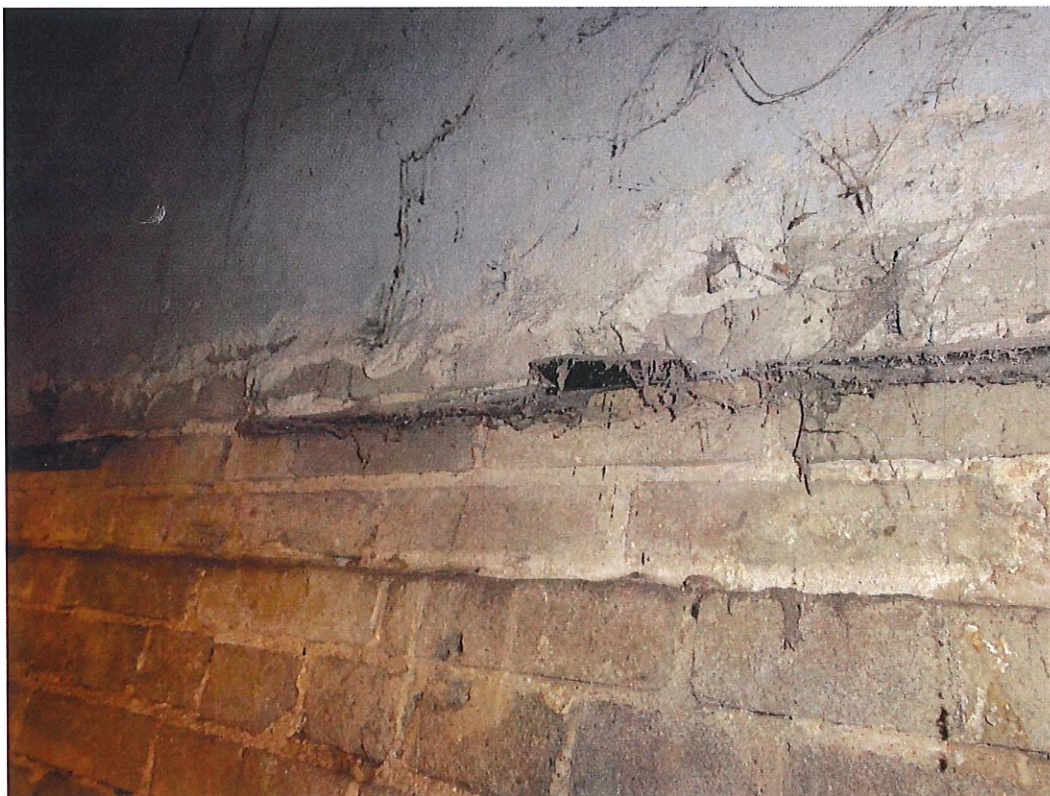
Brak ciągłości izolacji poziomej na murach piwnic.
