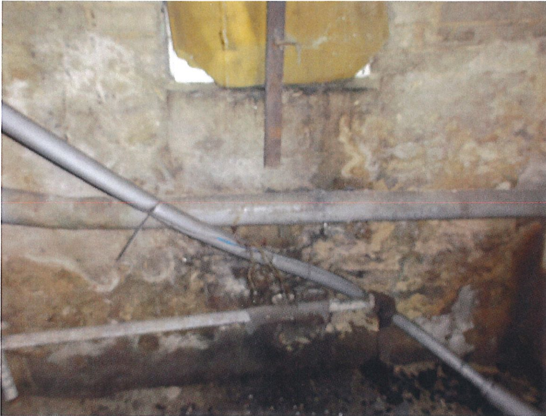
Zawilgocone mury i posadzka piwnic.
