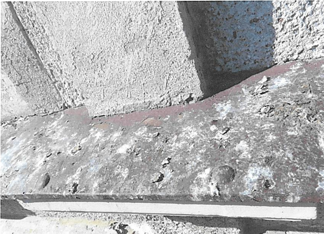
Fot 26 Oryginalna blacharka
