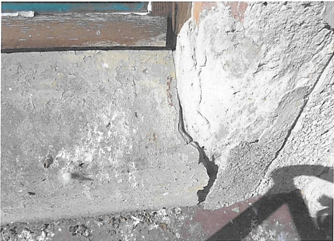
Fot 28 Destrukcja tynku i sztukaterii
