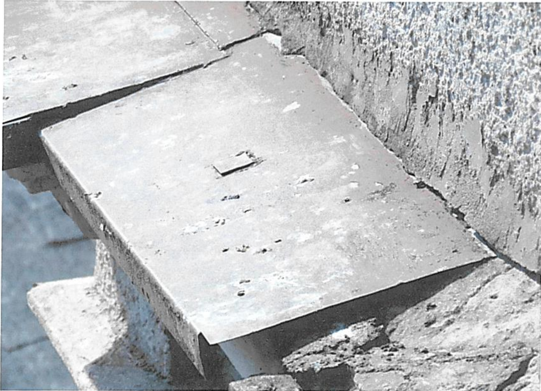
Fot 34 Szczeliny w obróbce blacharskiej i współczesne lokalne naprawy tynku
