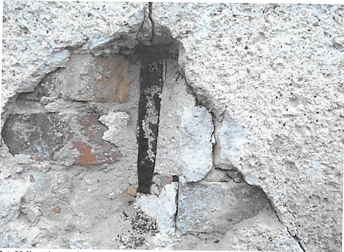
Fot 99 Skorodowane łączniki mechaniczne na spływie wolutowym
