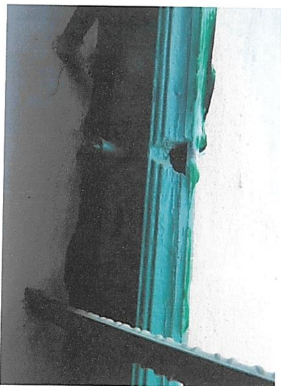
Fot 63 Okno poziom 2 – ubytek szprosu
