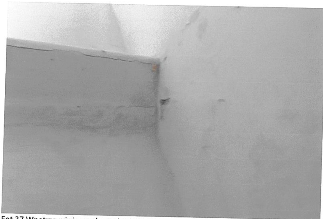
Fot 37 Wnętrze wieży -pod narożem pn- wsch – szczyt , stan zawilgocenia i pokrycie wieloma warstwami z gipsu
