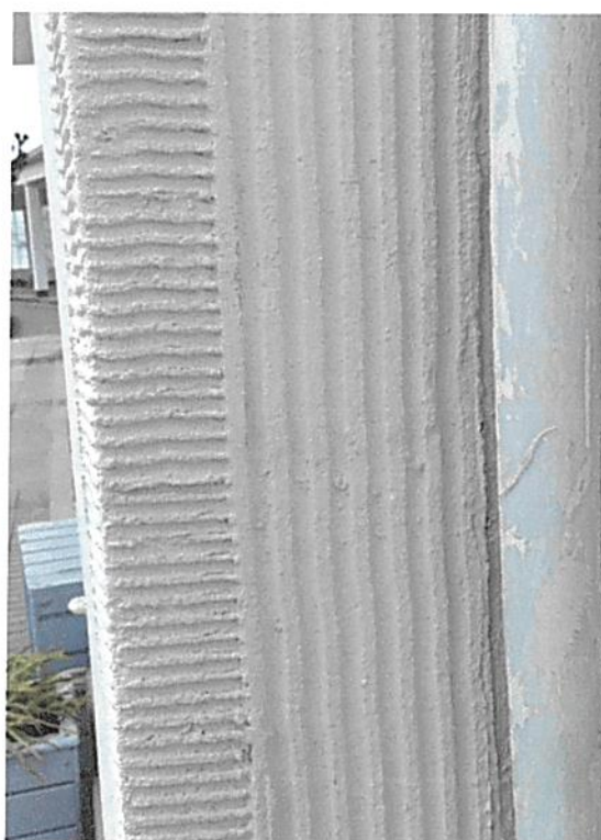
Fot 113 Bramka południowa – ryflowania Wykonane współcześnie w tynku akrylowym
