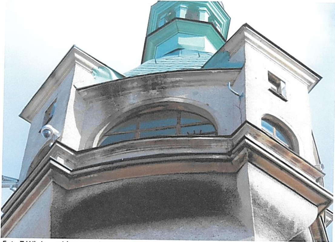
Fot 7 Wieża – widoczne zniszczenia sztukaterii, tynk wtórny i zabrudzenia kopciem
