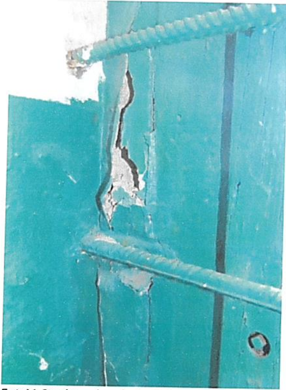
Fot 41 Strukturalna destrukcja tynku przy ościeżnicy okna spowodowana wilgocią
