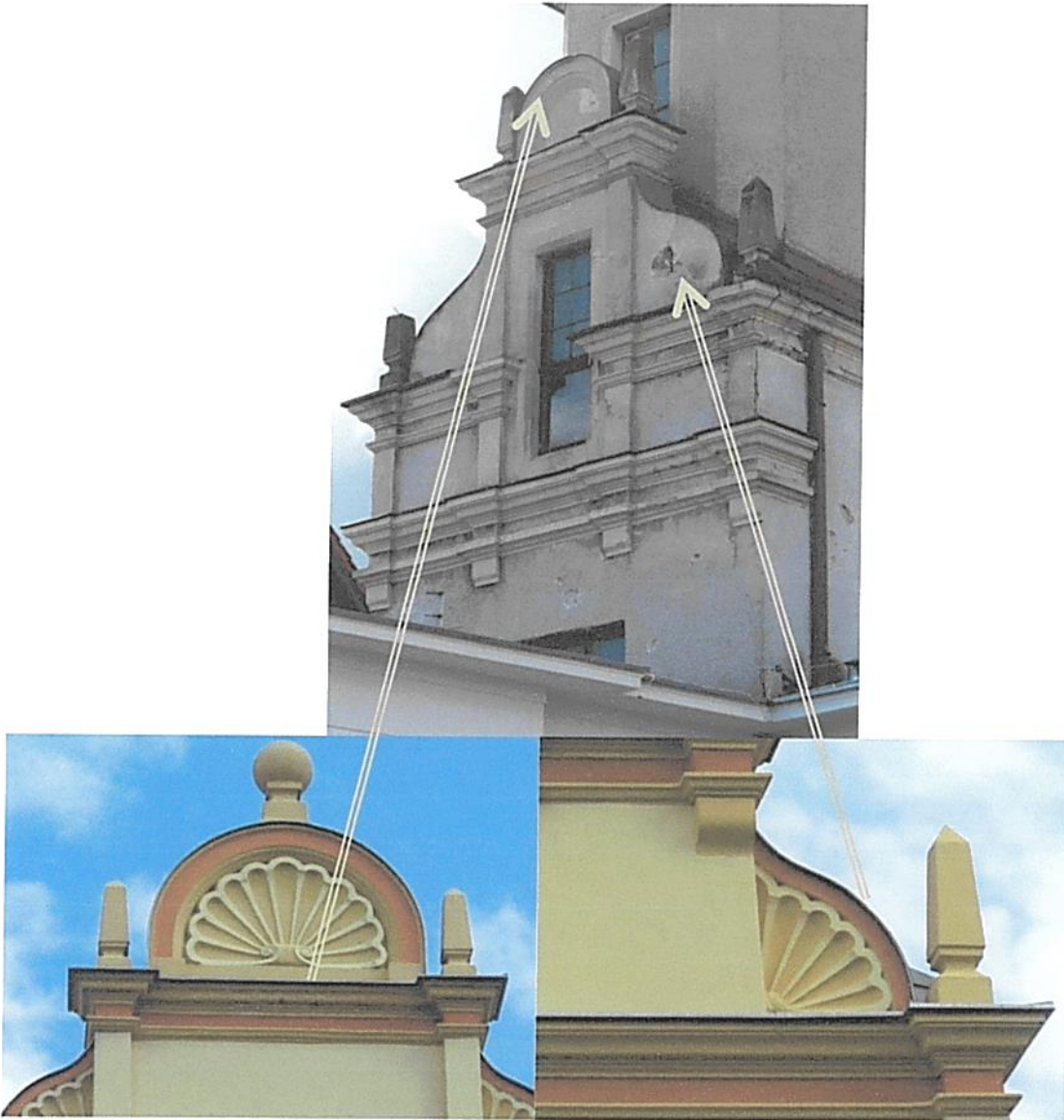
Fot 11 Szczyt , widoczny ubytek detalu w formie wachlarza
