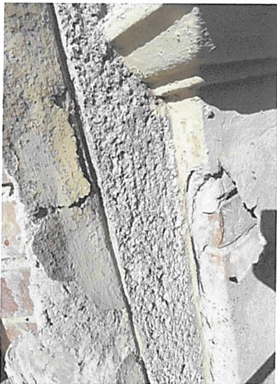
Fot 110 Destrukcja tynku na detalu sztukatorskim – odspojenie od wążku ceglanego
