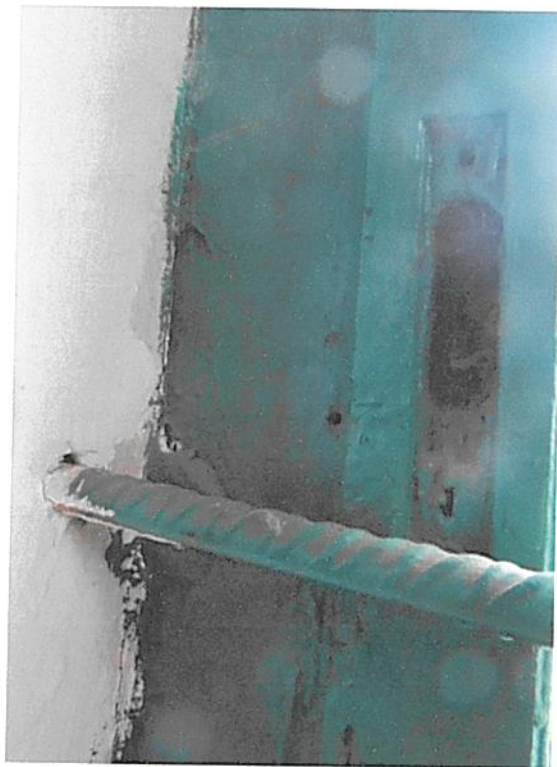
Fot 62 Okno poziom 2 brak okuć ,stan zachowania drewna
