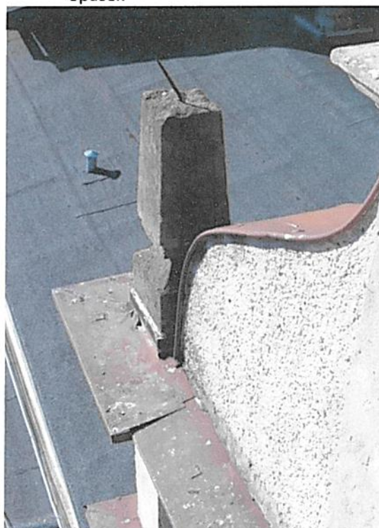
Fot 32 Ubytek części obelisku Szczeliny w obróbkach blacharskich
