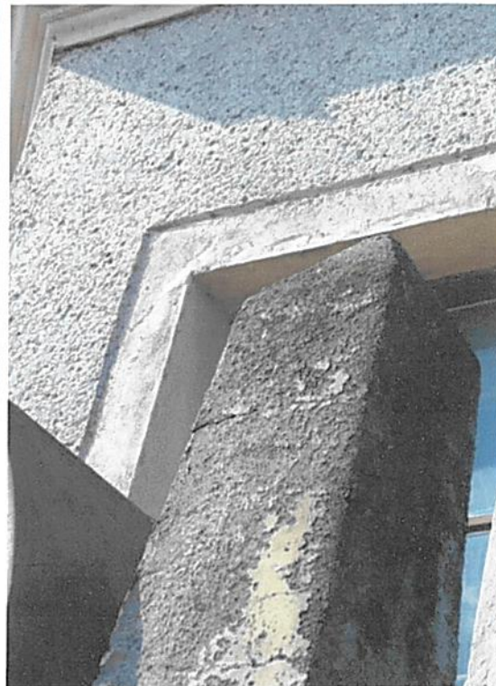
Fot 30 Wtórny tynk wyższy od powierzchni opasek
