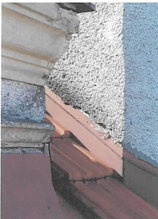
Fot 31 Brak szczelności na linii blacharka – tynk
