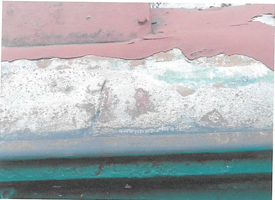
Fot 35 Wieża, parapet – rezultat złych remontów z lat 70-tych – malatura położona na okapie i wadliwej blacharce
