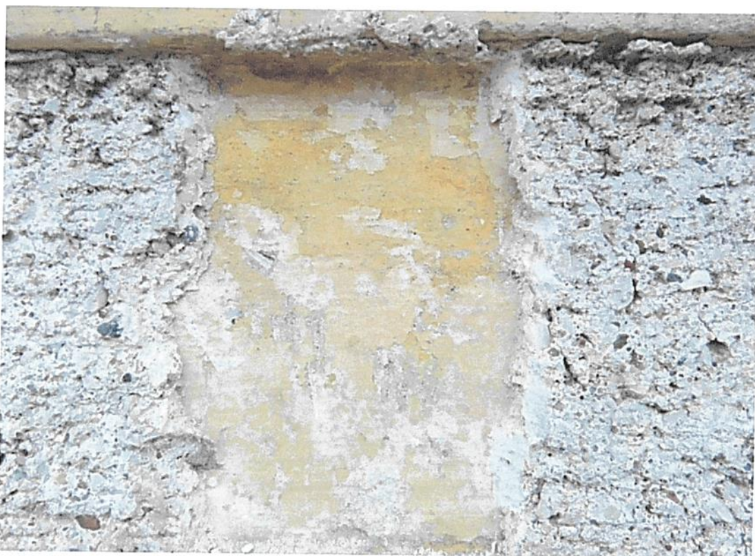
Fot 93 Gzyms, odkrywka stratygraficzna , widoczny współczesny gruby fakturalny tynk
