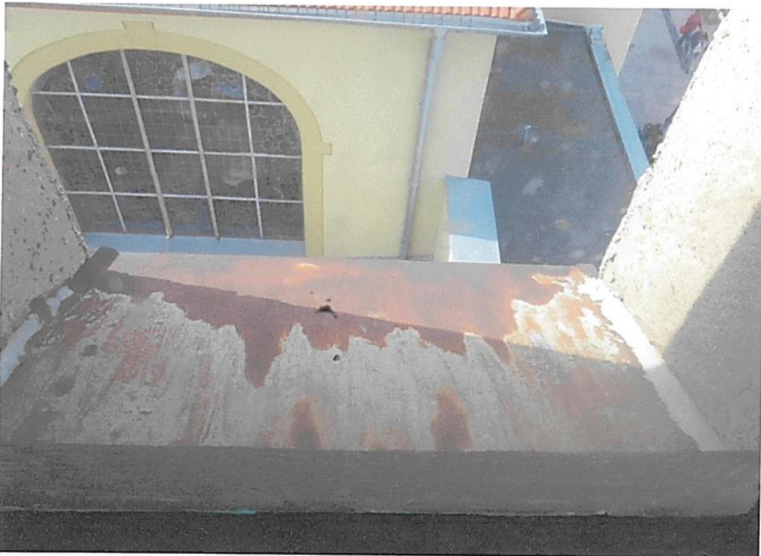
Fot 46 Wieża Wtórna skorodowana blacharka ( ocynk)
