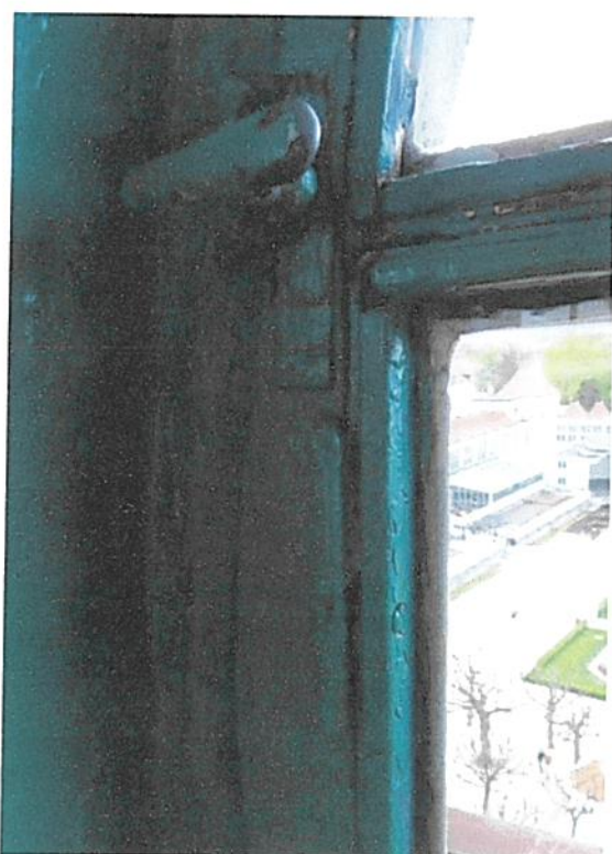
Fot 83 Mechanizm zamykający – okno po 1945
