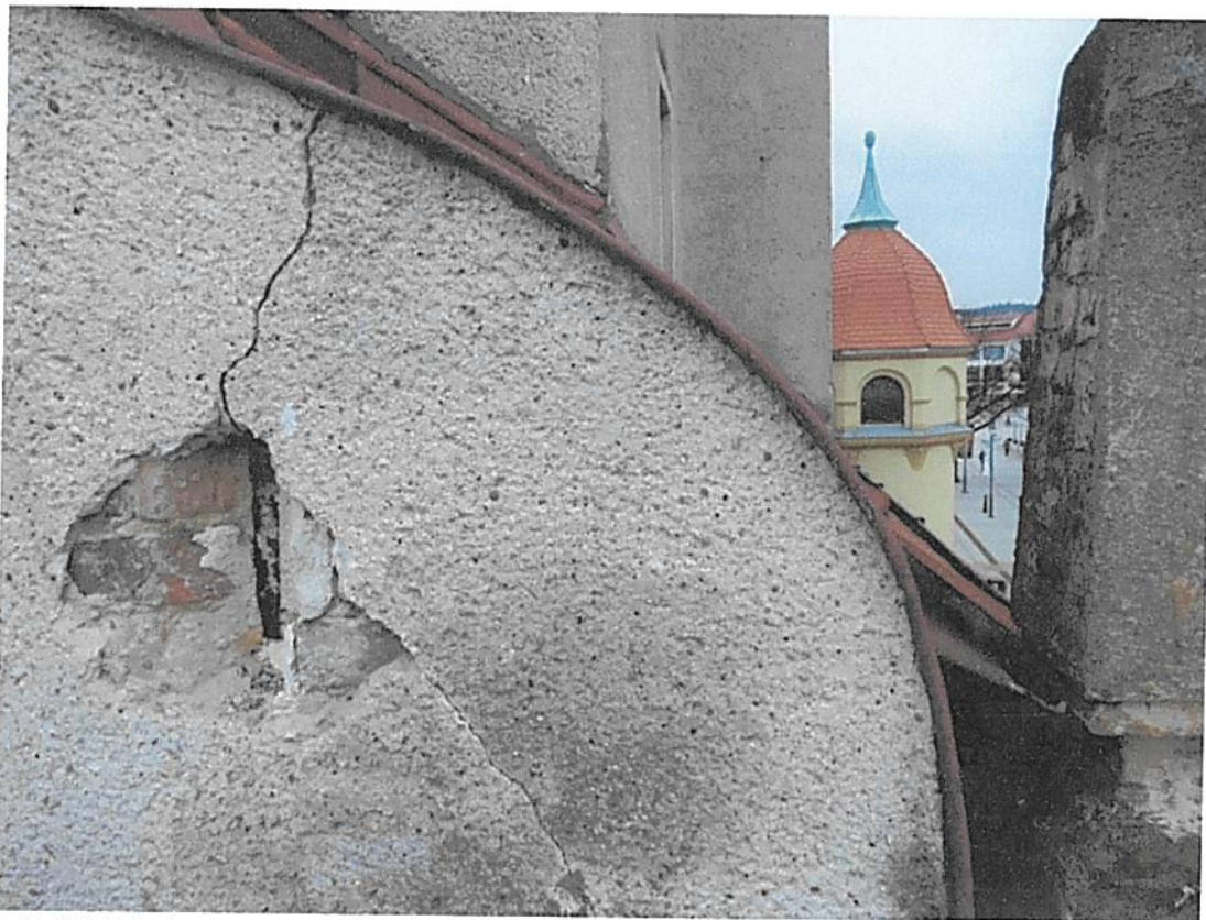
Fot 100 Pęknięcia na spływie wolutowym
