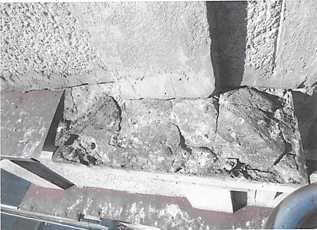
Fot 17 Destrukcja detalu wywołana ubytkiem blacharki
