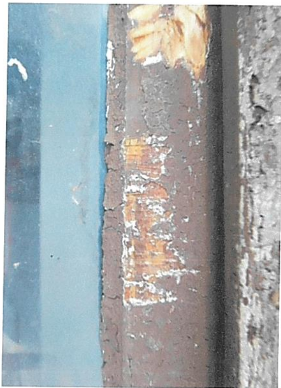
Fot 92 Odkrywka na ramie okna – kolor jasnobrązowy
