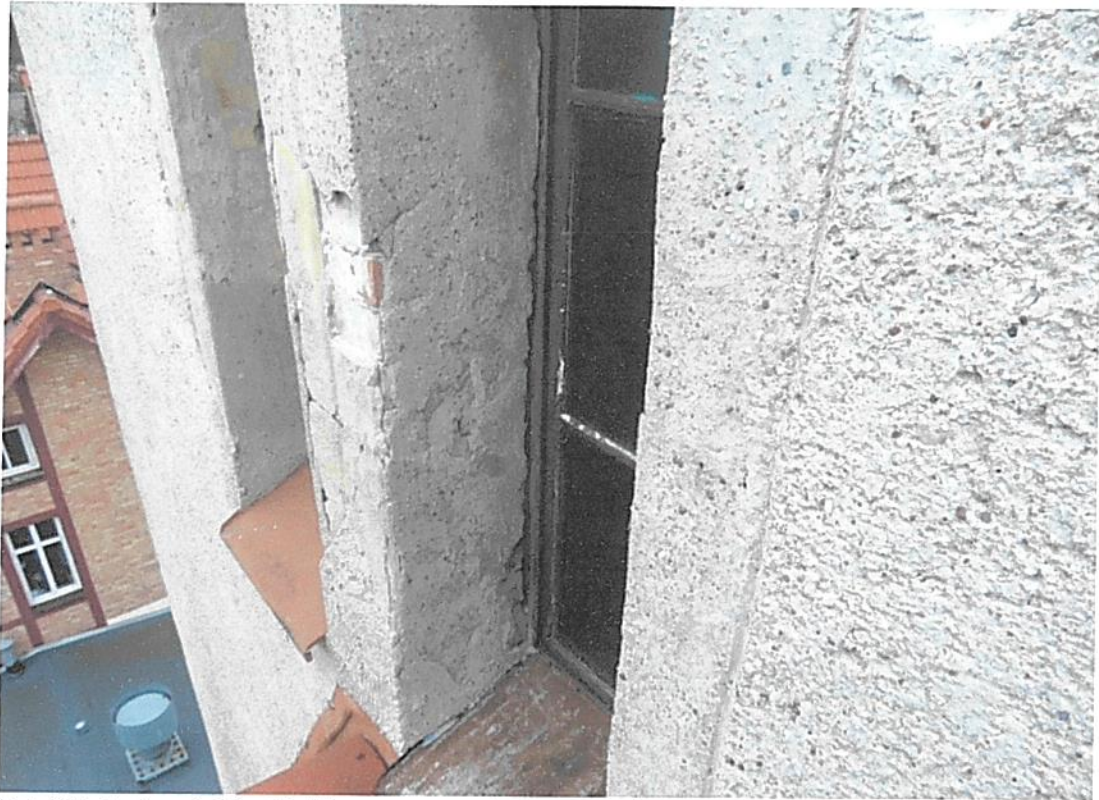
Fot 106 Poziom 6. Wnęki okienne ze zerodowanym tynkiem
