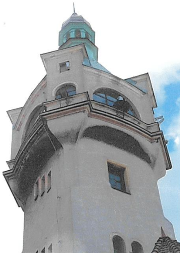
Fot 6 przebarwienia od kopca
