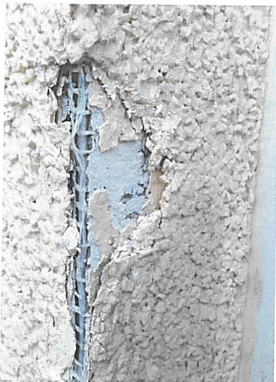
Fot 114 Budynek parterowy narożny – współczesne naprawy i styropian
