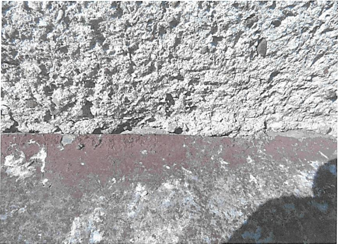
Fot 27 Ślady wykonywania tynkowania bez wymiany blacharki
