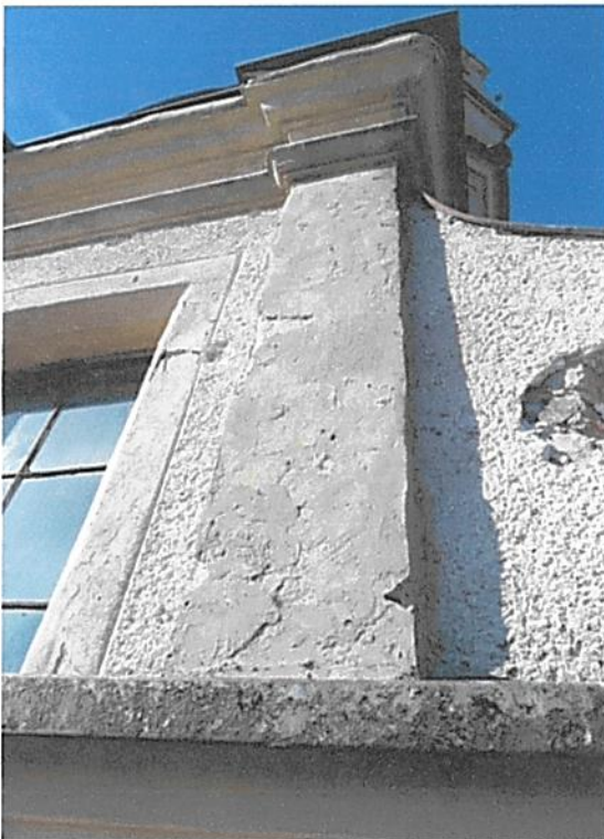
Fot 19 Stan zachowania sztukaterii – liczne kity i ubytki
