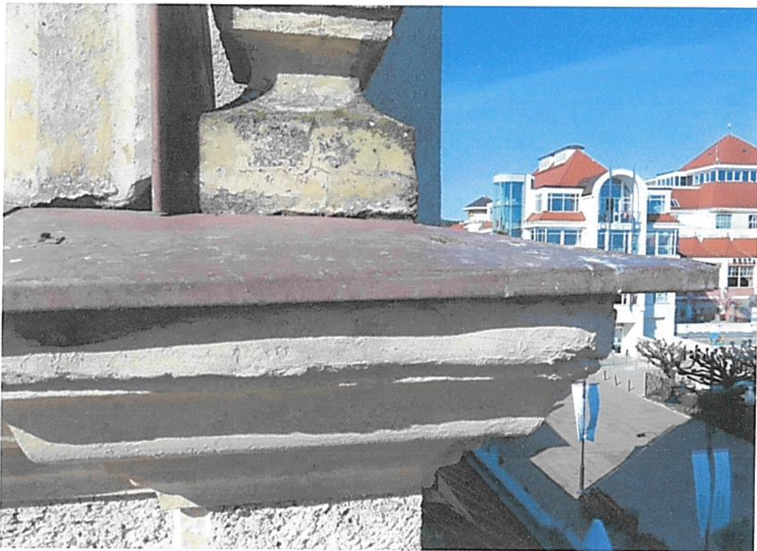
Fot 15 Stan zachowania sztukaterii , widoczny niewielki spadek blacharki
