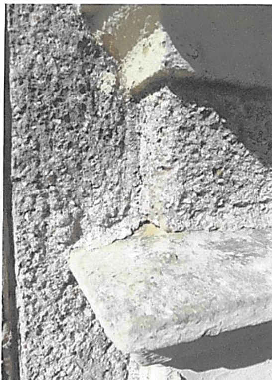
Fot 1111 Widoczne wtórne naprawy pograżające detal
