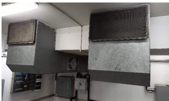
Zdjęcie nr 6 – wyrzutnie z pomieszczenia agregatów chłodniczych
