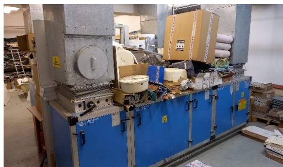
Zdjęcie nr 7 – wentylatory obsługujące pomieszczenie agregatów
