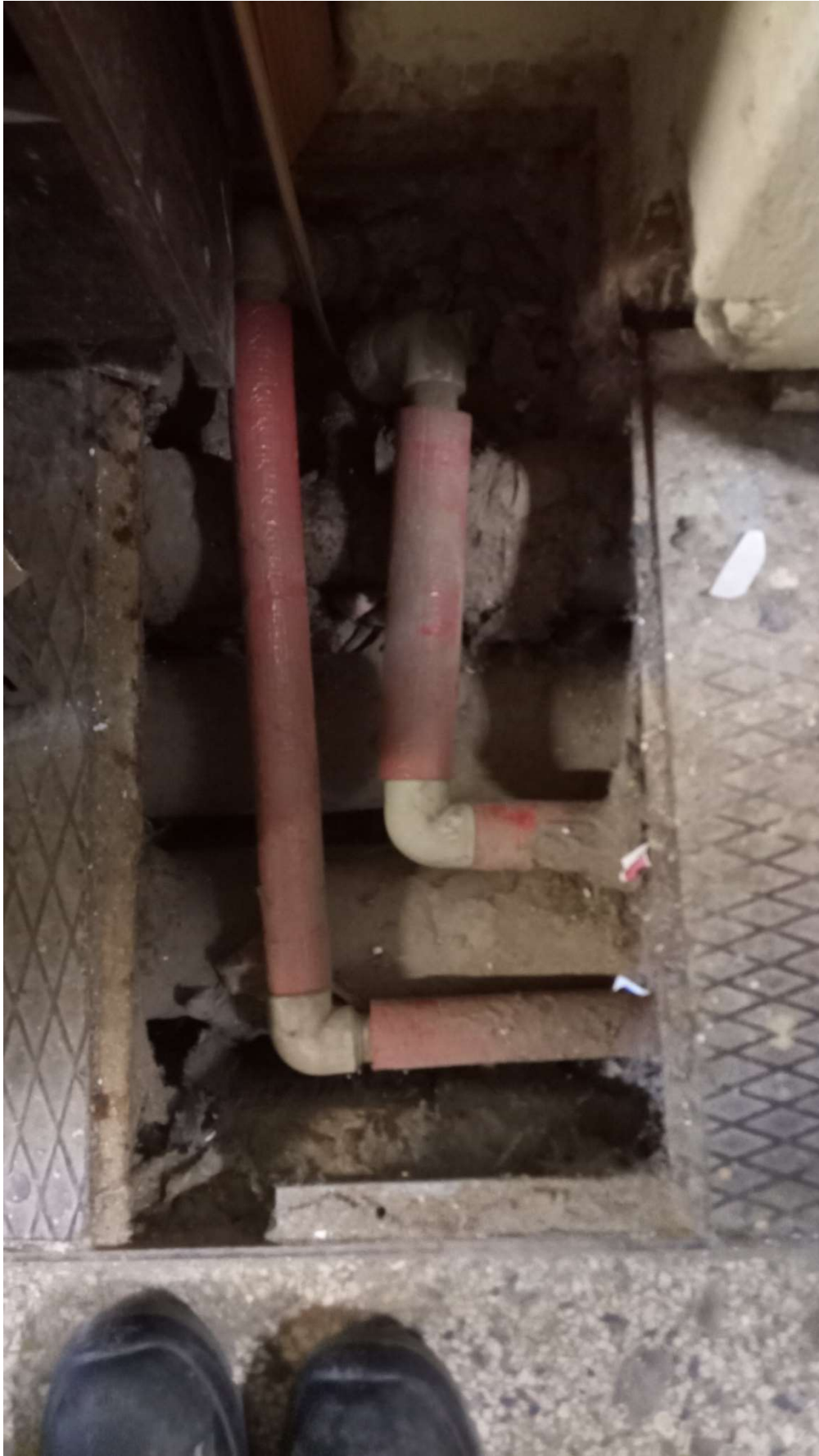
Rysunek 2 – widok kanatu technicznego (wspólnego dla instalacji CO i wodociągowej) w podłodze piwnicy
