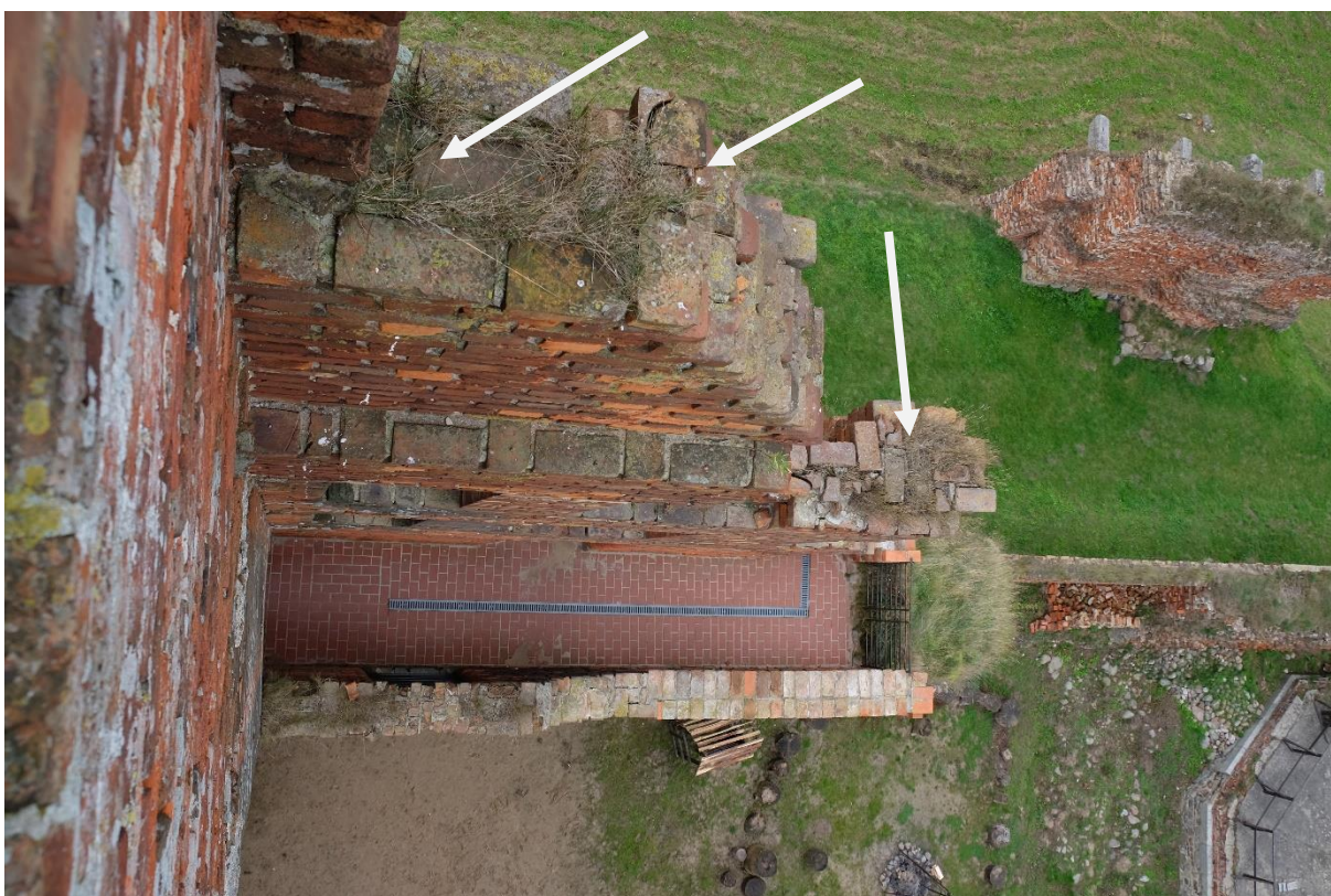
Fot.5, Rys 4 Zamek w Radzynie Chełmińskim , korona do renowacji nad murem zachodnim ganku zach.-płd ,Legenda z zakresem Prac konserwatorskich -IX Etapu 2022. ,. Fot R Gazda,2021
