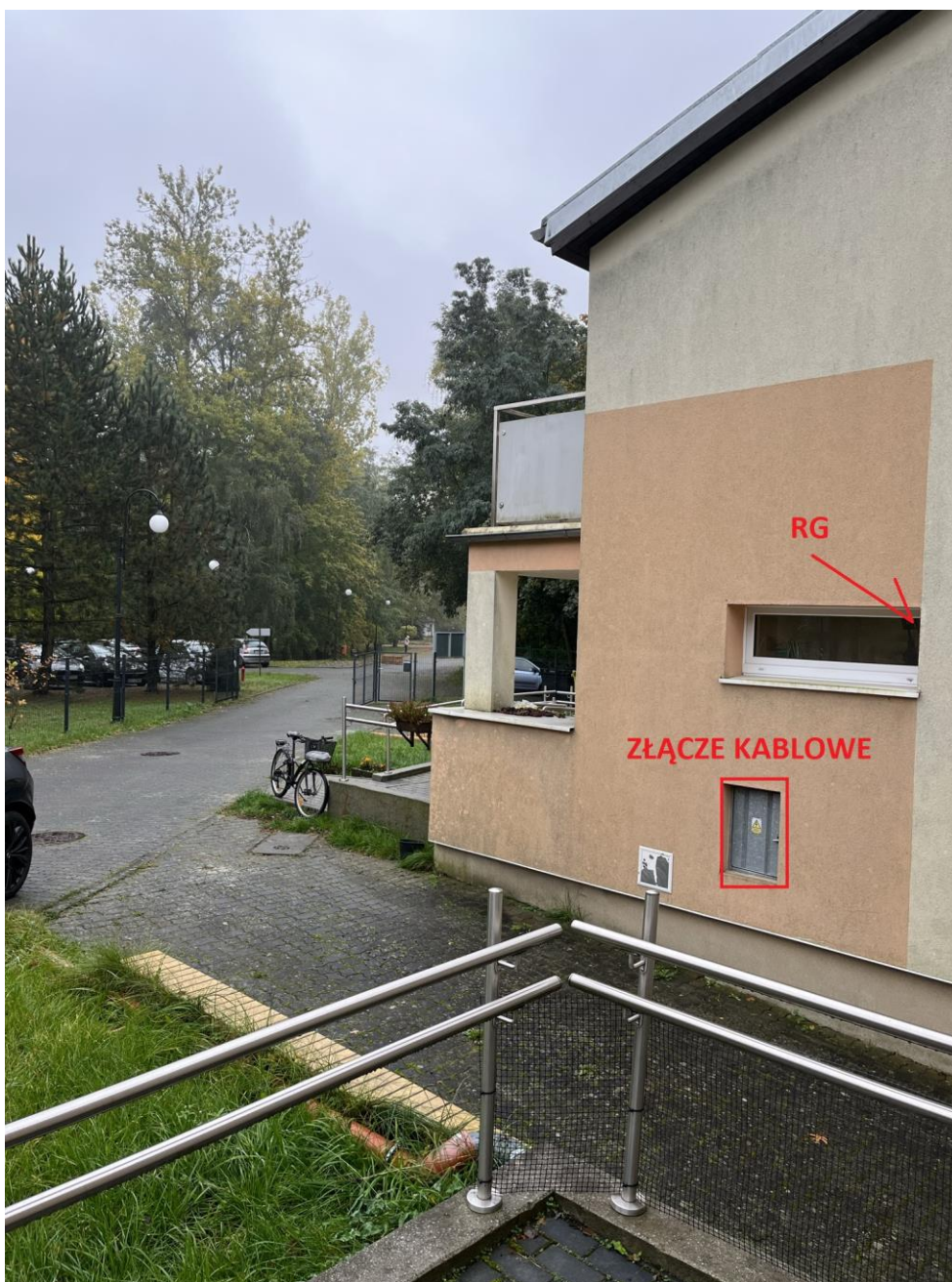
Rys. 5 Złącze kablowe lokalu mieszkalnego
