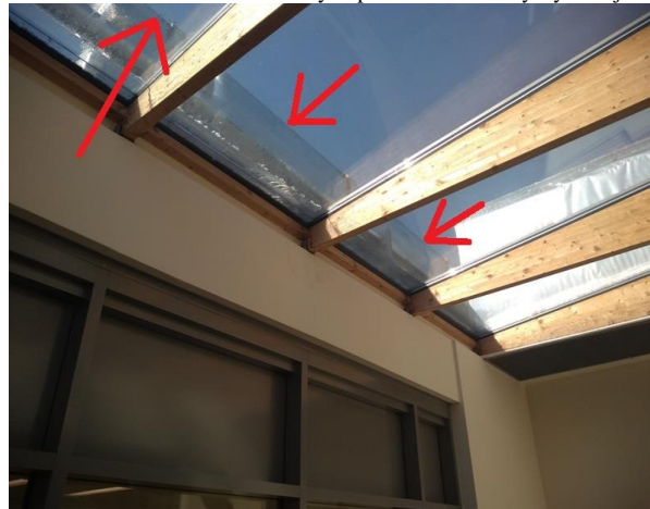
fot.1.10 Widoczna kraw d wody w przestrzeni mi dzyszybowej
