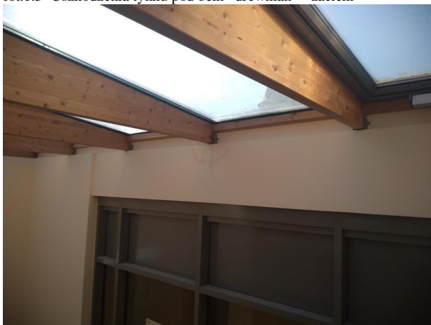
fot.1.3 Uszkodzenia tynku pod belk drewnian - zacieki
