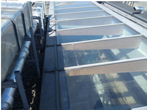
fot.1.11 Widoczne ludy wody (osad) w przestrzeni pomi dzy szybami
