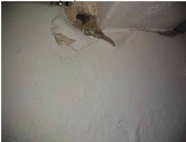
fot.1.5 Uszkodzenia tynku pod belk drewnian - zacieki
