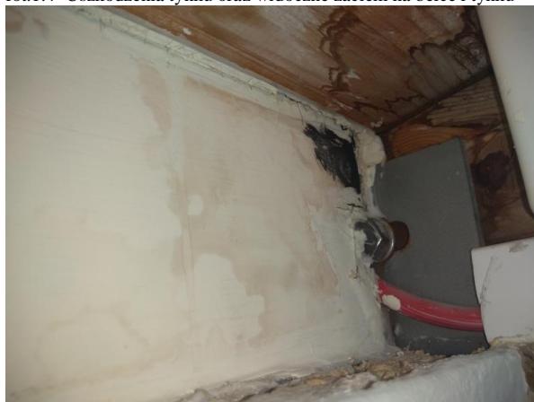
fot.1.4 Uszkodzenia tynku oraz widoczne zacieki na belce i tynku
