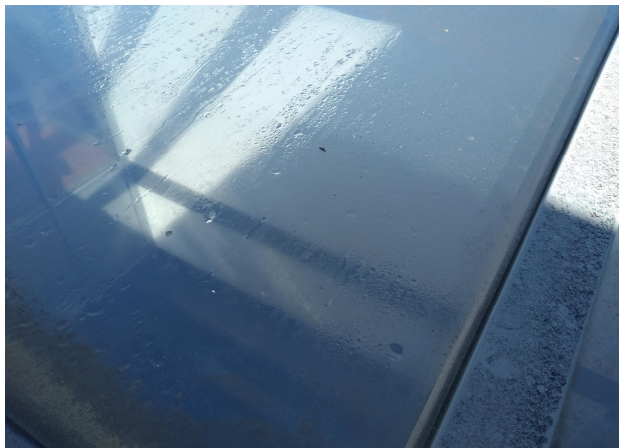
fot.1.12 Widoczna krople wody w przestrzeni mi dzyszybowej
