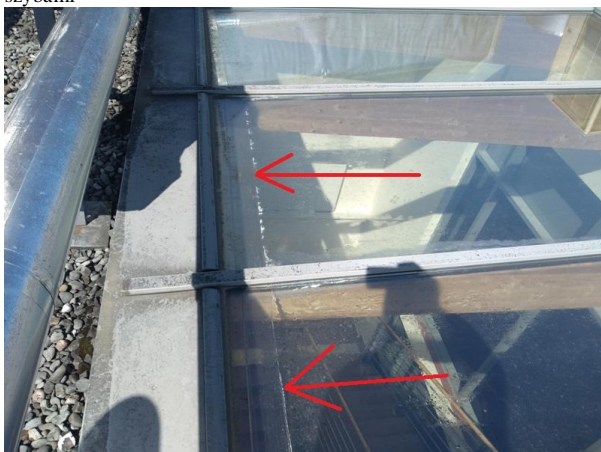
fot.1.9 Widoczne ludy wody (osad) w przestrzeni pomi dzy szybami
