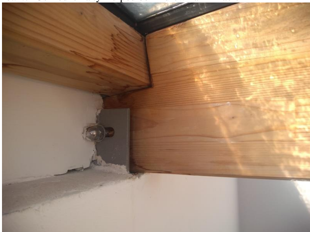
fot.1.7 Uszkodzenia tynku pod belk drewnian - zacieki
