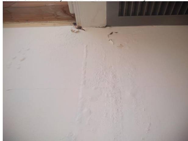
fot.1.6 Uszkodzenia tynku oraz widoczne zacieki na tynku
