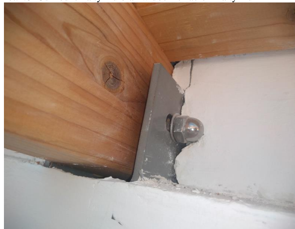
fot.1.8 Uszkodzenia tynku oraz widoczne zacieki na tynku
