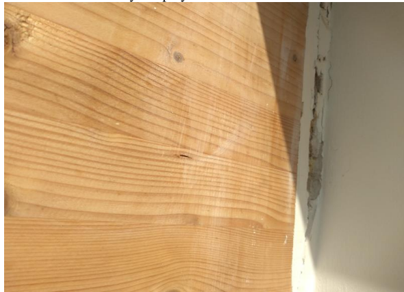
fot.1.1 Uszkodzenia tynku przy kontakcie z belką drewnianą
