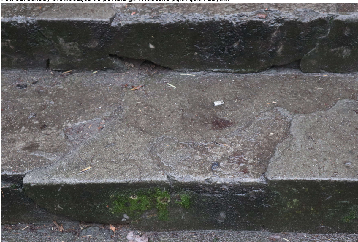
Fot. 62. Schody prowadzące do portalu gł. Widoczne pęknięcia, ubytki, wtórne uzupełnienia i mszaki na powierzchni stopni.
