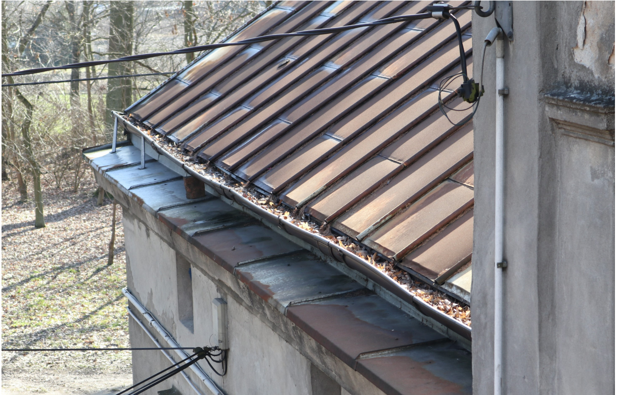
Fot. 50. Połączenie dachu widoczne nad elewacją frontową. Widoczna korozja poszycia oraz zanieczyszczone i wygięte rynny.
