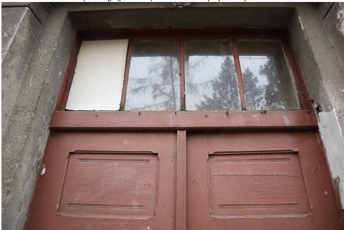
Fot. 55. Drzwi frontowe w portalu gł. (po 1945 r.). Widoczny brak jednej z szyb nadświetla oraz poziome pęknięcie płyciny skrzydła drzwiowego.
