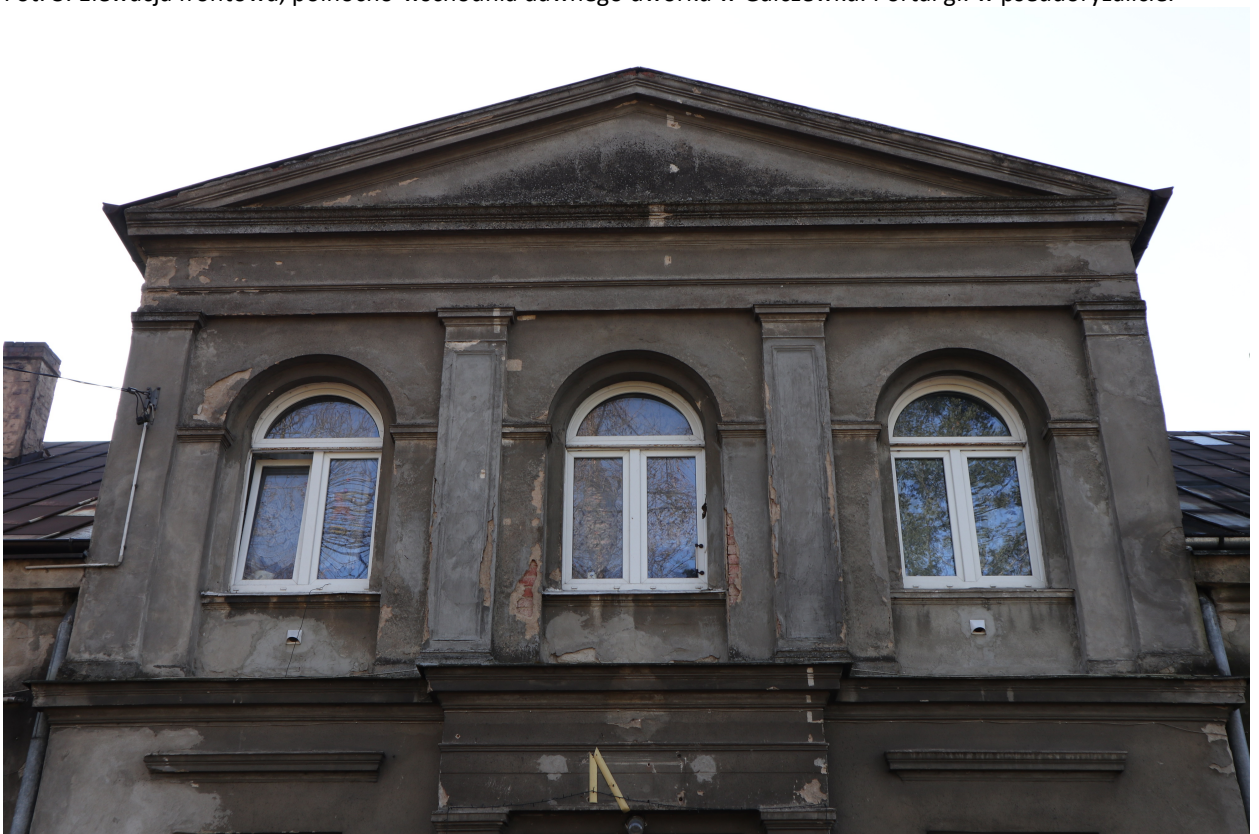
Fot. 4. Elewacja frontowa, północno-wschodnia dawnego dworku w Gałczewku. II kondygnacja pseudoryzaltu zwieńczona tympanonem.
