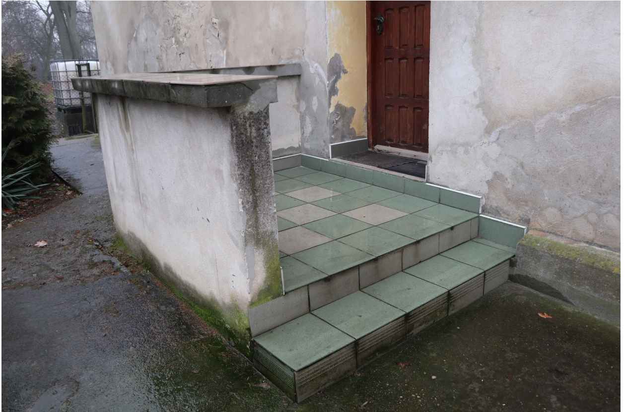
Fot. 12. Elewacja szczytowa południowo-wschodnia dawnego dworku w Gałczewku. Schody i balustrada prowadzące do drzwi bocznych.
