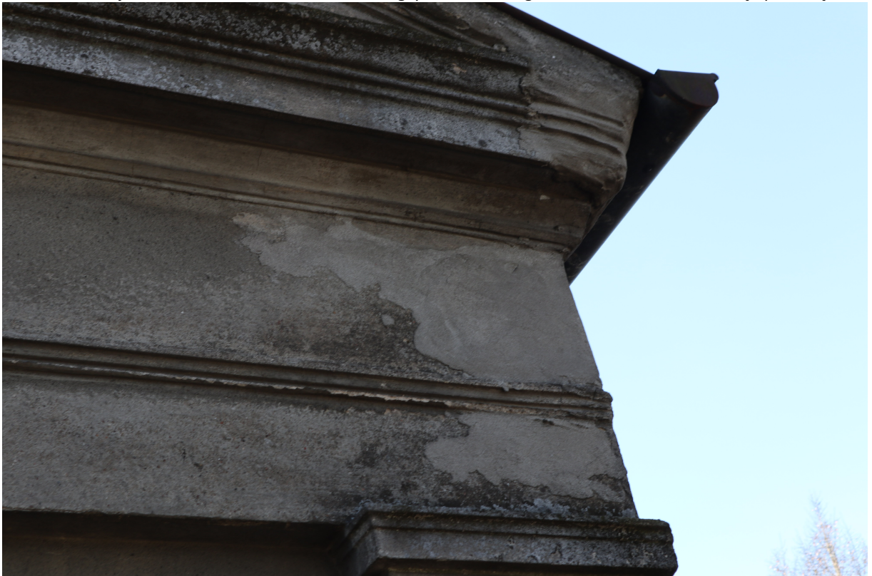
Fot. 39. Elewacja frontowa. Widoczne nieestetyczne uzupełnienie niewłaściwą (cementową) zaprawą gzymsu w tympanonie pseudoryzalitu.
