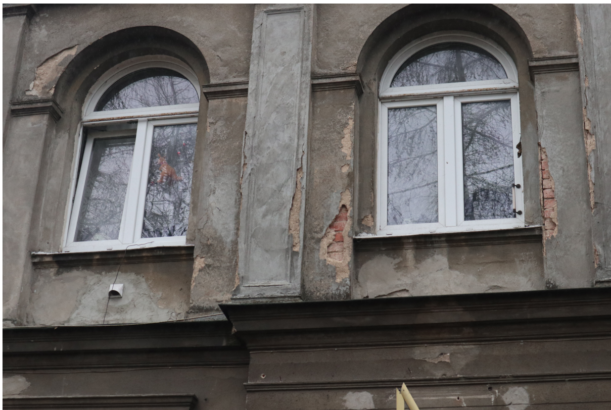
Fot. 58. Elewacja frontowa. Współczesna stolarka okienna w pseudoryzalicy wykonana z PVC.
