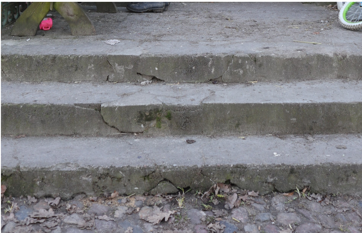
Fot. 61. Schody prowadzące do portalu gł. Widoczne pęknięcia i ubytki.
