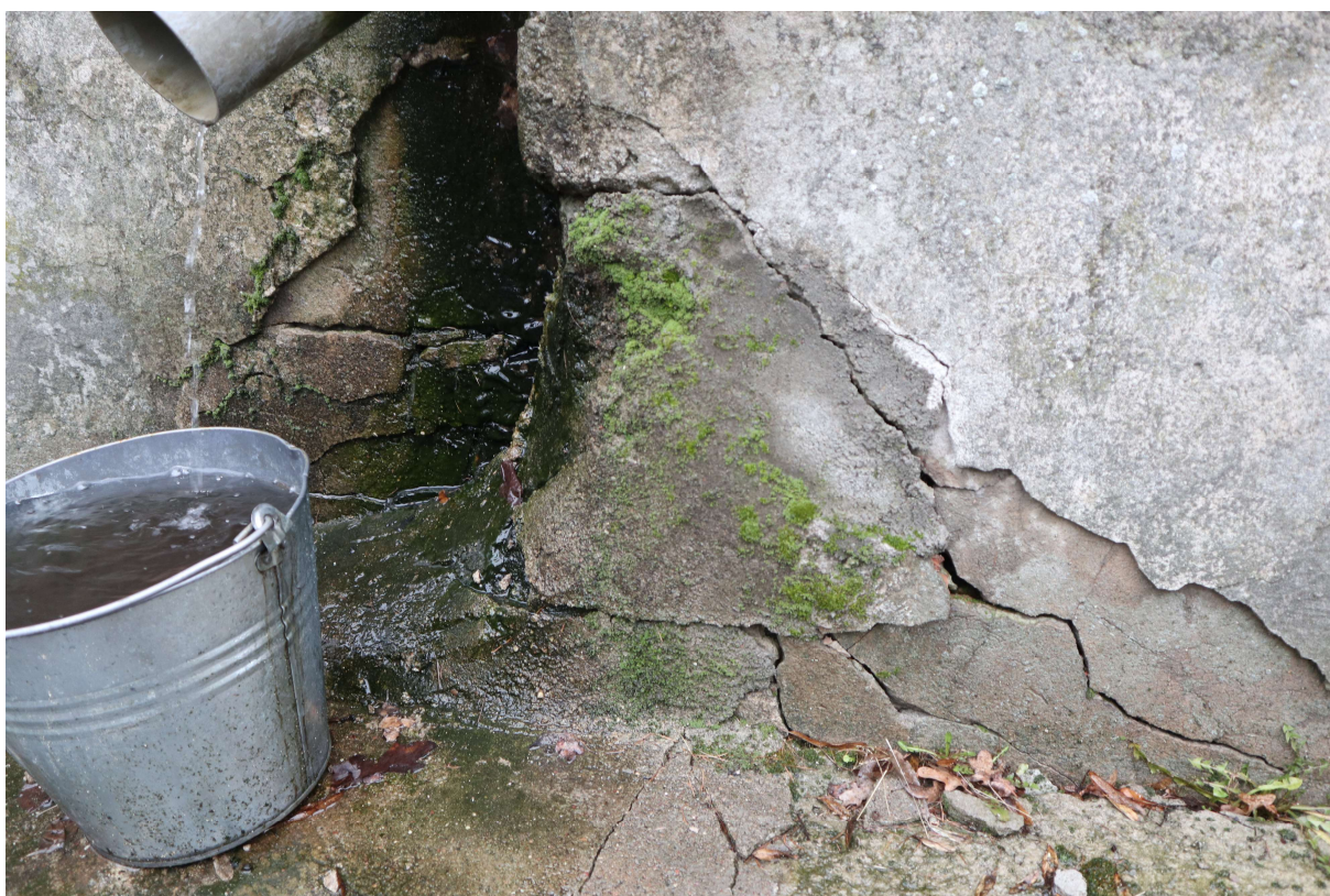
Fot. 23. Elewacja tylna. Widoczny bardzo zły stan zachowania zapraw oryginalnych i wtórnych na skutek gł. zalewania wodą opadową: silne spękanie, odspajanie się tynków, silne porażenie biologiczne.
