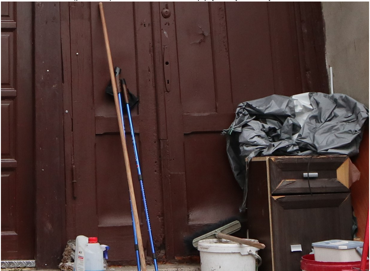
Fot. 57. Drzwi werandy (po 1945 r.). Widoczne zastąpienie drewnianych płycin płytą pilśniową, która jest wygięta i pęknięta.
