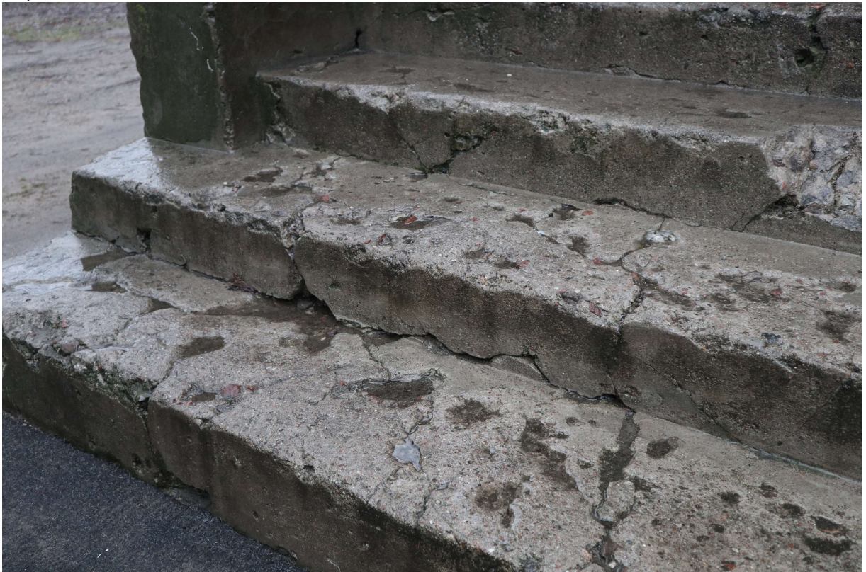
Fot. 64. Schody prowadzące do wejścia w werandzie. Widoczne liczne pęknięcia i ubytki w stopniach.
