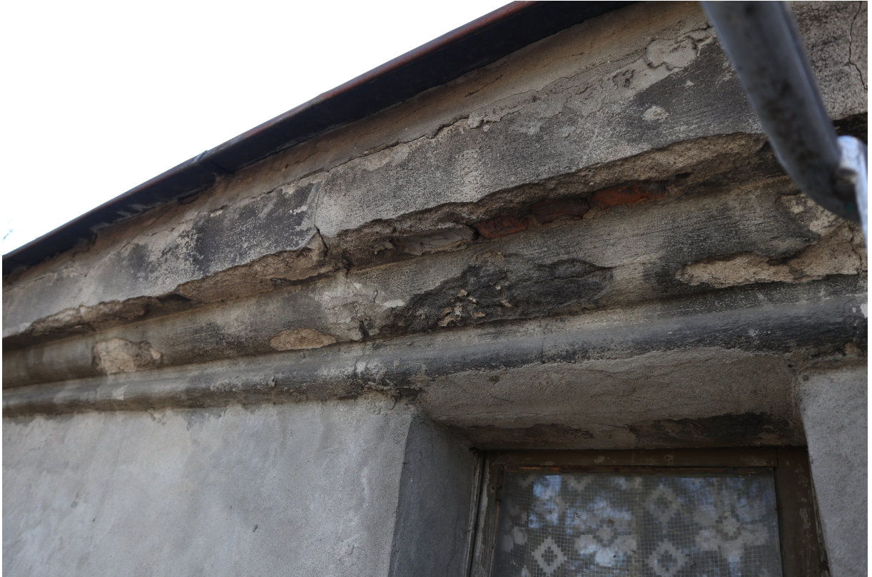
Fot. 38. Elewacja frontowa. Widoczne uszkodzenia gzymsu koronnego na skutek zalewania wodą opadową.
