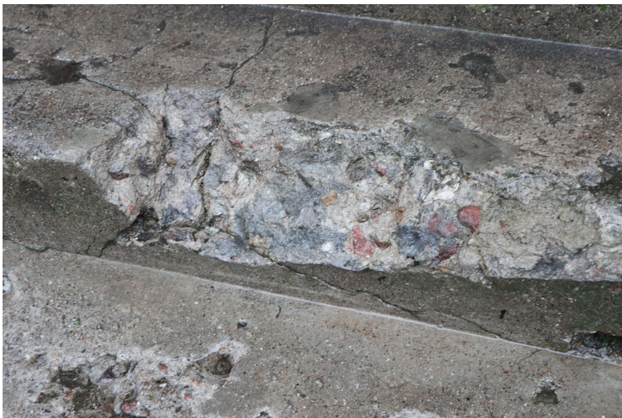
Fot. 65. Schody prowadzące do wejścia w werandzie. Zbliżenie na duży ubytek w jednym ze stopni.
