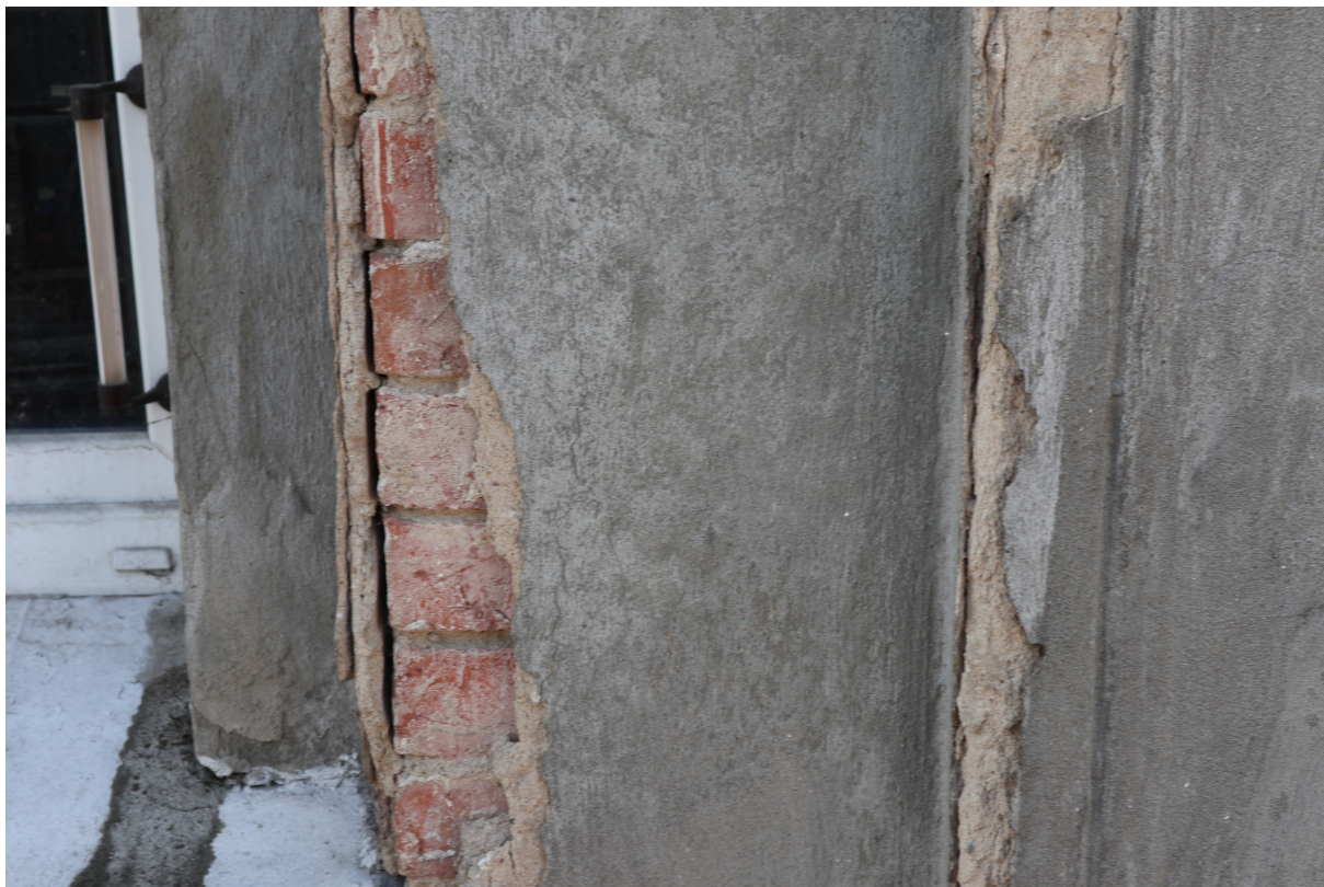
Fot. 32. Elewacja frontowa. Widoczne uszkodzenia oryginalnych tynków (odspajanie, ubytki, osypywanie) na skutek zalewania wodą opadową. Widoczne również szare cementowe zacierki na powierzchni historycznej beżowej zaprawy tynkarskiej.
