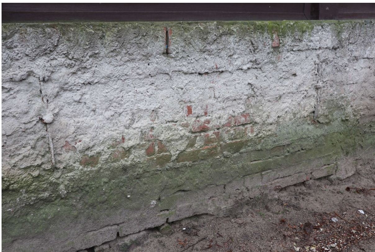
Fot. 40. Weranda. Zbliżenie na murowany cokół-taras z widocznymi wtórnie założonymi zaprawami, zachlapaniami. Widoczne porażenie biologiczne.
