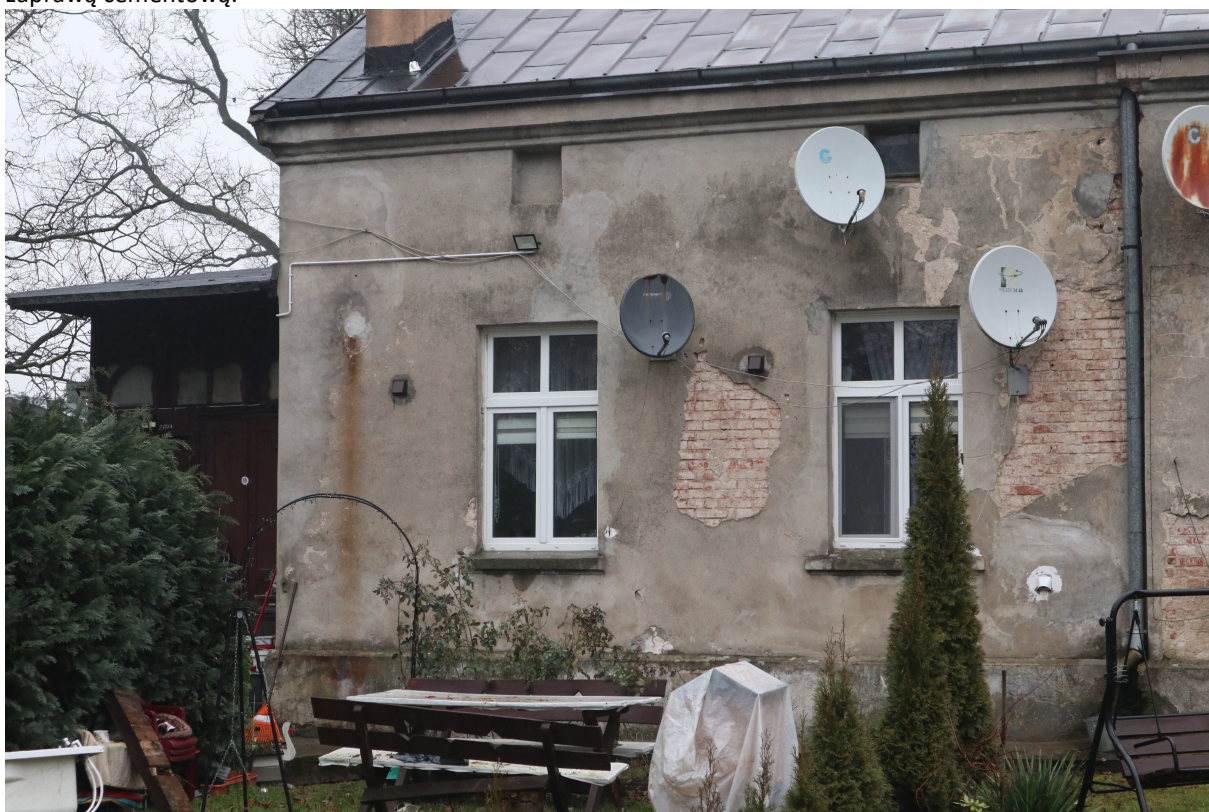
Fot. 35. Elewacja tylna. Widoczne uszkodzenia oryginalnych tynków płaskich (odspajanie, ubytki, osypywanie się, dezintegracja) na skutek zalewania wodą opadową i pokrycia wtórną zaprawą cementową. Widoczne rdzawe zaplamienia oraz nieestetyczne instalacje i talerze satelitarne na elewacji.
