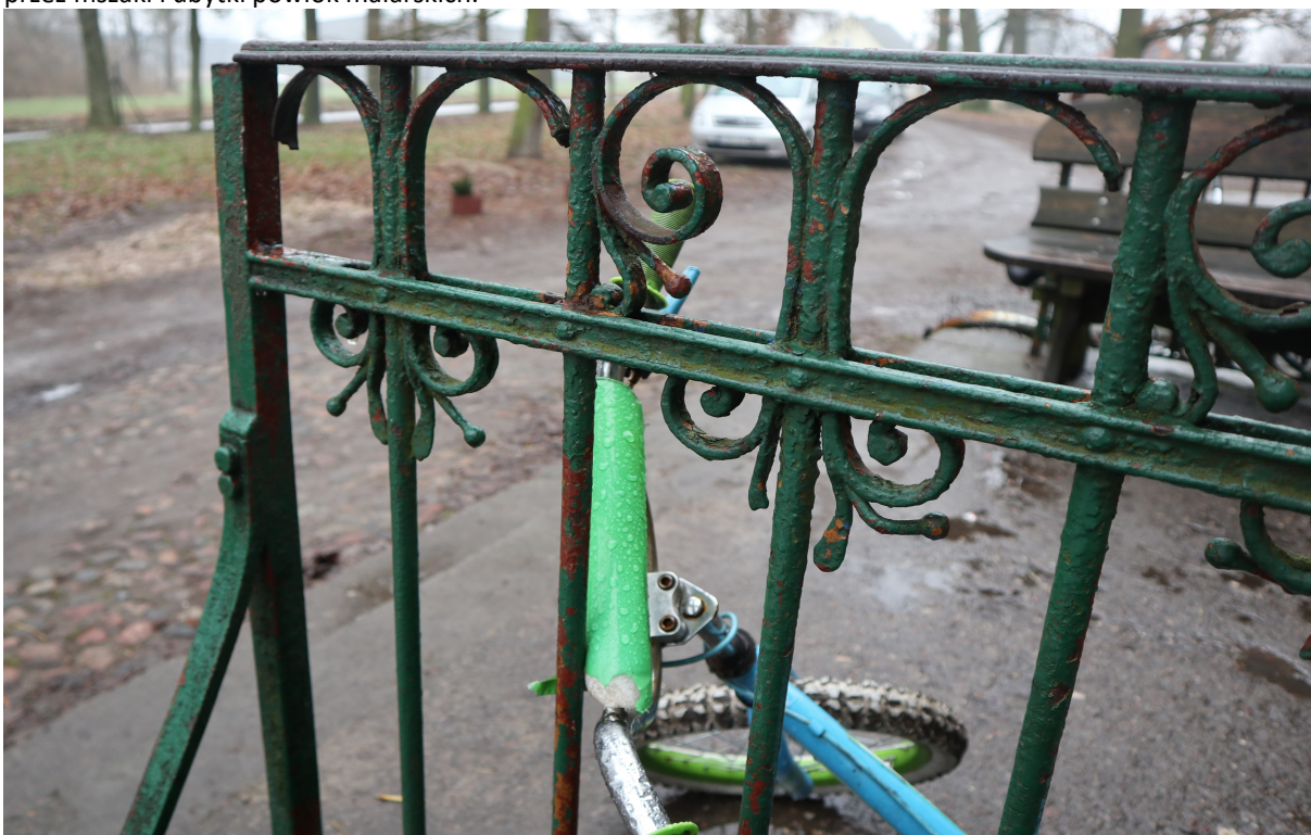
Fot. 68. Bariera zachodnia przed portalem gł. widoczne ubytki elementów dekoracyjnych oraz zatarcie formy zdobień przez liczne, wtórne powłoki malarskie.
