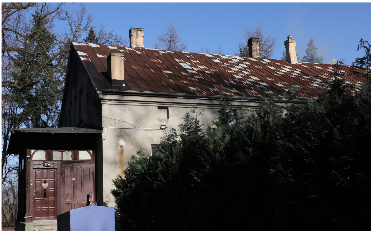
Fot. 47. Połączenie dachu widoczne nad elewacją tylną. Widoczna korozja blacharki na całej połączy.
