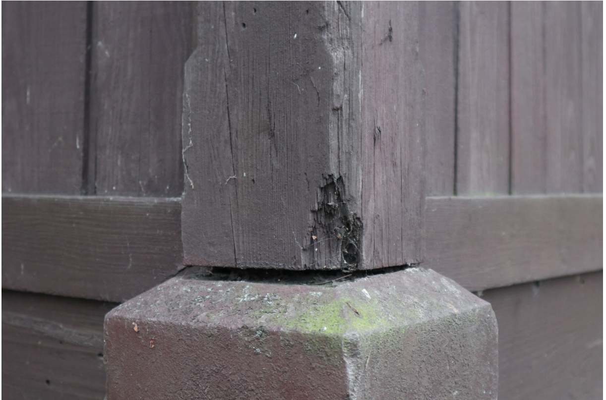
Fot. 43. Weranda. Zbliżenie na dolny fragment słupa narożnego ściany. Widoczne otwory wylotowe po owadach oraz uszkodzenie mechaniczne drewna.
