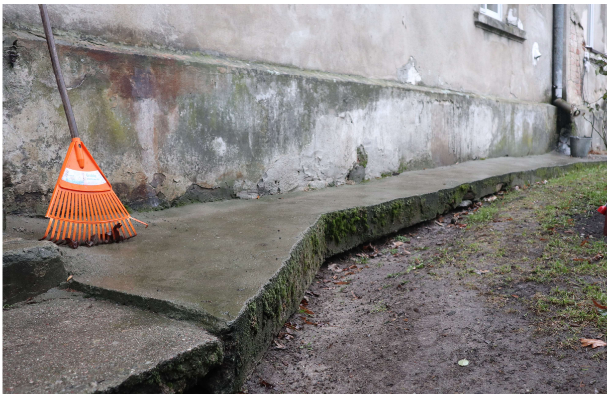
Fot. 21. Elewacja tylna. Widoczna opaska betonowa otaczająca budynek, która jest przyczyną utrzymywania się wysokiej wilgotności i zasolenia muru. Na skutek ciągłego zawilgocenia stan zachowania muru ceglanego, tynków oryginalnych jest b. zły.
