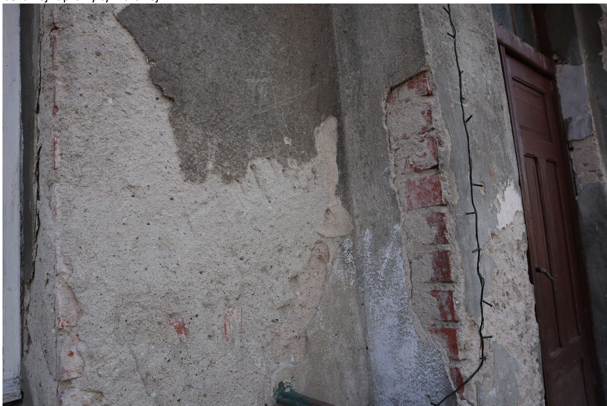
Fot. 33. Elewacja frontowa. Widoczne uszkodzenia oryginalnych tynków pseudoryzalitu przy portalu gł. (odspajanie, ubytki, osypywanie się, dezintegracja) na skutek zalewania wodą opadową i pokrycia wtórną zaprawą cementową.
