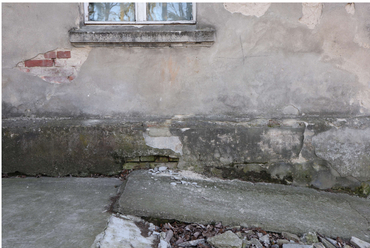
Fot. 26. Elewacja frontowa. Widoczne ubytki oryginalnych wypraw tynkarskich, odspajanie się i dezintegracja tynków na poziomie cokołu.
