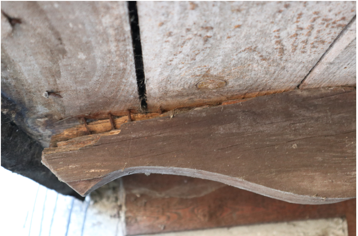
Fot. 44. Weranda. Zbliżenie na końcówkę krokwi z widocznym ubytkiem drewna.
