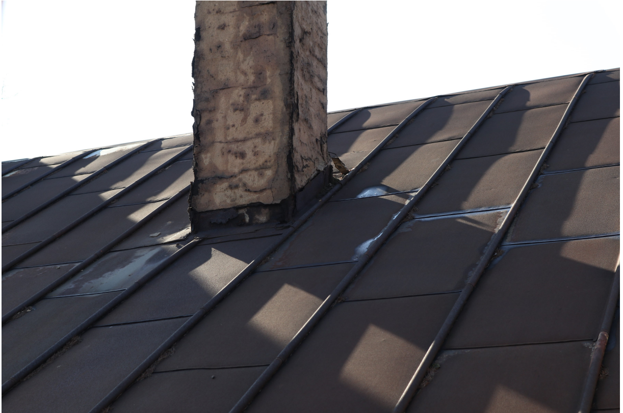
Fot. 48. Połąc dachu widoczna nad elewacją frontową. Widoczna korozja blacharki oraz silnie skorodowana, przzerwana i posiadająca ubytki obróbka przy kominie.
