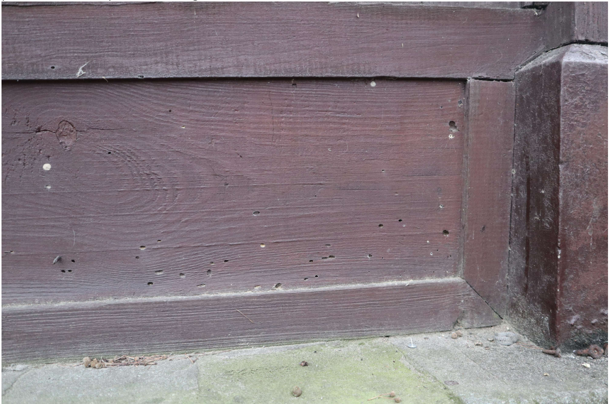
Fot. 42. Weranda. Zbliżenie na dolną strefę ściany drewnianej z widocznymi otworami wylotowymi po owadach.
