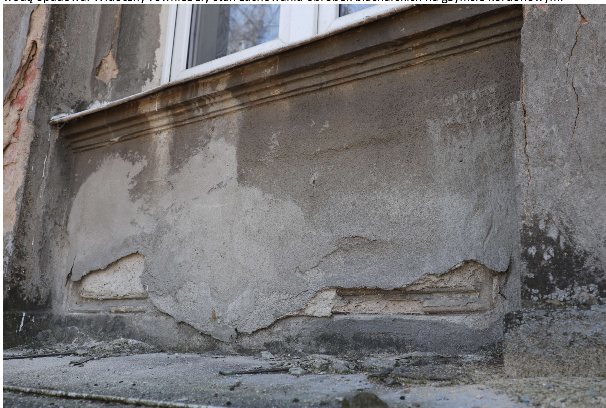
Fot. 31. Elewacja frontowa. Środkowa płycina podokienna na poziomie kondygnacji pseudoryzalitu. Widoczna odspajająca się wtórna zacierka betonowa i zdegradowane oryginalne tynki płaskie i ramy płyciny.
