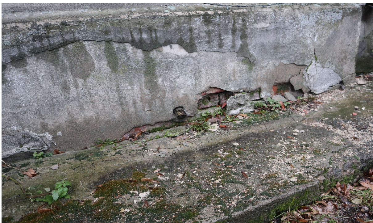
Fot. 19. Elewacja tylna. Widoczne kruszące się i łuszczące cegły na poziomie cokołu, wtórnie pokrytego warstwą betonowej wyprawy oraz opaska betonowa wokół budynku, która jest przyczyną utrzymywania się wysokiej wilgotności muru. Na skutek ciągłego zawilgocenia stan zachowania muru ceglanego, tynków oryginalnych jest b. zły.
