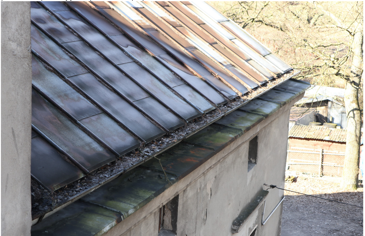
Fot. 49. Połąc dachu widoczna nad elewacją frontową. Widoczna korozja poszycia oraz zanieczyszczone rynny.
