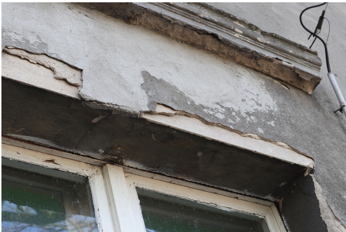
Fot. 34. Elewacja frontowa. Widoczne uszkodzenia oryginalnych tynków płaskich i profili gzymsu nadokiennego (odspajanie, ubytki, osypywanie się, dezintegracja) na skutek zalewania wodą opadową i pokrycia wtórną zaprawą cementową.
