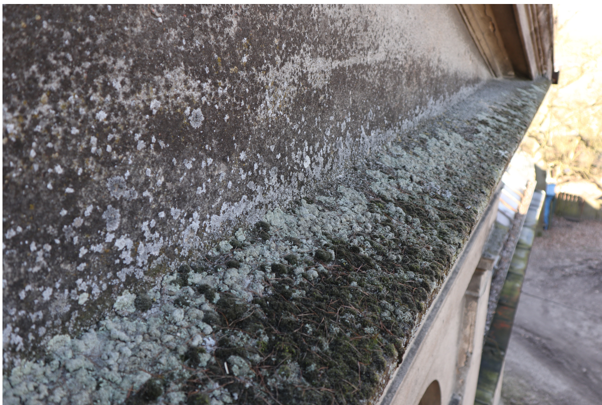
Fot. 40. Elewacja frontowa. Widoczne porastanie tła i gzymsu dolnego w tympanonie przez porosty, mszak, glony.
