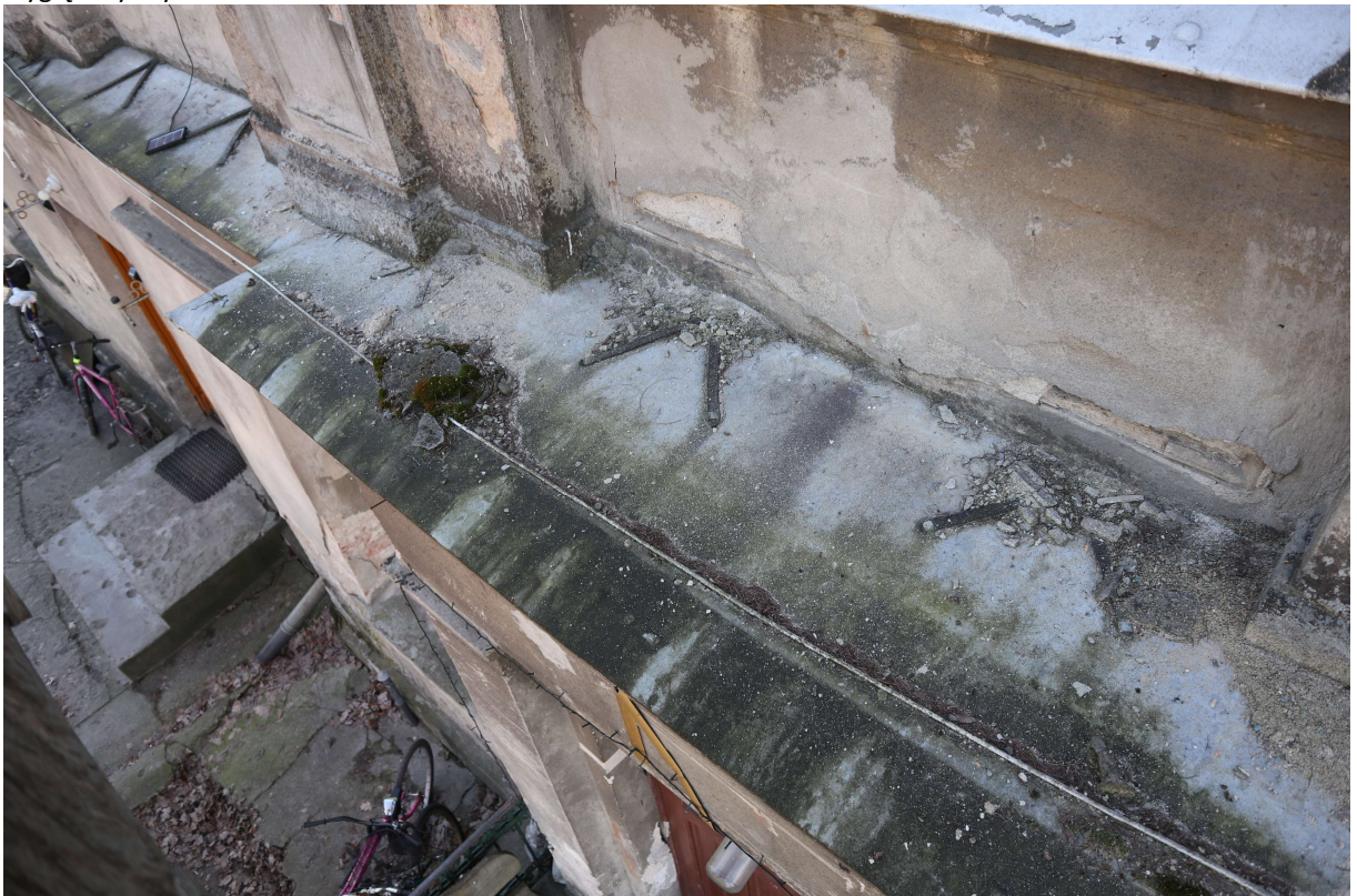
Fot. 51. Elewacja frontowa. Oryginalna obróbka blacharska na powierzchni gzymsu kordonowego w pseudoryzalicy.
