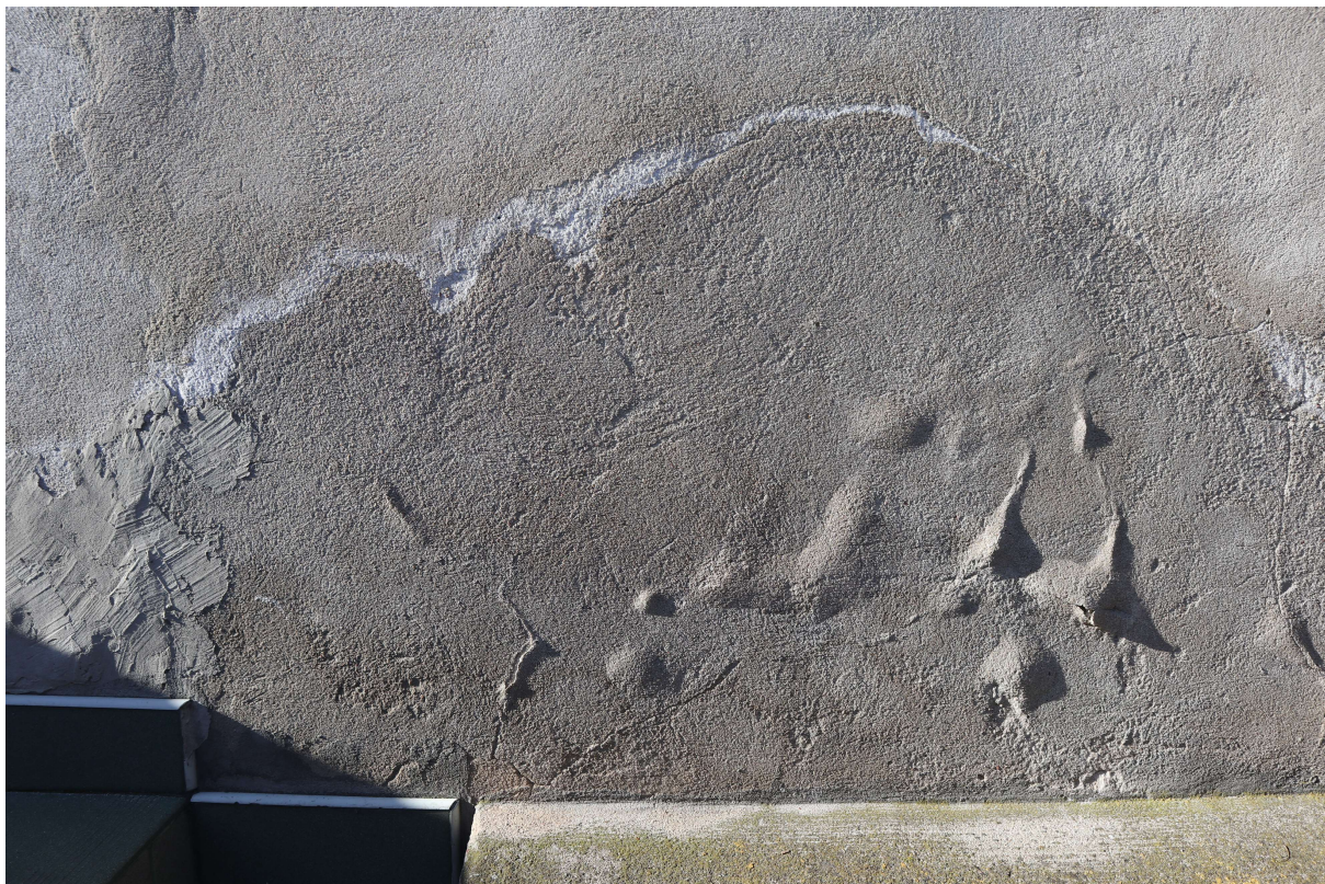
Fot. 28. Elewacja szczytowa południowo-wschodnia. Widoczna zacierka betonowa na powierzchni tynku oryginalnego- odspajanie się, degradacja i wykwyty solne na granicy odsychania tynków.
