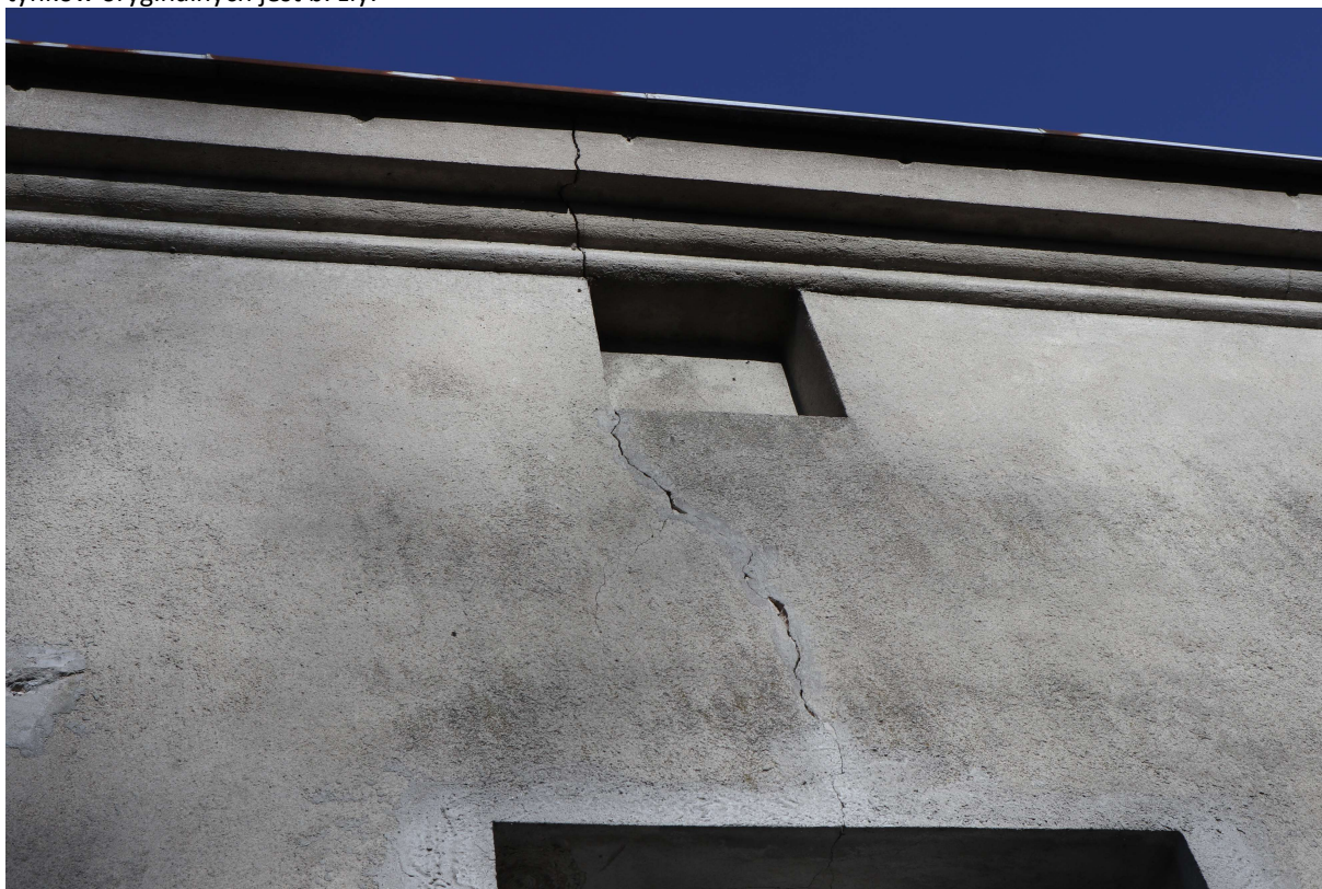
Fot. 22. Elewacja tylna. Widoczne pionowe pęknięcie konstrukcyjne w górnej części muru w 1. osi od str. wschodniej.
