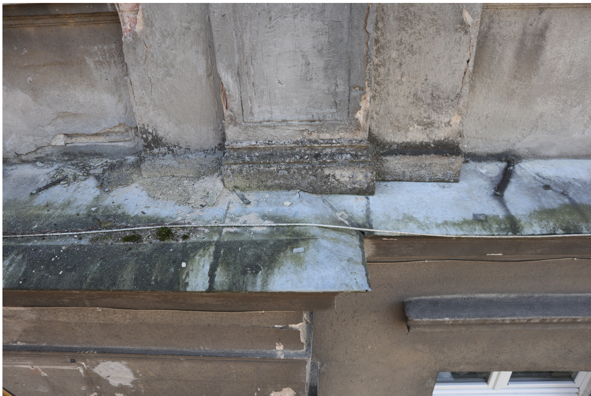
Fot. 52. Elewacja frontowa. Oryginalna obróbka blacharska na powierzchni gzymsu kordonowego w pseudoryzalicy. Widoczne wygięcie arkuszy, które są kruche.
