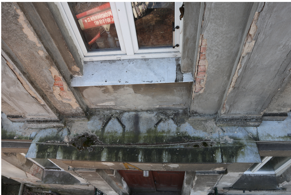
Fot. 30. Elewacja frontowa. Środkowa strefa ryzalitu z widocznymi uszkodzeniami tynków i na skutek zalewania wodą opadową. Widoczny również zły stan zachowania obróbek blacharskich na gzymsie kordonowym.
