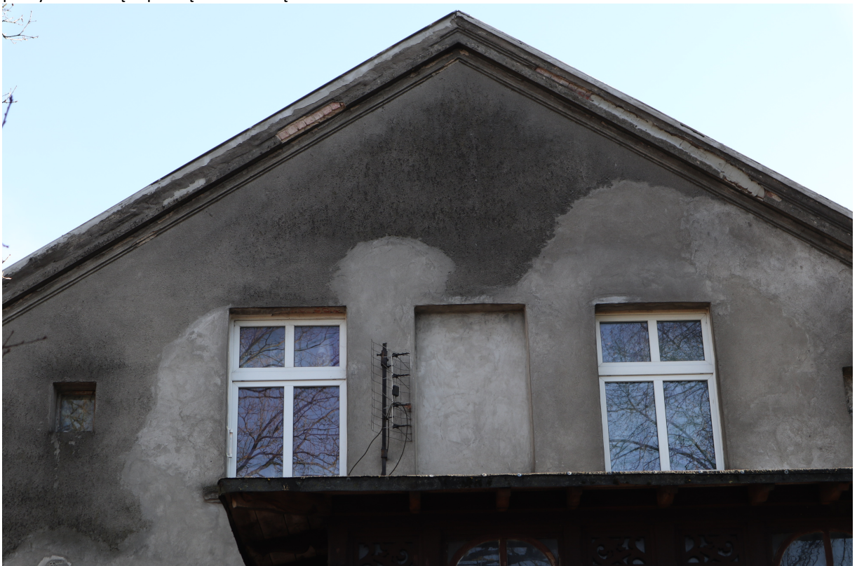
Fot. 37. Elewacja szczytowa północno-zachodnia. Widoczne uszkodzenia gzymsu koronnego (odspajanie, ubytki) oraz wtórne uzupełnienia w tynku płaskim wykonane z zaprawy cementowej.
