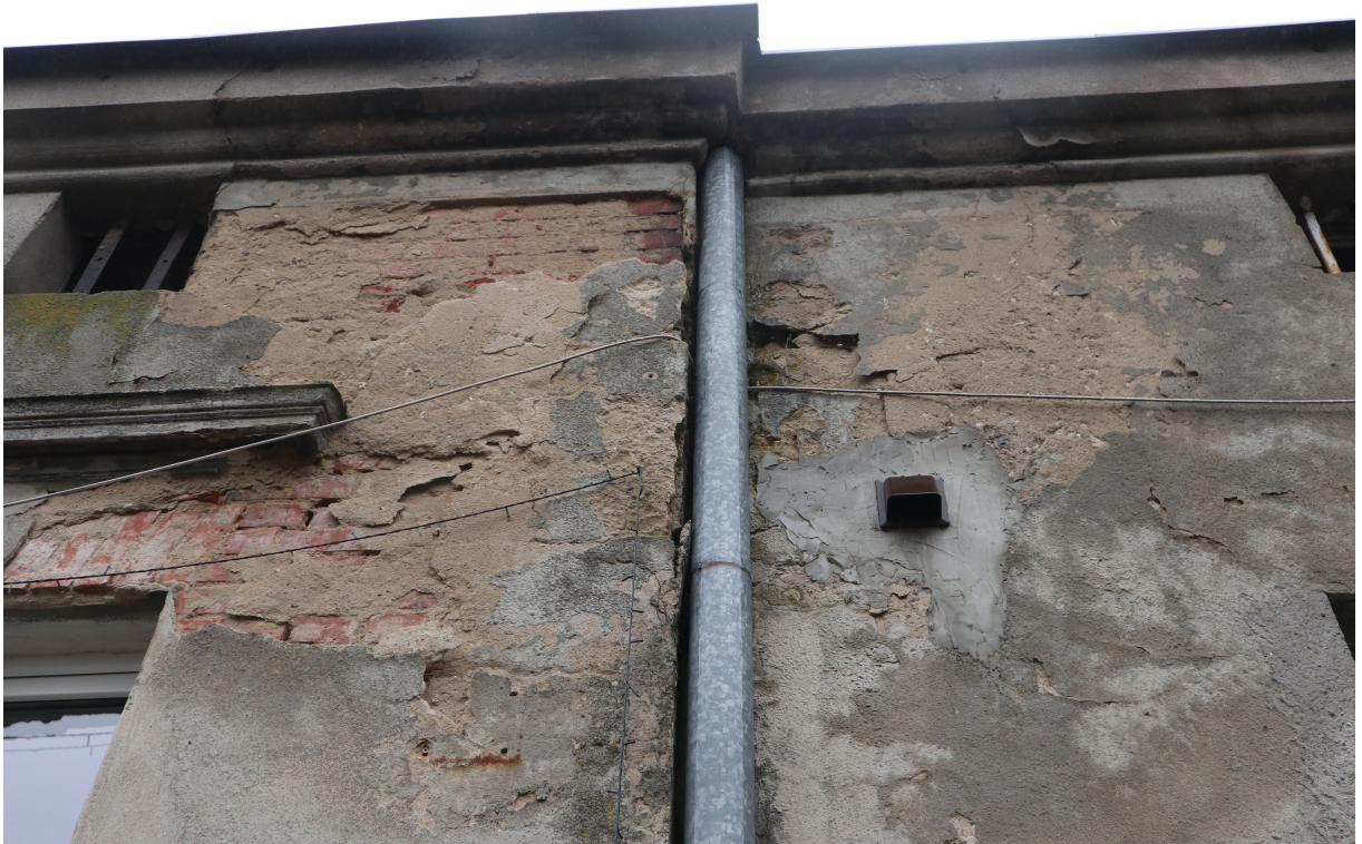
Fot. 36. Elewacja tylna. Widoczne uszkodzenia oryginalnych tynków płaskich i profili gzymsu koronnego i nadokiennego (odspajanie, ubytki, osypywanie się, dezintegracja) na skutek zalewania wodą opadową i pokrycia wtórną zaprawą cementową.
