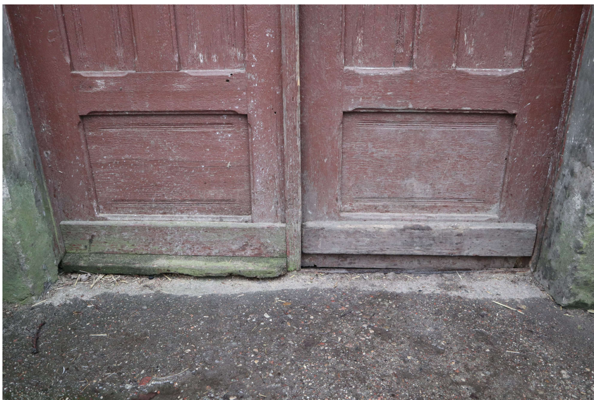
Fot. 53. Drzwi frontowe w portalu gł. (po 1945 r.). Zbliżenie na dolne partie skrzydeł drzwiowych z widocznym ubytkiem jednego z okapników, zniszczeniami drugiego. Dolne elementy ram skrzydeł i płyciny są wyługowane, pozbawione częściowo powłoki ochronnej.
