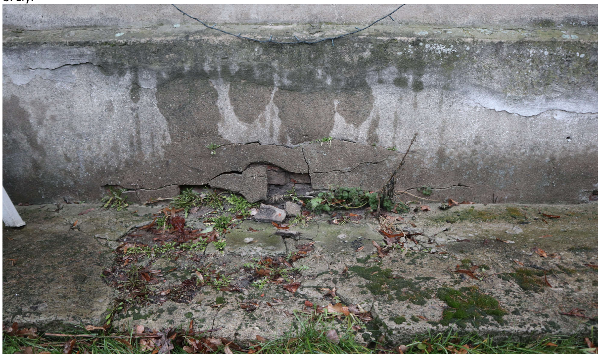
Fot. 20. Elewacja frontowa. Widoczne kruszące się i łuszczące cegły na poziomie cokołu, wtórnie pokrytego warstwą betonowej wyprawy oraz opaska betonowa wokół budynku, która jest przyczyną utrzymywania się wysokiej wilgotności muru. Na skutek ciągłego zawilgocenia stan zachowania muru ceglanego, tynków oryginalnych jest b. zły.
