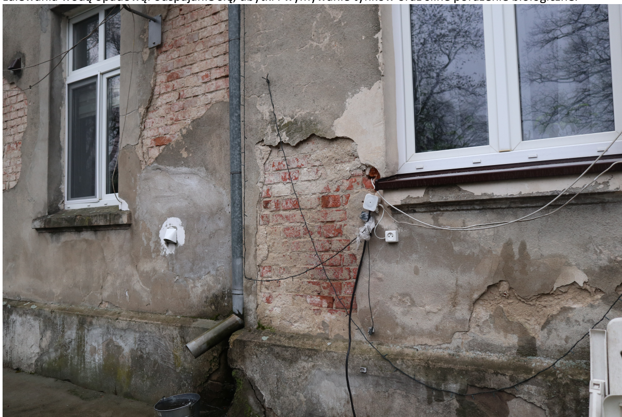
Fot. 25. Elewacja tylna. Widoczne liczne, obszerne ubytki oryginalnych wypraw tynkarskich, odpajanie się i dezintegracja zachowanych tynków, nieestetyczne uzupełnienia zapraw wykonane z zapraw cementowych.
