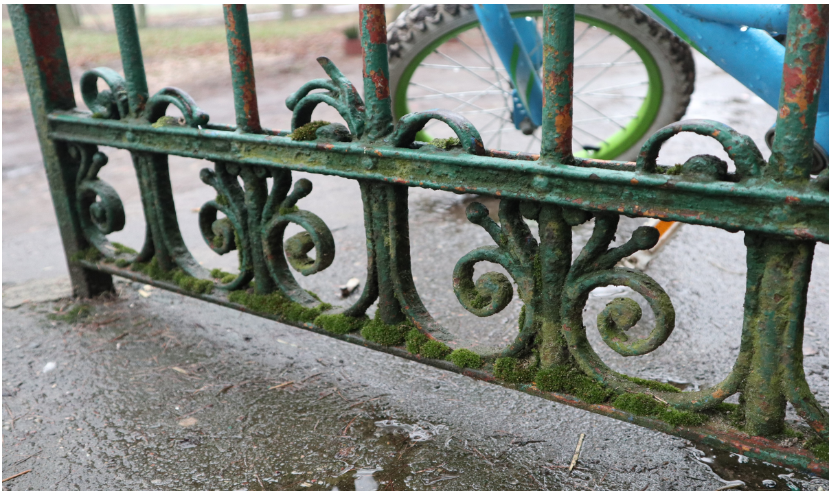
Fot. 67. Bariera zachodnia przed portalem gł. Widoczne ubytki elementów dekoracyjnych, porastanie bariery przez mszaki i ubytki powłok malarskich.
