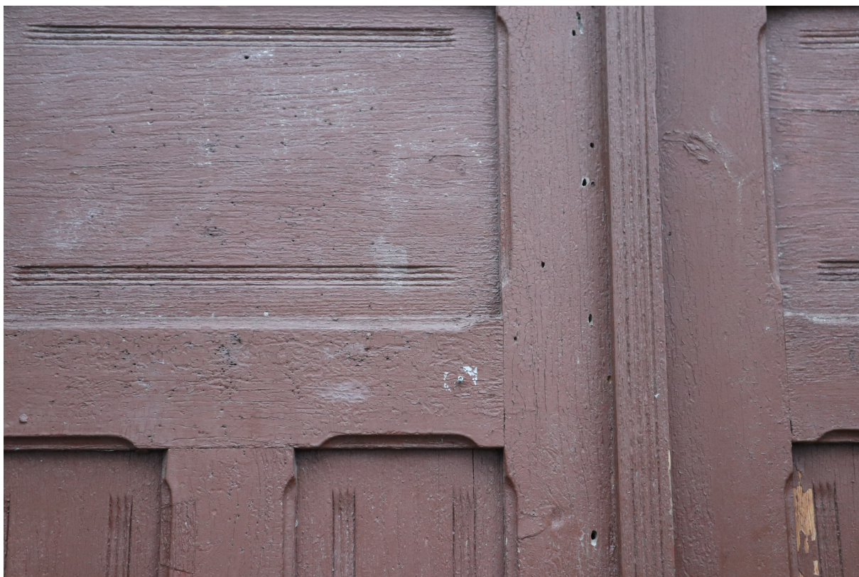
Fot. 54. Drzwi frontowe w portalu gł. (po 1945 r.). Widoczne otwory wylotowe po owadach.
