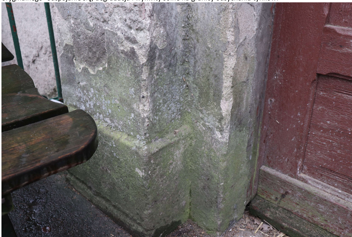
Fot. 29. Elewacja frontowa. Dolna strefa portalu głównego z widocznymi zielonymi ogniskami porażenia biologicznego (glony, sinice, porosty, mszaki).
