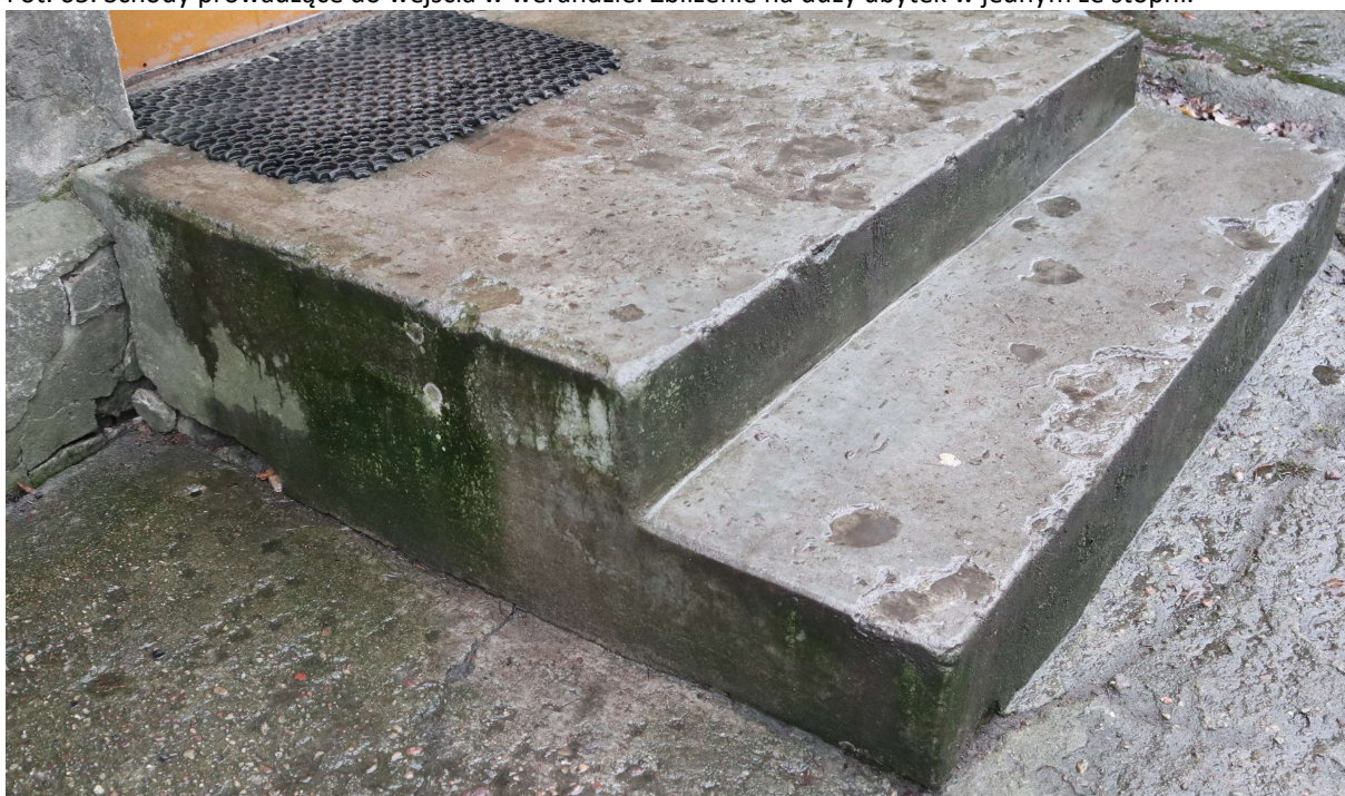
Fot. 66. Schody przed wejściem bocznym w elewacji frontowej. Widoczne liczne ubytki i wypłycenia w stopniach oraz porażenie biologiczne.
