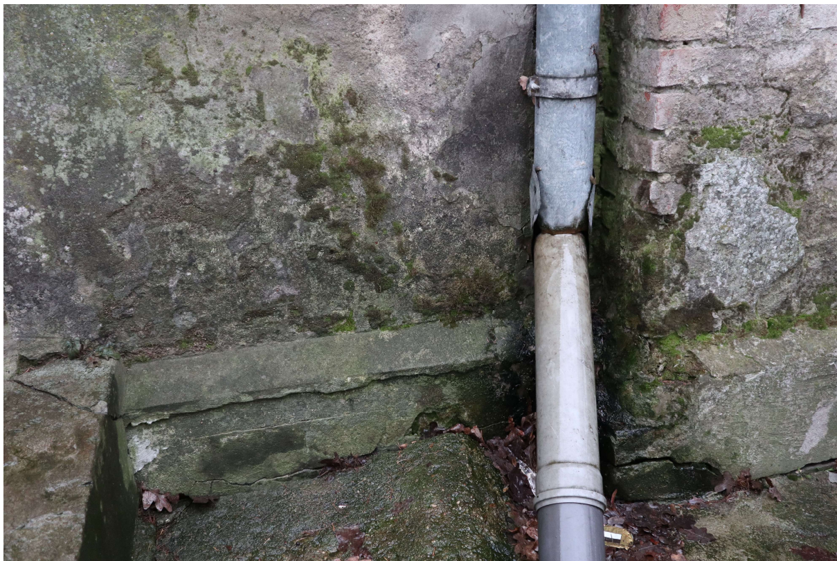
Fot. 24. Elewacja frontowa. Widoczny bardzo zły stan zachowania zapraw oryginalnych i wtórnych na skutek gł. zalewania wodą opadową: odpajanie się, ubytki i wymywanie tynków oraz silne porażenie biologiczne.
