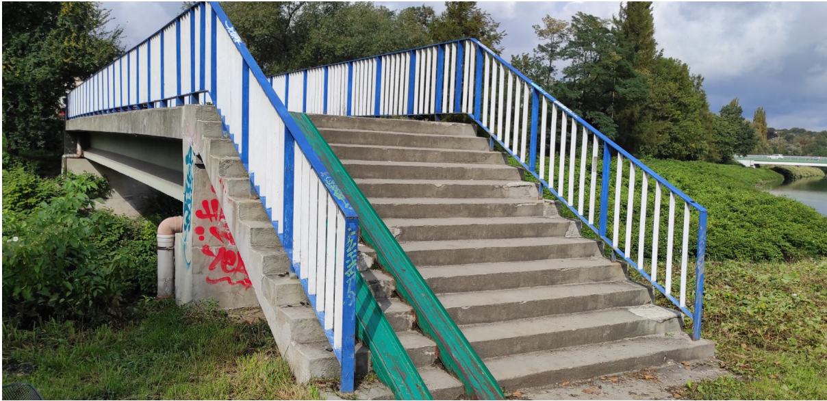
Rys. 30 Istniejąca kładka dla pieszych - do remontu przez rz. Bładnica, w rejonie ujścia do rz. Wisła. Należy przebudować pochylnie dostosowując je do ruchu rowerzystów lub przebudować obiekt, ze względu na ograniczone warunki terenowe. Obiekt w ciągu Wiślanej Trasy Rowerowej.
