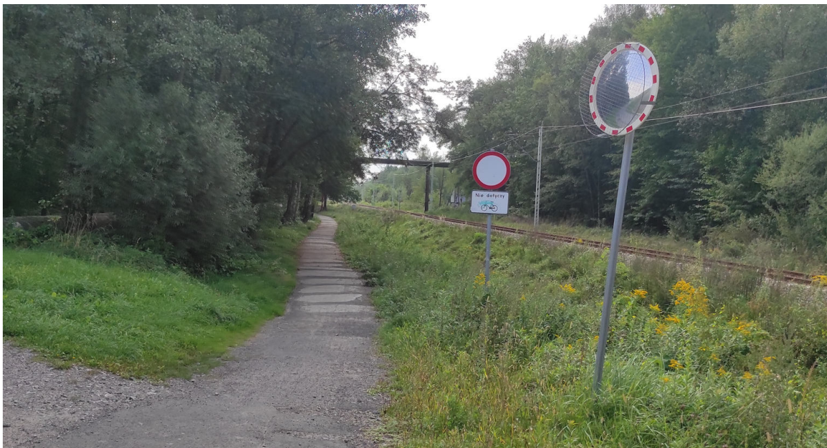
Rys. 17 Droga wewnętrzna - remont. Droga wewnętrzna wzdłuż linii kolejowej nr 190 Bielsko-Biała Główna - Cieszyn w rejonie ul. Ciężarowej.
