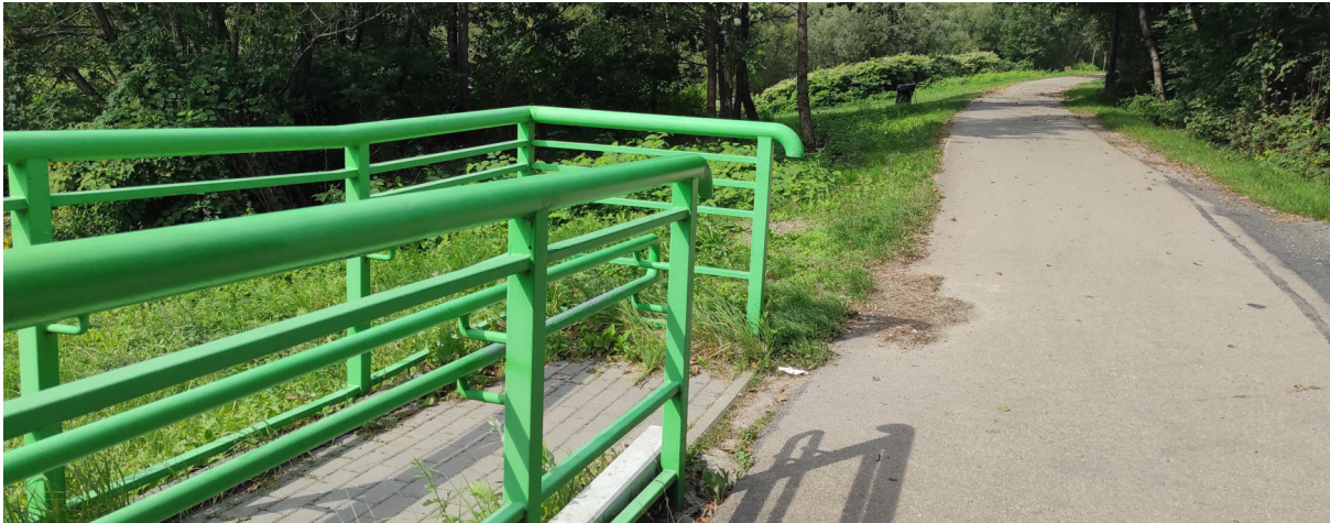
Rys. 13 Pochylnia istniejącej kładki na rz. Wisła, w rejonie ul. Świętego Marcina. Należy ją przebudować i dostosować do ruchu rowerzystów.
