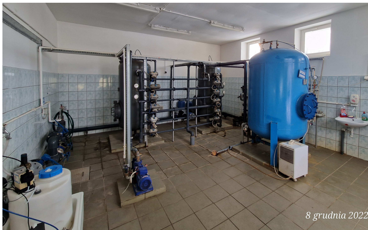
Fot. 9. Istniejący układ technologiczny SUW Kleszczewo
