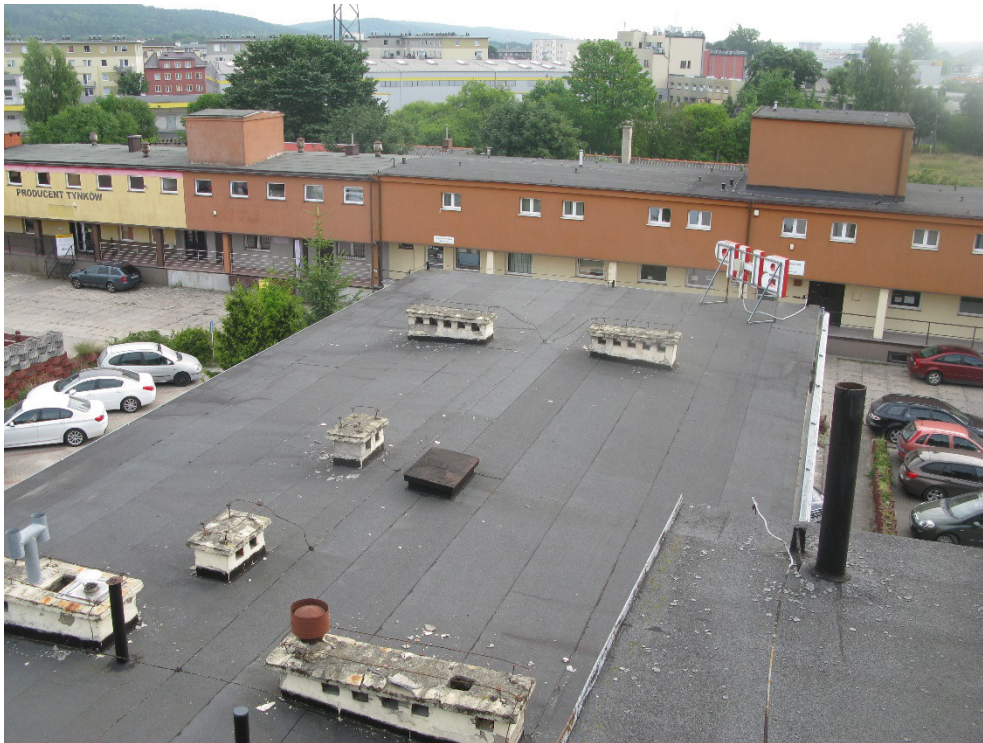
Fot.1 Połać dachu „B” nad budynkiem niższym. Kominy w złym stanie do przemurowania
