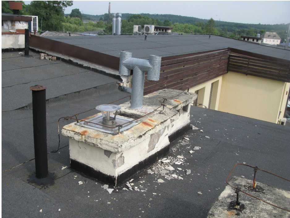
Fot.2 Połać dachu „B” nad budynkiem niższym – kominy i instalacja odgromowa w bardzo złym stanie technicznym.
