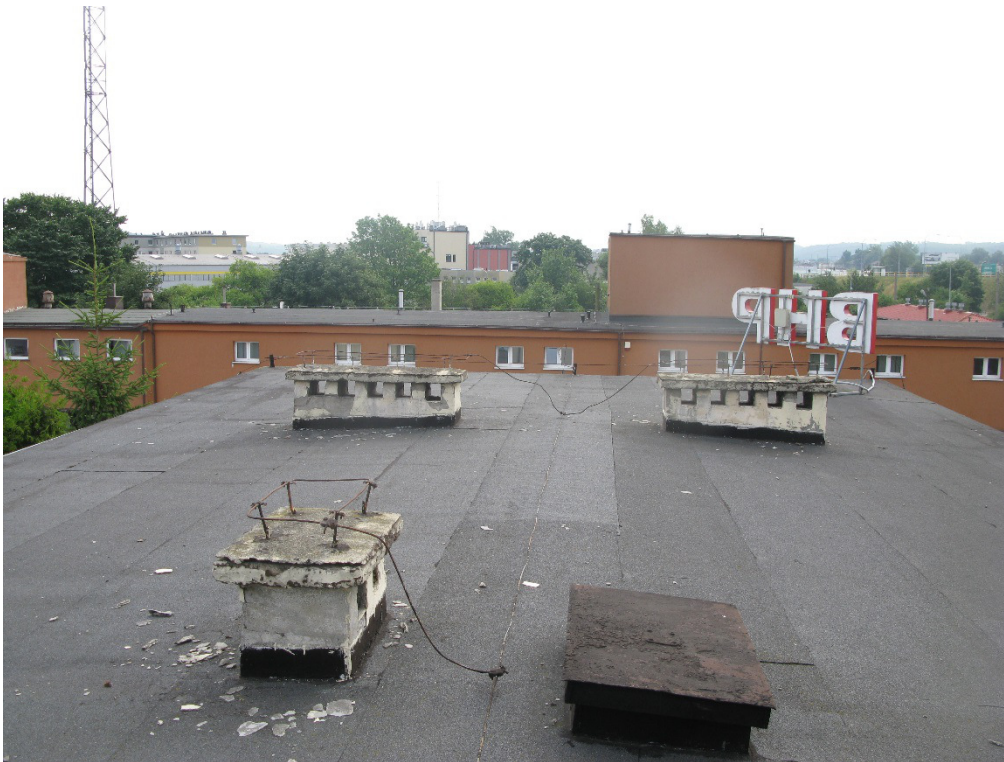
Fot. 3 Połączenie dachu „B” nad budynkiem niższym – kominy i instalacja odgromowa w bardzo złym stanie technicznym.
