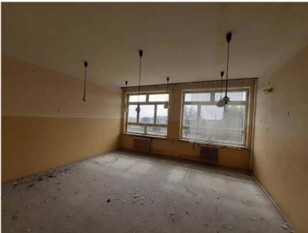
Fot. nr 14. Widok oświetlenia i grzejników c.o. na piętrze budynku.
