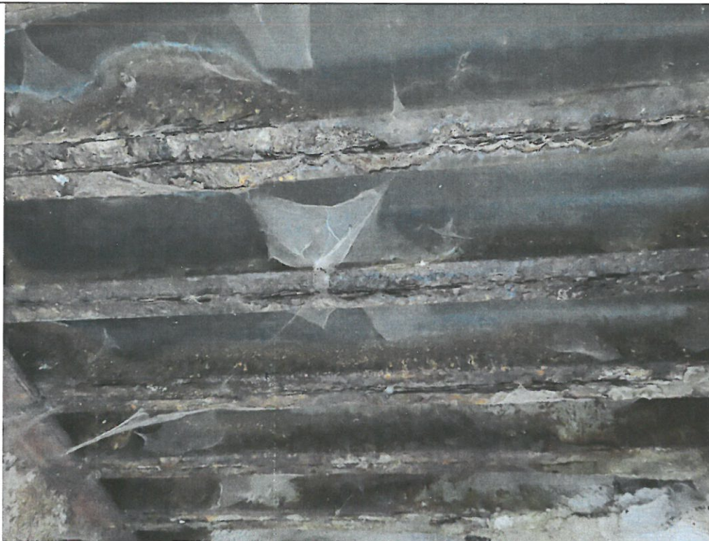
Fot. 1 Korozja pomostu ustroju nośnego
