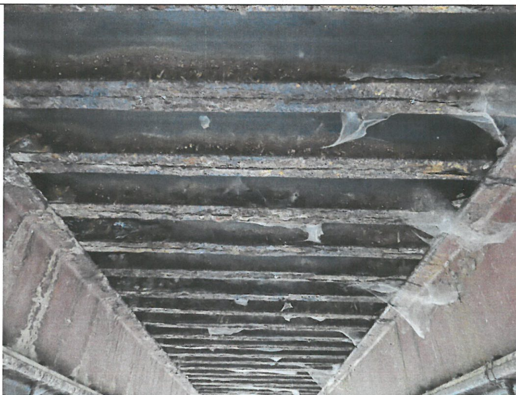
Fot. 2 Korozja pomostu i dźwigarów głównych
