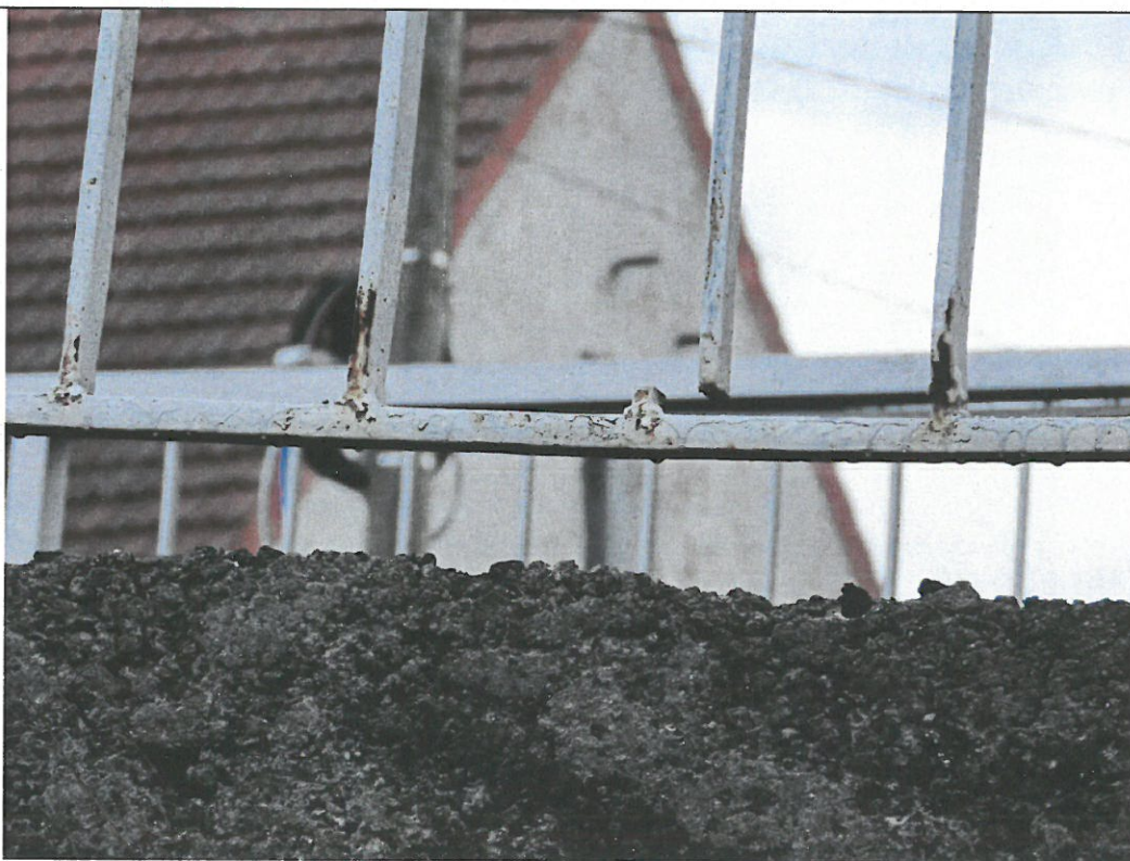
Fot. 4 Korozja i lokalne uszkodzenia balustrady
