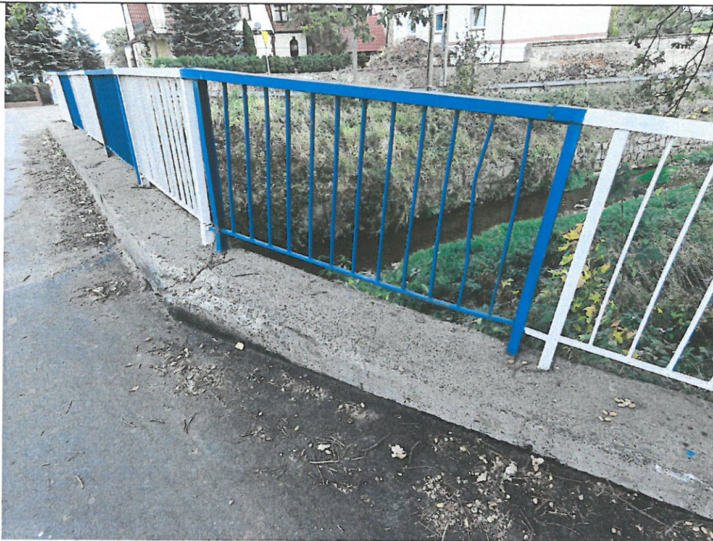
Fot. 3 Lokalne deformacje balustrady
