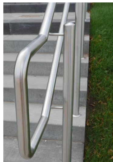
Rysunek 2. Prawidłowo wysunięte poręcze schodów poza pierwszy i ostatni stopień [fot.: M. Wysocki].
