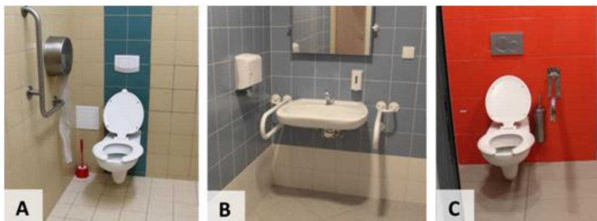
Rysunek 58. Przykład zastosowania kontrastów kolorystycznych w pomieszczeniach sanitarnych [fot.: N. Ratajczak-Szponik, Dostosowanie polskich szkół z początku XXI wieku do potrzeb dzieci z niepełnosprawnościami ..., op.cit., s. 275].
