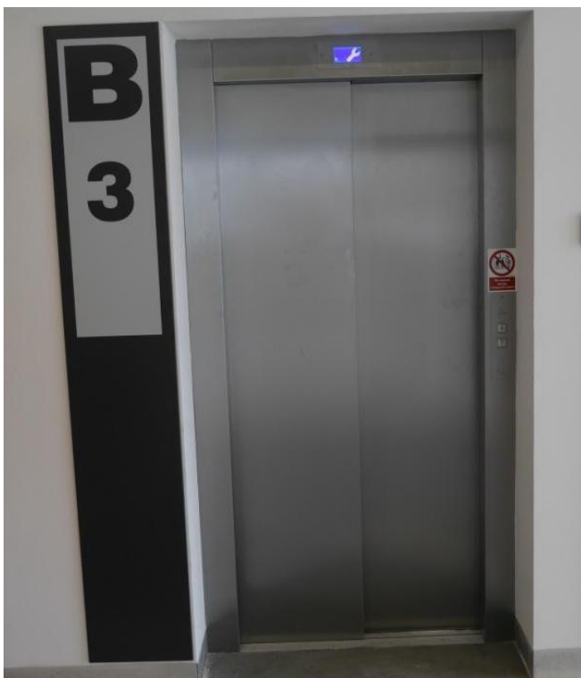
Rysunek 8A. Przykład wyróżnienia drzwi: z lewej - panel informacyjny przy drzwiach do dźwigu osobowego [fot. M. Wysocki].
