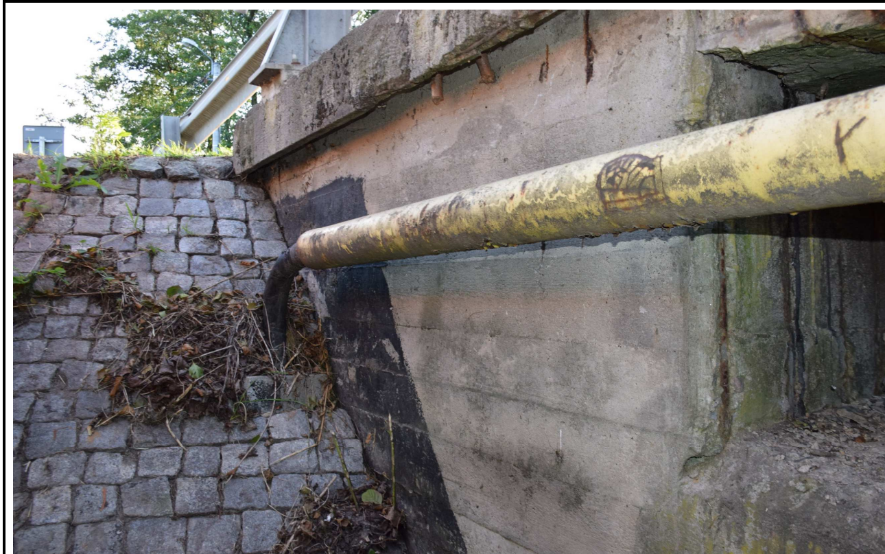
Fot. 11. Zanieczyszczenia oraz korozja rury osłonowej urządzenia obcego.
