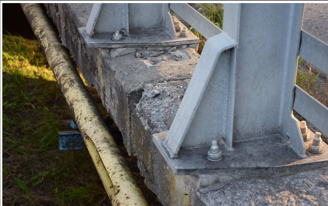
Fot. 10. Zanieczyszczenia, korozja, rysy i ubytki betonu gzymsu.
