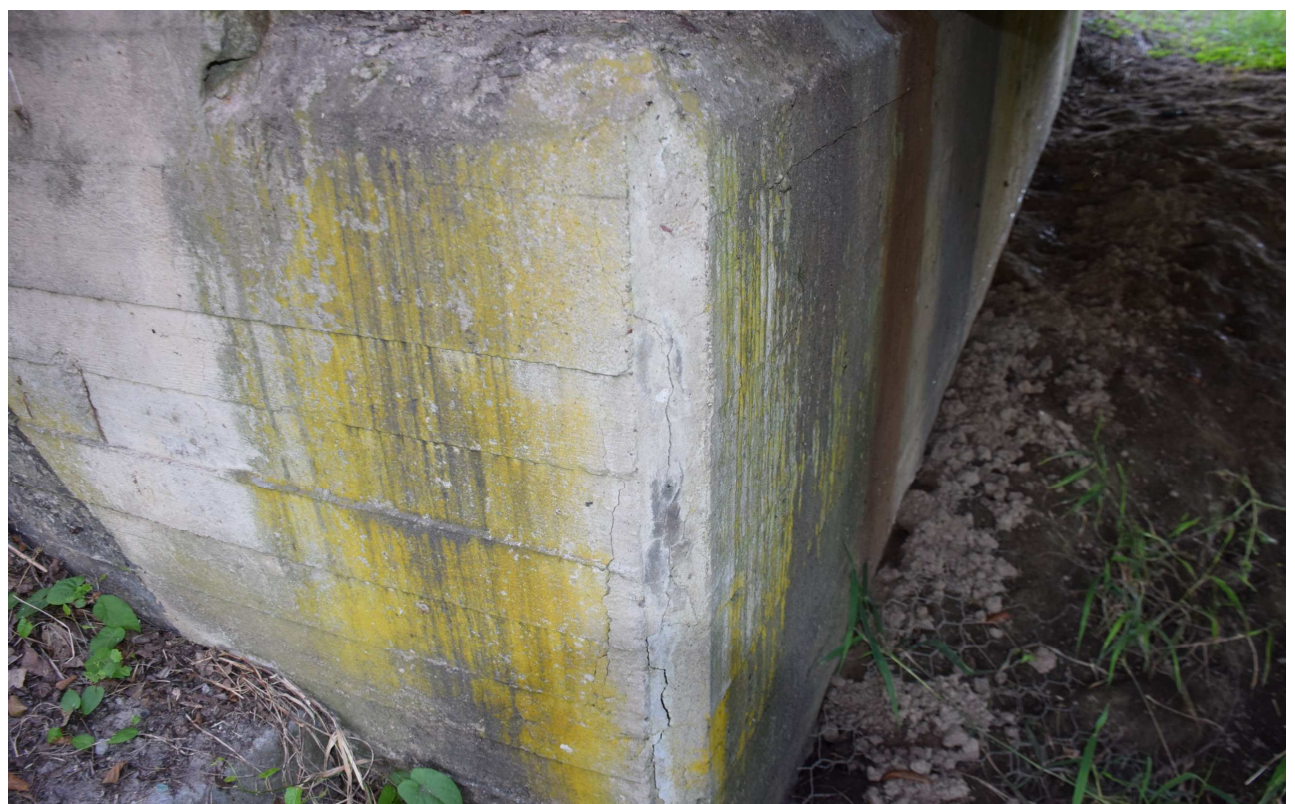
Fot. 8. Wegetacja porostów oraz rysy betonu przyczółka.
