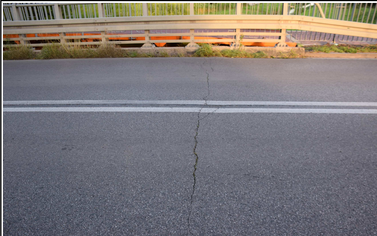
Fot. 9. Rysy nawierzchni bitumicznej w strefie dylatacji.
