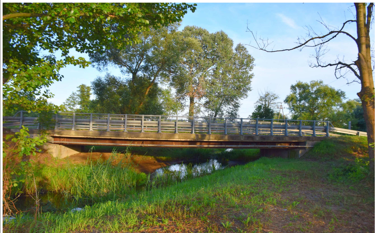
Fot. 2. Widok z boku od strony zachodniej.
