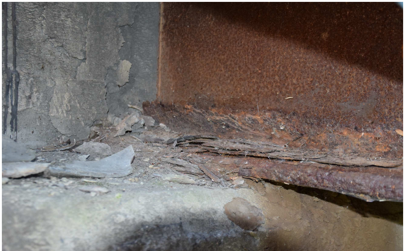
Fot. 7. Zniszczenie struktury materiału półki dolnej skrajnego dźwigara.
