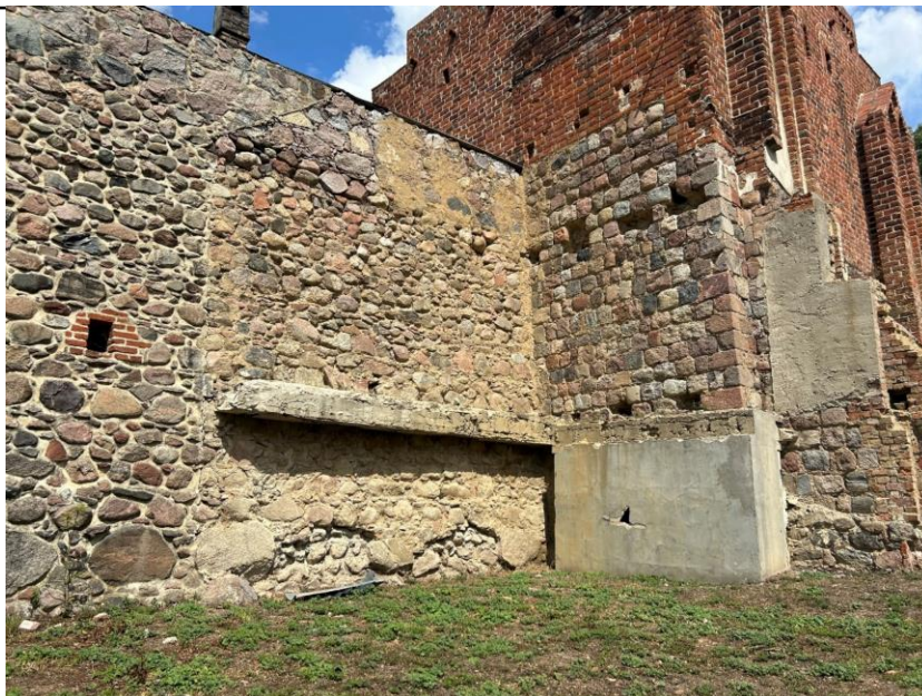
Fot. 52. Odcinek kurtyny muru przyległy do Bramy Myśliborskiej z widocznym obrysem nieistniejącego już budynku przy ul. Dworcowej 2; widoczna w obrębie partii z licem murowanym z cegły ukośna bruzda, wykuta w celu osadzenia opierzenia na styku z połącją dachu rozebranego budynku
