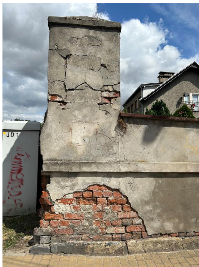
Fot. 31. Odcinek murowanego ogrodzenia przy ul. Kościuszki – słup północny z widoczną nasiloną korozją wyprawy tynkarskiej, głównie w górnej jego partii oraz w przyziemiu; zabrudzenia i zaplamienia powierzchni muru; rozrost drobnej roślinności w spękaniach oraz ubytkach tynku; korozja mikrobiologiczna głównie na powierzchniach spływowych
