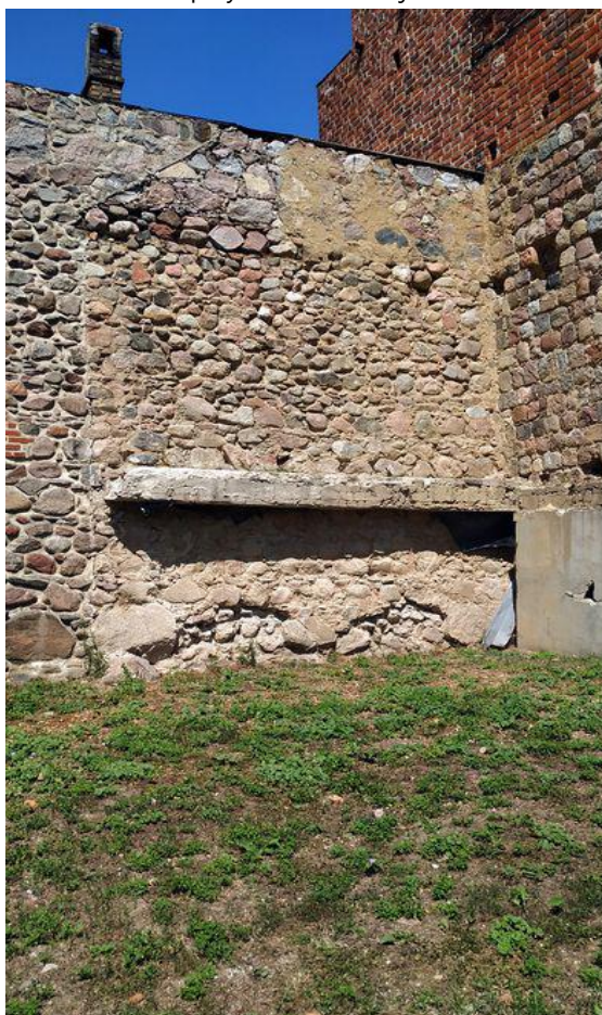
Fot. 49. Odcinek kurtyny przyległy do Bramy Myśluborskiej – widoczny obrys nieistniejącego już budynku przy ul. Dworcowej 2, półka ze zbrojonego betonu, będąca jego pozostałością, a także znaczne ubytki kamiennego lica muru na styku z poziomem terenu
