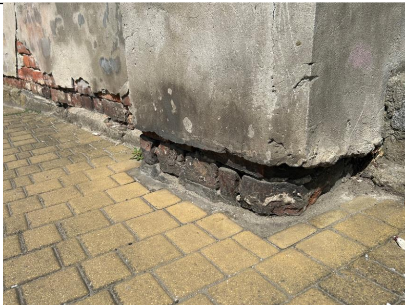
Fot. 34. Odcinek murowanego ogrodzenia przy ul. Kościuszki – dolny fragment słupa południowego z widoczną nasiloną korozją materiałów budowlanych wywołaną podciąganiem kapilarnym wód gruntowych wraz z solami rozpuszczalnymi w wodzie; zabrudzenia powierzchniowe muru
