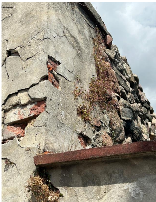
Fot. 32. Odcinek murowanego ogrodzenia przy ul. Kościuszki – słup północny – widoczna silna korozja tynków oraz obecność drobnej roślinności zakorzenionej w spękaniach i ubytkach tynku, która przyczynia się do rozsadzania murów oraz utrzymywania wysokiego stopnia ich zawilgocenia
