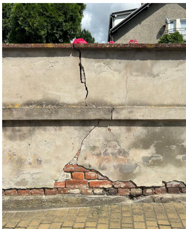
Fot. 33. Odcinek murowanego ogrodzenia przy ul. Kościuszki – pęknięcie o przebiegu zbliżonym do pionowego w jego środkowej partii; znaczne ubytki tynku w przyziemiu; zabrudzenia i zaplamienia powierzchni tynków; korozja mikrobiologiczna
