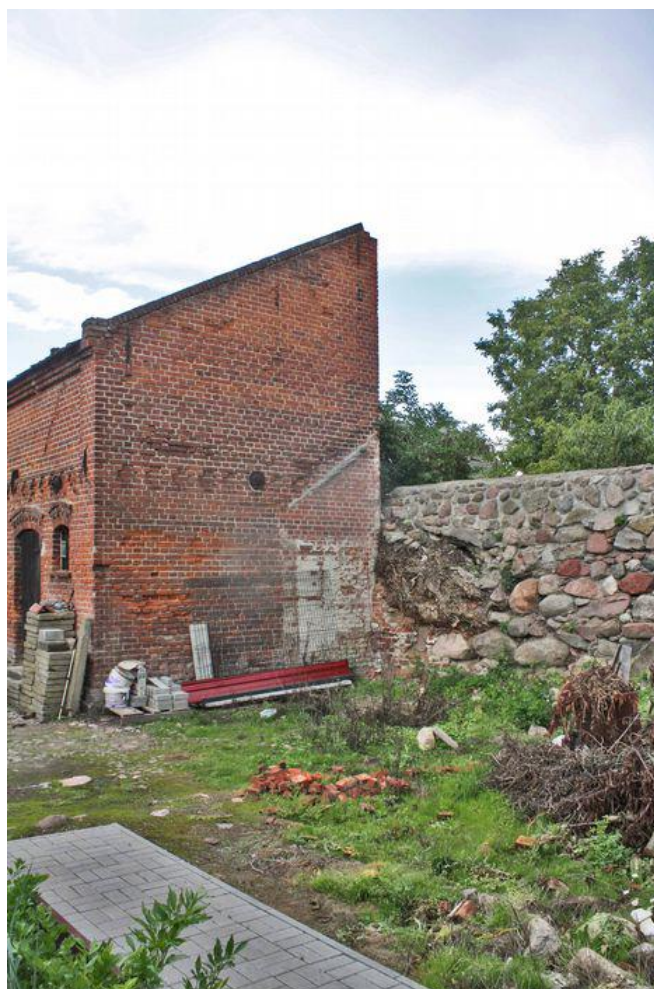
Fot. 35. Budynek gospodarczy oraz przyległy odcinek kurtyny muru z wrośniętym korzeniem
