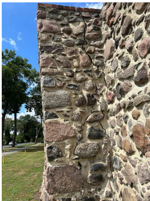
Fot. 43. Baszta łupinowa nr VIII w ciągu zabytkowych murów obronnych – widoczna deformacja muru w kierunku południowym, a także wydatne pęknięcia zlokalizowane na styku z przyległą kurtyną muru (widok od strony wschodniej)
