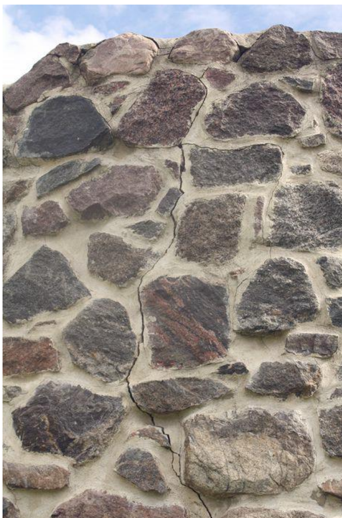
Fot. 47. Baszta łupinowa nr VII w ciągu zabytkowych murów obronnych – spękanie o przebiegu zbliżonym do pionowego w partii środkowej cylindrycznego obrysu
