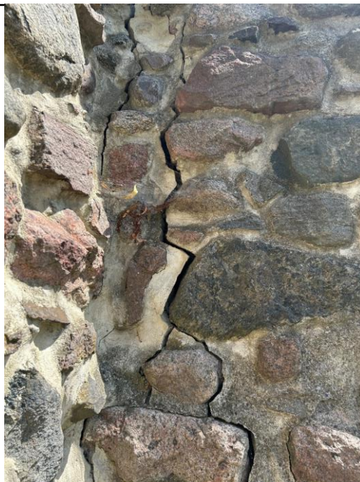
Fot. 42. Baszta łupinowa nr VIII w ciągu zabytkowych murów obronnych – wydatne pęknięcie zlokalizowane na styku z przyległą kurtyną muru (widok od strony zachodniej)
