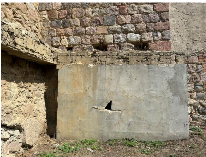
Fot. 53. Dolny fragment ściany zachodniej Bramy Myśliborskiej z pozostałościami nieistniejącego już budynku przy ul. Dworcowej 2 – półką ze zbrojonego betonu oraz ścianką z gazobetonu; ubytki zapraw spoinujących między kwadrami
