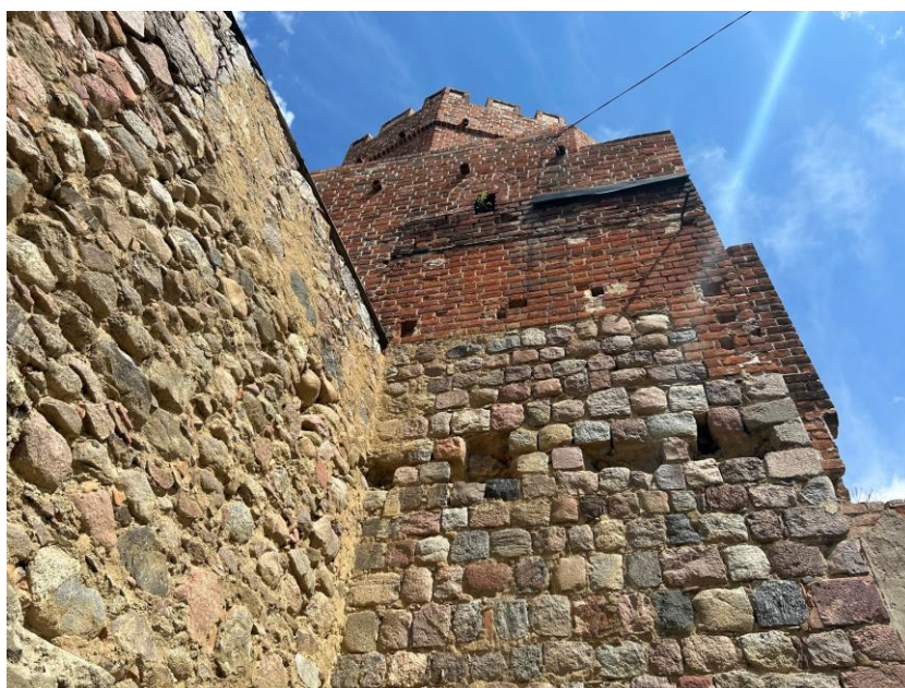
Fot. 51. Część ściany zach. Bramy Myśluborskiej – widoczna w obrębie partii z licem mурowanym z cegły ukośna bruzda, wykuta w celu osadzenia opierzenia na styku z połączeniem dachu rozebranego budynku
