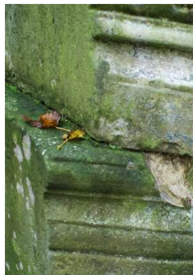
Fot. 36. Widok na odwrocie i łączenie obu części cokołu od prawej strony. Widoczny duży ubytek oraz znaczny rozwój mikroflory.
