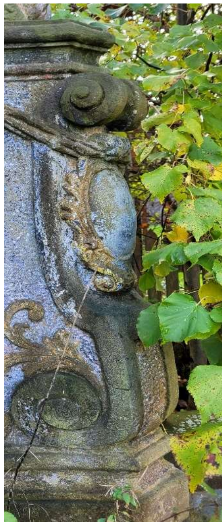
Fot. 28. Widok na lewy narożnik górnej części cokołu. Widoczny znaczny rozwój mchów i porostów. Dobrze zachowana polichromia na kilku detalach tego elementu.
