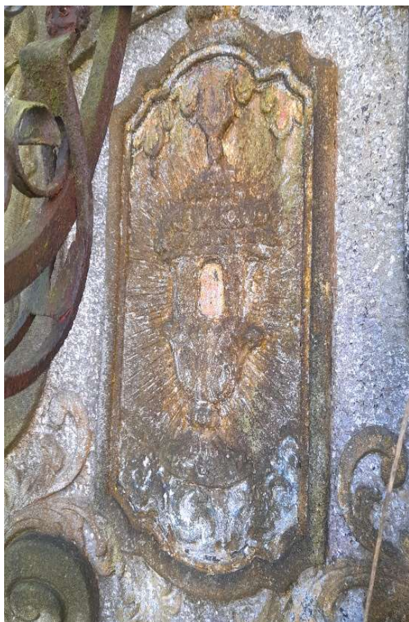
Fot. 25. Widok na górną część cokołu, od frontu. Zbliżenie na kartusz z płaskorzeźbionym relikwiarzem. Zachowana polichromia, która w widoczny sposób rozwarstwia się i łuszczy.
