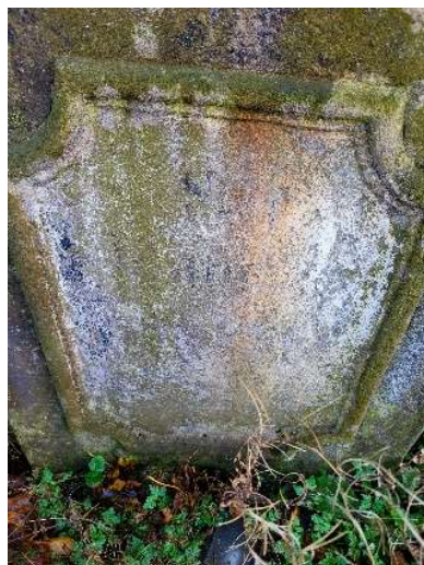
Fot. 38. Widok na dolną część cokołu od frontu. Szczątkowo zachowana polichromia na kartuszu. Widoczne przebarwienia na powierzchni kamienia i rozwój mchów i porostów, a w przyziemiu rozwój roślinności.
