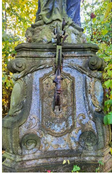
Fot. 21. Widok na górną część cokołu od frontu i metalowy wysięgnik na latarnię. Widoczna zachowana polichromia na niektórych elementach oraz znaczny rozwój mchów i porostów.
