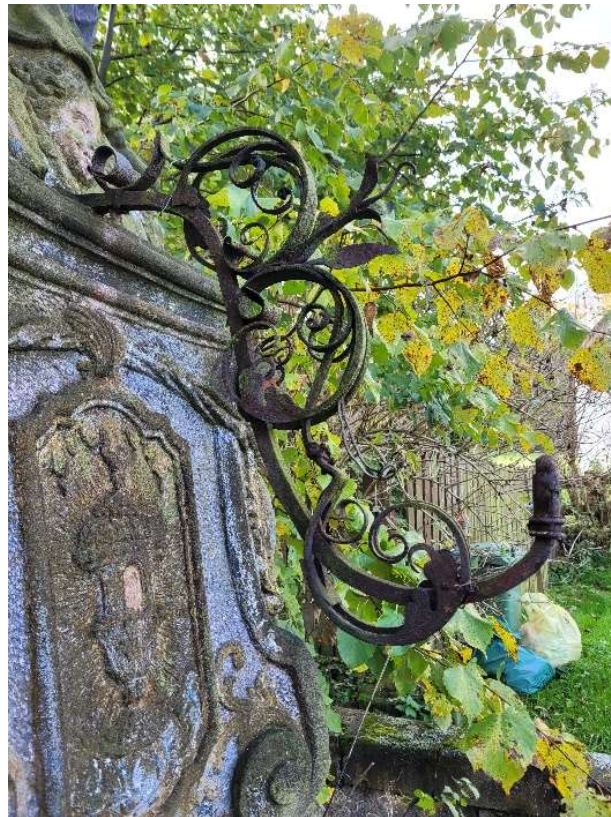
Fot. 23. Widok na późniejszy, ozdobny wysięgnik pokryty produktami korozji oraz mchami i porostami. Brak zamontowanej latarni.
