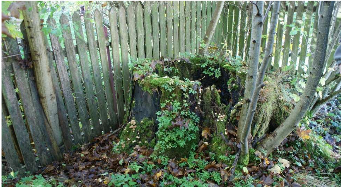
Fot. 56. Karcz ściętego drzewa, znajdujący się za rzeźbą. Jego korzenie, a także nowo wyrastające drzewa, mają bezpośredni wpływ na mechaniczne niszczenie fundamentów, a tym samym i pozostałych elementów balustrady.
