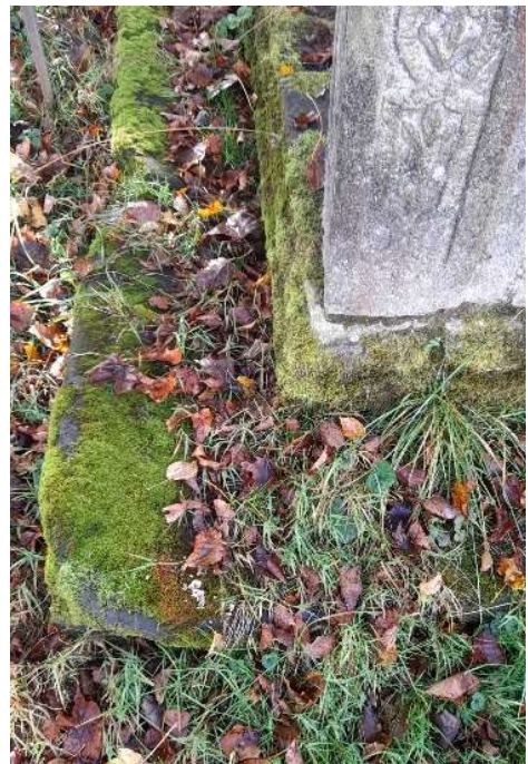
Fot. 55. Zbliżenie na część cokołu i fundamentu od frontu (narożnik po prawej stronie rzeźby). Widoczne liczne skupiska mchów, porostów i traw.
