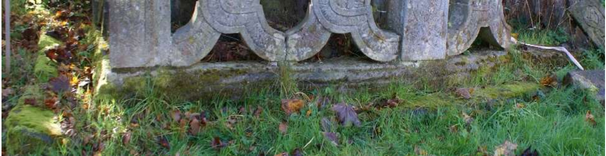
Fot. 53. Widok na frontową część cokołu i fundamentu ogrodzenia. Widoczne liczne skupiska mchów i porostów na kamieniach oraz niemal całkowicie zarośnięty fundament.
