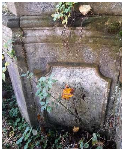
Fot. 37. Widok na dolną część lewej strony cokołu. Szczątkowo zachowana polichromia na kartuszu. Widoczne przebarwienia powierzchni kamienia i rozwój mikroflory, a w przyziemiu rozwój roślinności.
