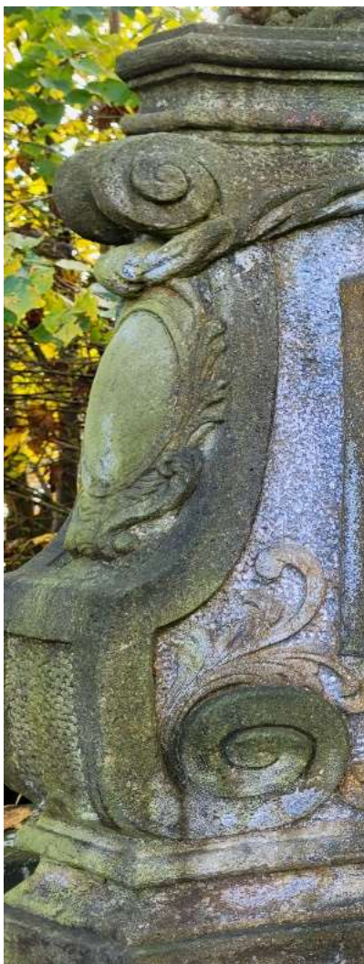
Fot. 27. Widok na prawy narożnik górnej części cokołu, widoczny znaczny rozwój mchów i porostów.
