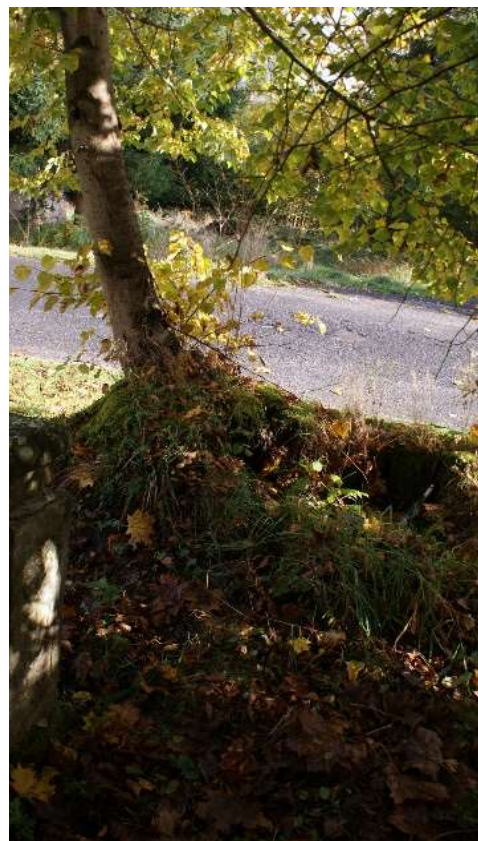
Fot. 58. Karcz ściętego drzewa za rzeźbą, po prawej stronie. Jego korzenie, a także nowo wyrastające drzewo, mają bezpośredni wpływ na mechaniczne niszczenie fundamentów balustrady.
