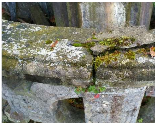
Fot. 42. Zbliżenie na nakrywę balustrady od frontu. Widoczne znaczne uszkodzenie mechaniczne oraz rozwój mchów i porostów.
