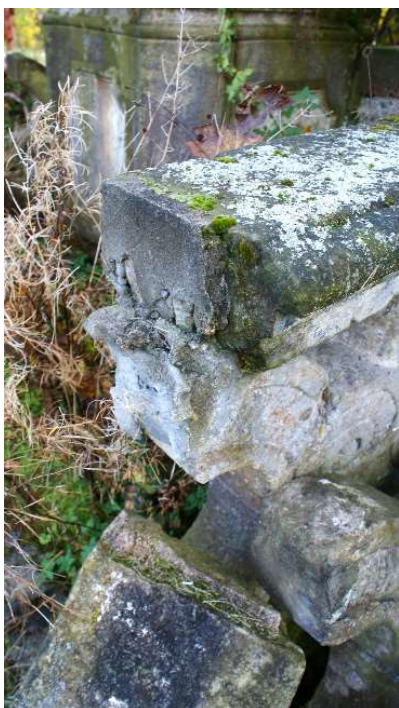
Fot. 48. Widok na lewy narożnik ogrodzenia. Widoczne pozostałości zaprawy cementowej.
