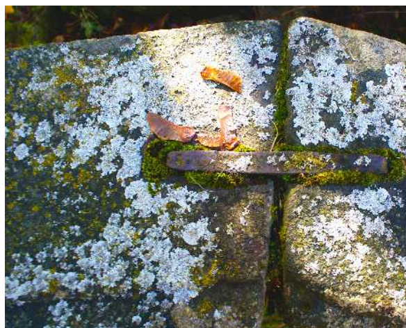
Fot. 43. Zbliżenie na nakrywę balustrady od frontu i na metalową klamrę łączącą kamienne bloki nakrywy. Metalowy element jest silnie skorodowany.
