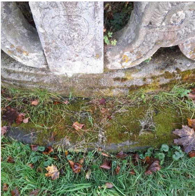
Fot. 54. Zbliżenie na część cokołu i fundamentu od frontu. Widoczne liczne skupiska mchów, porostów i traw.
