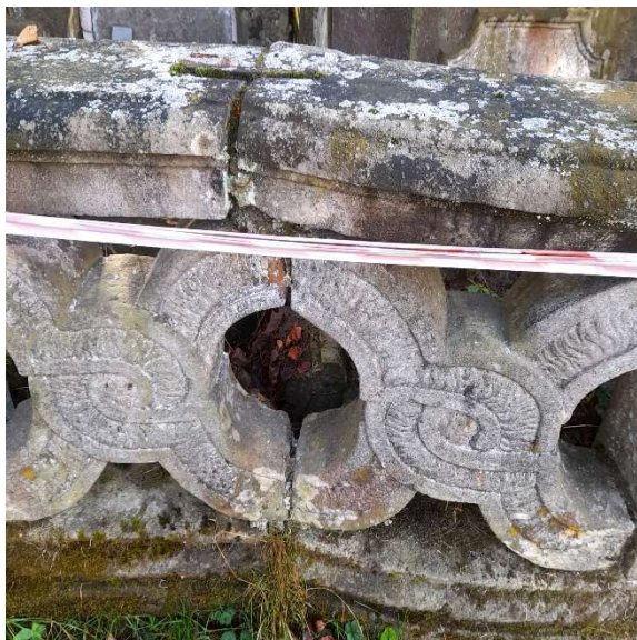
Fot. 44. Widok na frontową część ogrodzenia, zbliżenie na elementy w formie „X”. Widoczne dobrze zachowane ozdobne reliefy tych elementów, nieliczne przebarwienia, szczególnie w przyziemiu oraz rozwój mchów i porostów.
