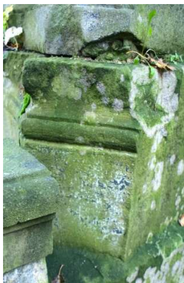
Fot. 34. Widok na odwrocie i łączenie obu części cokołu od lewej strony. Widoczne duże ubytki w tym miejscu oraz znaczny rozwój mikroflory.
