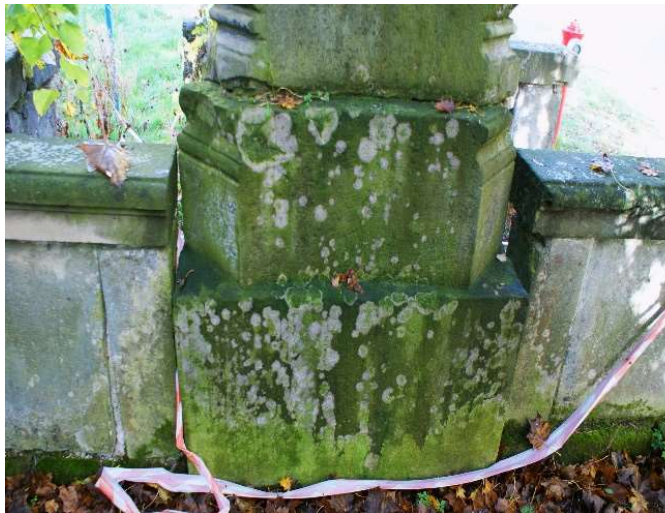
Fot. 7. Dolna część odwrocia cokółu rzeźby św. Jana Nepomucena i tylnej części kamiennego ogrodzenia.
