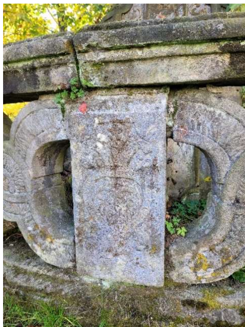
Fot. 46. Widok na frontową część ogrodzenia, zbliżenie na element w formie prostopadłościanu. Widoczny dobrze zachowany, ozdobny relief, przebarwienia na powierzchni kamienia i kilka miejsc ze skupiskami mchów i porostów. Widoczny rozwój roślinności pomiędzy elementami balustrady.
