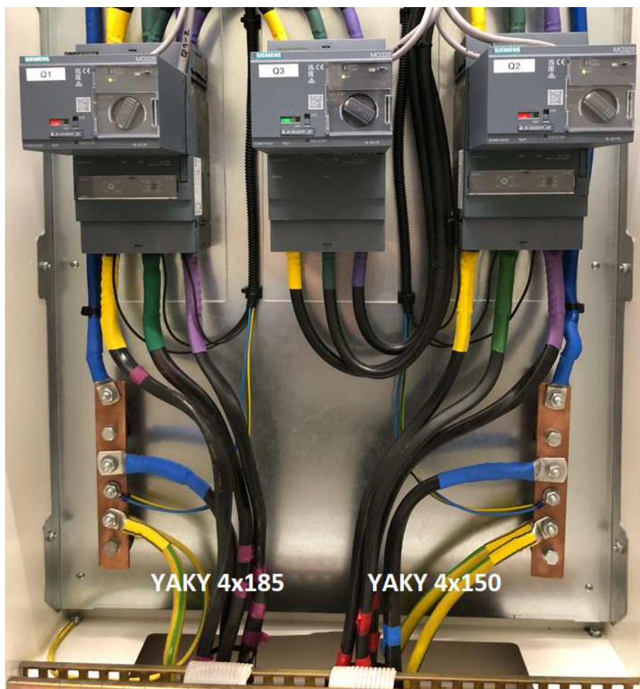
Podejścia linii kablowych K1 na SZR rozdzielnicy R10-4.
