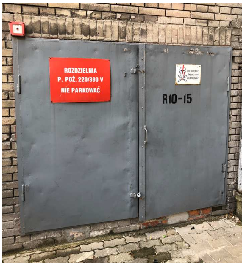
Rys. 6. Prezentacja lokalizacji rozdzielnic R10- 15 w elewacji budynku Wydziału Elektrotechniki
