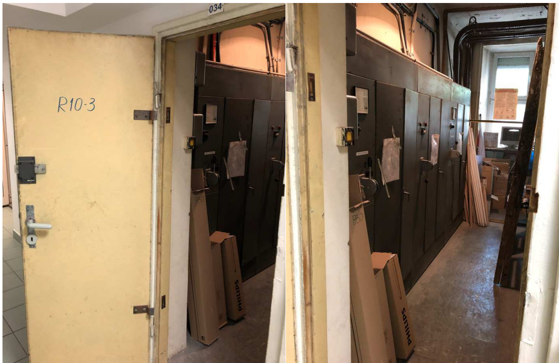
Widok pomieszczenia rozdzielnic R10-3
