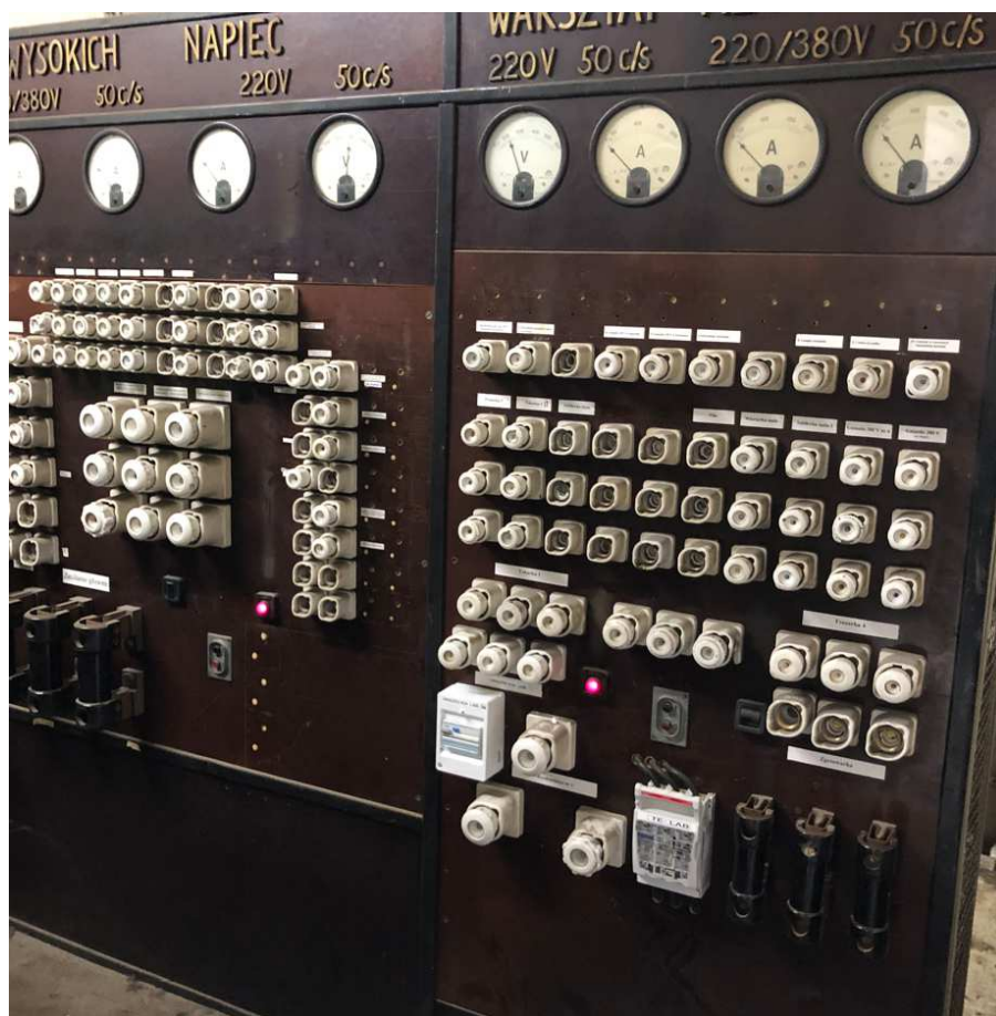
Widok rozdzielnic RWt, front – fragment.
