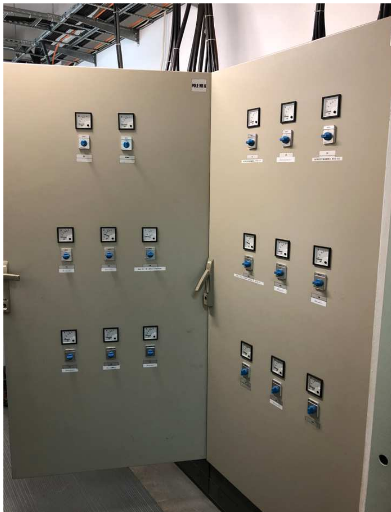
Widok rozdzielnicy R1-0 – fragment.
