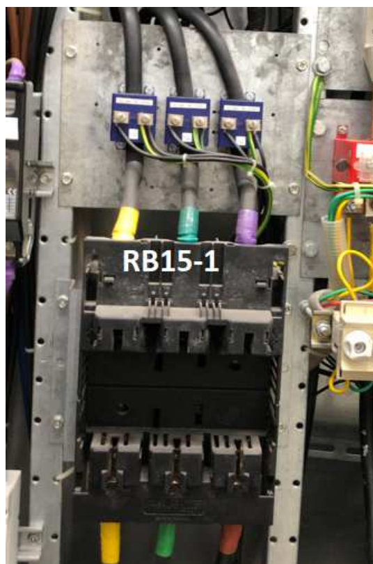
Widok zabezpieczenia RB15-1 w Polu 2 rozdzielnic R10-4, zasilania rezerwowego R10-15.
