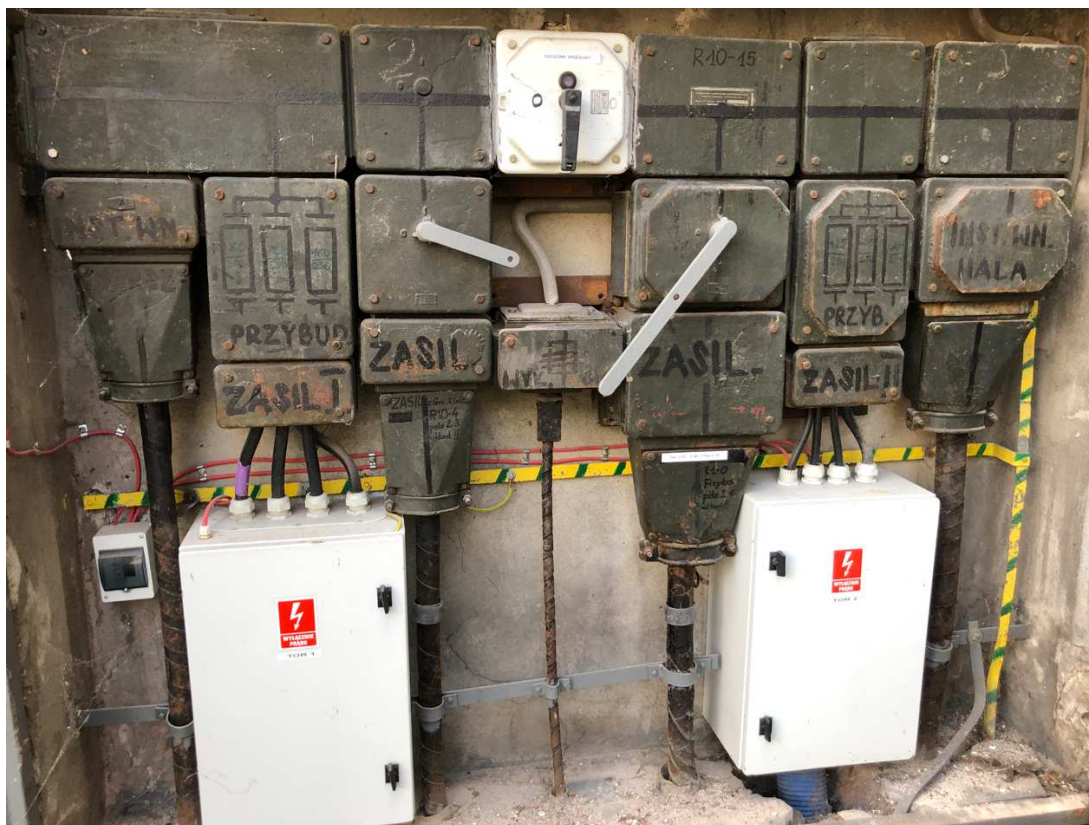
Widok rozdzielnic R10-15.
