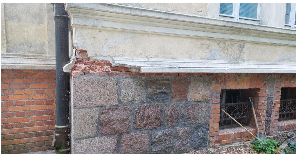
Fragment elewacji północnej, stan istniejący: maj 2023 r. (uszkodzenia - ubytki gzymsów, łuszczenia farby, wykwyty i przebarwienia).
