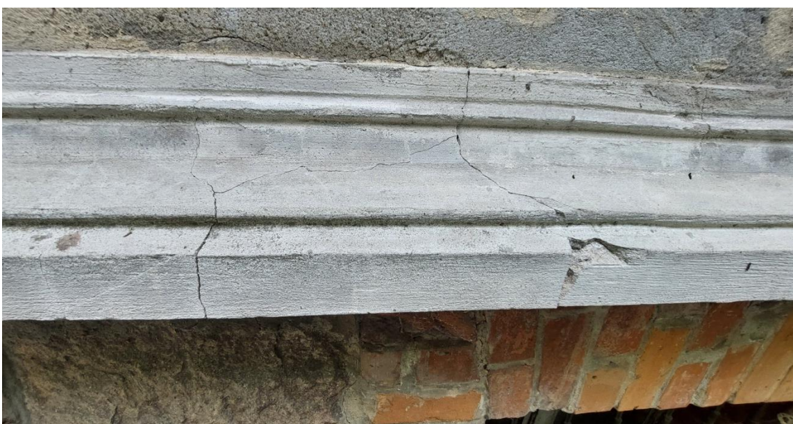
Fragment elewacji północnej, stan istniejący: maj 2023 r. (pęknięcia gzymsów).
