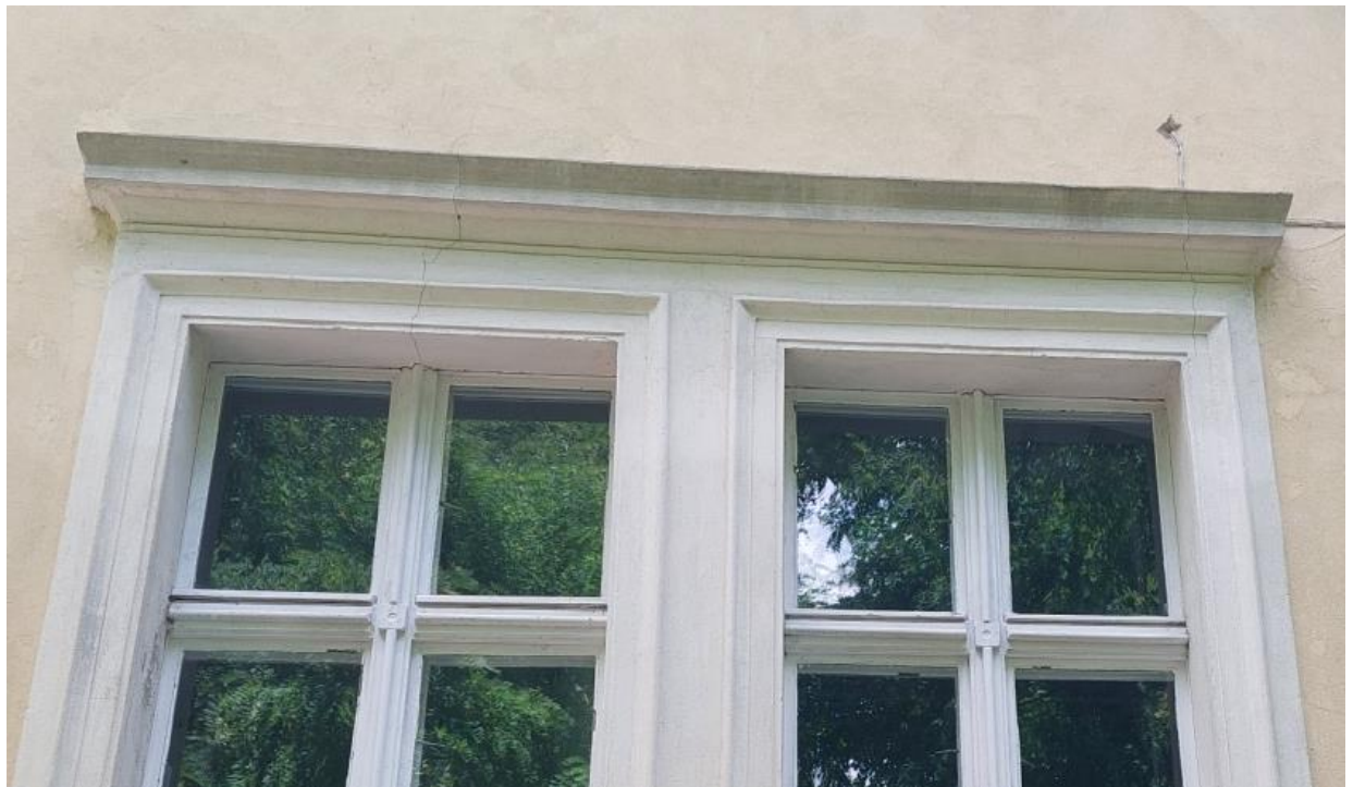
Elewacja północna, pęknięcia nadproży okiennych. Stan istniejący maj' 2023 r.
