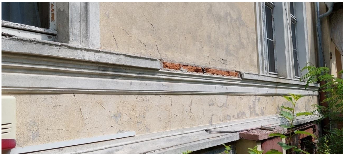
Fragment elewacji południowej, stan istniejący: maj 2023 r. (uszkodzenia gzymsów, łuszczenia farby, wykwyty i przebarwienia).
