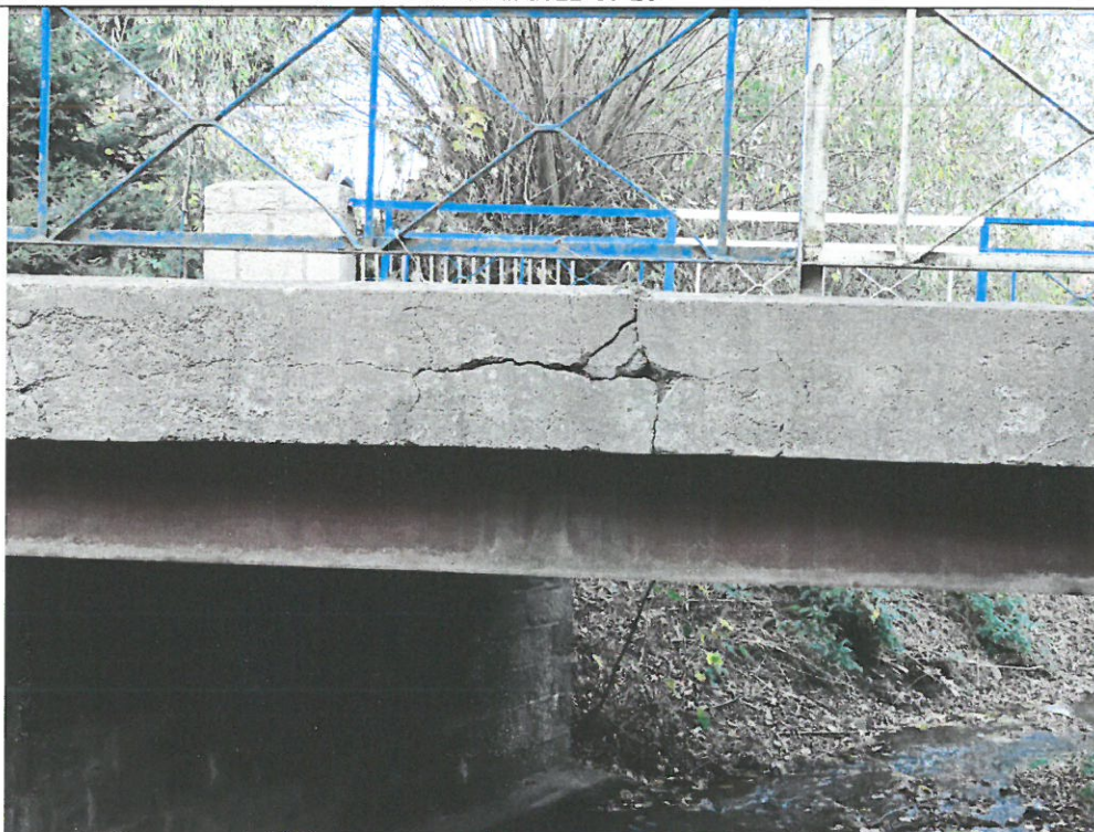
Fot. 3 Zarysowanie oraz ubytek betonu na gzymsie
