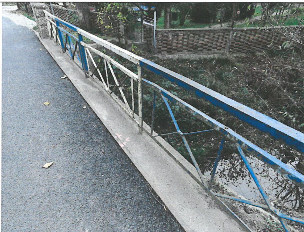
Fot. 4 Korozja oraz deformacja balustrady
