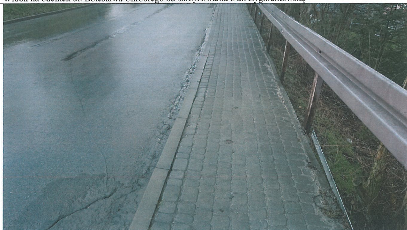
Widok na główne pęknięcia w obrębie odcinka ul. Bolesława Chrobrego częściowo zabezpieczone
