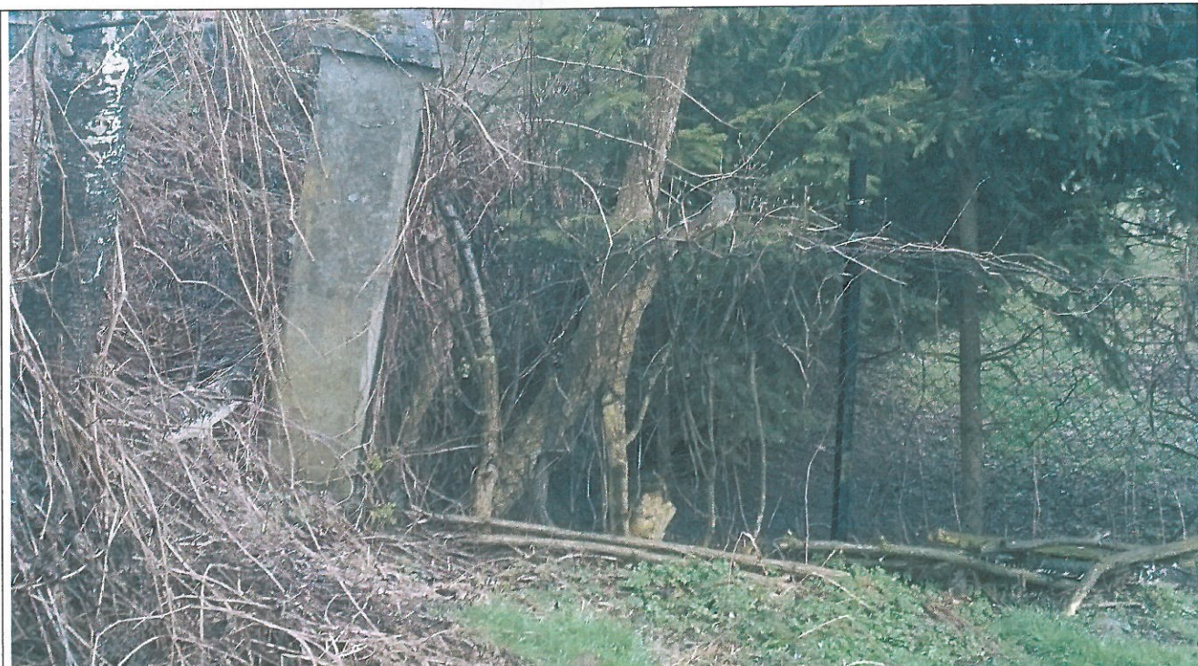
Widok na przechylony słup ogrodzenia na skarpie pod ul. Bolesława Chrobrego
